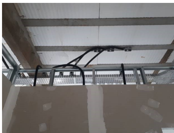
Figura 10E: infra estrutura condutetes
