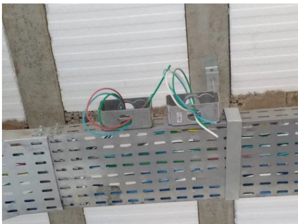
Figura 15E: cabeamento elétrico 2,5mm 2
