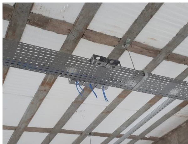
Figura 12E: infra estrutura condutetes
