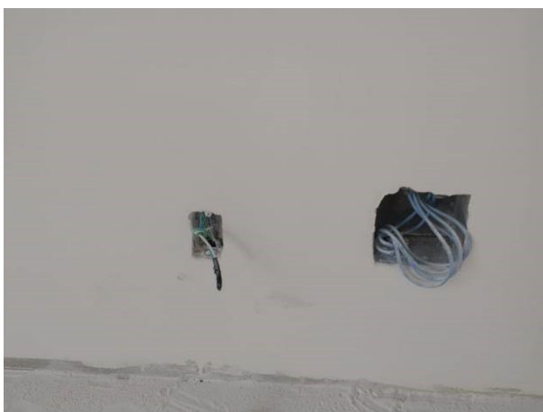
Figura 25E: cabeamento estruturado UTP Cat6
