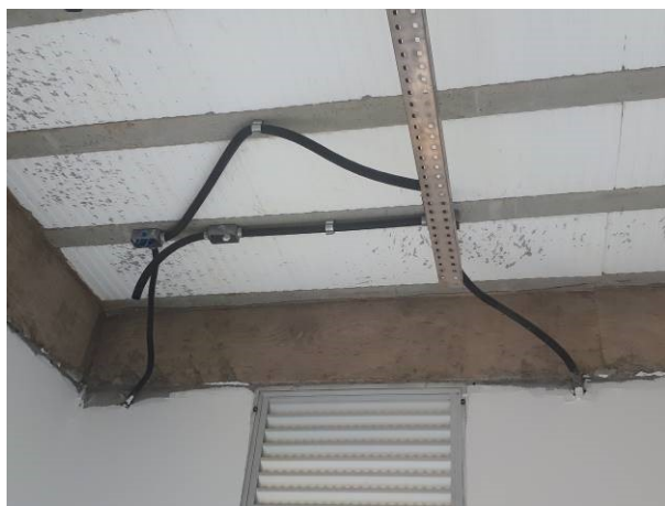
Figura 11E: infra estrutura condutetes
