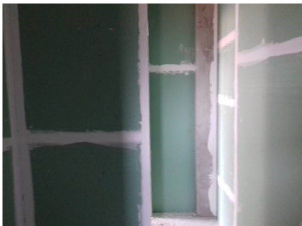
Figura 09C: Parede de gesso acartonado verde, nos vestiários
