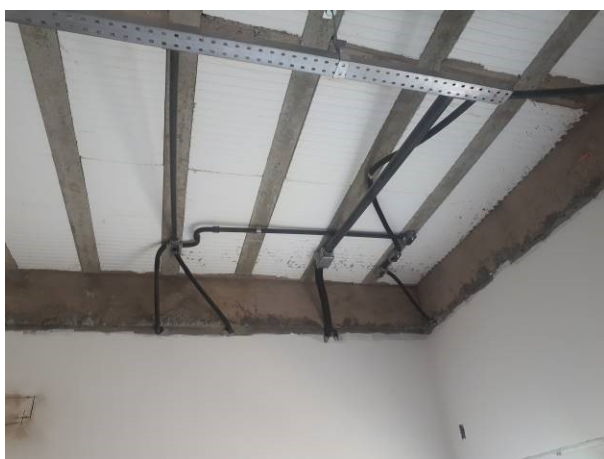
Figura 09E: infra estrutura condutetes
