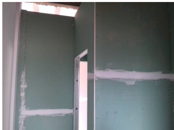
Figura 10C: Parede de gesso acartonado verde, nos vestiários
