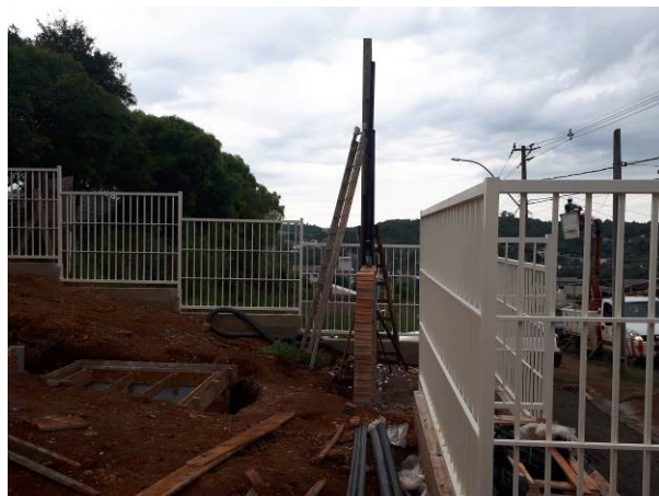
Figura 02E: entrada de energia elétrica - necessidade remanejamento
