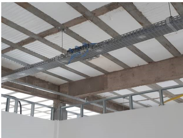
Figura 27E: cabeamento estruturado UTP Cat6
