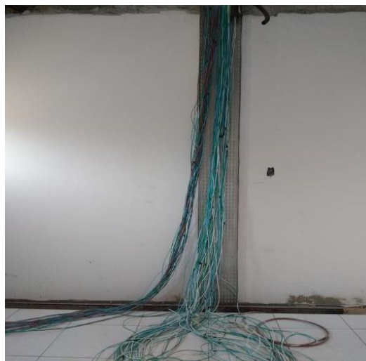
Figura 20E: cabeamento elétrico 2,5mm 2
