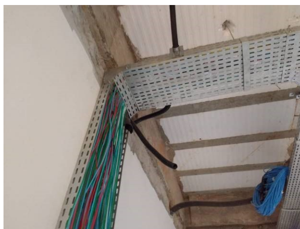
Figura 18E: cabeamento elétrico 2,5mm 2 - necessidade substituição neutro estabilizada
