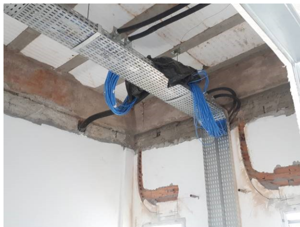
Figura 30E: cabeamento estruturado UTP Cat6
