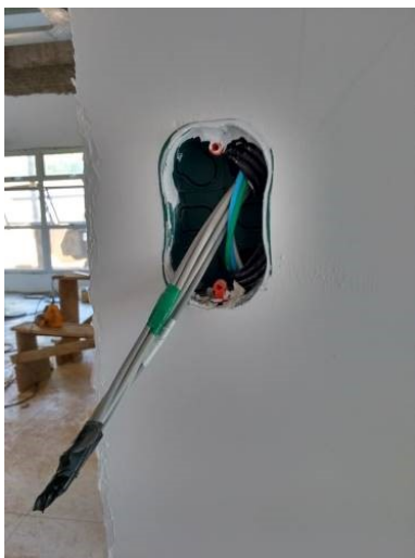
Figura 19E: cabeamento elétrico 2,5mm 2
