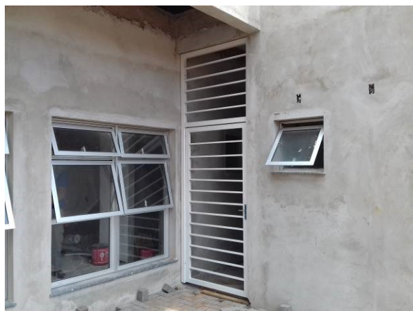
Figura 17C: Gradil de proteção da porta localizada na lateral direita, ao lado da sala técnica
