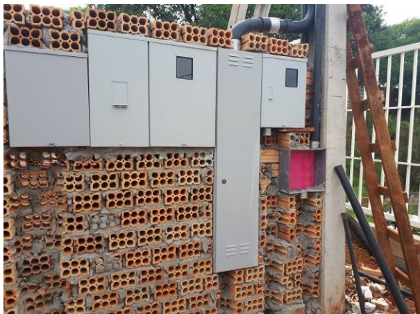
Figura 01E: entrada de energia elétrica - necessidade remanejamento
