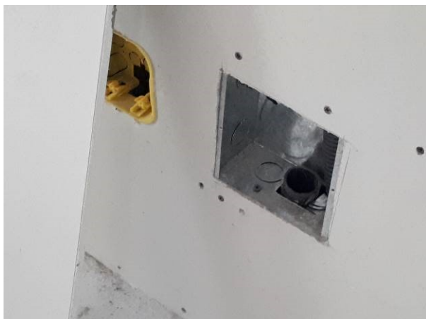
Figura 23E: infraestrutura para cabeamento estruturado - caixas de passagem e eletrodutos
