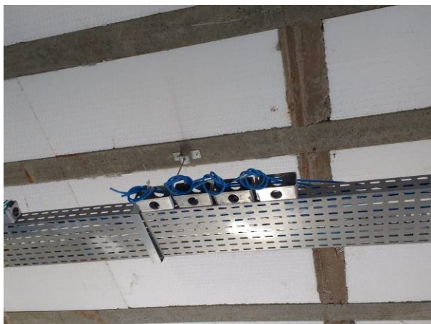
Figura 29E: cabeamento estruturado UTP Cat6
