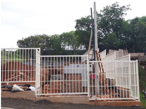
Figura 03E: entrada de energia elétrica - necessidade remanejamento
