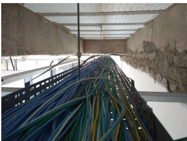
Figura 17E: cabeamento elétrico 2,5mm 2
