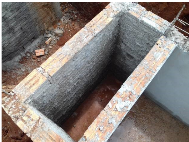
Figura 32C: Filtro anaeróbico, detalhe do poço de queda
