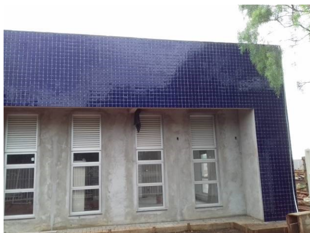
Figura 51C: Pastilhas instaladas na fachada frontal à direita (arquivo e sala múltiplo uso)
