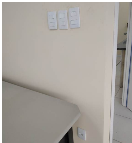
Figura 11E - Tomadas e interruptores
