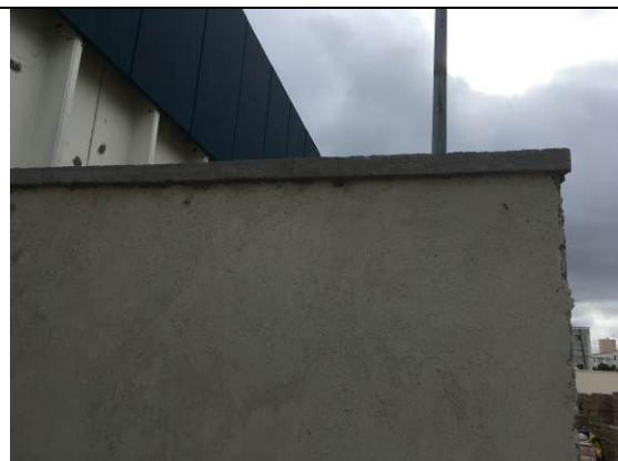
Figura 41C - requadros e pingadeiras - muro - lounge externo
