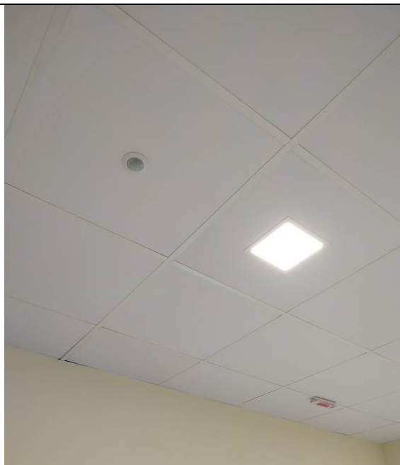
Figura 15E - Iluminação com painel LED, bloco de emergência e sensor de presença
