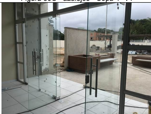
Figura 32C - portas de vidro temperado
