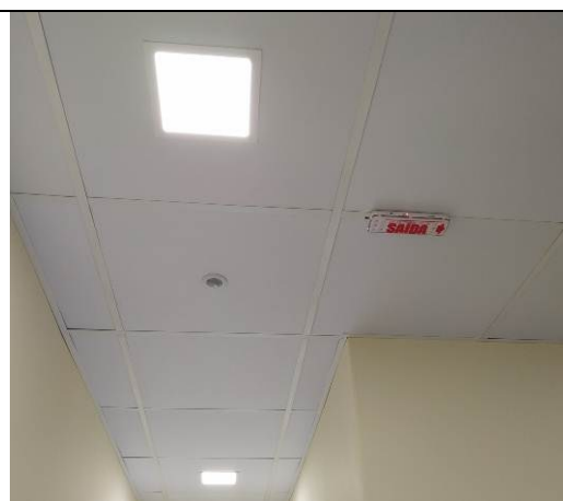
Figura 14E - Iluminação com painéis LED, bloco de emergência e sensor de presença
