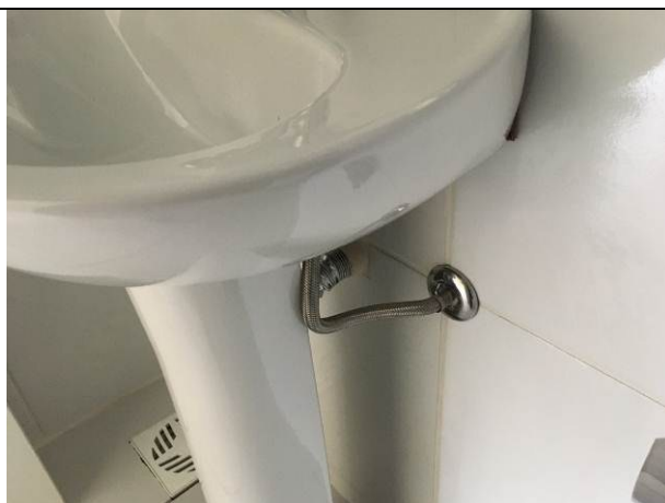
Figura 10C - ponto de água - lavatório
