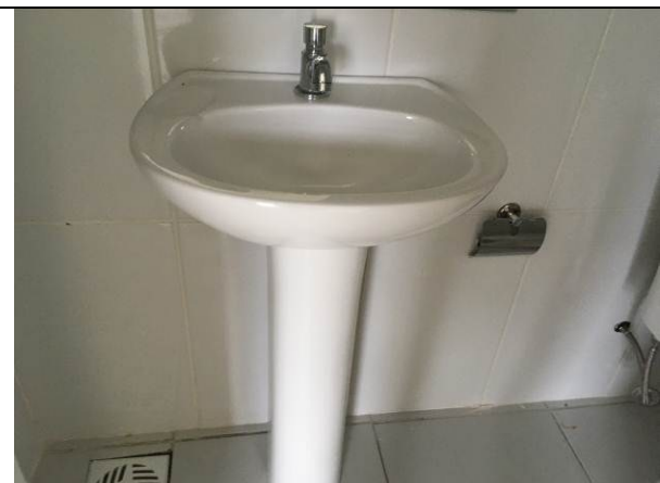
Figura 12C - lavatório de coluna
