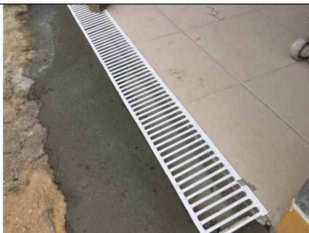
Figura 19C - grelha captação águas pluviais
