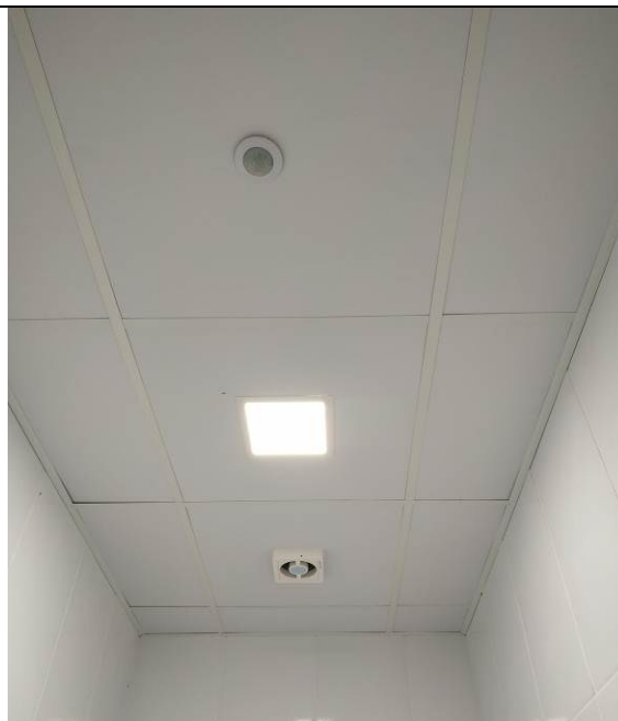
Figura 16E - Iluminação com painel LED, exaustor de teto e sensor de presença
