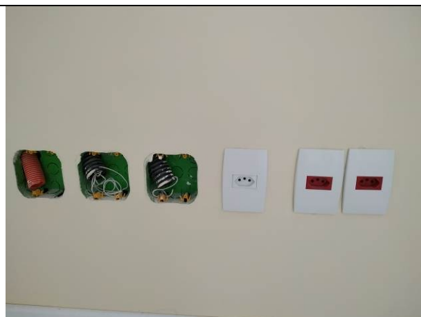
Figura 09E - Tomadas elétricas
