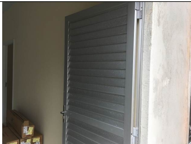
Figura 35C - porta alumínio - acesso ao estacionamento
