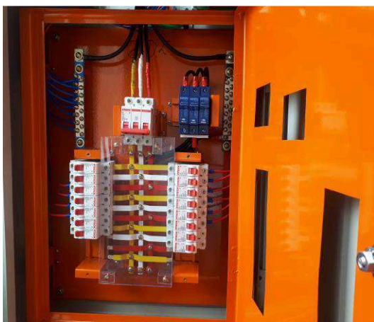
Figura 19E: Quadros elétricos - subtampa com dobradiças
