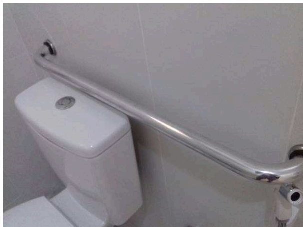
Figura 17C: Barras de apoio para vaso sanitário, instaladas no sanitário PNE do pavimento superior
