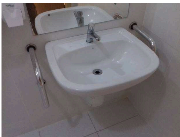
Figura 14C: Barras de apoio para lavatório, instaladas no sanitário PNE do pavimento superior
