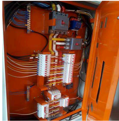
Figura 18E: Quadros elétricos - subtampa com dobradiças
