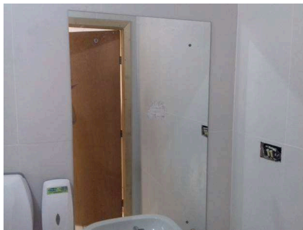
Figura 18C: Espelho cristal, tamanho 60x100cm, instalado no sanitário PNE do pavimento superior
