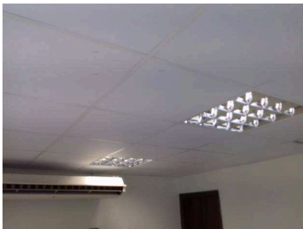
Figura 06C: Forro de gesso acartonado removível, instalado na sala de audiência 1
