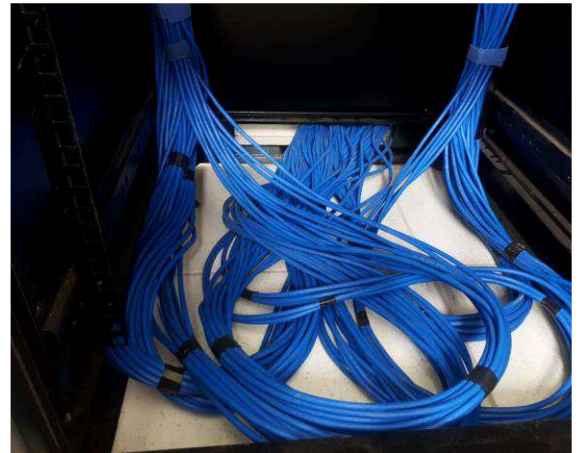
Figura 22E: Cabeamento estruturado cat6
