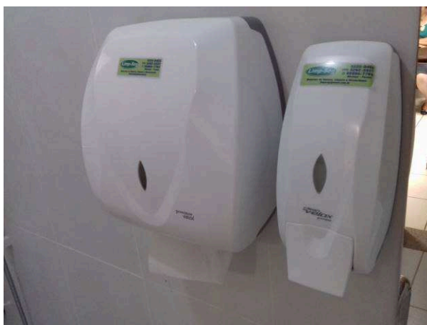
Figura 12C: Dispensers de papel toalha e sabonete líquido, instalados no sanitário PNE do pavimento superior
