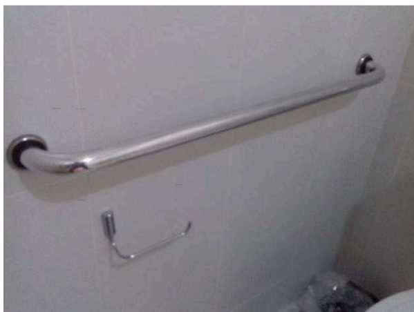
Figura 16C: Barras de apoio para vaso sanitário, instaladas no sanitário PNE do pavimento superior
