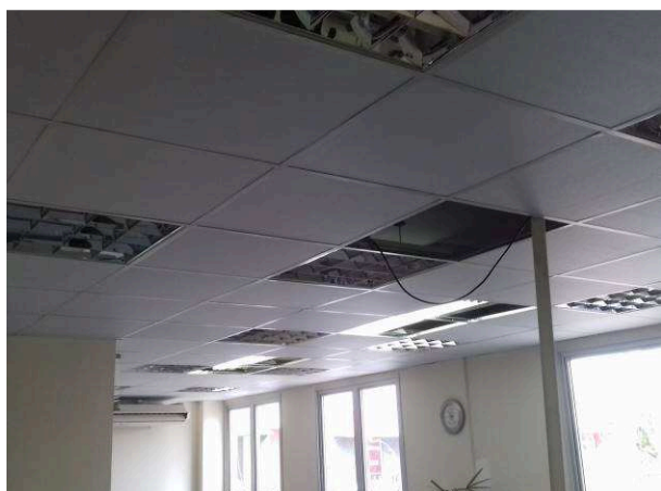
Figura 07C: Forro de gesso acartonado removível, instalado na secretaria
