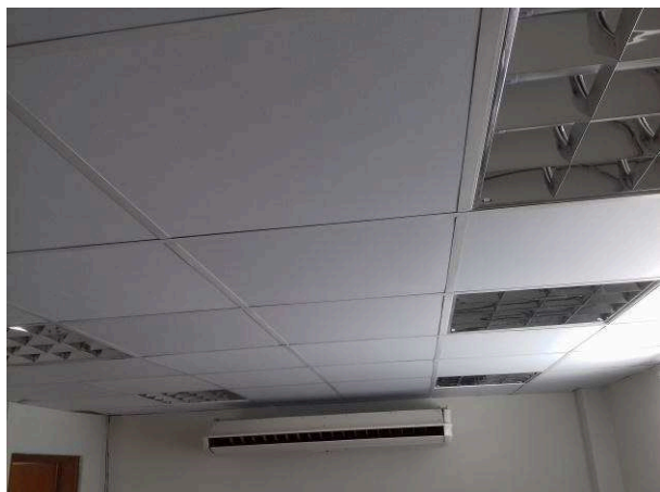
Figura 05C: Forro de gesso acartonado removível, instalado na sala de audiência 2
