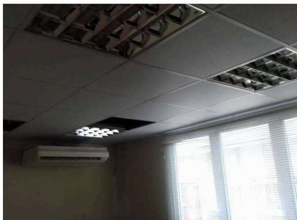
Figura 03C: Forro de gesso acartonado removível, instalado na secretaria, próximo ao balcão de atendimento
