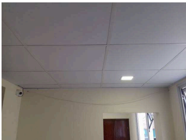
Figura 04C: Forro de gesso acartonado removível, instalado no segundo pavimento
