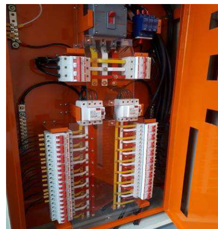
Figura 20E: Quadros elétricos - subtampa com dobradiças
