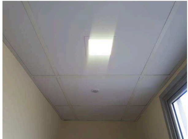
Figura 16E: luminárias tipo plafon e sensores de presença
