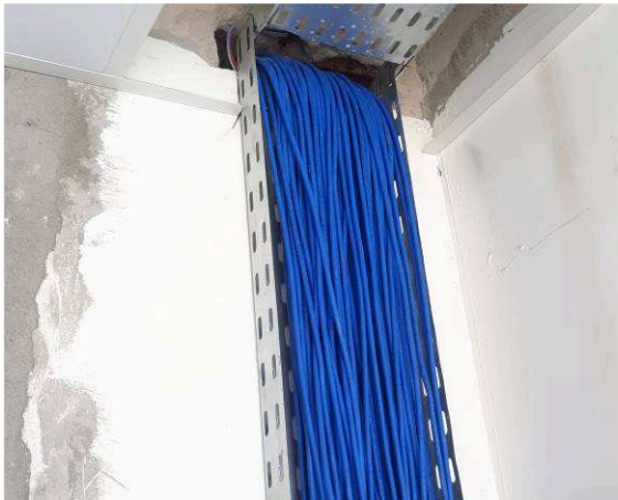
Figura 21E: Cabeamento estruturado cat6
