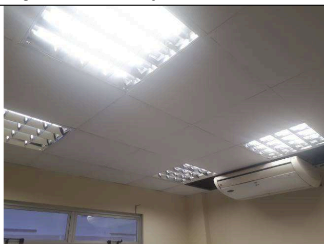
Figura 22E: iluminação Setorial
