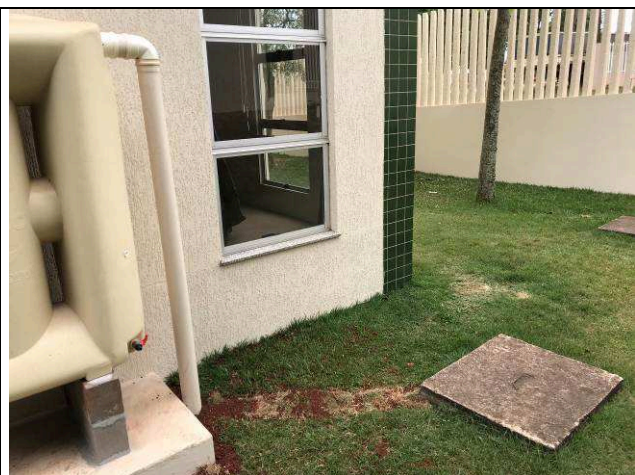
Figura 33C: Saída do extravasor superior - aproveitamento de águas pluviais.
