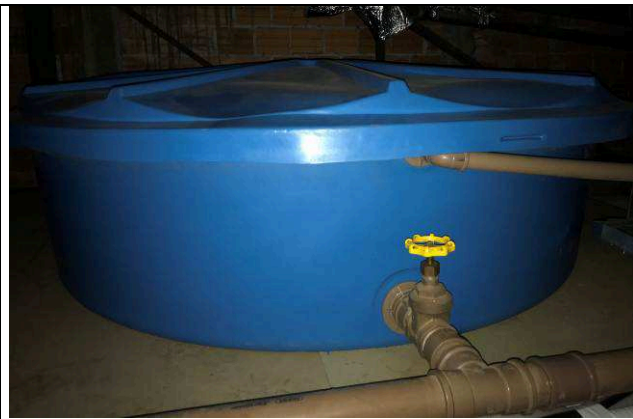
Figura 22C: Estrutura de apoio e caixas de água - 2ª Vara.
