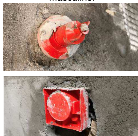
Figura 38C: Válvula de descarga e registro substituídos.
