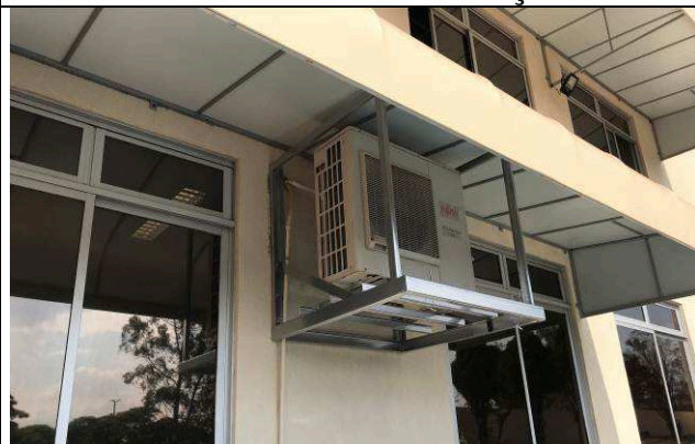
Figura 130C: Rede frigorígena nova e condensadora - Térreo da Setorial.
