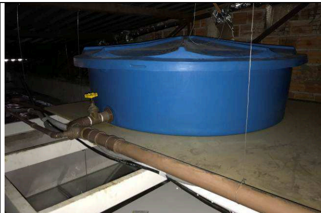
Figura 21C: Estrutura de apoio e caixas de água - 2ª Vara.
