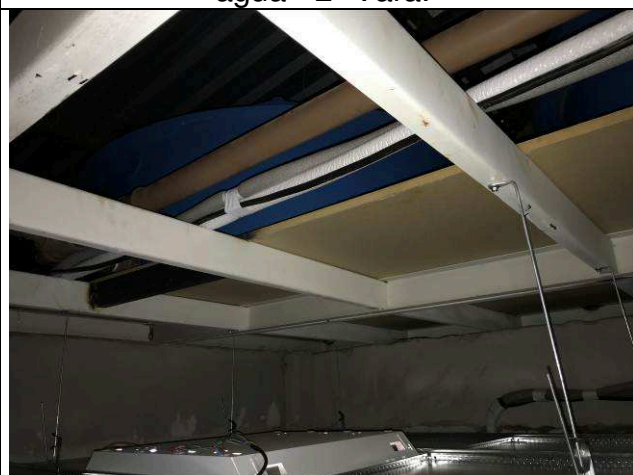
Figura 23C: Estrutura de apoio e caixas de água - 2ª Vara.
