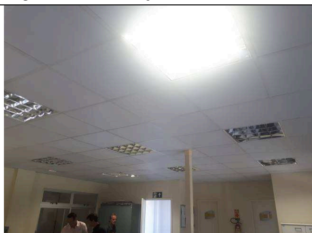
Figura 21E: iluminação Setorial
