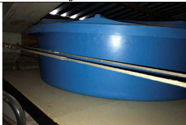
Figura 29C: Estrutura de apoio e caixa de água - Setorial.
