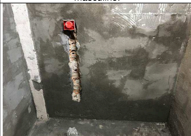
Figura 37C: Válvula de descarga substituída.
