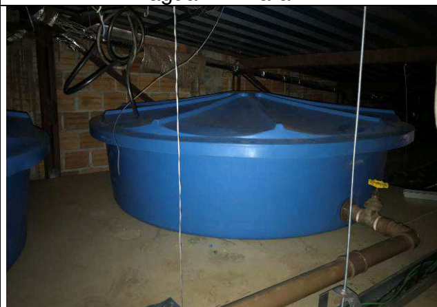
Figura 26C: Estrutura de apoio e caixas de água - 1ª Vara.
