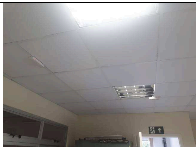
Figura 24E: iluminação Setorial
