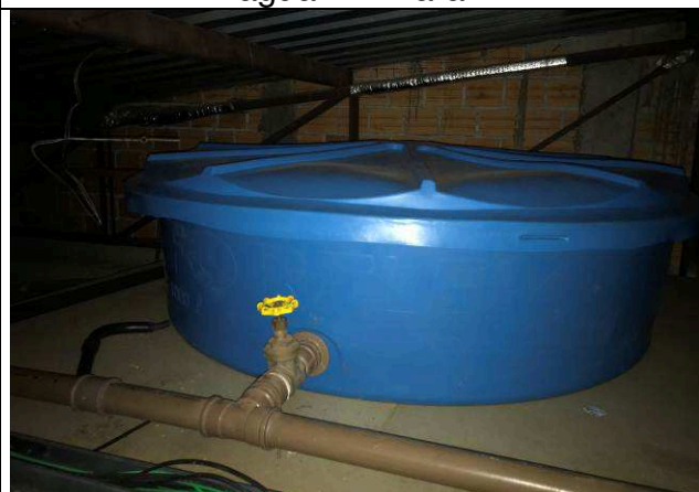
Figura 25C: Estrutura de apoio e caixas de água - 1ª Vara.
