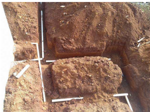
Figura 05C: Lateral direita com valas abertas para passagem da rede pluvial e esgoto
