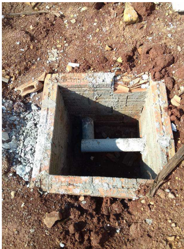
Figura 40C: Caixa de inspeção de esgoto, junto a sanitário público
