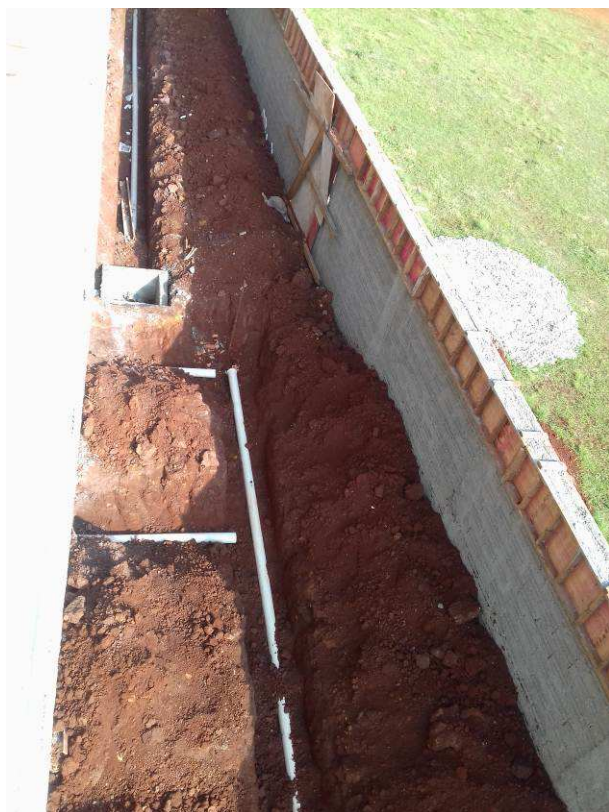
Figura 01C: Valas abertas para instalação da rede de esgoto sanitário, na parte posterior do imóvel
