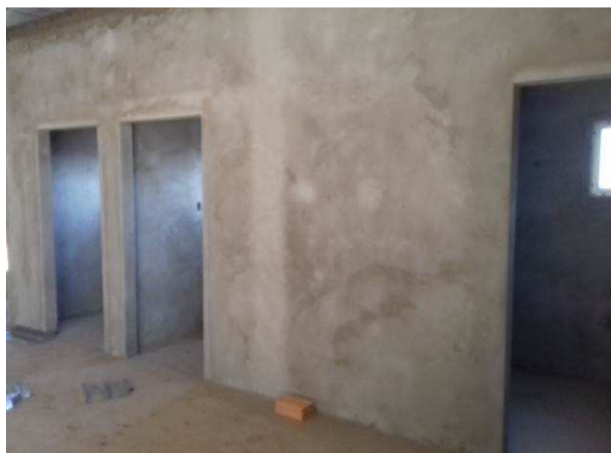
Figura 21C: Rebôco de parede em sanitários da secretaria e área de serviço
