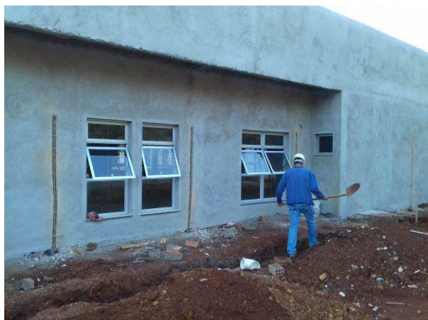
Figura 16C: Janelas 90x180cm, instaladas na sala dos assistentes e janela de 180x180, instalada no gabinete do juiz titular
