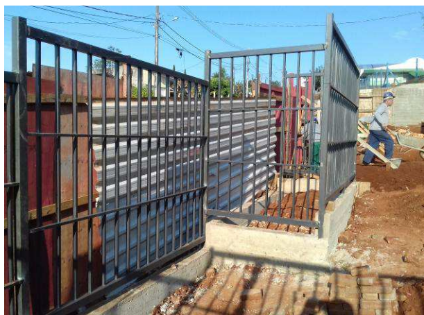
Figura 51C: Gradil instalado próximo ao acesso de veículos e pedestres
