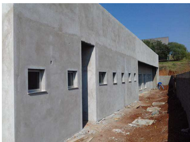
Figura 23C: Rebôco de parede externa - fundos
