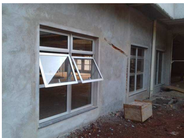
Figura 08C: Janelas 180x180cm, instaladas na sala de conciliação, sala de testemunhas e hall público
