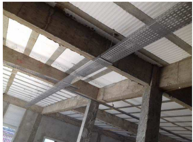
Figura 06E: Eletrocalha U#200x50, instalada no arquivo
