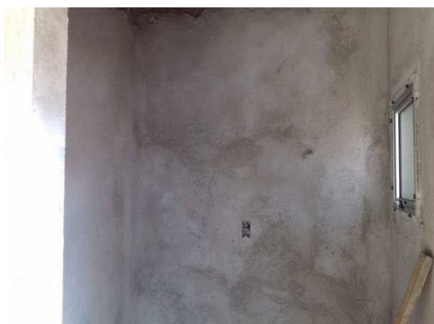
Figura 19C: Rebôco de parede em sanitário público
