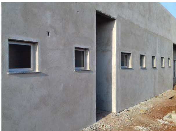
Figura 13C: Janelas 60x60cm e 90x60cm, instaladas na sala técnica, área de serviço e sanitários da vara
