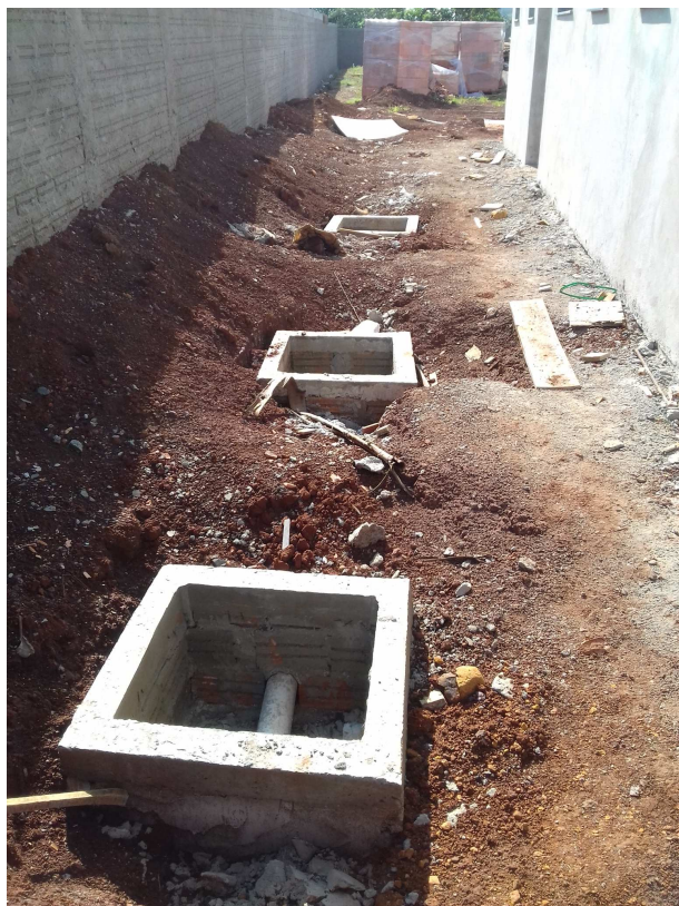
Figura 39C: Caixas de inspeção de esgoto, instaladas junto aos sanitários da secretaria
