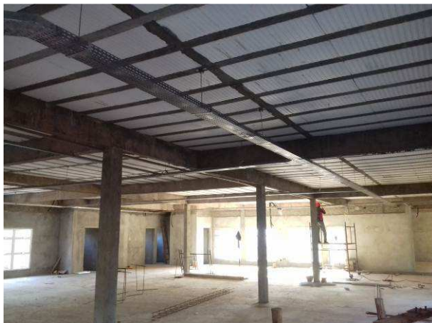
Figura 05E: Eletrocalha U#200x50, instalada na secretaria
