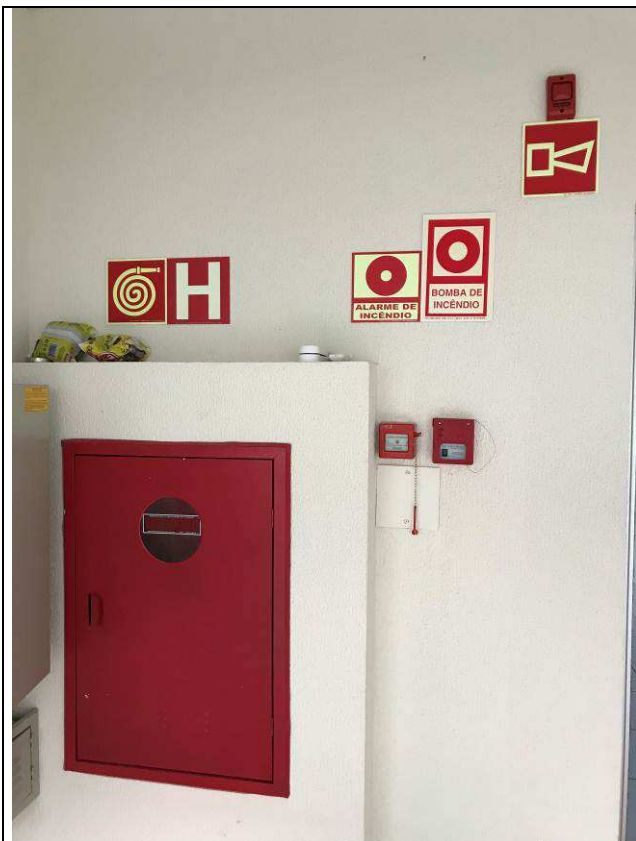
Figura 53C: Abrigo de Incêndio - Arquivo.
