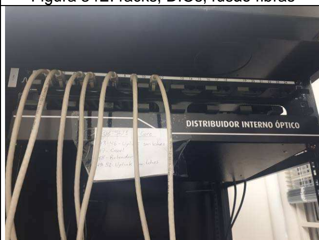
Figura 36E: racks, DIOs, fusão fibras
