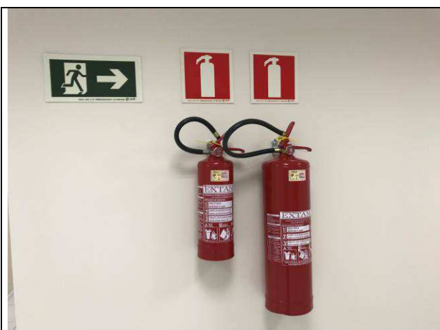
Figura 63C: Extintores de pó ABC e água potável - 3ª Vara - Fórum.
