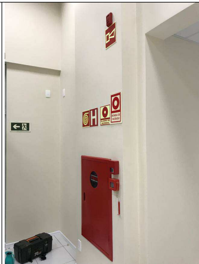
Figura 54C: Abrigo de Incêndio - Hall.
