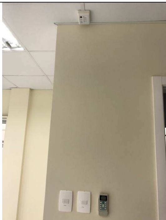
Figura 41C: Controle remoto e sensor instalados.
