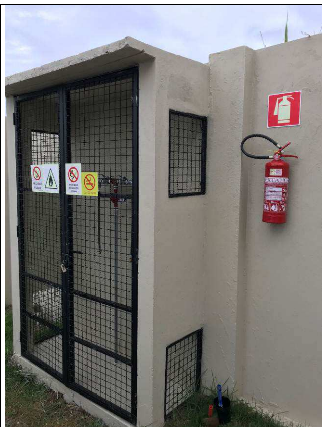
Figura 73C: Extintores de CO 2 e água potável - Abrigo de gás.
