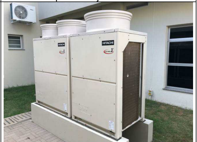
Figura 50C: Conjunto de condensadoras do Módulo Administrativo em teste.
