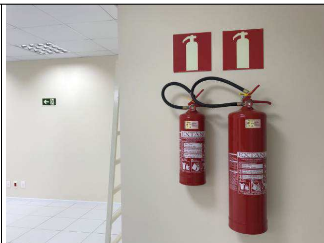
Figura 70C: Extintores de pó ABC e água potável - Distribuição - Fórum.
