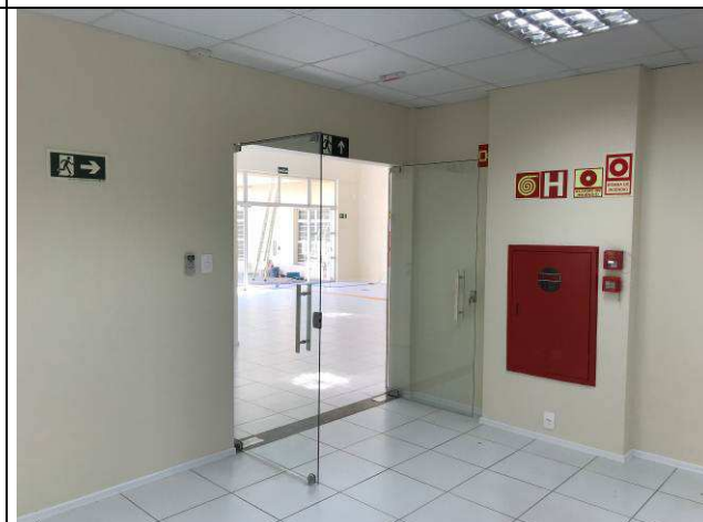
Figura 56C: Abrigo de Incêndio - 2ª Vara.
