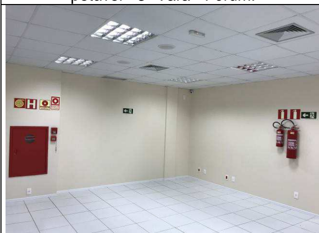
Figura 65C: Extintores de pó ABC e água potável - 2ª Vara - Fórum.
