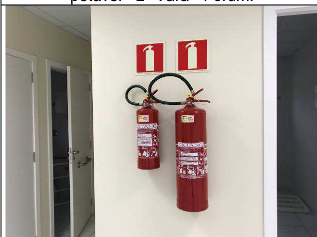
Figura 67C: Extintores de pó ABC e água potável - 2ª Vara - Fórum.
