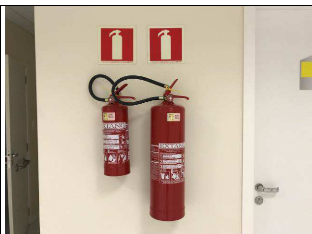
Figura 64C: Extintores de pó ABC e água potável - 3ª Vara - Fórum.
