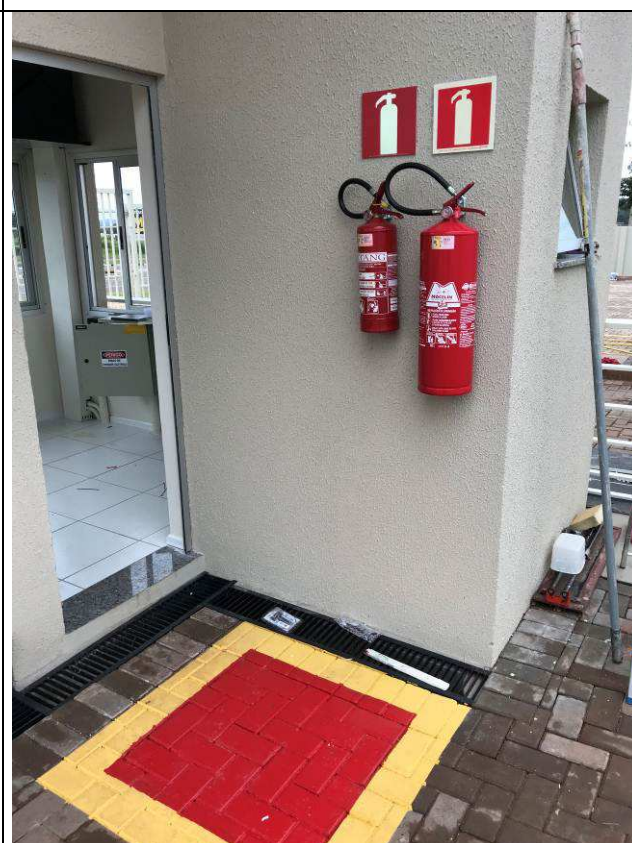
Figura 72C: Extintores de pó ABC e água potável - Guarita.
