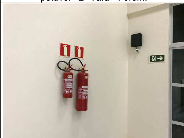
Figura 68C: Extintores de pó ABC e água potável - Hall - Fórum.
