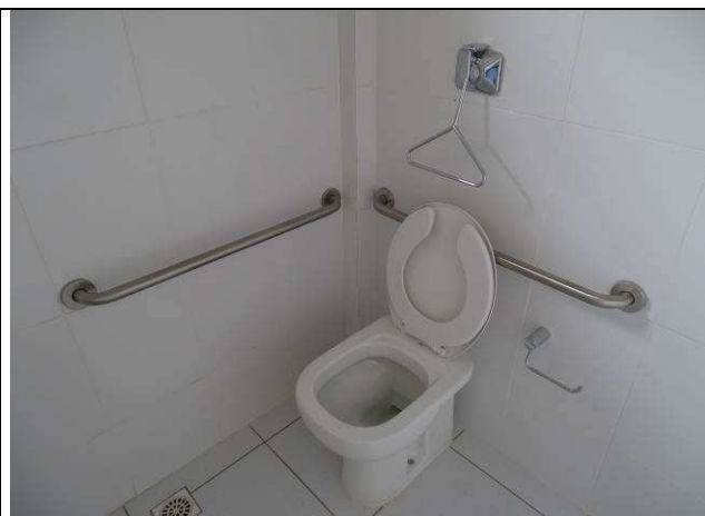
Figura 34C: Banheiro de secretaria PNE - Fórum.
