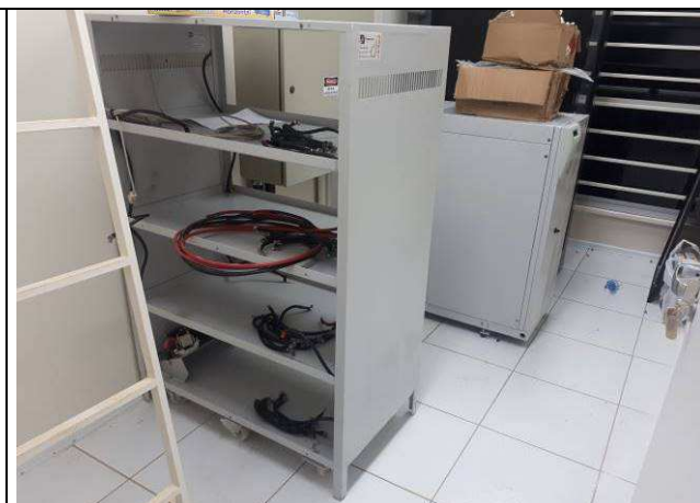
Figura 24E: Remanejamento Nobreak
