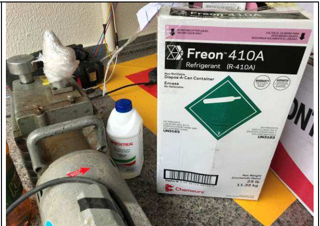
Figura 48C: Gás refrigerante utilizado na complementação das linhas.
