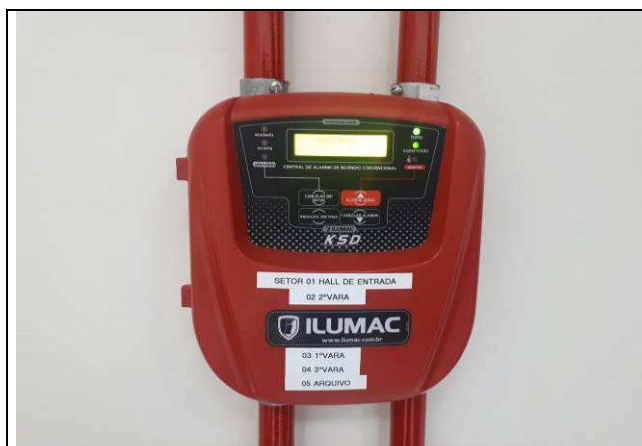
Figura 25E: Central de alarme de incêndios.
