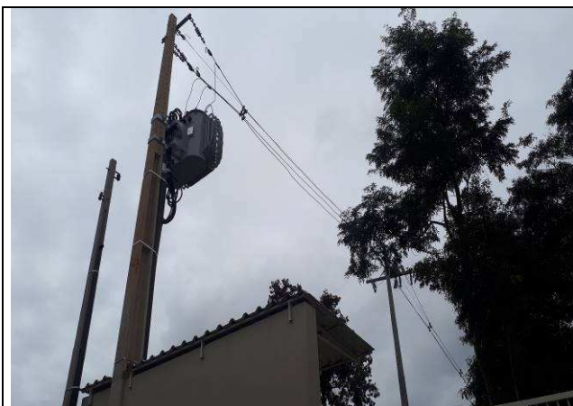
Figura 01E: Ligação definitiva de energia elétrica
