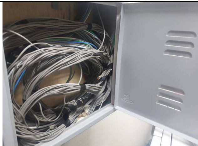
Figura 29E: Quadro alarme e cabeamento
