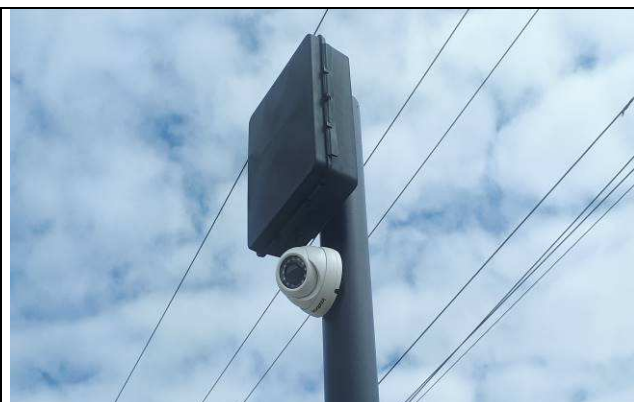
Figura 06E: tomada elétrica CFTV
