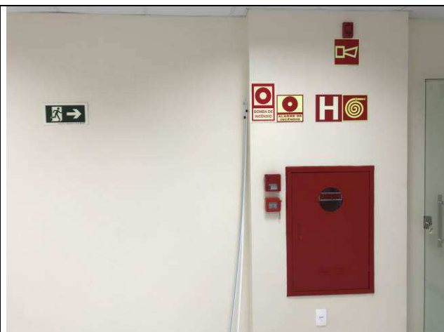
Figura 57C: Abrigo de Incêndio - 3ª Vara.
