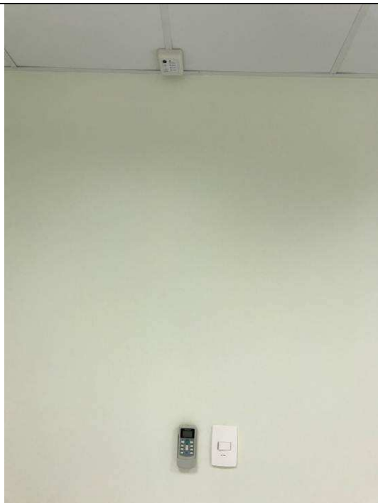
Figura 39C: Controle remoto e sensor instalados.
