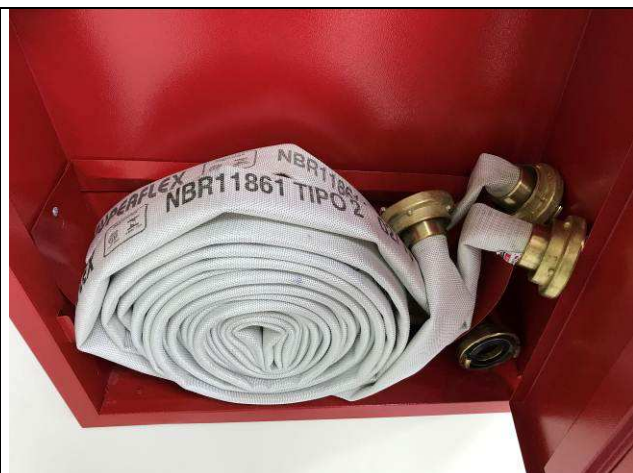
Figura 58C: Mangueiras no interior dos abrigos.
