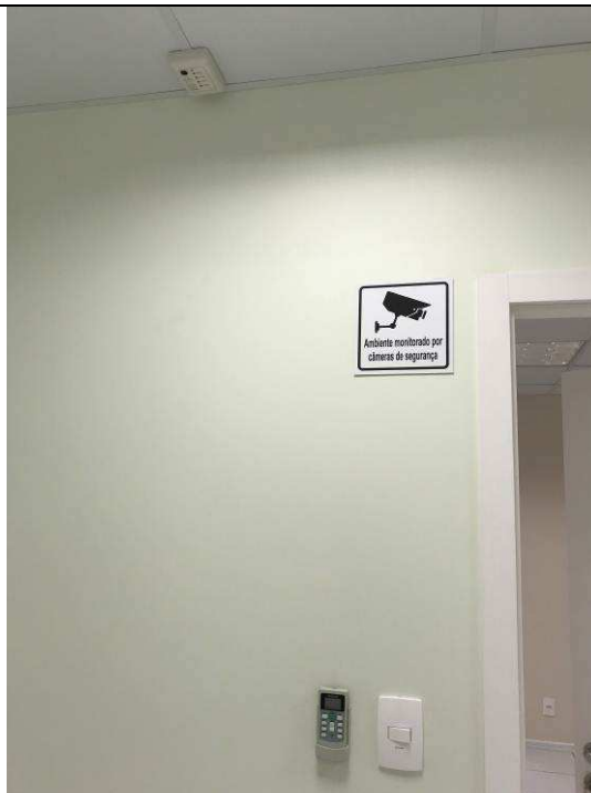
Figura 40C: Controle remoto e sensor instalados.
