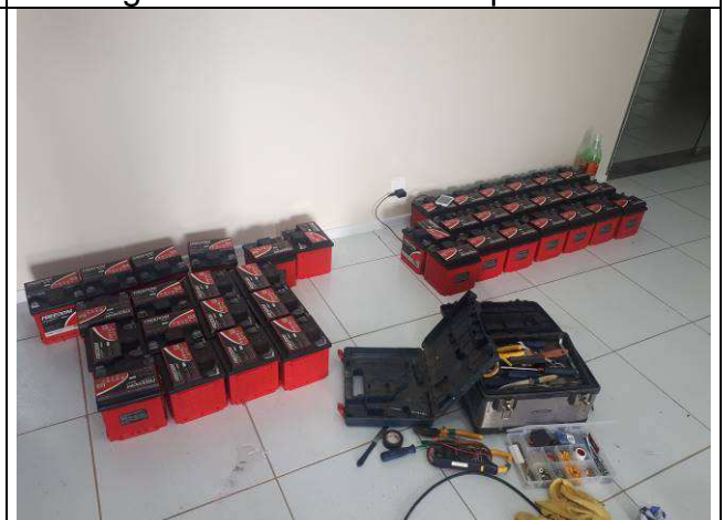
Figura 22E: Remanejamento Nobreak - baterias a serem substituídas
