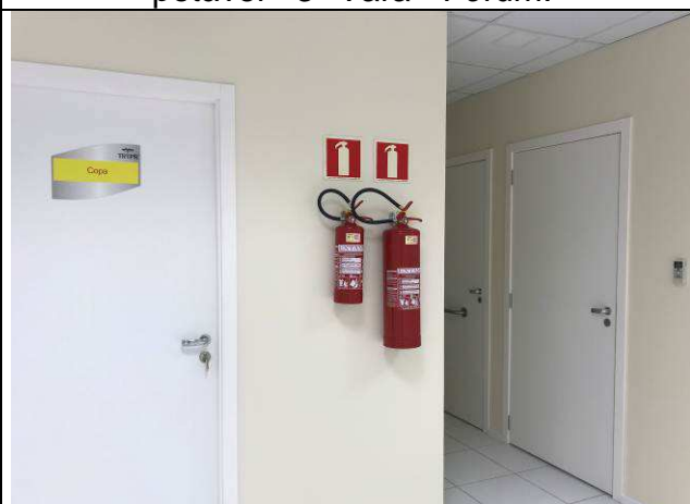
Figura 66C: Extintores de pó ABC e água potável - 2ª Vara - Fórum.
