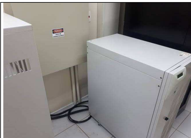
Figura 23E: Remanejamento Nobreak
