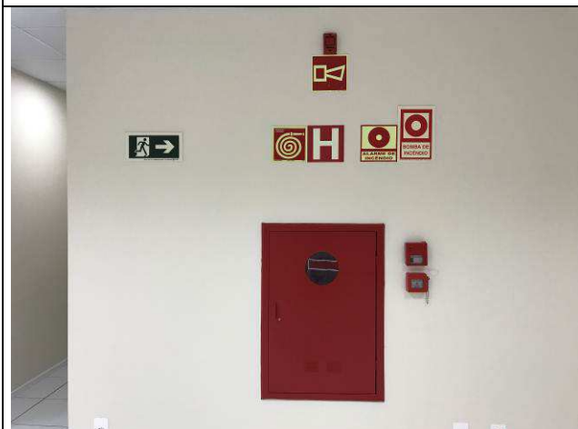
Figura 55C: Abrigo de Incêndio - 1ª Vara.
