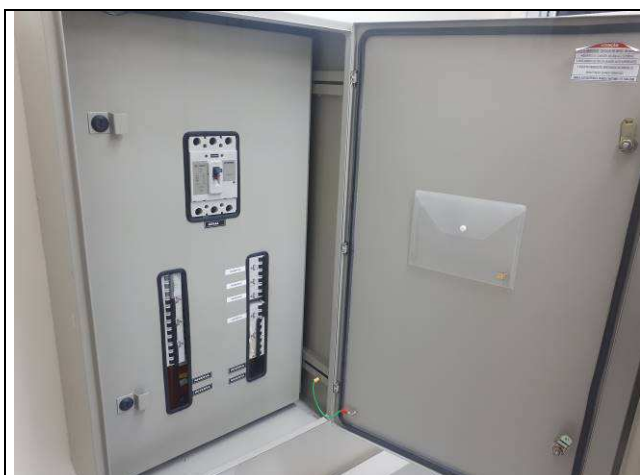
Figura 41E: Quadro QDACG2
