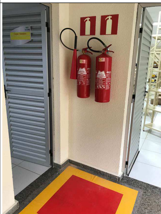
Figura 71C: Extintores de CO 2 e água potável - Hall - Arquivo.
