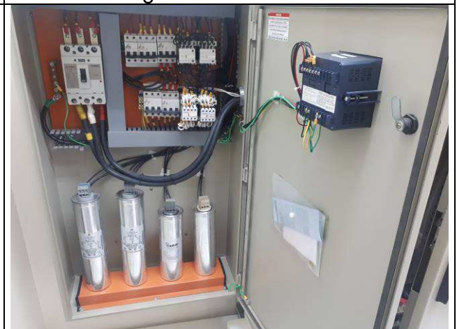
Figura 20E: Banco de Capacitores
