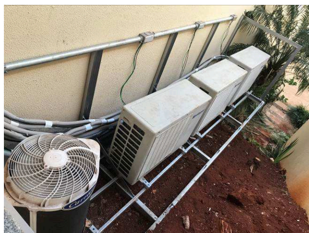
Figura 95C: Rede frigorígena nova e condensadoras - 2ª Vara.
