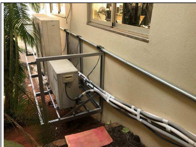
Figura 87C: Rede frigorígena nova e condensadoras - 1ª Vara.
