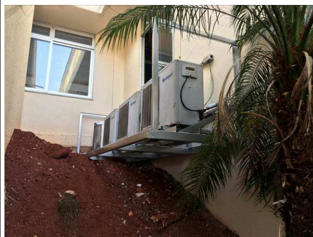
Figura 96C: Rede frigorígena nova e condensadoras - 2ª Vara.
