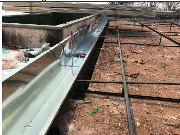
Figura 45C: Calha - 3ª Vara.
