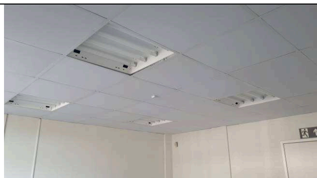
Figura 25E: luminárias 1ª VT - Lumaticenter 4 lâmpadas com aletas
