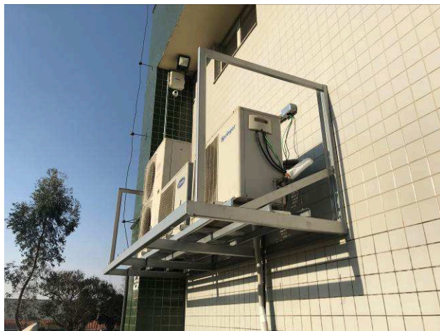
Figura 97C: Rede frigorígena nova e condensadoras - 2ª Vara.
