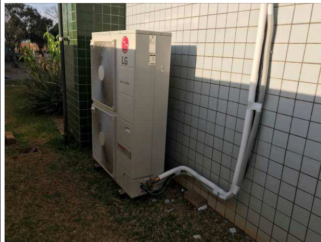
Figura 98C: Rede frigorígena nova e condensadoras - 2ª Vara.
