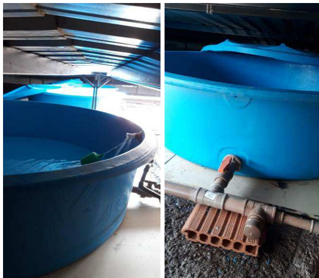
Figura 55C: Caixas de água - 3ª Vara.
