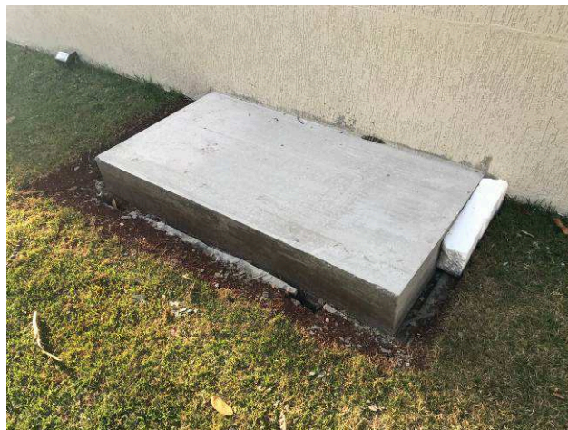
Figura 58C: Base do tanque aéreo de aproveitamento de águas pluviais.
