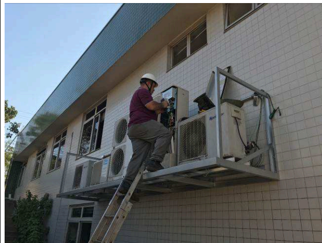
Figura 90C: Rede frigorígena nova e condensadoras - 1ª Vara.
