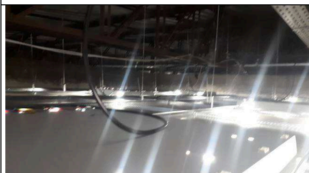
Figura 17E: infraestrutura e circuitos iluminação - alimentação luminárias.
