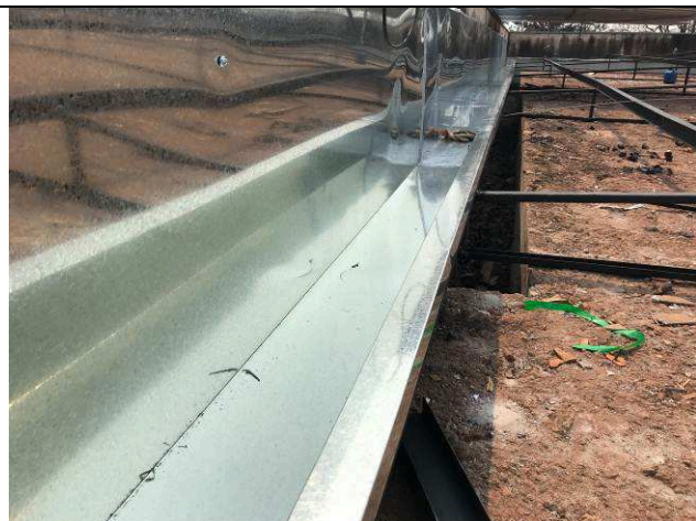
Figura 43C: Calha - 3ª Vara.
