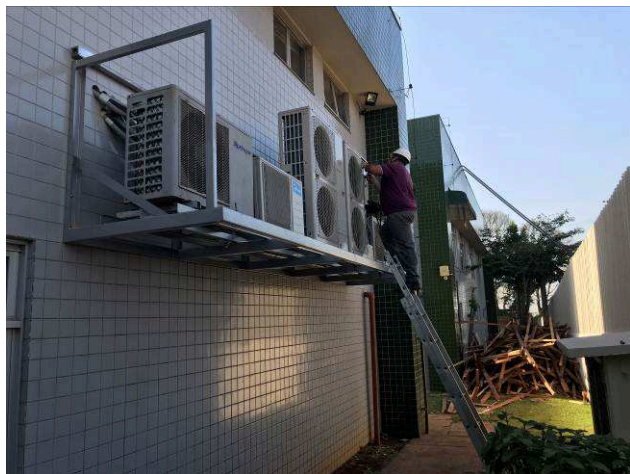
Figura 89C: Rede frigorígena nova e condensadoras - 1ª Vara.
