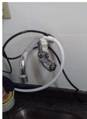
Figura 34C: Ponto de água fria, executado na copa
