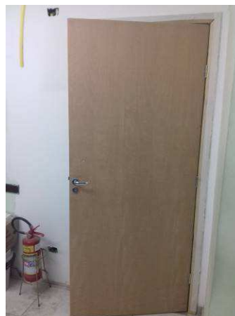
Figura 23C: Porta de madeira, na entrada do banheiro PNE do segundo pavimento
