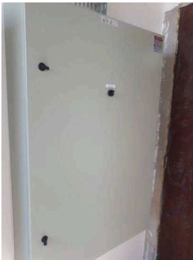
Figura 15E: Quadro QDG
