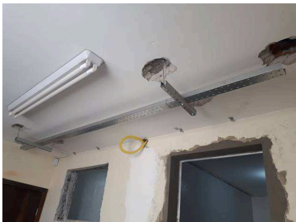
Figura 05E: Infraestrutura eletrocalhas
