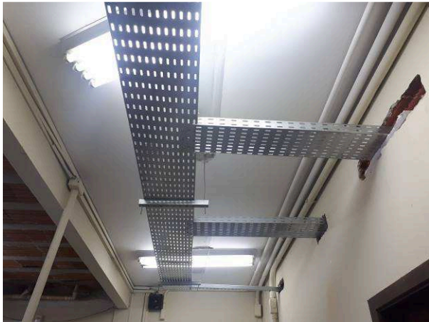
Figura 07E: Infraestrutura eletrocalhas
