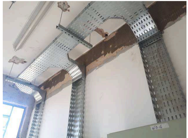
Figura 10E: Infraestrutura eletrocalhas
