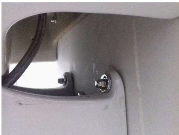
Figura 32C: Alimentação do lavatório com coluna suspensa, instalado no banheiro PNE do pavimento superior
