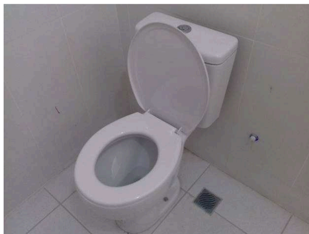
Figura 28C: Bacia sanitária, instalada no banheiro PNE do pavimento superior
