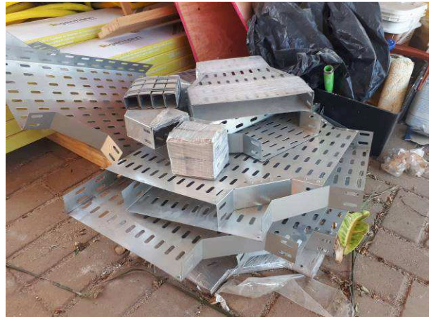
Figura 08E: Infraestrutura eletrocalhas
