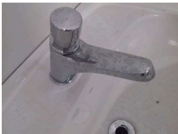
Figura 33C: Torneira de pressão com desligamento automático, instalada no banheiro PNE do pavimento superior
