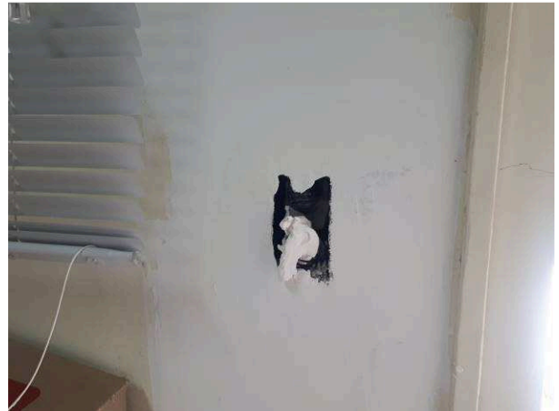
Figura 14E: Infraestrutura eletrodutos e caixas 2x4"
