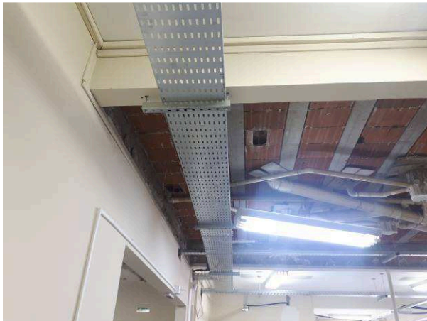
Figura 09E: Infraestrutura eletrocalhas
