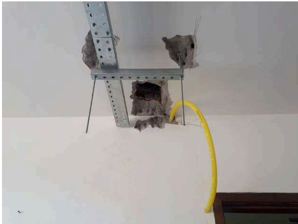
Figura 13E: Infraestrutura eletrodutos e caixas 2x4"
