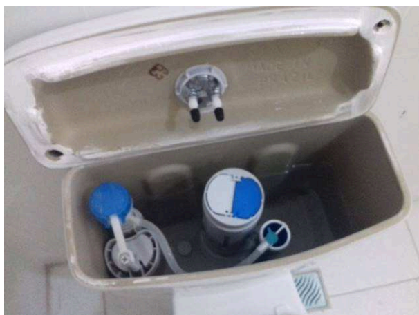
Figura 29C: Sistema de acionamento de bacia sanitária, instalada no banheiro PNE do pavimento superior
