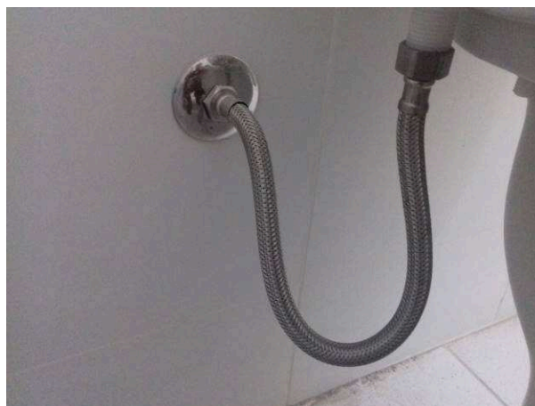
Figura 30C: Alimentação de bacia sanitária, instalada no banheiro PNE do pavimento superior
