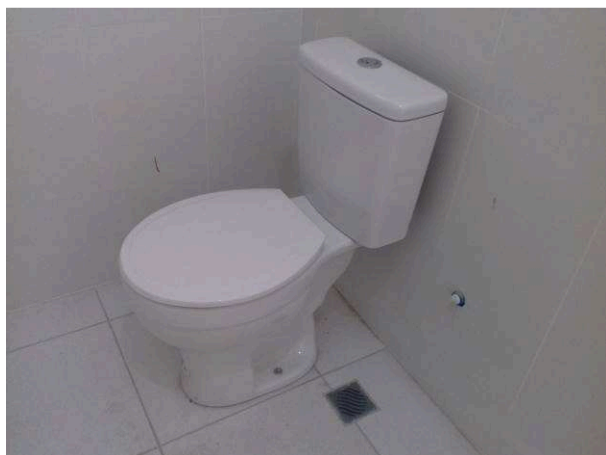
Figura 27C: Bacia sanitária, instalada no banheiro PNE do pavimento superior
