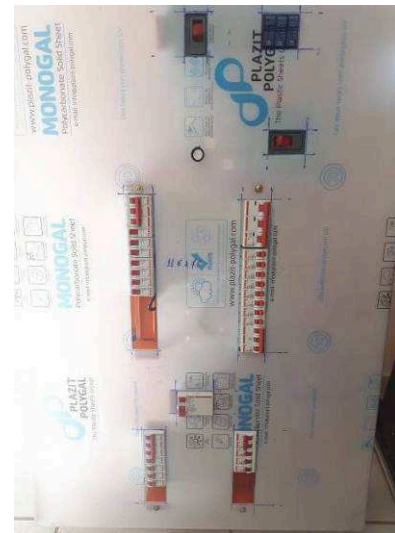
Figura 16E: Quadro QDG
