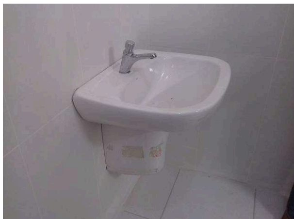
Figura 31C: Lavatório com coluna suspensa, instalado no banheiro PNE do pavimento superior
