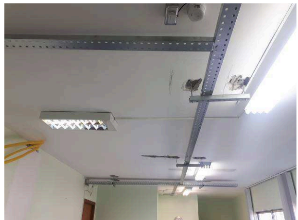
Figura 06E: Infraestrutura eletrocalhas
