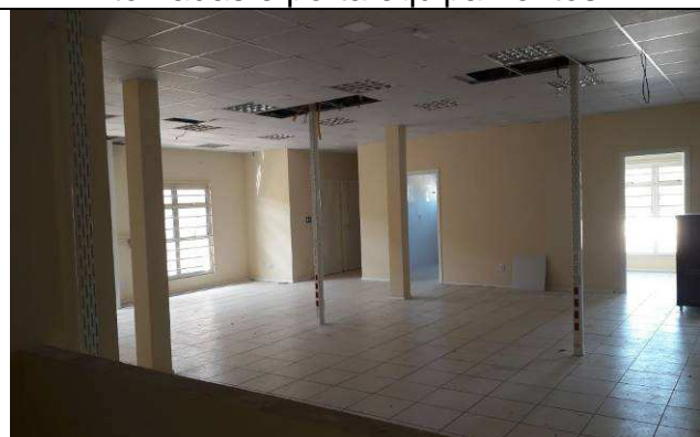
Figura 35E: colunas técnicas Dutotec, tomadas e porta equipamentos
