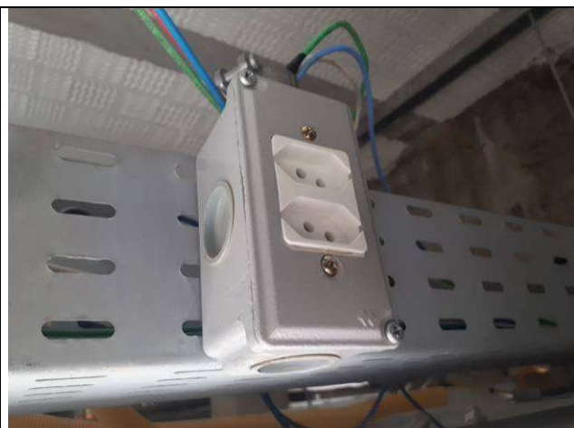
Figura 26E: tomadas elétricas condutores padrão genérico
