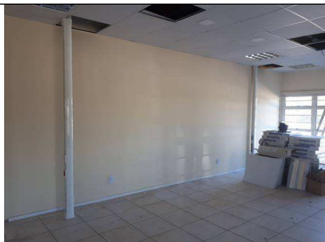
Figura 31E: colunas técnicas Dutotec, tomadas e porta equipamentos
