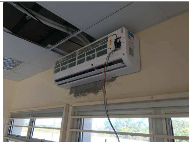
Figura 51C: Evaporadora 30.000 BTUs - distribuição / sala de oficiais.
