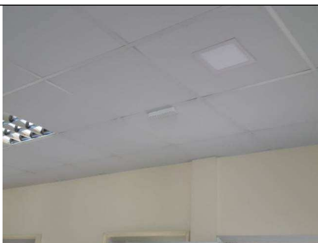
Figura 42E: blocos de emergência
