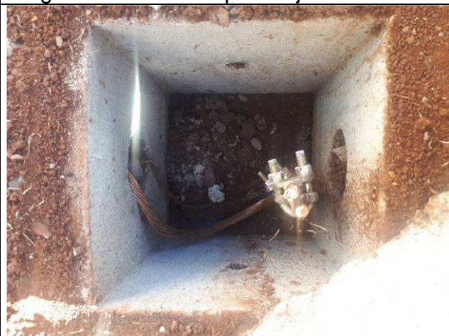
Figura 05E: aterramento entrada energia
