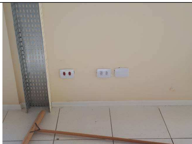
Figura 19E: interruptores e tomadas elétricas
