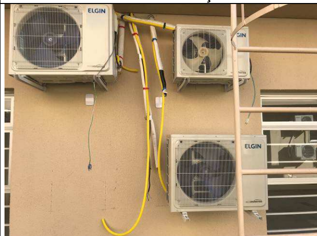
Figura 57C: Condensadora 30.000 BTUs - Sala de audiências 2 da 2ª VT.
