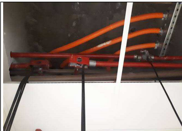
Figura 67E: infraestrutura e cabeamento SDAI
