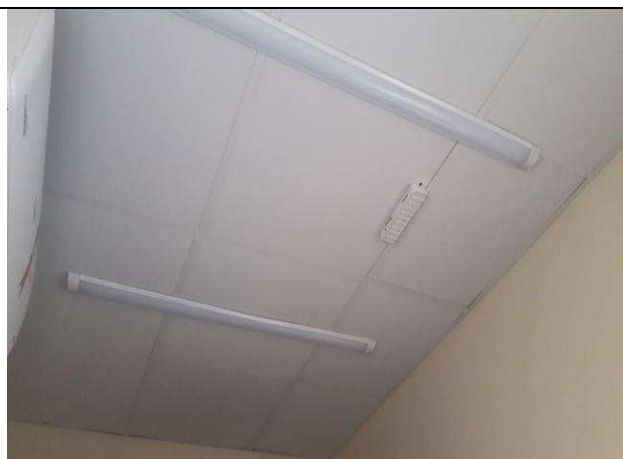
Figura 38E: luminárias sala técnica
