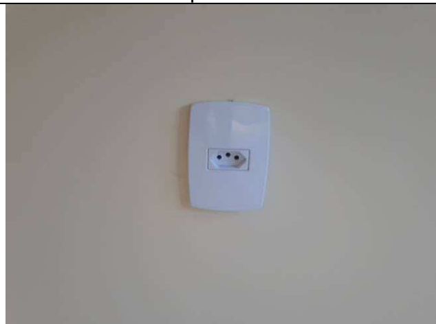
Figura 17E: interruptores e tomadas elétricas
