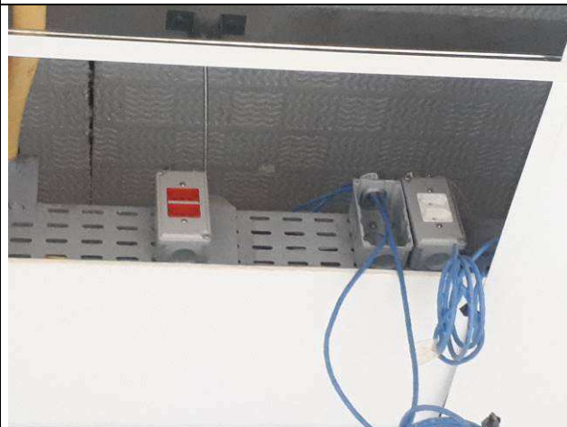
Figura 24E: tomadas elétricas condutores padrão genérico
