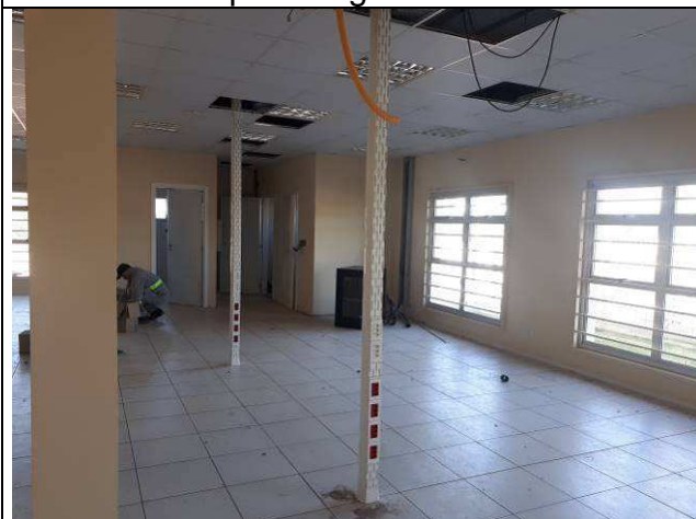
Figura 29E: colunas técnicas Dutotec, tomadas e porta equipamentos
