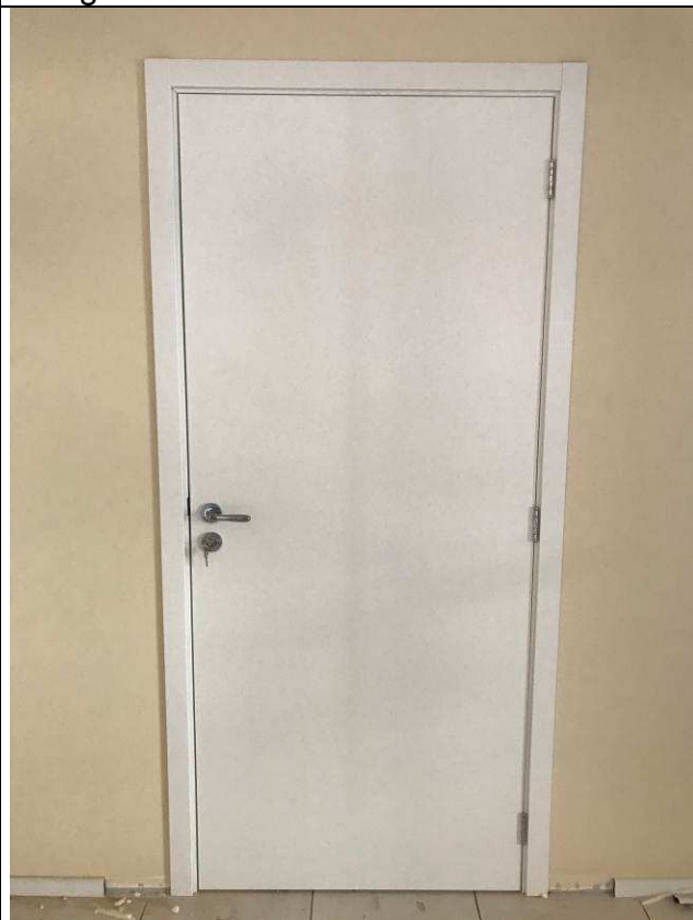
Figura 12C: Portas de madeira - sala técnica de informática.
