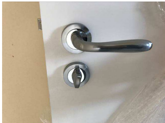
Figura 29C: Portas de madeira - Fechadura de banheiro.
