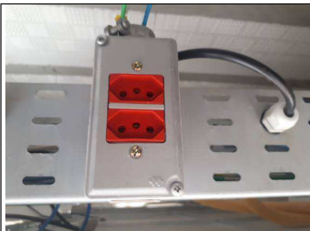
Figura 25E: tomadas elétricas condutores padrão genérico
