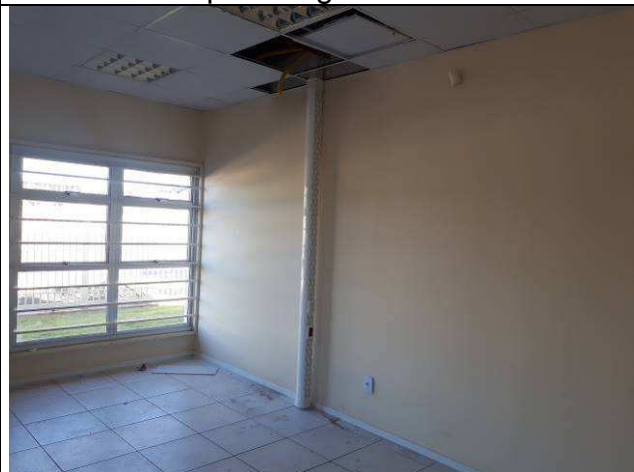
Figura 28E: colunas técnicas Dutotec, tomadas e porta equipamentos
