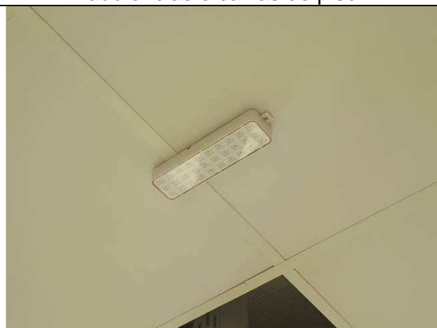
Figura 39E: blocos de emergência
