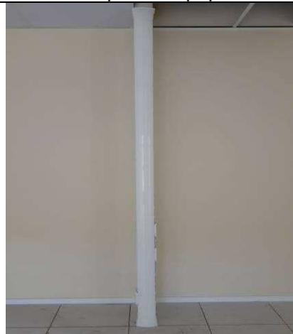
Figura 34E: colunas técnicas Dutotec, tomadas e porta equipamentos
