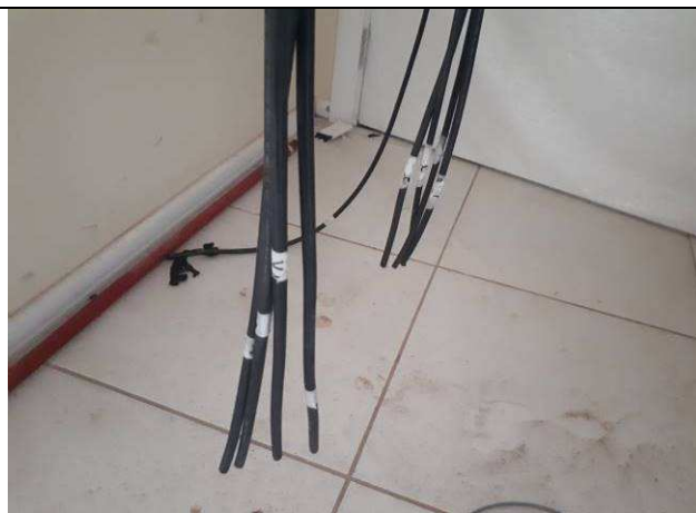
Figura 68E: infraestrutura e cabeamento SDAI
