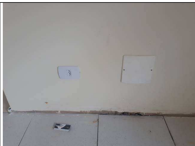
Figura 20E: interruptores e tomadas elétricas
