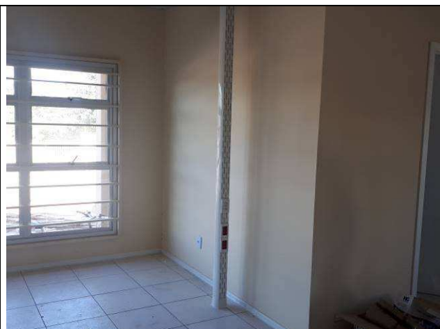
Figura 32E: colunas técnicas Dutotec, tomadas e porta equipamentos
