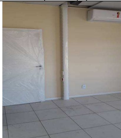
Figura 33E: colunas técnicas Dutotec, tomadas e porta equipamentos
