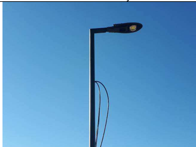
Figura 47E: postes de iluminação externa - estacionamento
