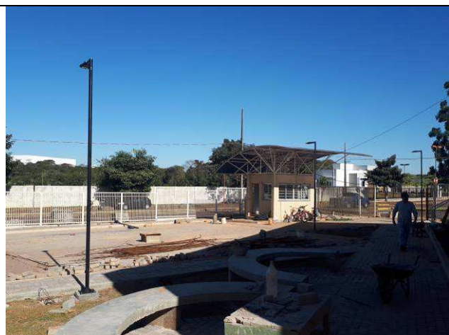
Figura 49E: postes de iluminação externa - estacionamento
