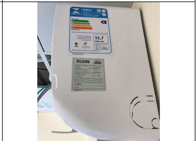
Figura 52C: Evaporadora 30.000 BTUs - distribuição / sala de oficiais.
