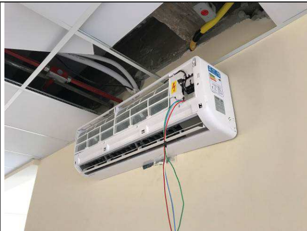
Figura 49C: Evaporadora 30.000 BTUs - área do PAB I.
