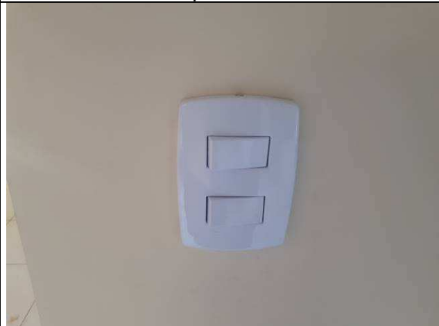
Figura 16E: interruptores e tomadas elétricas
