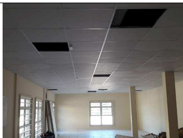
Figura 41E: blocos de emergência
