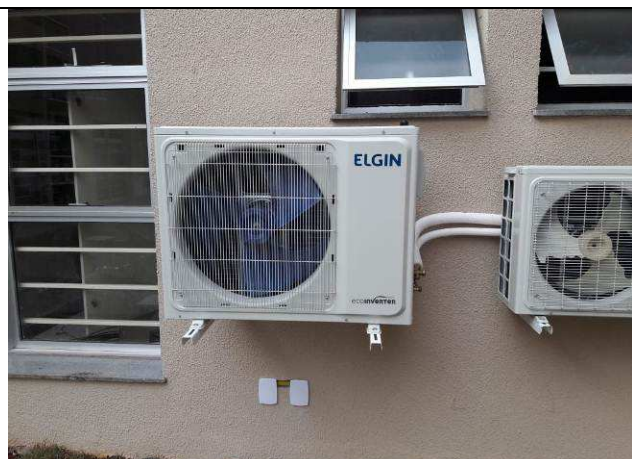
Figura 56C: Condensadora 30.000 BTUs - Sala de audiências 1 da 2ª VT.
