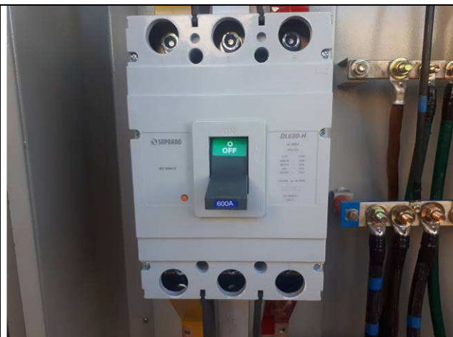
Figura 02E: disjuntor geral 600A
