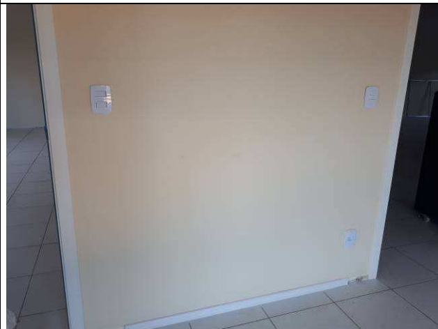
Figura 22E: interruptores e tomadas elétricas
