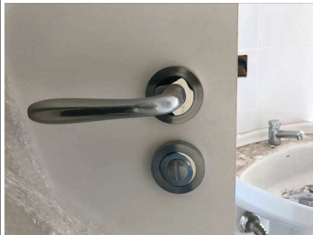
Figura 30C: Portas de madeira - Fechadura de banheiro.
