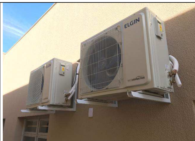
Figura 55C: Condensadoras 30.000 BTUs - PAB I e Distribuição.
