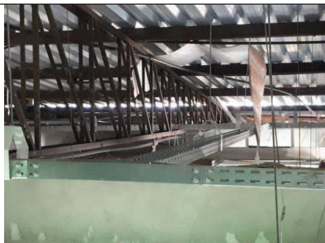
Figura 17E: Infraestrutura - eletrocalhas e perfilados para iluminação 2ª VT.
