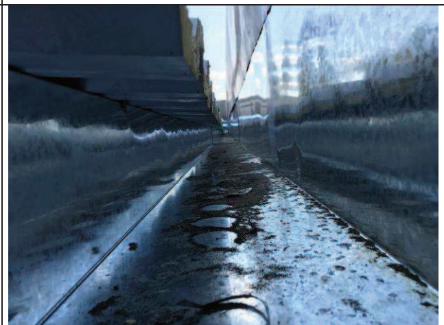
Figura 20C: Calha - 2ª Vara.
