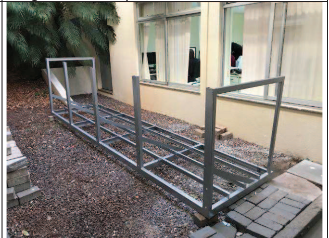
Figura 36C: Suportes de condensadoras.
