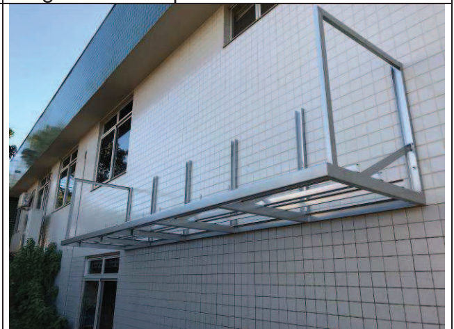
Figura 38C: Suportes de condensadoras.
