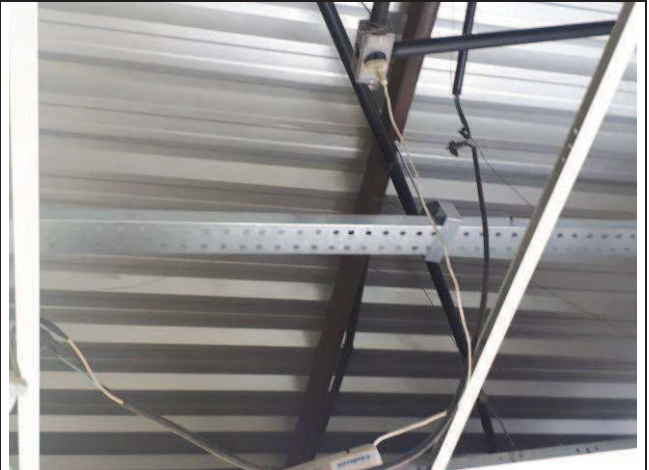
Figura 02E: Infraestrutura - perfilados para circuitos alimentadores aparelhos condicionadores de ar 2ª VT.
