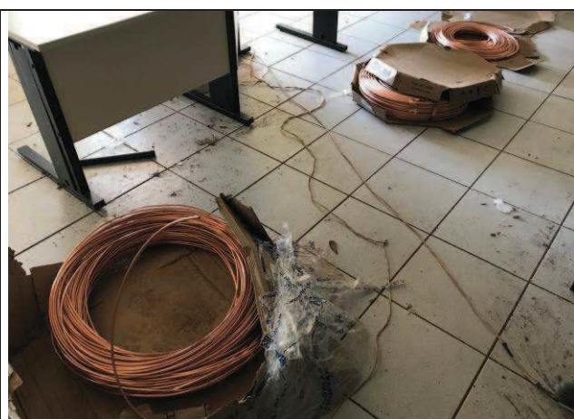
Figura 76C: Tubos de cobre - rede frigorígena.
