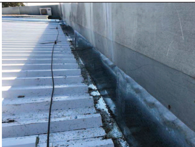
Figura 19C: Calha - 2ª Vara.
