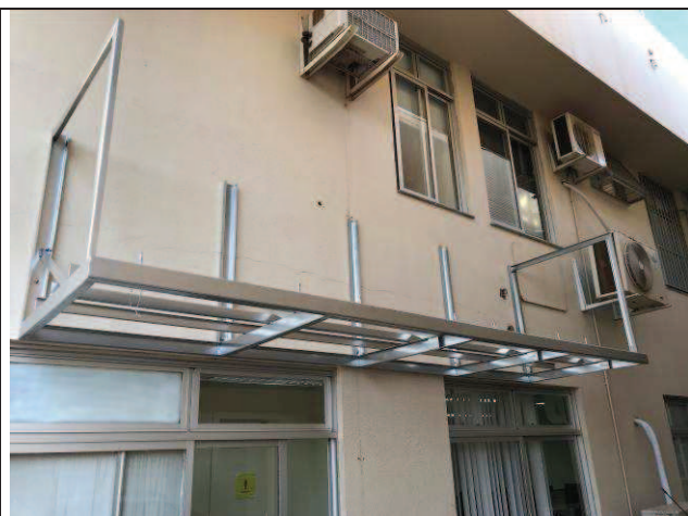
Figura 39C: Suportes de condensadoras.
