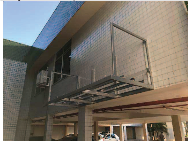
Figura 35C: Suportes de condensadoras.
