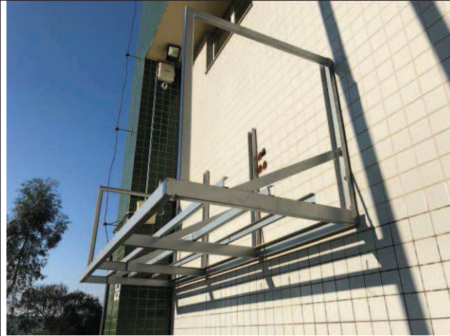
Figura 33C: Suportes de condensadoras.
