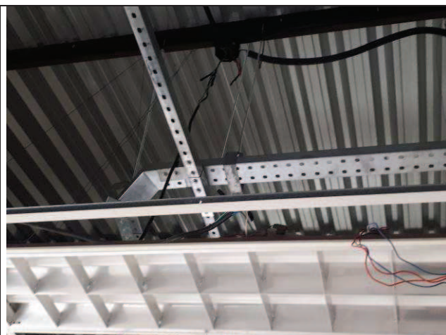
Figura 18E: Infraestrutura - eletrocalhas e perfilados para iluminação 2ª VT.
