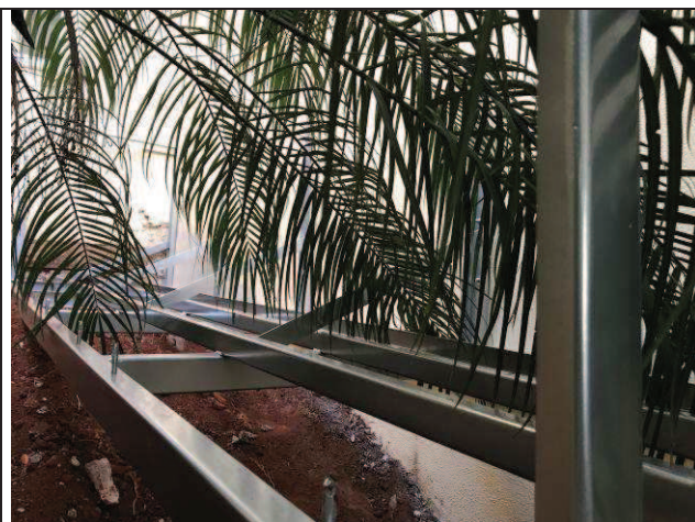
Figura 40C: Suportes de condensadoras.
