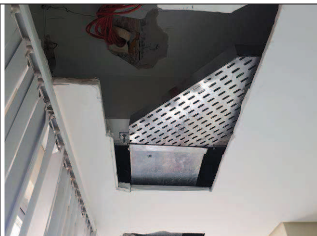
Figura 06E: Infraestrutura - eletrocalhas para ramais alimentadores QDE, QDAR1, QDAR2
