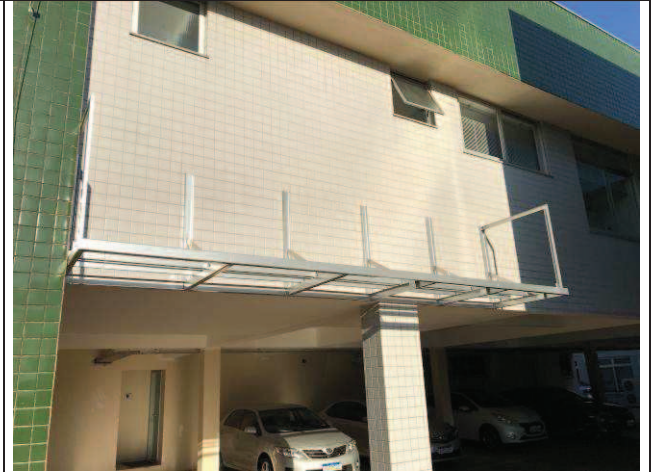
Figura 34C: Suportes de condensadoras.
