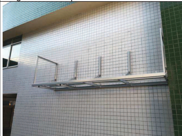
Figura 37C: Suportes de condensadoras.
