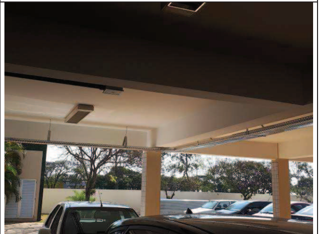
Figura 04E: Infraestrutura - eletrocalhas para ramais alimentadores QDE, QDAR1, QDAR2
