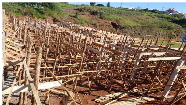
Figura 07C: Visão do início do escoramento de vigas e lajes – parte posterior da obra
