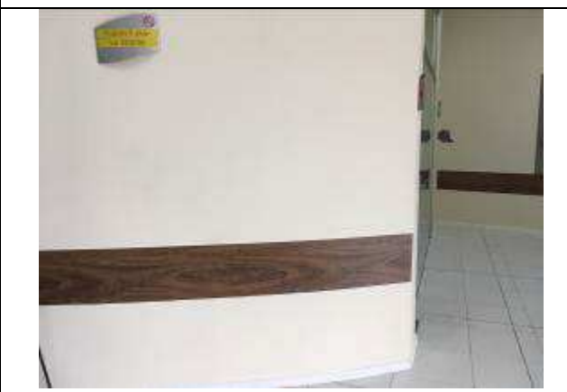
Figura 36C: protetores de parede - hall público.
