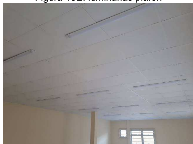
Figura 21E: luminárias padrão comercial
