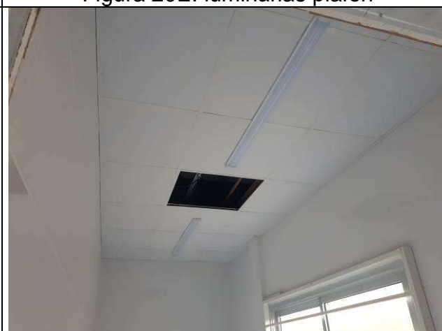
Figura 22E: luminárias padrão comercial
