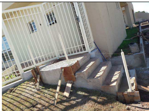
Figura 46C: Corrimãos - escada de acesso ao estacionamento frontal.
