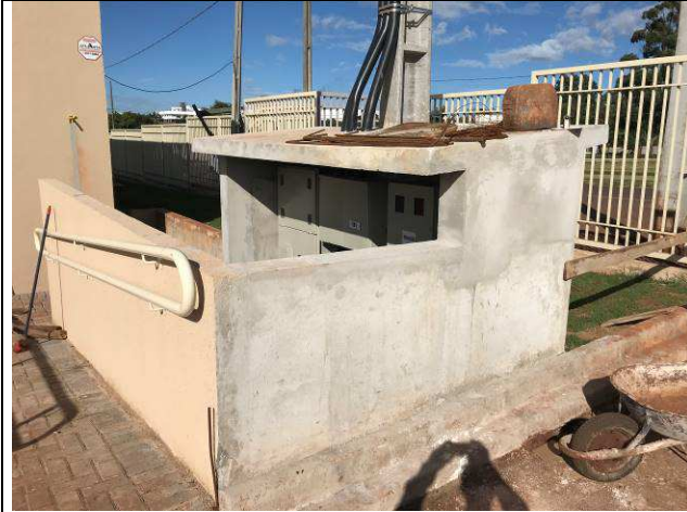
Figura 01E: Entrada de energia
