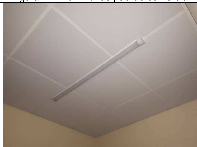
Figura 23E: luminárias padrão comercial
