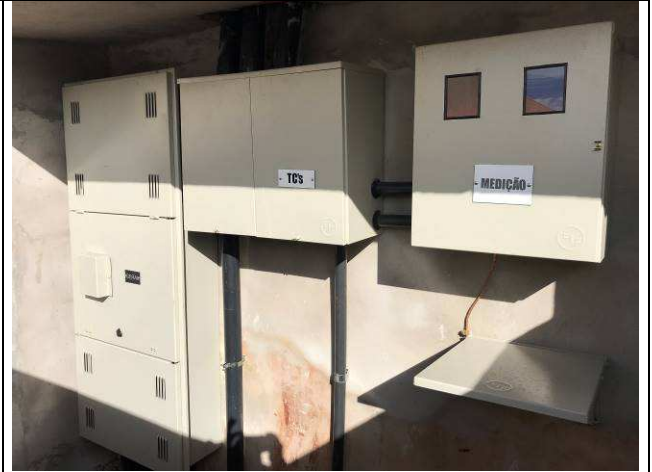
Figura 02E: Entrada de energia
