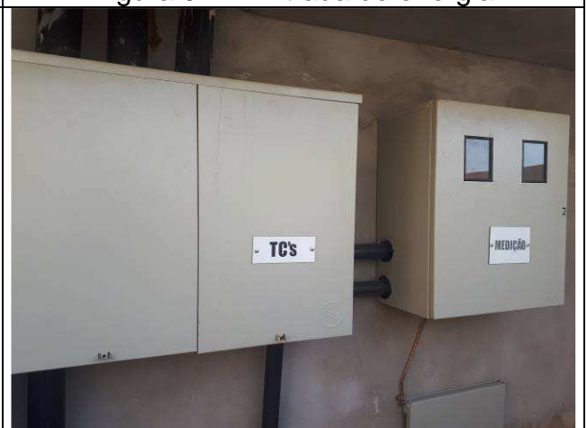
Figura 06E: Entrada de energia
