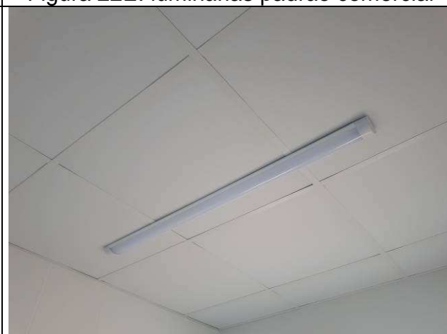
Figura 24E: luminárias padrão comercial
