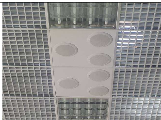
Figura 26E: caixas de som
