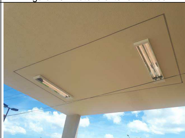
Figura 12E: luminárias Guarita
