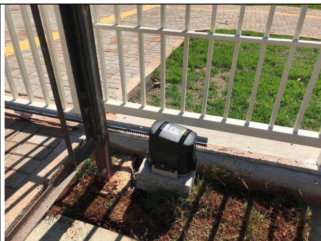
Figura 67C: Portão de pedestre automatizado.
