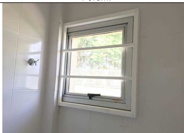
Figura 28C: Gradis de proteção das janelas - Fórum.
