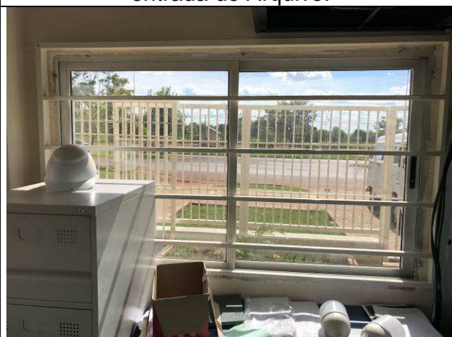
Figura 20C: Gradis de proteção das janelas - Guarita.
