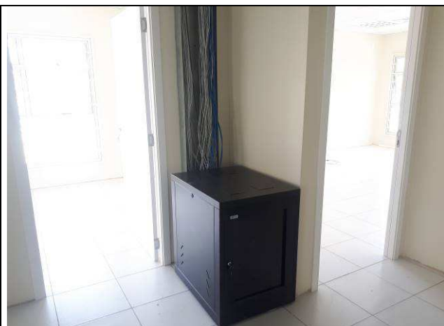
Figura 30E: organização - cabeamento Racks
