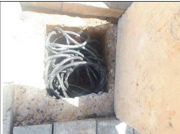
Figura 24E: cabos CFTV UTP cat6 externo
