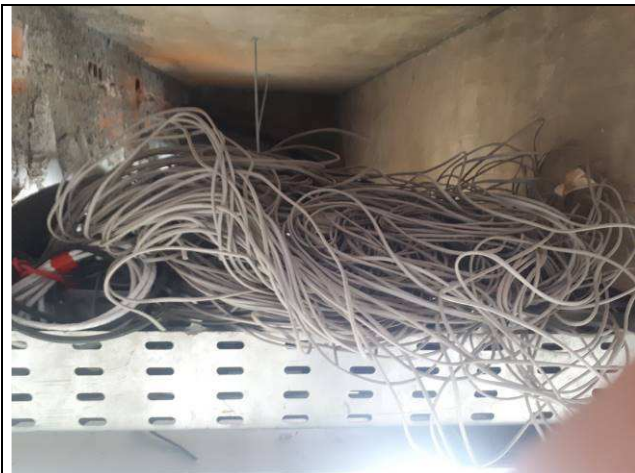
Figura 23E: cabos sistema de alarme patrimonial
