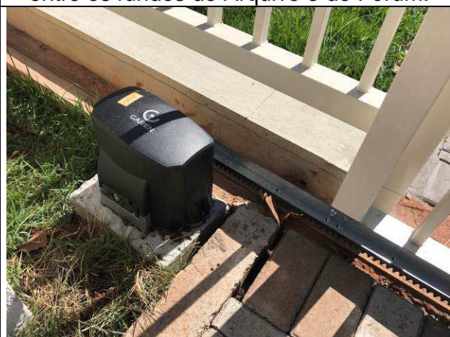
Figura 65C: Portão de pedestre automatizado.
