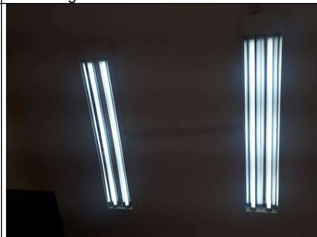
Figura 14E: luminárias Guarita
