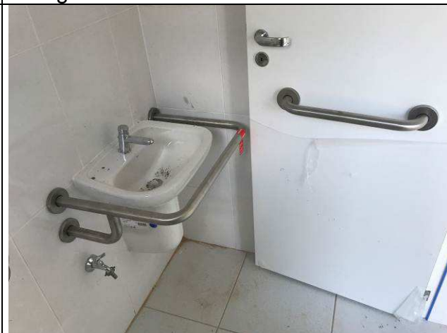
Figura 51C: Barras lavatório e portas - Fórum.
