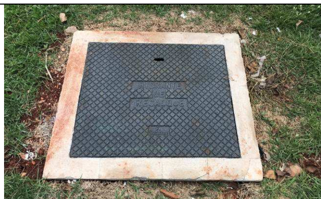
Figura 58C: Hidrante de recalque.
