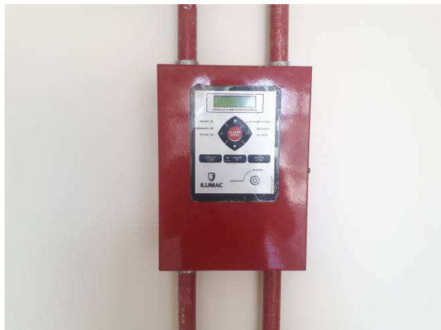
Figura 19E: Central de alarme de incêndios
