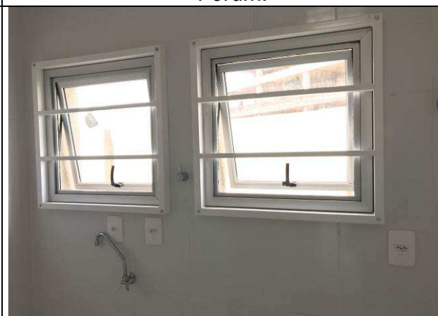
Figura 29C: Gradis de proteção das janelas - Fórum.
