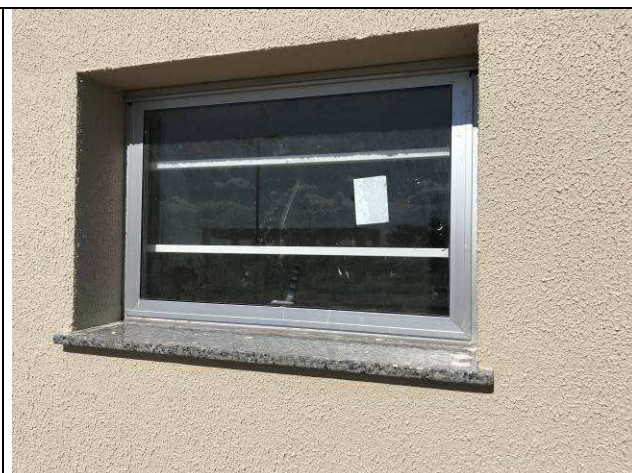
Figura 25C: Gradis de proteção das janelas - Arquivo.
