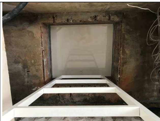
Figura 15C: Alçapão de acesso aos reservatórios de água.
