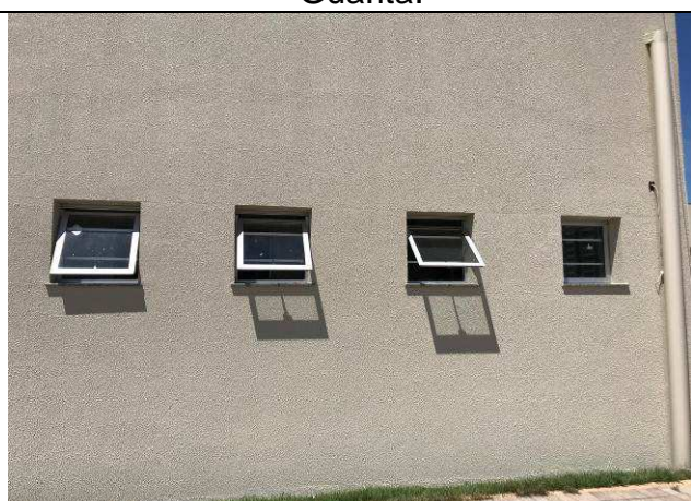
Figura 23C: Gradis de proteção das janelas - Arquivo.
