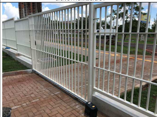
Figura 68C: Portão de veículos automatizado.
