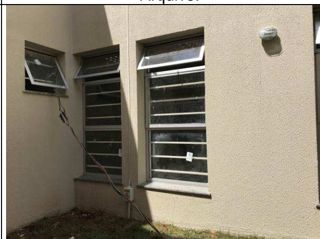
Figura 27C: Gradis de proteção das janelas - Fórum.
