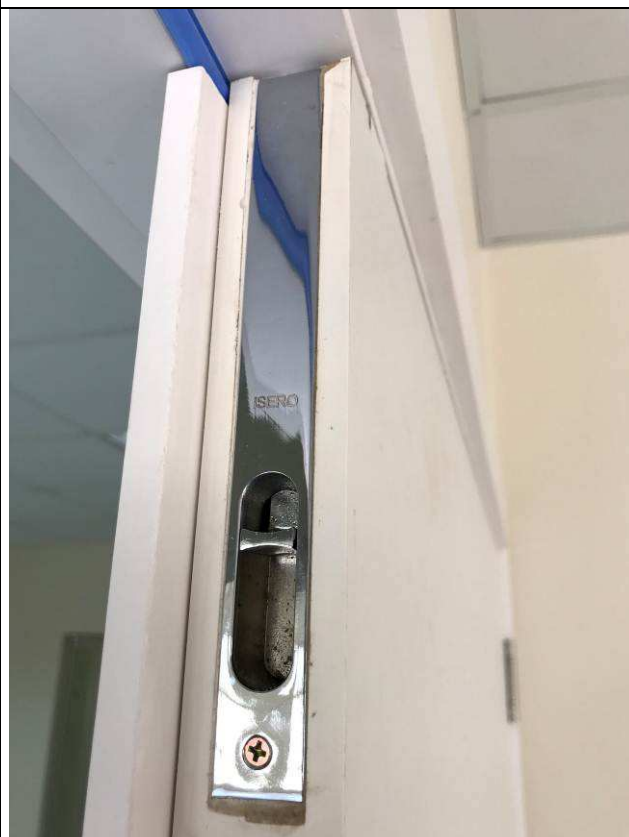
Figura 13C: Trinco embutido instalado na porta dupla da sala múltiplo uso - Fórum.
