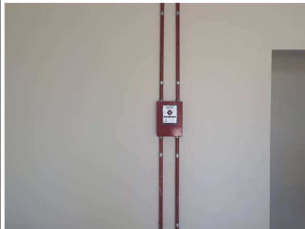
Figura 20E: Central de alarme de incêndios
