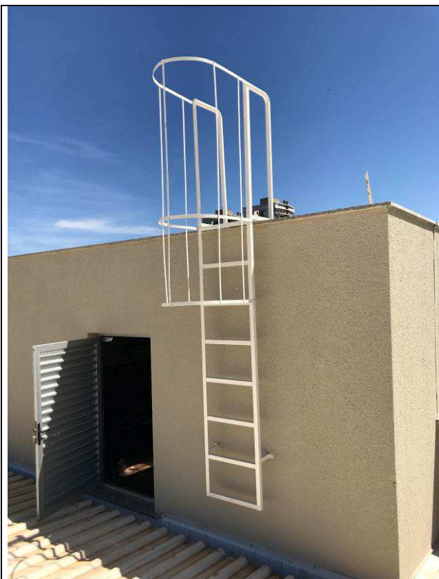
Figura 114C: Escada marinheiro - Fórum.
