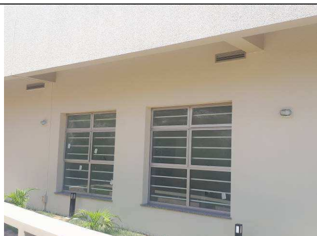
Figura 15E: luminárias tipo tartaruga
