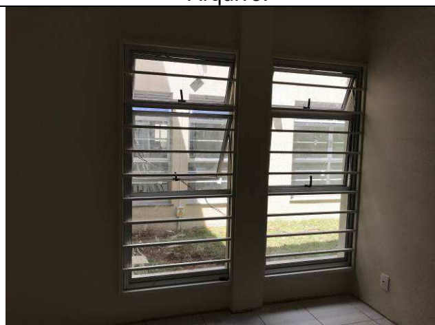
Figura 26C: Gradis de proteção das janelas - Fórum.
