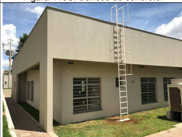
Figura 112C: Escada marinheiro - Fórum.
