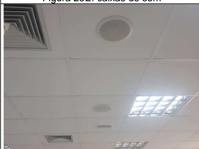
Figura 27E: caixas de som
