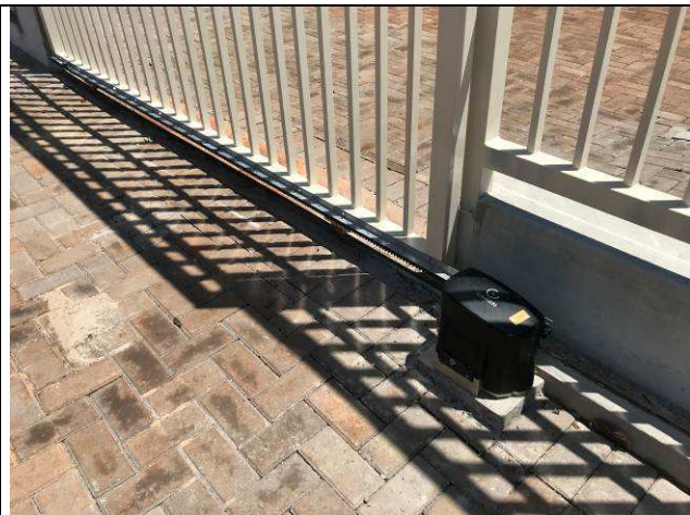
Figura 117C: Portões de veículos automatizados.
