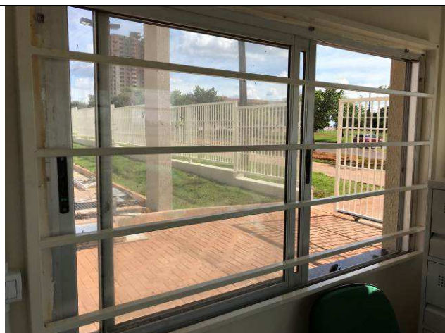
Figura 19C: Gradis de proteção das janelas - Guarita.
