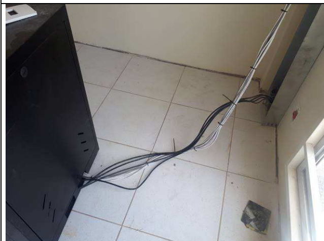
Figura 31E: organização - cabeamento Racks
