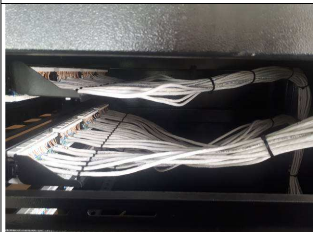
Figura 33E: organização - cabeamento e patch panels Racks
