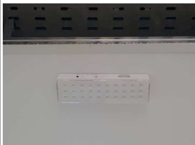
Figura 18E: blocos de emergência
