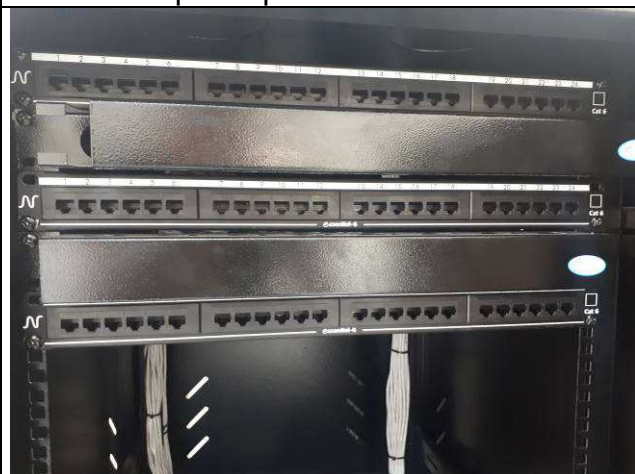
Figura 34E: organização - cabeamento e patch panels Racks
