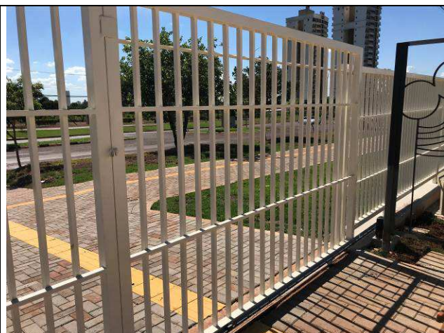
Figura 66C: Portão de pedestre automatizado.
