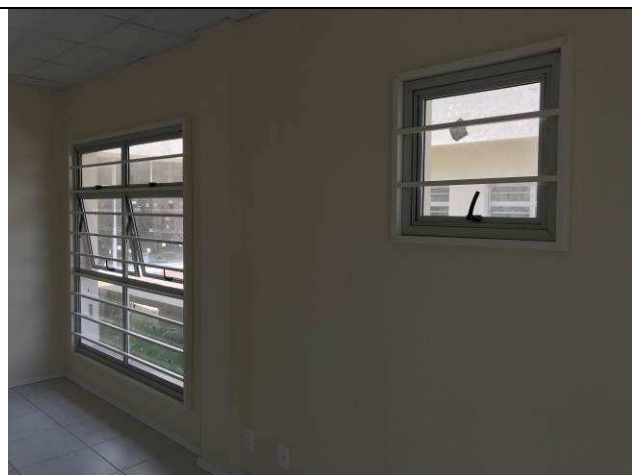
Figura 30C: Gradis de proteção das janelas - Fórum.
