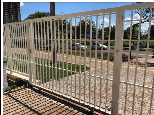
Figura 64C: Portão de pedestre automatizado.
