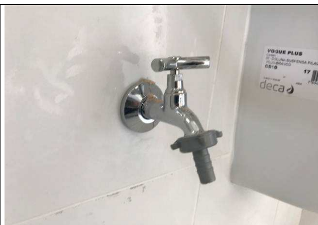
Figura 46C: Torneiras de limpeza - Fórum.
