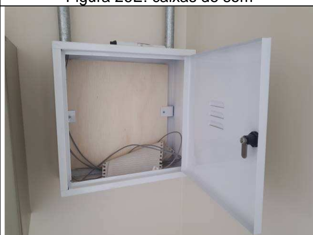
Figura 28E: quadro DG OAB
