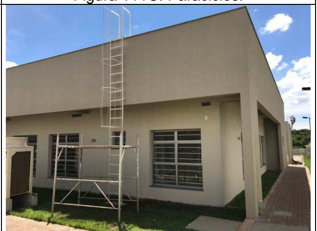
Figura 113C: Escada marinheiro - Fórum.
