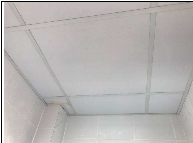
Figura 37C: Forro do banheiro da Guarita.
