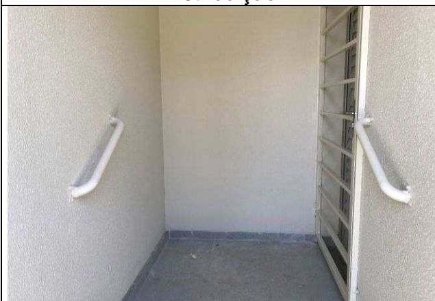
Figura 62C: Corrimão metálico - 3ª Vara.
