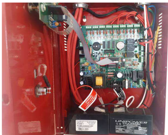
Figura 21E: Central de alarme de incêndios
