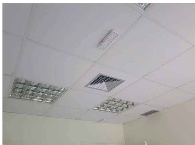
Figura 17E: blocos de emergência
