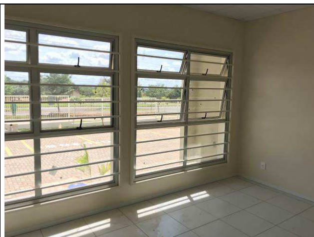
Figura 31C: Gradis de proteção das janelas - Fórum.
