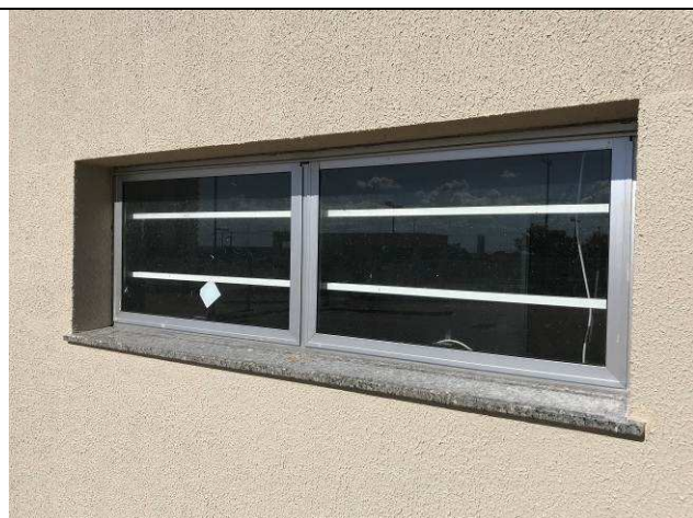
Figura 24C: Gradis de proteção das janelas - Arquivo.
