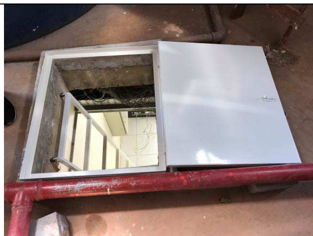
Figura 14C: Alçapão de acesso aos reservatórios de água.
