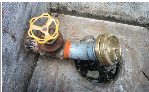
Figura 59C: Hidrante de recalque.
