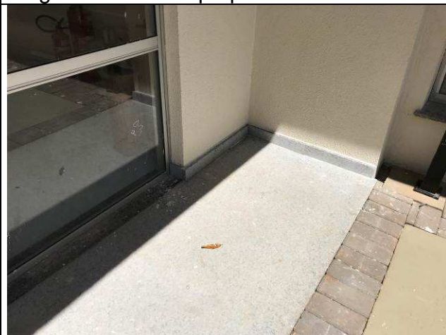
Figura 45C: Rodapé granito - Fórum.
