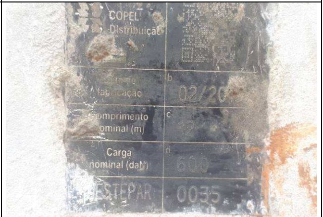
Figura 04E: entrada de energia e transformador
