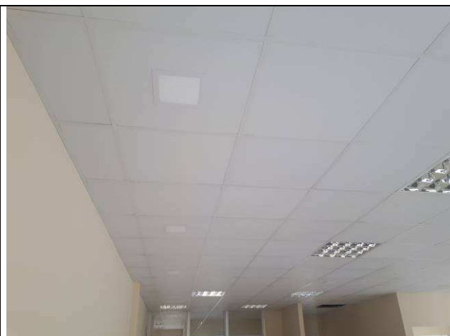
Figura 13E: iluminação interna - luminárias plafon LED
