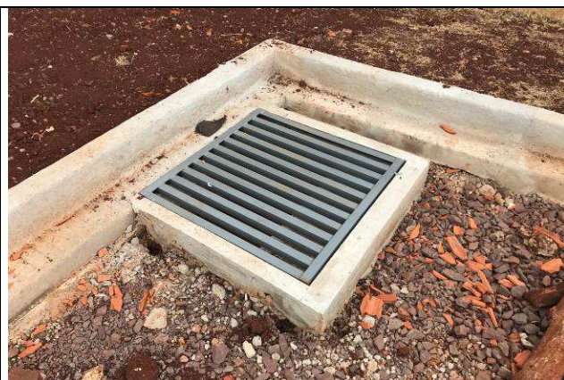
Figura 38C: Grelha de caixa de coleta/inspeção de águas pluviais.
