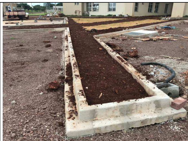
Figura 56C: Meios-fios em concreto - estacionamento frente.
