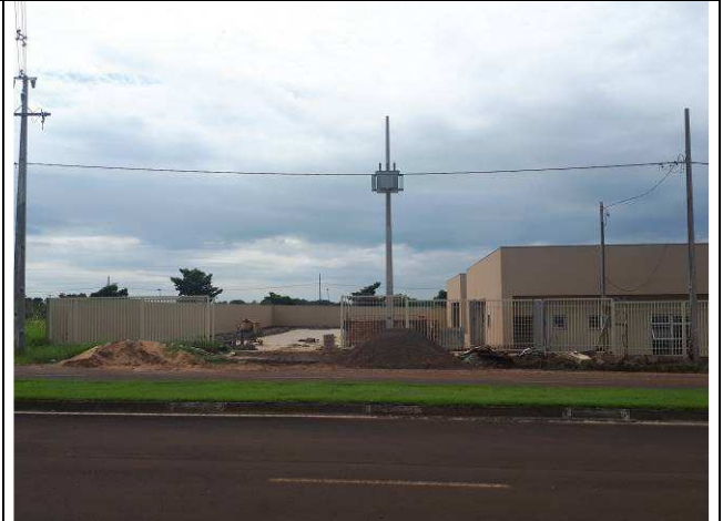
Figura 02E: entrada de energia e transformador
