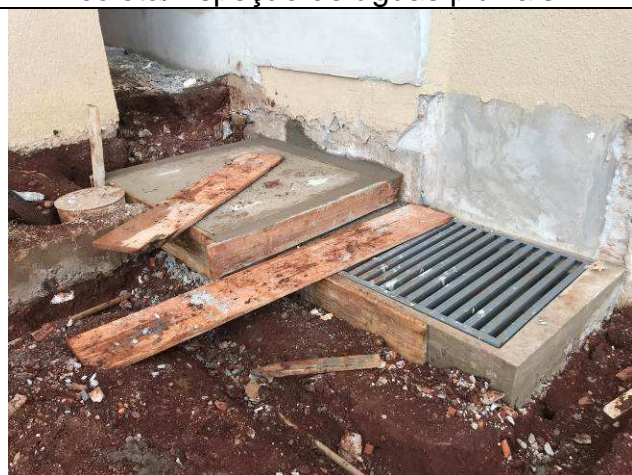
Figura 35C: Grelha de caixa de águas pluviais e tampa de caixa de esgoto.
