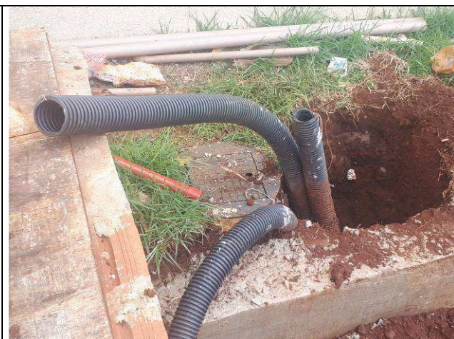
Figura 18E: tampa caixas de inspeção de aterramento
