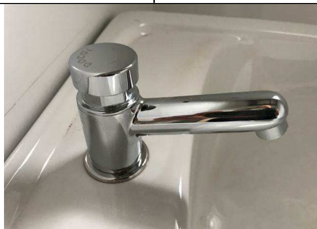
Figura 27C: Torneira de pressão com fechamento automático.
