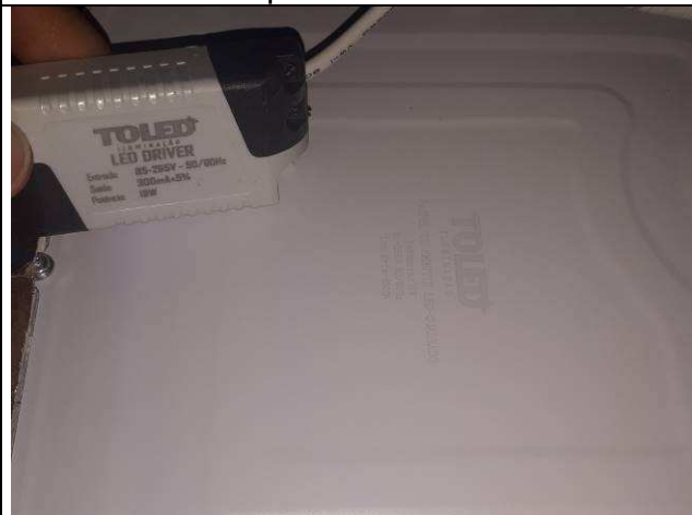
Figura 16E: iluminação interna - luminárias plafon LED
