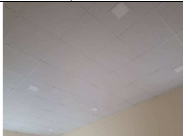
Figura 15E: iluminação interna - luminárias plafon LED
