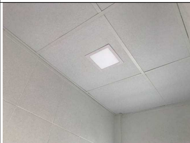
Figura 20C: Forro - Banheiro - 1ª Vara.
