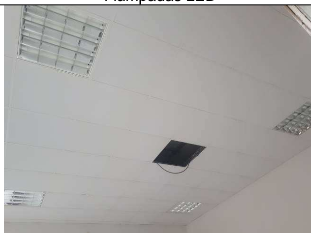
Figura 11E: iluminação interna - luminárias 4 lâmpadas LED
