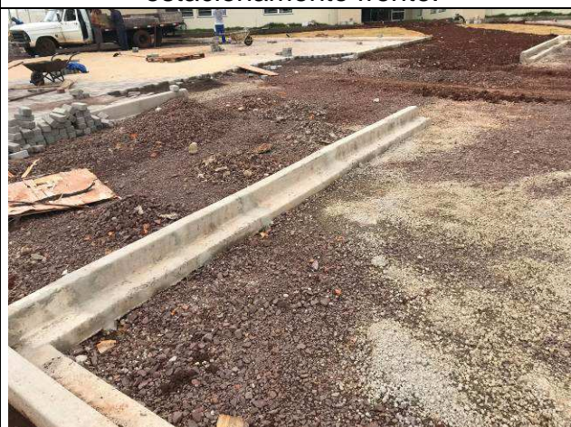
Figura 58C: Meios-fios em concreto - estacionamento frente.
