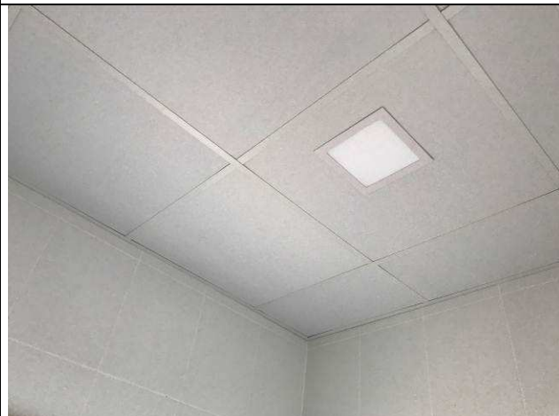
Figura 06C: Forro - Banheiro Secretaria - 2ª Vara.
