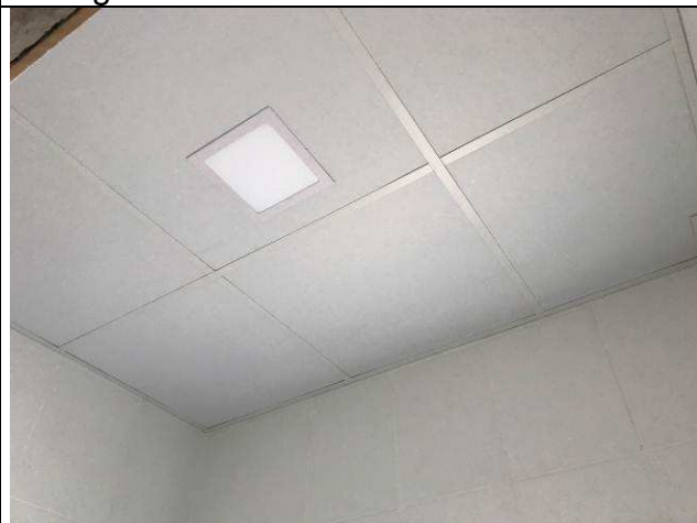
Figura 18C: Forro - Banheiro - 1ª Vara.
