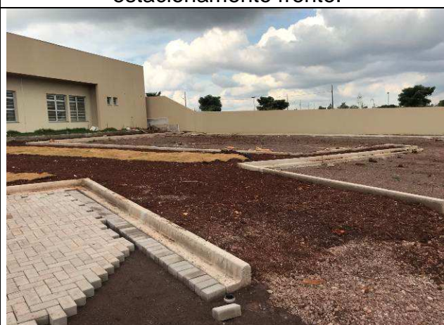
Figura 59C: Meios-fios em concreto - estacionamento frente.
