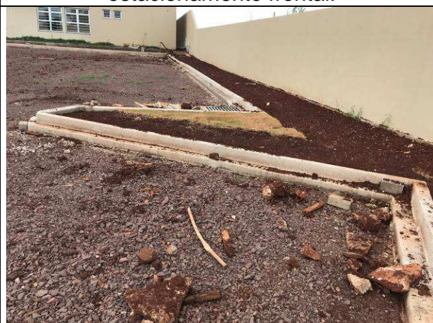
Figura 57C: Meios-fios em concreto - estacionamento frente.
