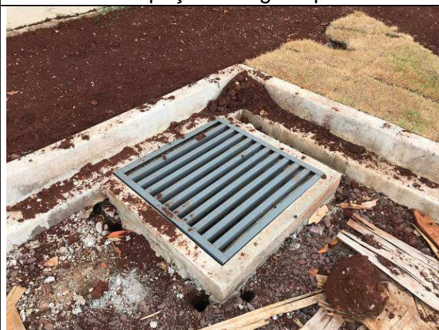
Figura 36C: Grelha de caixa de coleta/inspeção de águas pluviais.
