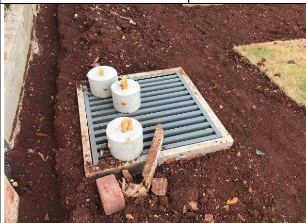
Figura 34C: Grelha de caixa de coleta/inspeção de águas pluviais.
