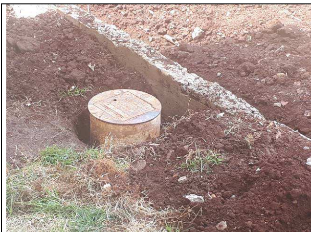
Figura 17E: tampa caixas de inspeção de aterramento
