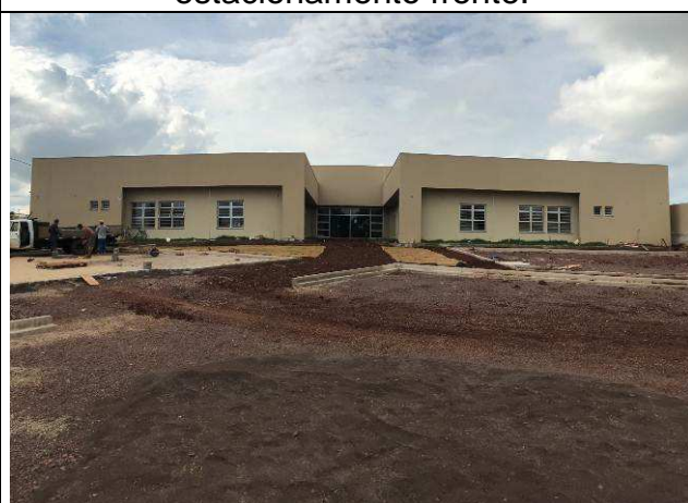
Figura 60C: Meios-fios em concreto - estacionamento frente.
