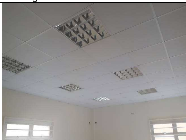
Figura 09E: iluminação interna - luminárias 4 lâmpadas LED
