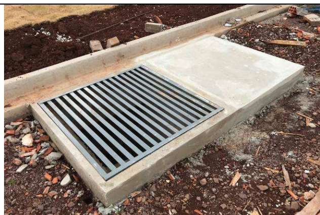
Figura 37C: Grelha de caixa de águas pluviais e tampa de caixa de esgoto.
