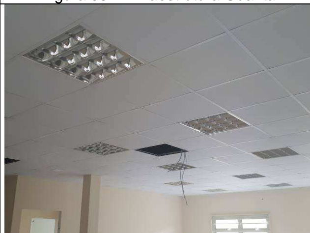
Figura 10E: iluminação interna - luminárias 4 lâmpadas LED
