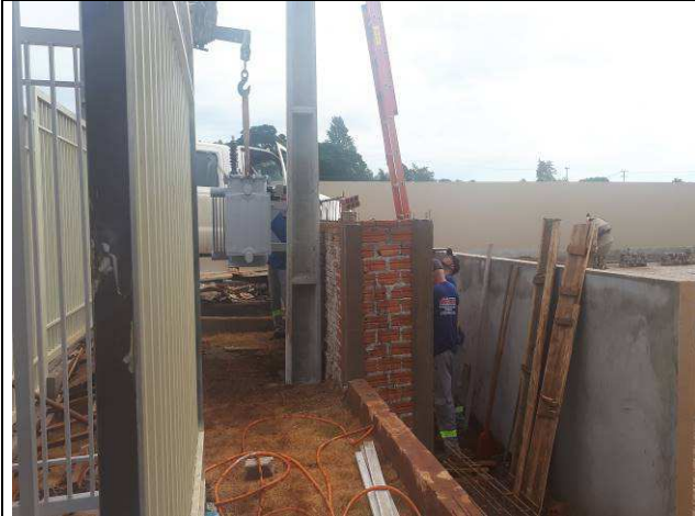
Figura 01E: entrada de energia e transformador
