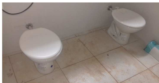
Figura 25C: Bacias sanitárias convencionais com assento, instaladas no sanitário público - Bloco da direita
