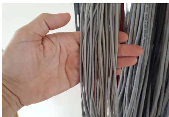
Figura 32E: cabeamento alarme patrimonial
