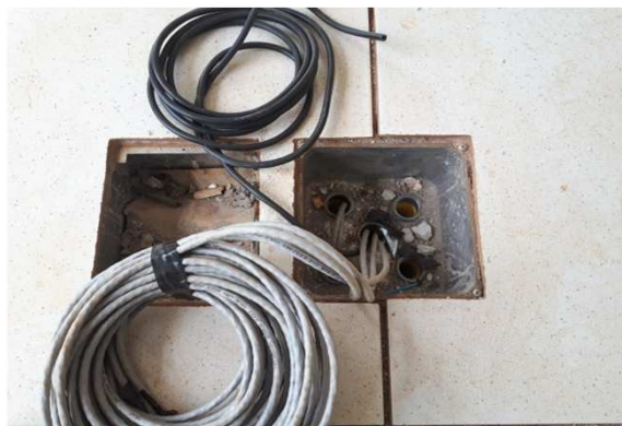
Figura 06E: caixas de passagem salas de audiências
