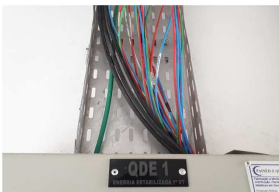
Figura 09E: cabeamento elétrico e alimentadores
