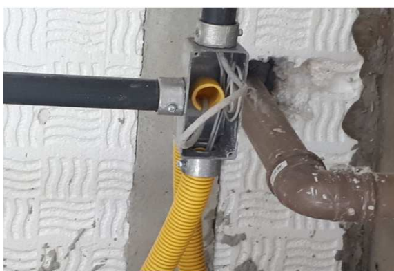
Figura 31E: cabeamento alarme patrimonial
