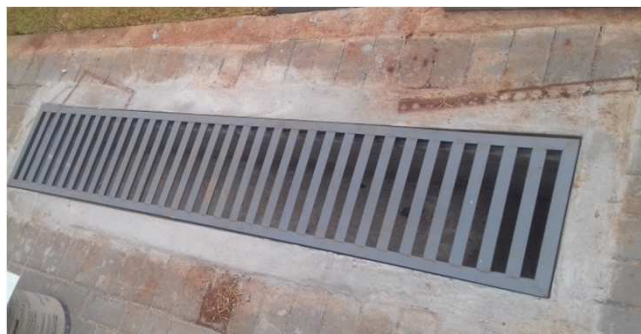
Figura 17C: Canaleta com grela, instalada no passeio entre estacionamento e porta lateral - bloco da direita
