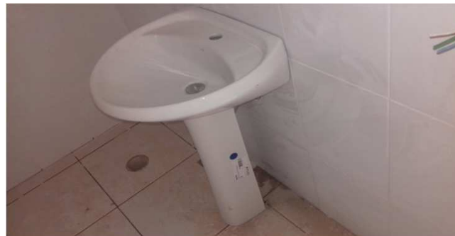
Figura 31C: Lavatório com coluna - Instalado no BWC do juiz auxiliar da 2ª Vara
