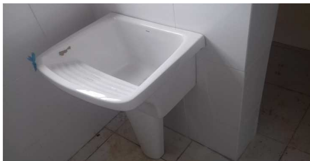
Figura 41C: Tanque de louça, instalado na área de serviço do bloco da esquerda
