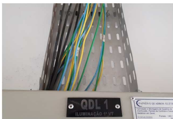
Figura 08E: cabeamento elétrico e alimentadores
