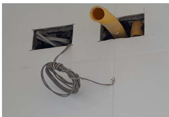
Figura 33E: cabeamento alarme patrimonial
