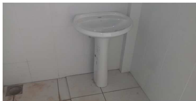
Figura 30C: Lavatório com coluna - Instalado no vestiário do bloco da direita
