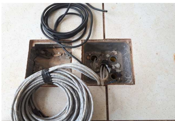
Figura 27E: cabeamento som, utp e caixas audiências
