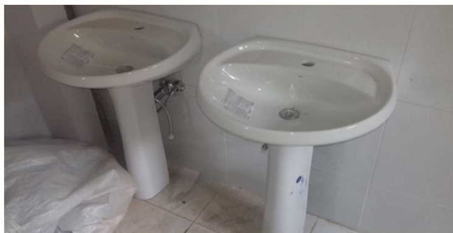
Figura 28C: Lavatórios com coluna - Instalados no BWC público - bloco da esquerda
