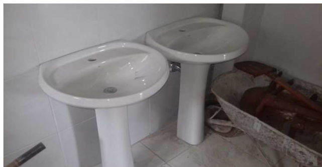
Figura 29C: Lavatórios com coluna - Instalados no BWC público - bloco da direita
