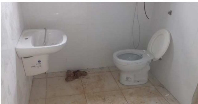
Figura 39C: Lavatório com coluna suspensa, instalado no BWC masculino da 1ª Vara
