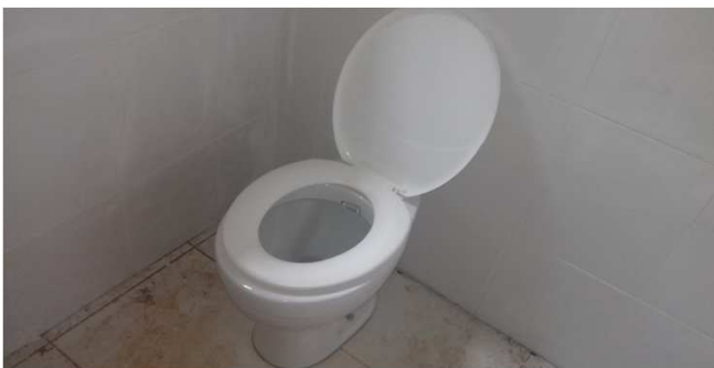
Figura 20C: Bacia sanitária PNE com assento - Sanitário Feminino da 1ª Vara
