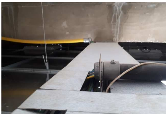
Figura 01E: eletrocalhas tampadas
