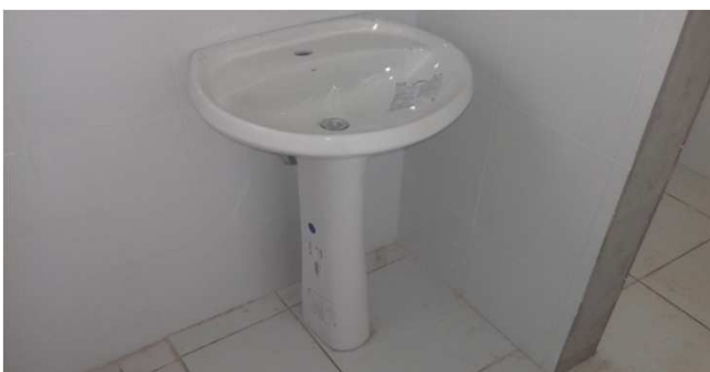
Figura 27C: Lavatório com coluna - Instalado no BWC do juiz auxiliar da 1ª Vara
