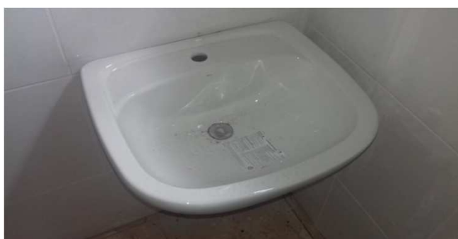
Figura 36C: Lavatório com coluna suspensa, instalado em BWC público PNE - bloco da esquerda
