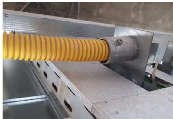
Figura 02E: eletrocalhas tampadas
