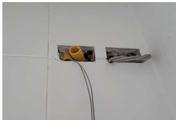
Figura 30E: cabeamento alarme patrimonial
