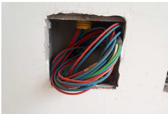
Figura 05E: caixas de passagem salas de audiências
