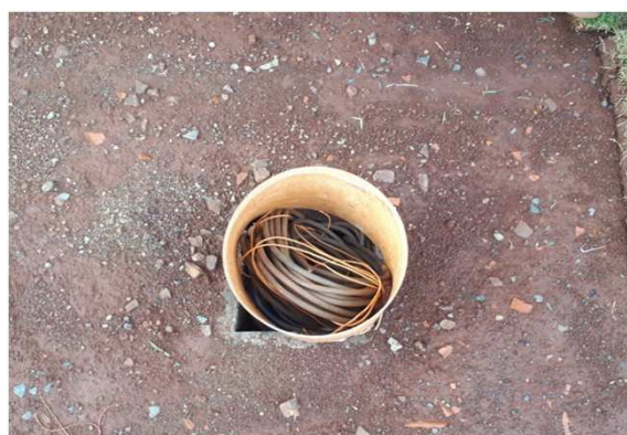
Figura 16E: cabearmento alimentador casa de máquinas
