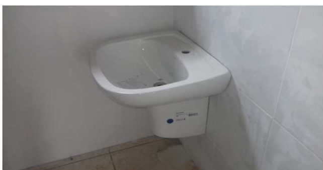
Figura 37C: Lavatório com coluna suspensa, instalado em BWC público PNE - bloco da direita
