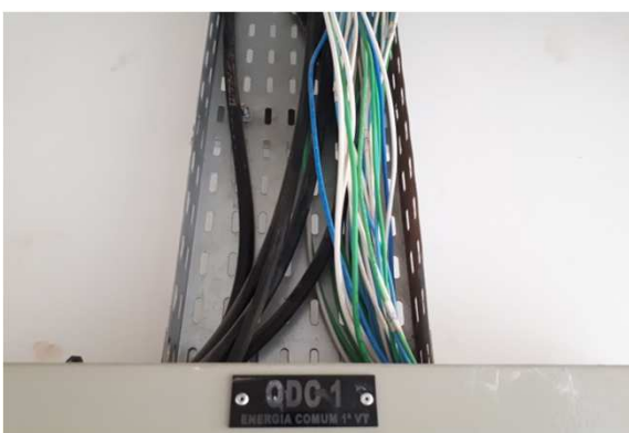
Figura 07E: cabeamento elétrico e alimentadores
