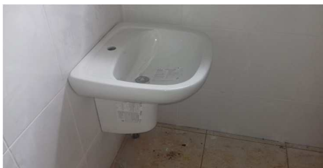
Figura 38C: Lavatório com coluna suspensa, instalado no BWC masculino da 2ª Vara
