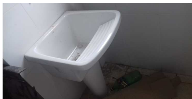
Figura 42C: Tanque de louça, instalado na área de serviço do bloco da direita
