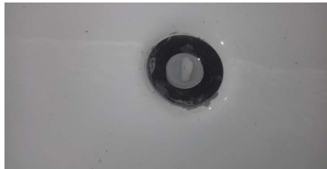
Figura 33C: Detalhe de válvula instalada em lavatório
