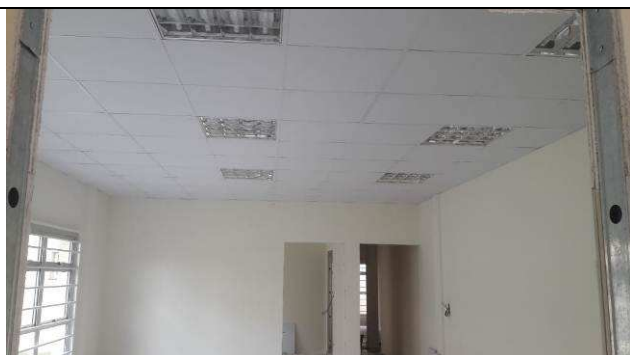
Figura 10C: Forro modular - Sala de Audiências - 2ª Vara.
