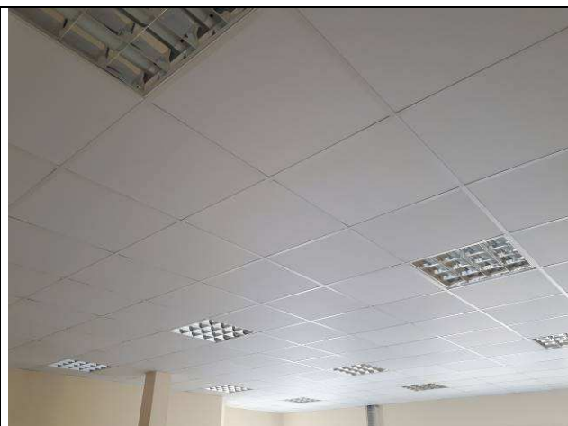
Figura 12E: luminárias 4x10W com aletas
