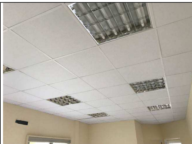
Figura 20C: Forro modular - Área de Vivência.
