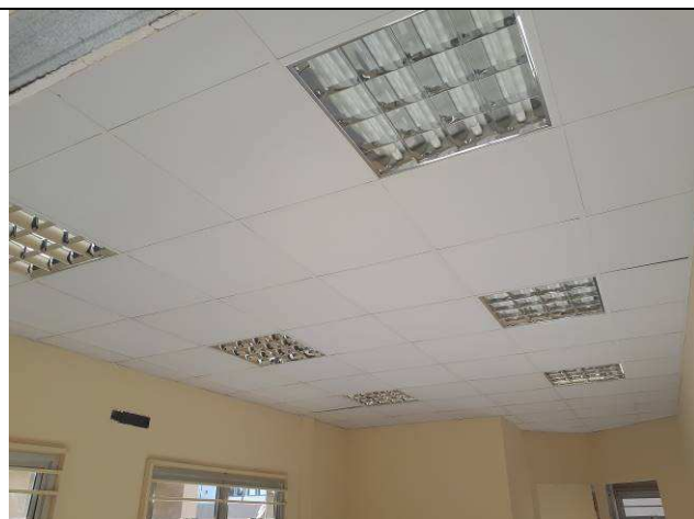
Figura 11E: luminárias 4x10W com aletas
