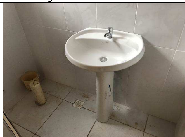
Figura 58C: Lavatório com coluna - banheiro sala de segurança do Hall.
