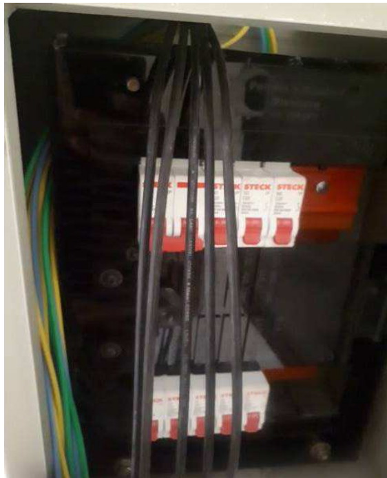
Figura 08E: cabos 6mm 2
