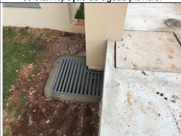
Figura 66C: Grelhas das caixas de coleta/inspeção de águas pluviais.
