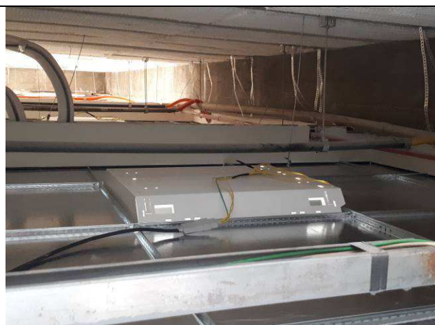
Figura 15E: luminárias - conexão
