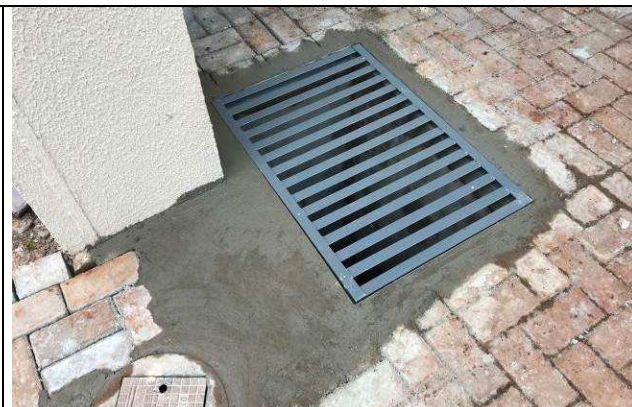
Figura 68C: Grelhas das caixas de coleta/inspeção de águas pluviais.
