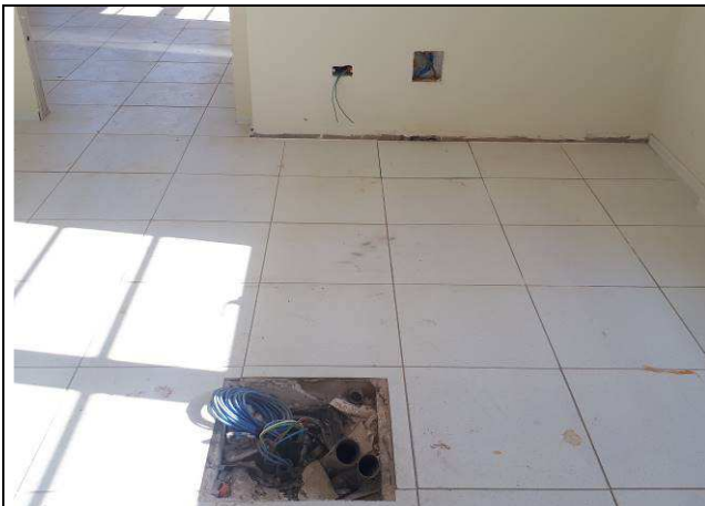
Figura 01E: caixa de inspeção salas de audiências
