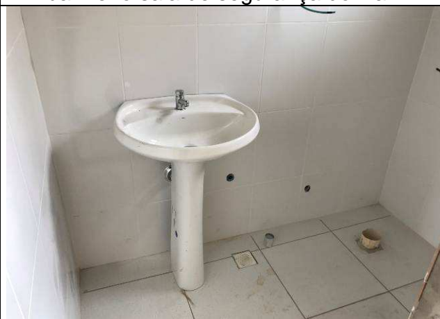
Figura 60C: Lavatório com coluna - banheiro área de vivência.
