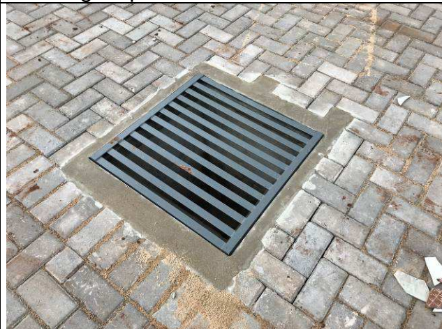
Figura 64C: Grelhas das caixas de coleta/inspeção de águas pluviais.
