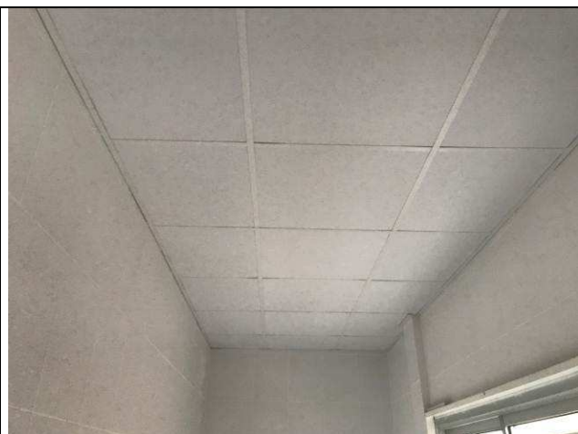
Figura 25C: Forro modular - Cozinha de Terceirizados.
