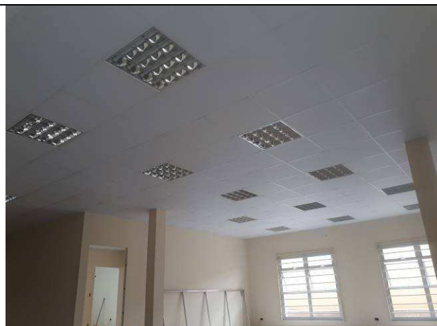
Figura 13E: luminárias 4x10W com aletas
