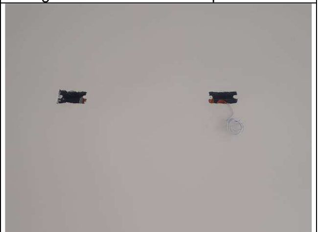
Figura 22E: cabos alarme patrimonial
