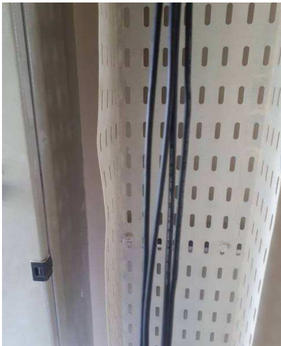
Figura 07E: cabos ar-condicionado
