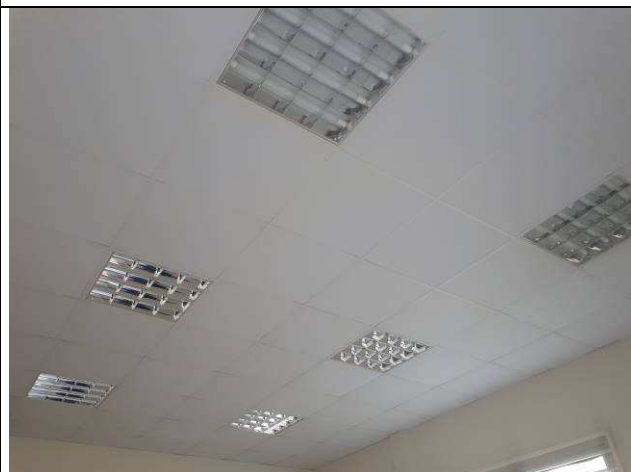
Figura 14E: luminárias 4x10W com aletas
