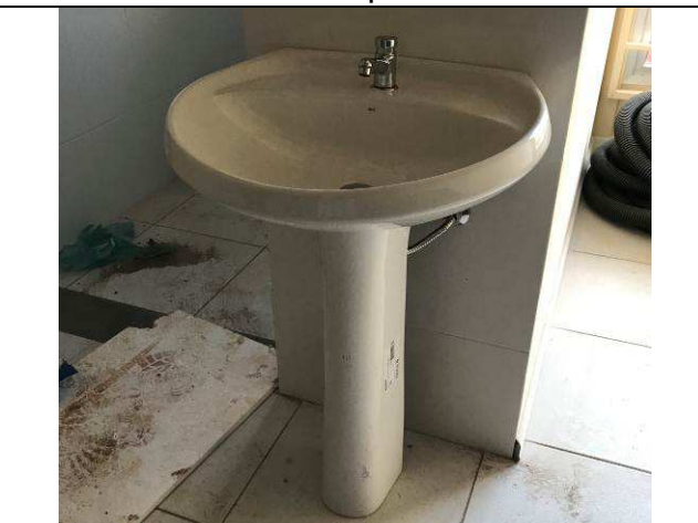
Figura 54C: Lavatórios com coluna - Sala de Perícias.
