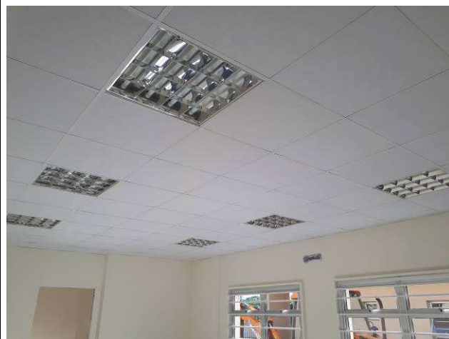
Figura 10E: luminárias 4x10W com aletas
