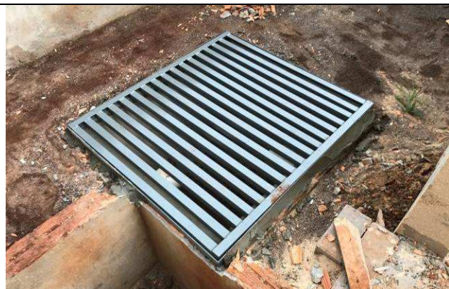
Figura 67C: Grelhas das caixas de coleta/inspeção de águas pluviais.
