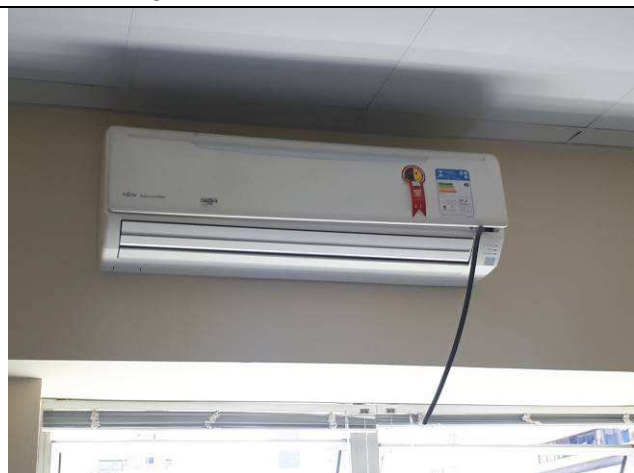
Figura 11C: Equipamento de ar condicionado instalado.
