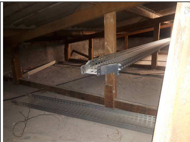
Figura 44E: instalações elétricas ar - cobertura VM362
