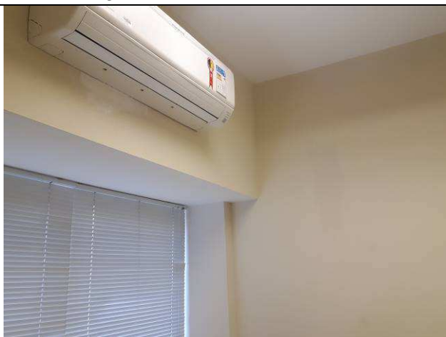
Figura 12C: Equipamento de ar condicionado instalado.
