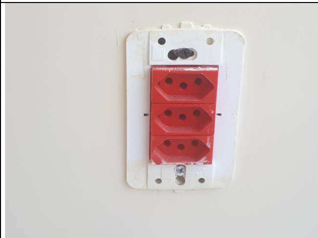
Figura 08E: tomadas elétricas - rede estabilizada
