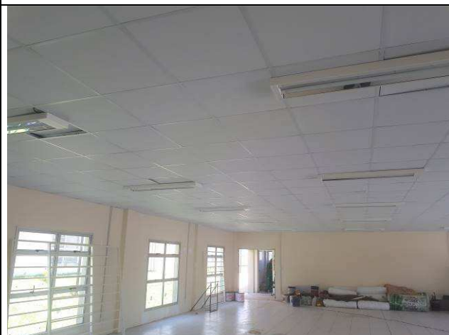
Figura 14E: luminárias arquivo
