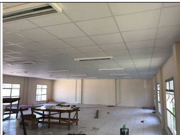
Figura 41C: Forro modular - Arquivo.
