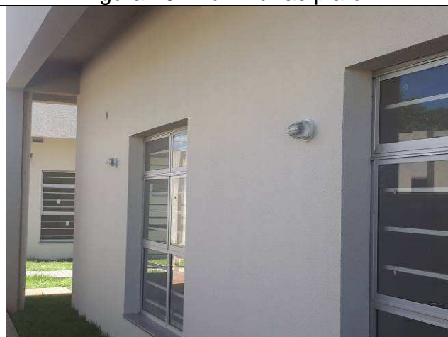
Figura 21E: luminárias tartaruga
