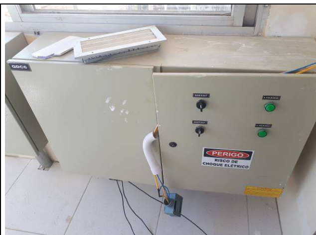
Figura 24E: quadros elétricos guarita QDC6
