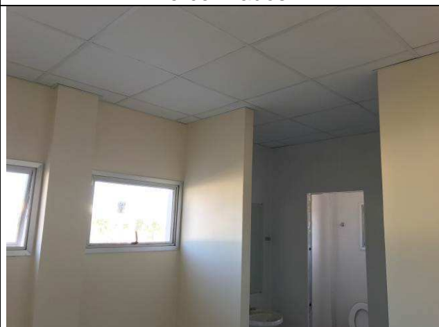
Figura 44C: Forro modular - Vestiário Terceirizados.
