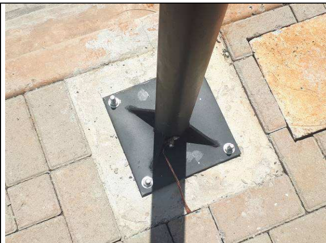
Figura 40E: atterramento partes metálicas - postes de iluminação externa
