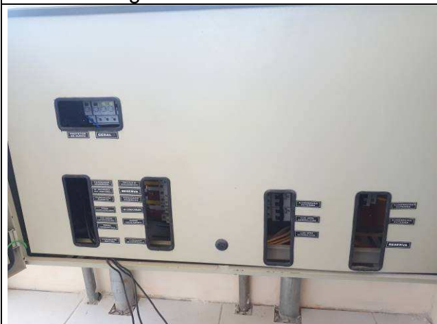
Figura 25E: quadros elétricos guarita QDC6
