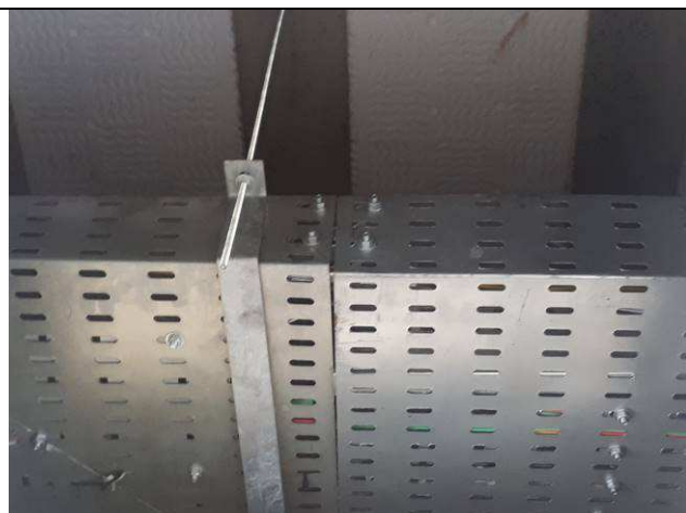
Figura 05E: Infraestrutura interna - eletrocalhas 500mm
