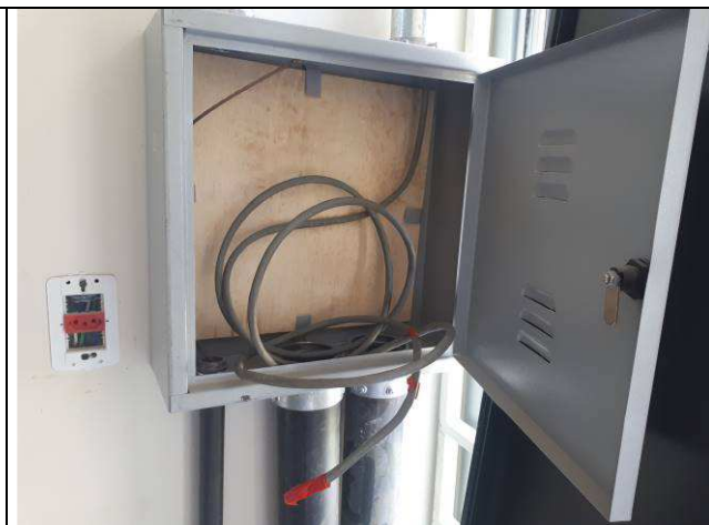
Figura 30E: Quadro telefonia DG
