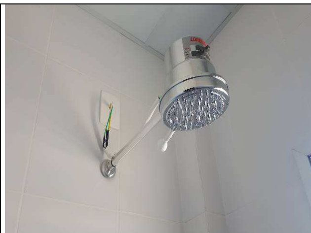
Figura 06E: cabeamento elétrico
