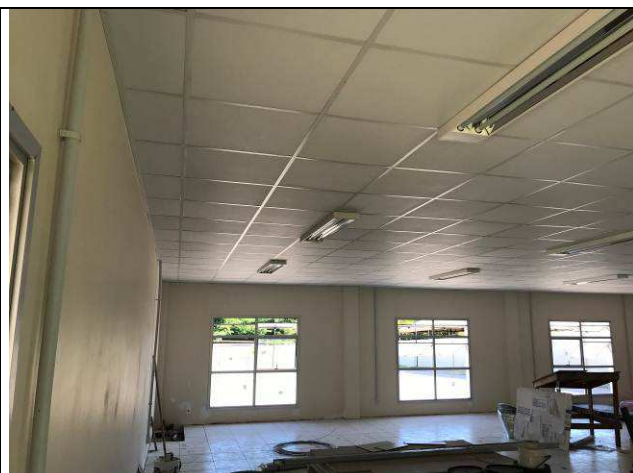
Figura 40C: Forro modular - Arquivo.
