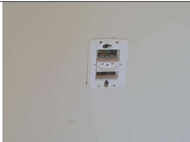
Figura 09E: tomadas elétricas - rede comum
