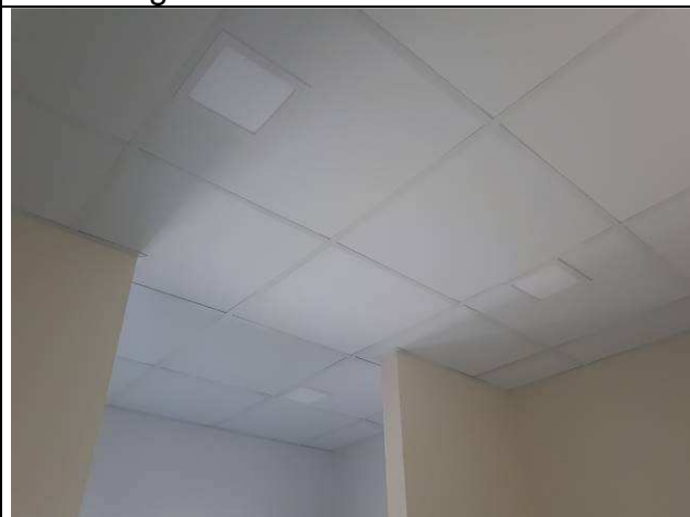
Figura 20E: luminárias plafon
