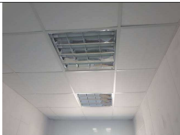
Figura 17E: luminárias 4x10W
