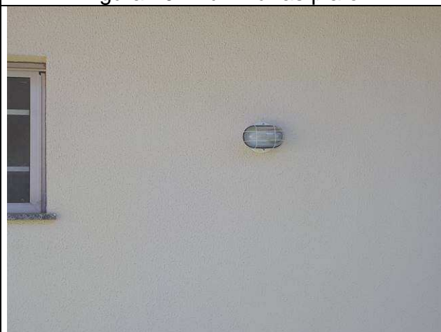
Figura 22E: luminárias tartaruga
