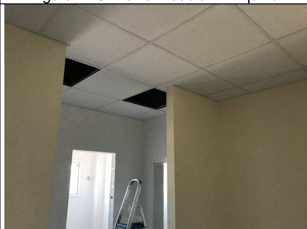
Figura 43C: Forro modular - Vestiário Terceirizados.
