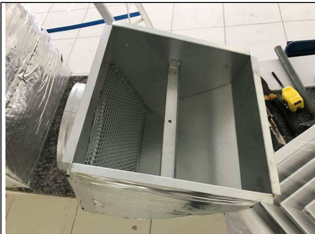
Figura 69C: Caixas dos difusores de insuflamento - Fórum.
