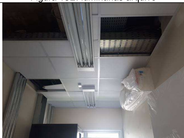
Figura 15E: luminárias sala técnica
