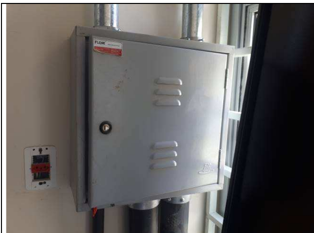
Figura 29E: Quadro telefonia DG
