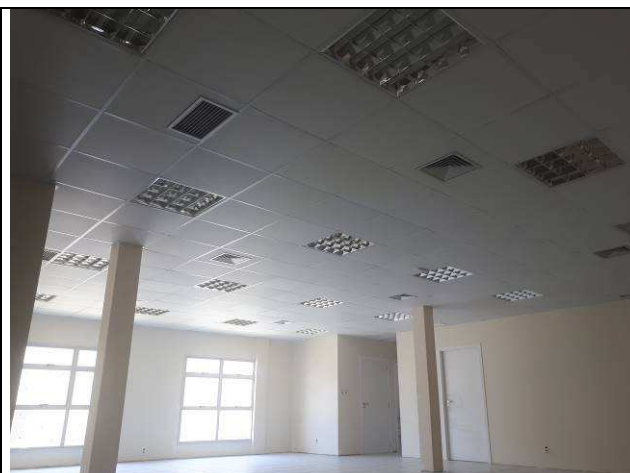
Figura 18E: luminárias 4x10W
