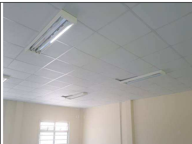
Figura 12E: luminárias arquivo
