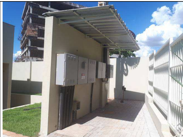
Figura 01E: Infraestrutura externa - entrada energia
