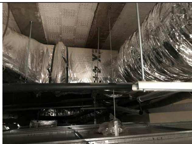
Figura 73C: Dutos flexíveis ligados aos difusores e grelhas - Fórum.
