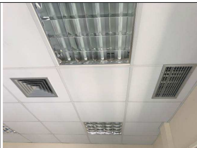
Figura 74C: Difusores e Grelha.
