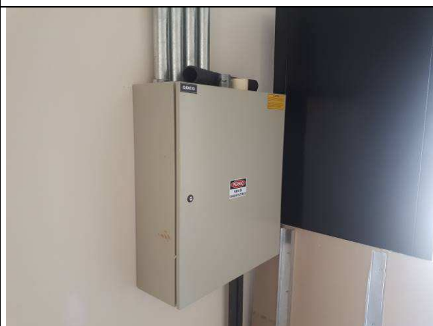
Figura 04E: Infraestrutura interna - eletrodutos
