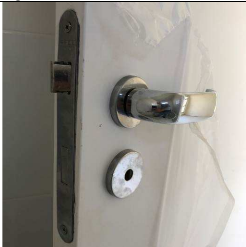
Figura 26C: Fechaduras instaladas - portas dos banheiros.
