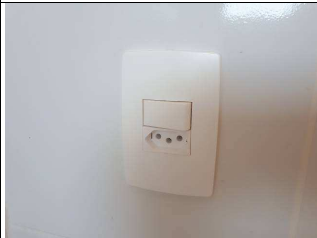
Figura 10E: tomadas elétricas e interruptores
