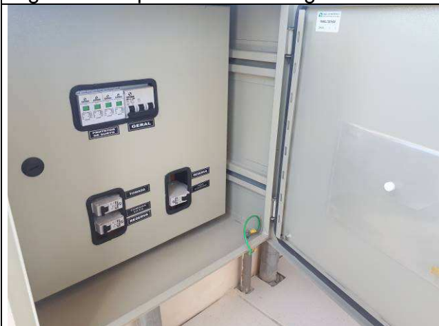
Figura 27E: quadros elétricos guarita QDE6
