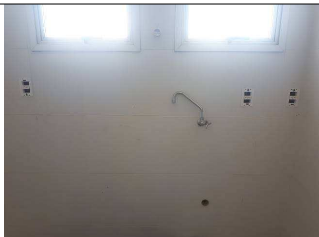
Figura 11E: tomadas elétricas - rede comum
