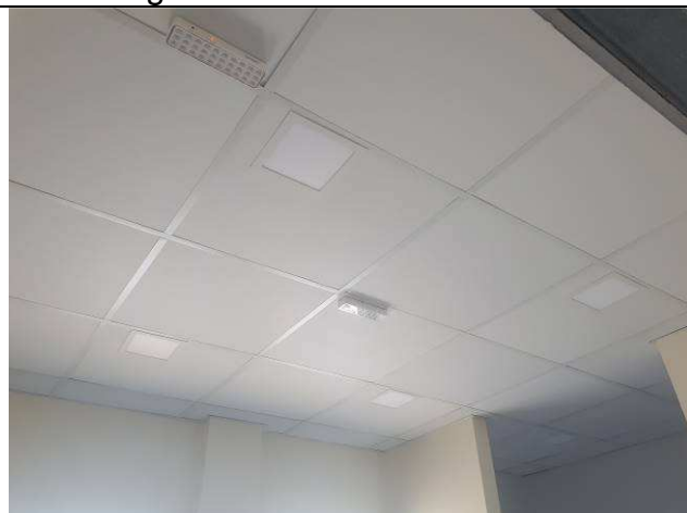
Figura 19E: luminárias plafon
