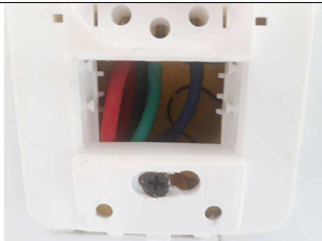
Figura 07E: cabeamento elétrico
