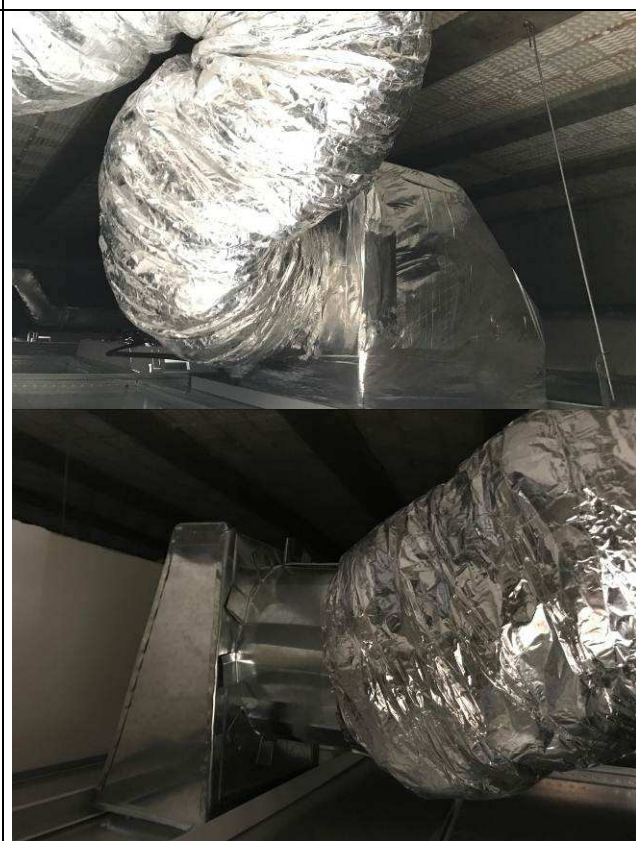
Figura 72C: Dutos flexíveis ligados aos difusores e grelhas - Fórum.
