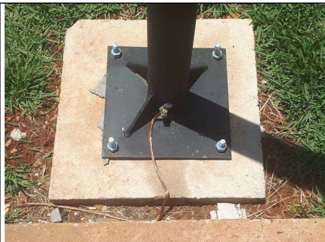
Figura 39E: atterramento partes metálicas - postes de iluminação externa
