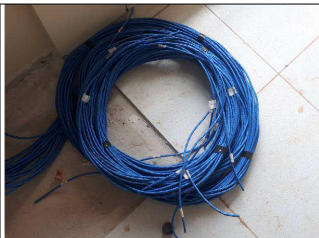
Figura 24E: cabeamento UTP cat6
