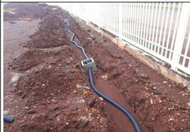
Figura 03E: infraestrutura externa - caixas 30x30 e eletrodutos 50mm e 75mm
