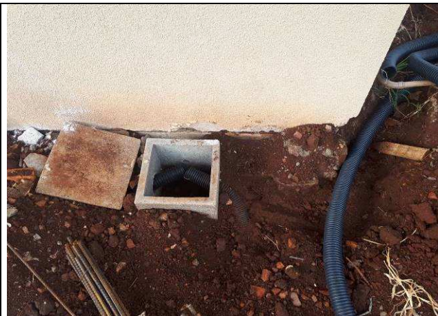
Figura 02E: infraestrutura externa - caixas 30x30 e eletrodutos 50mm e 75mm
