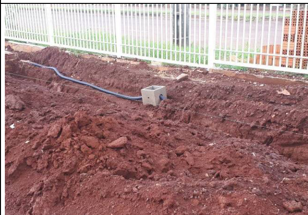
Figura 04E: infraestrutura externa - caixas 30x30 e eletrodutos 50mm e 75mm
