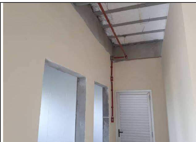
Figura 30E: infraestrutura eletrodutos e condutes - SDAI
