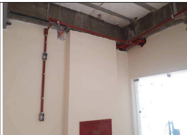
Figura 29E: infraestrutura eletrodutos e condutes - SDAI
