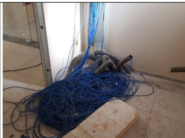
Figura 23E: cabeamento UTP cat6 sala site
