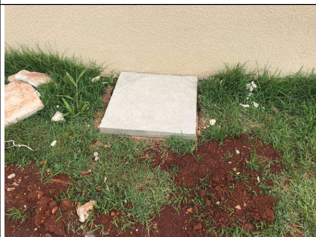
Figura 23C: Tampas das caixas de gordura.
