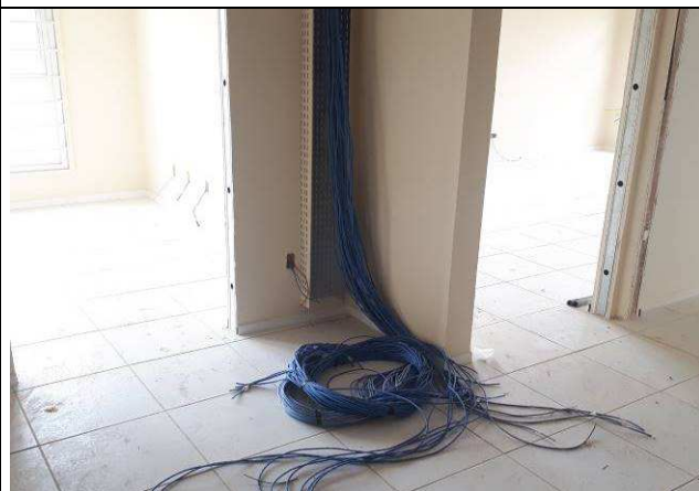
Figura 26E: cabeamento UTP cat6
