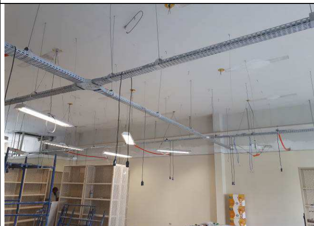
Figura 06E: infraestrutura - eletrocalhas e acessórios - 3ª VT
