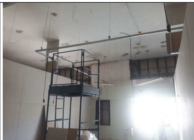
Figura 04E: infraestrutura - eletrocalhas e acessórios - 3ª VT
