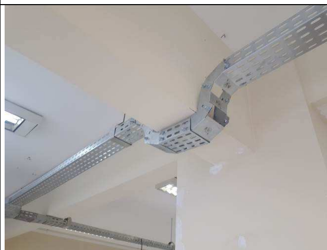
Figura 08E: infraestrutura - eletrocalhas e acessórios - 6ª VT
