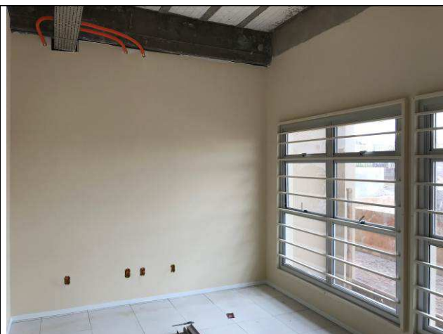
Figura 26C: Paredes de gesso acartonado - 2ª Vara - Assessoria.
