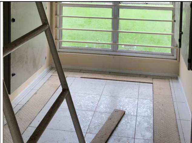
Figura 72C: Pisos cerâmicos - Sala técnica.
