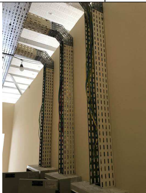
Figura 03E: infraestrutura interna - eletrocalhas descida quadros
