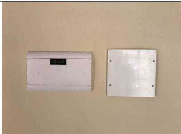
Figura 19E: infraestrutura interna - quadro telefonia OAB
