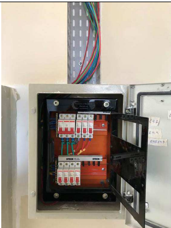
Figura 17E: cabeamento elétrico - QDE4
