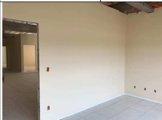
Figura 12C: Paredes de gesso acartonado - 1ª Vara - Assessoria.
