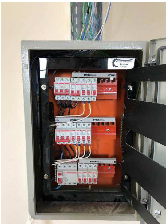
Figura 18E: cabeamento elétrico - QDC4
