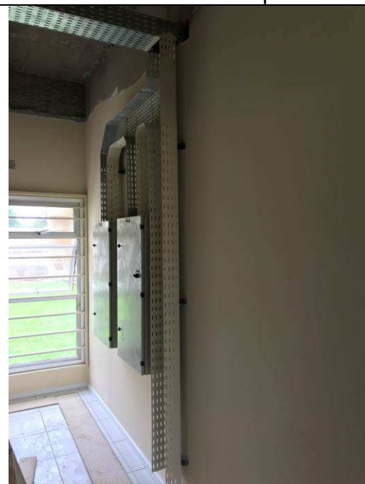
Figura 04E: infraestrutura interna - eletrocalhas descida quadros
