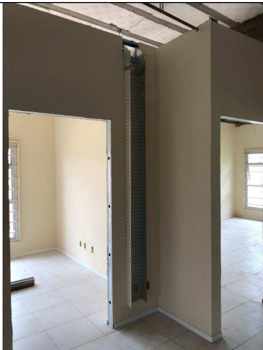
Figura 01E: infraestrutura interna - eletrocalhas descida quadros
