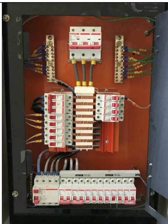
Figura 15E: cabeamento elétrico - QDC3
