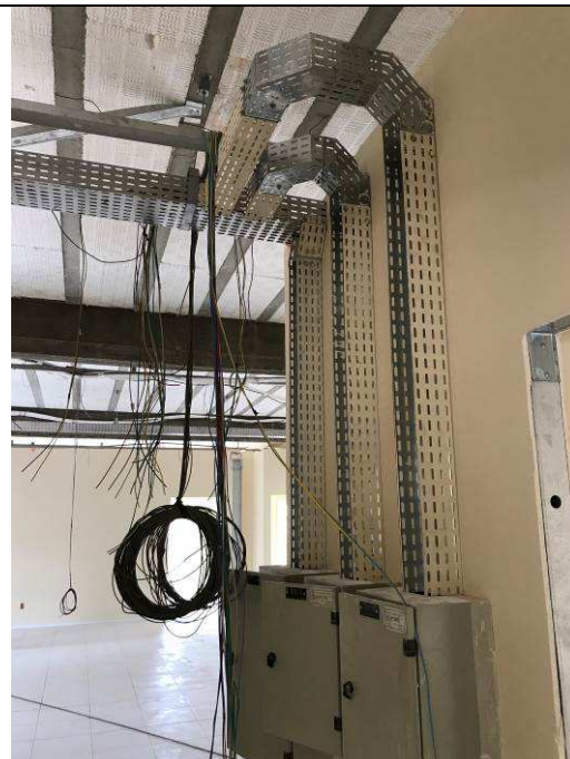
Figura 02E: infraestrutura interna - eletrocalhas descida quadros
