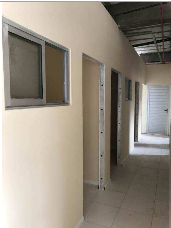
Figura 49C: Paredes de gesso acartonado - Circulação Vestiários.
