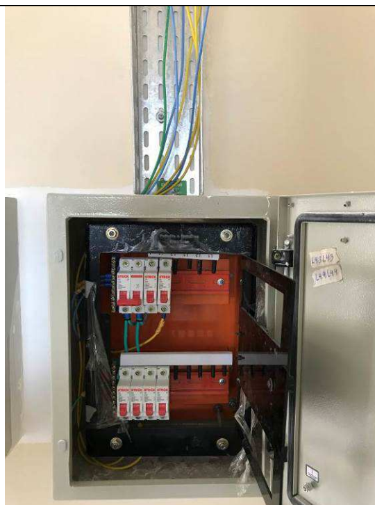
Figura 16E: cabeamento elétrico - QDL4
