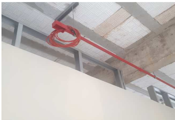
Figura 15E: infraestrutura e cabeamento sistema SDAI
