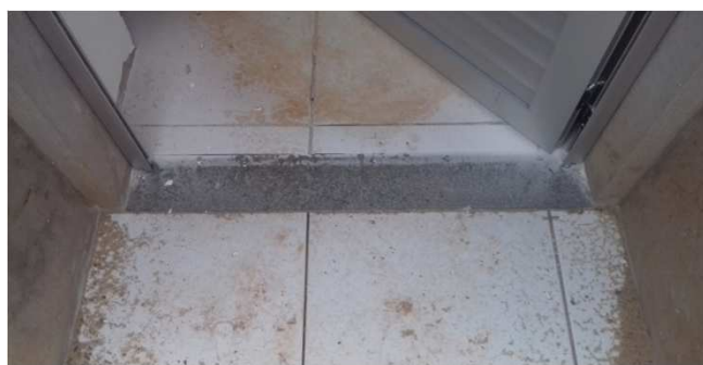
Figura 35C: Soleira instalada em porta de acesso aos fundos - bloco da esquerda
