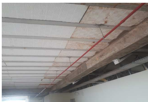
Figura 18E: infraestrutura e cabeamento sistema SDAI
