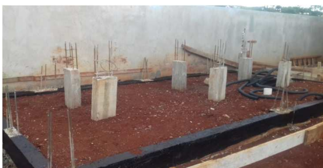
Figura 01C: Vigas baldrame concretadas e já deformadas - Reservatório de incêndio
