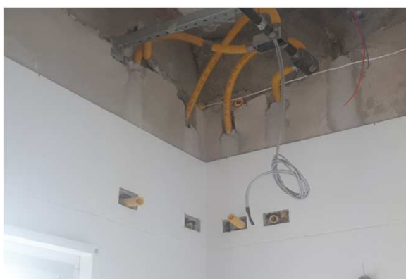
Figura 07E: infraestrutura interna - caixas e eletrodutos
