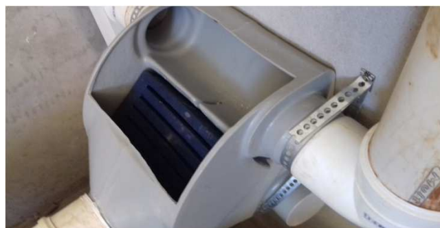
Figura 58C: Detalhe interno do filtro
