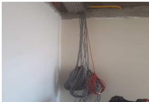
Figura 22E: cabeamento UTP entroncamento racks
