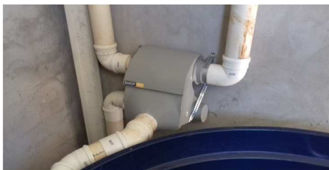
Figura 57C: Filtro instalado após a captação pluvial e antes da ligação com reservatório
