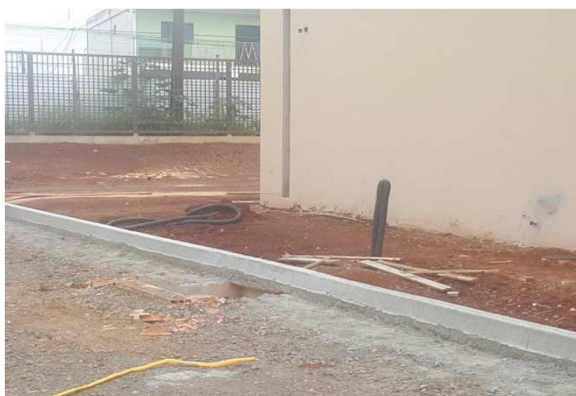
Figura 01E: infraestrutura de eletrodutos e caixas 30x30 - externo estacionamento
