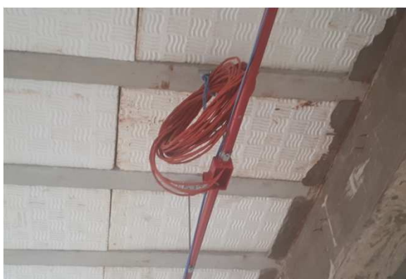
Figura 17E: infraestrutura e cabeamento sistema SDAI
