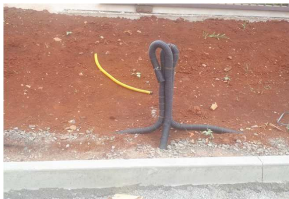
Figura 04E: infraestrutura de eletrodutos e caixas 30x30 - externo estacionamento
