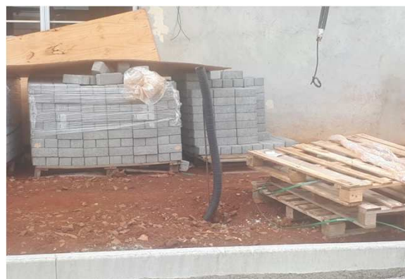
Figura 02E: infraestrutura de eletrodutos e caixas 30x30 - externo estacionamento
