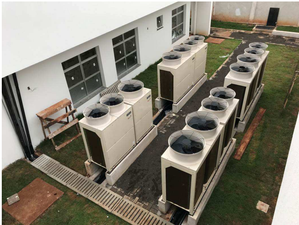
Figura 4 – Prédio do Fórum – vista externa - equipamentos de refrigeração.
