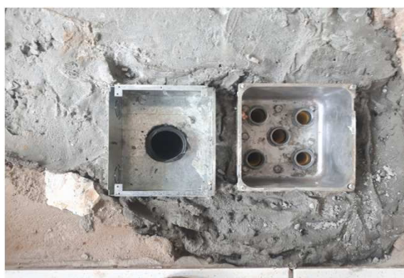
Figura 10E: infraestrutura interna - caixas de piso e eletrodutos (lado direito, audiências)
