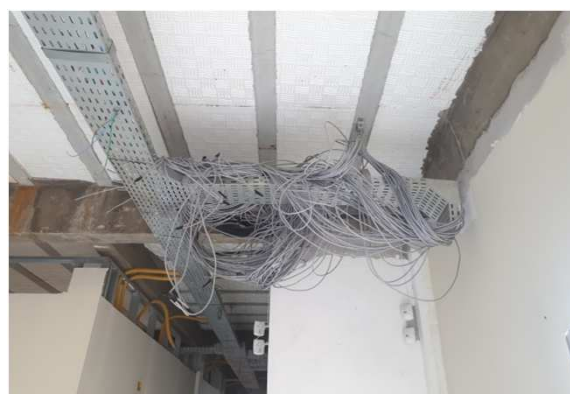
Figura 16E: cabeamento UTP cat6
