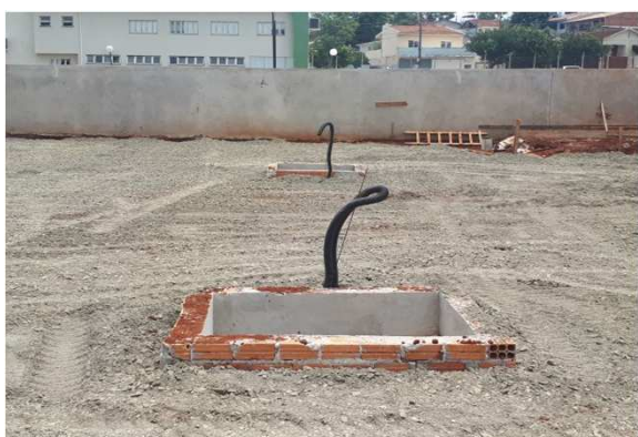
Figura 03E: infraestrutura de eletrodutos e caixas 30x30 - externo estacionamento
