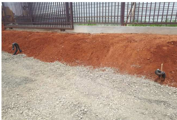
Figura 01E: infraestrutura de eletrodutos e caixas 30x30 - externo estacionamento
