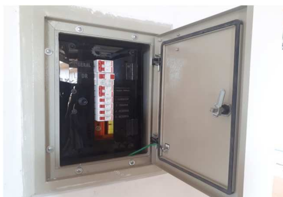
Figura 12E: quadro elétrico - OAB
