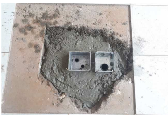
Figura 09E: infraestrutura interna - caixas de piso e eletrodutos (lado direito, audiências)
