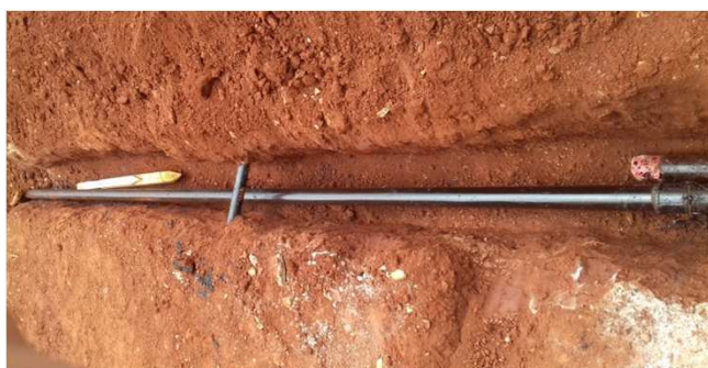
Figura 49C: Tubo de incêndio 2 1/2", instalado entre a calçada e a entrada do imóvel
