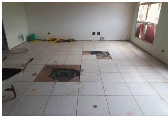
Figura 08E: infraestrutura interna - caixas de piso e eletrodutos (lado direito, audiências)
