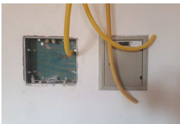
Figura 11E: quadro elétrico - OAB
