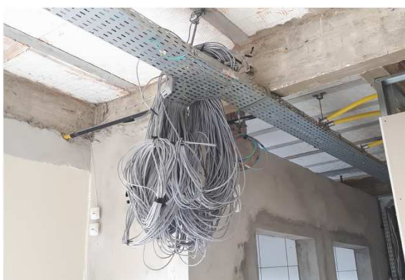
Figura 17E: cabeamento UTP cat6
