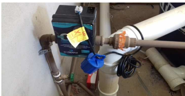
Figura 42C: Válvula solenóide, já com bóia elétrica acoplada (cabo preto)
