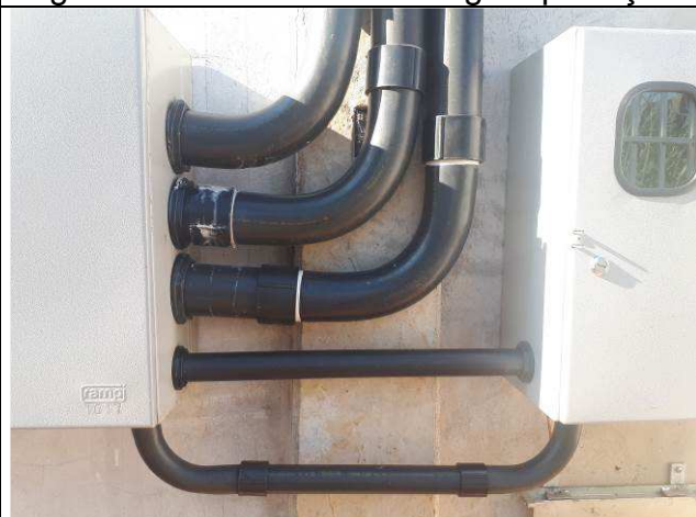
Figura 06E: Entrada de energia - eletrodutos.
