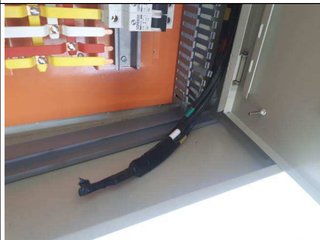
Figura 12E: ramal alimentador quadro QDE4.
