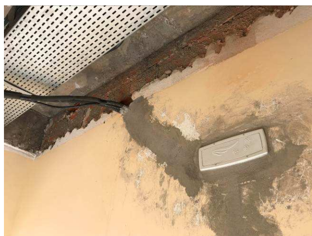
Figura 42C: Caixa de dreno de linha frigorígena - Sala Técnica 1.
