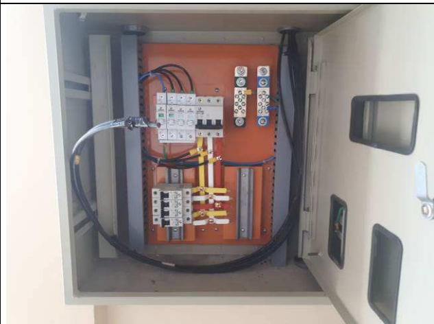
Figura 10E: ramal alimentador quadro QDC5.
