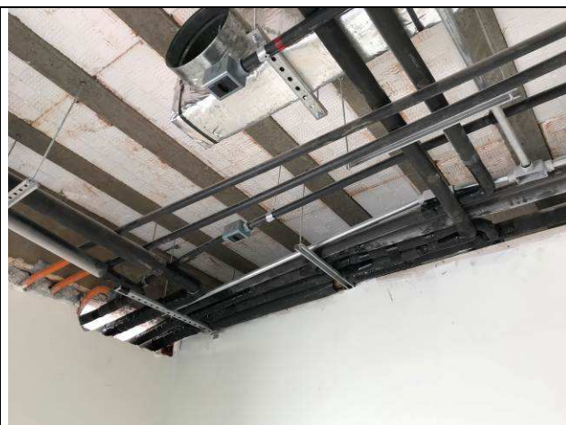
Figura 35C: Linhas frigorígenas e drenos com isolamento térmico.
