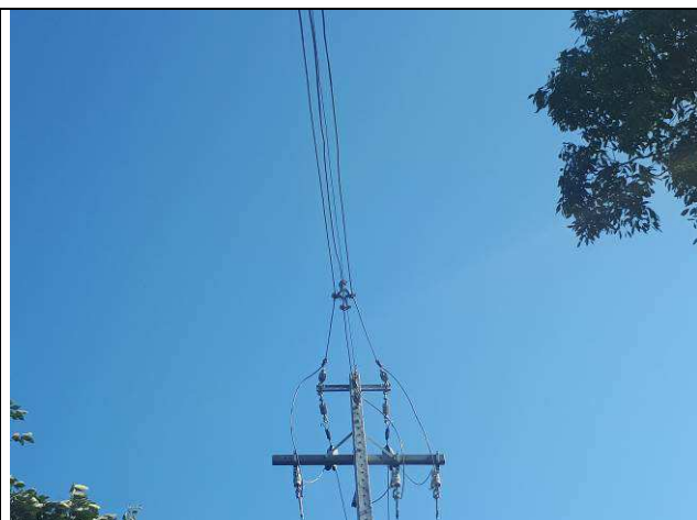
Figura 08E: Entrada de energia - ramal de média tensão.
