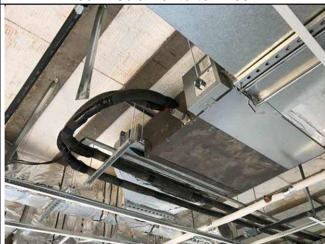
Figura 33C: Linhas frigorígenas e drenos com isolamento térmico.
