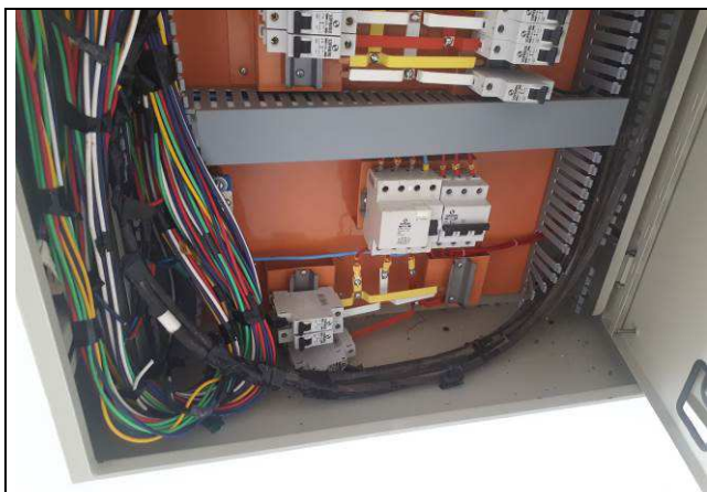
Figura 13E: ramal alimentador quadro QDC1.
