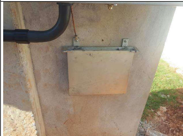
Figura 09E: Entrada de energia - bandeja medição.
