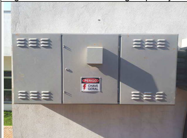
Figura 03E: Entrada de energia - proteção.
