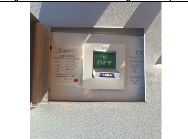
Figura 04E: Entrada de energia - proteção.
