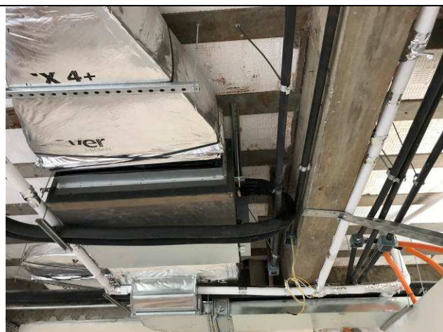
Figura 34C: Linhas frigorígenas e drenos com isolamento térmico.
