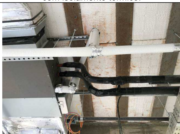
Figura 36C: Linhas frigorígenas e drenos com isolamento térmico.
