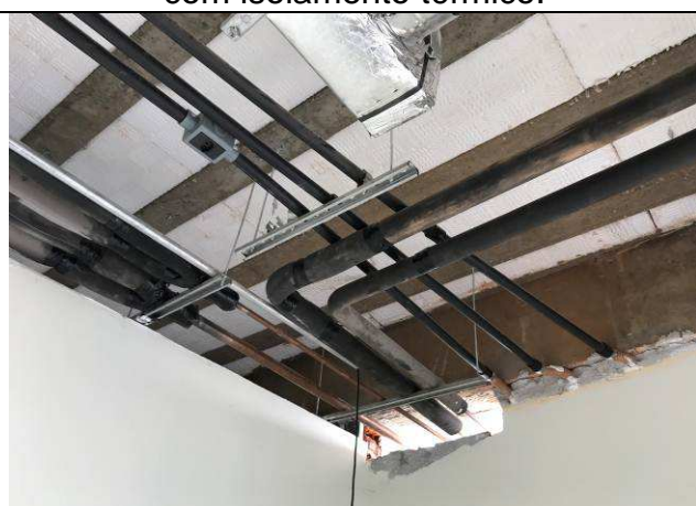
Figura 38C: Linhas frigorígenas e drenos com isolamento térmico.
