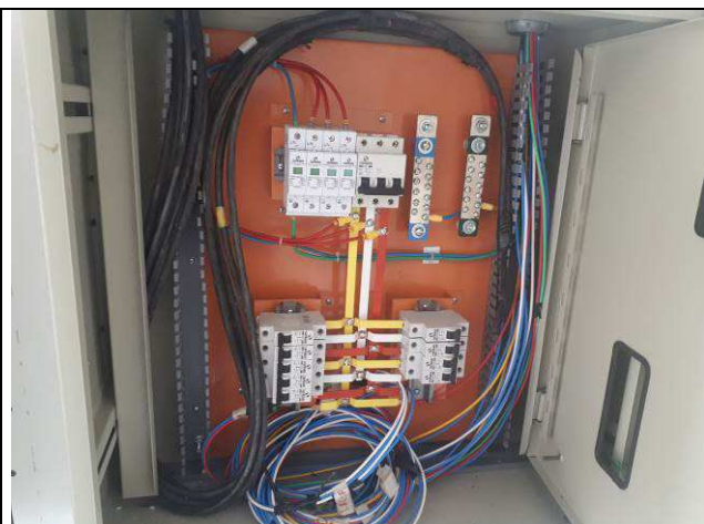
Figura 14E: ramal alimentador quadro QDE1.
