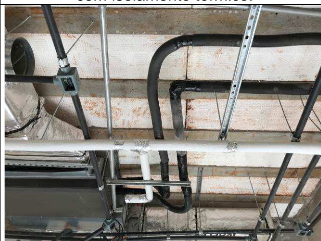
Figura 37C: Linhas frigorígenas e drenos com isolamento térmico.
