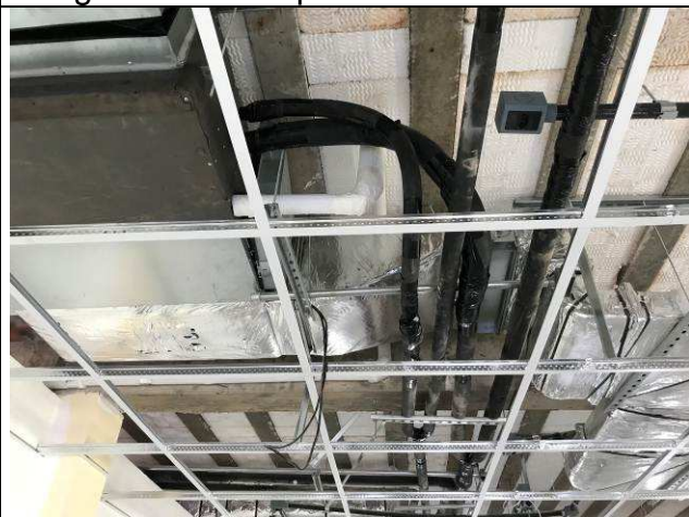
Figura 30C: Linhas frigorígenas e drenos com isolamento térmico.
