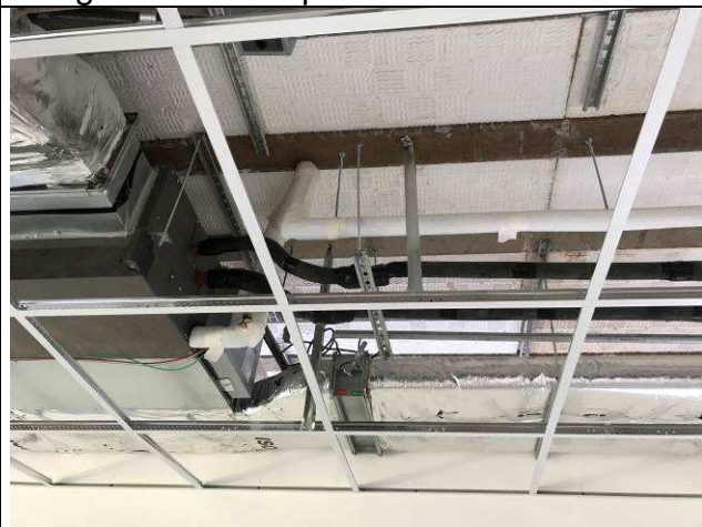
Figura 31C: Linhas frigorígenas e drenos com isolamento térmico.
