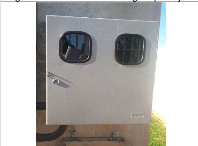
Figura 05E: Entrada de energia - medição.
