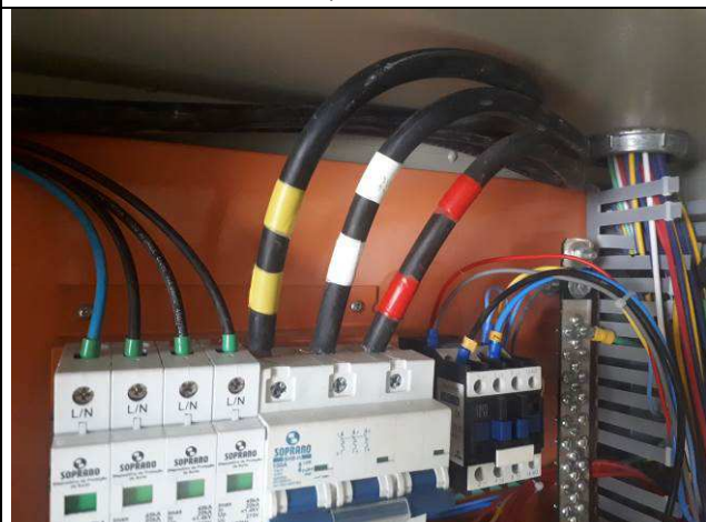
Figura 16E: ramal alimentador quadro QDC2.
