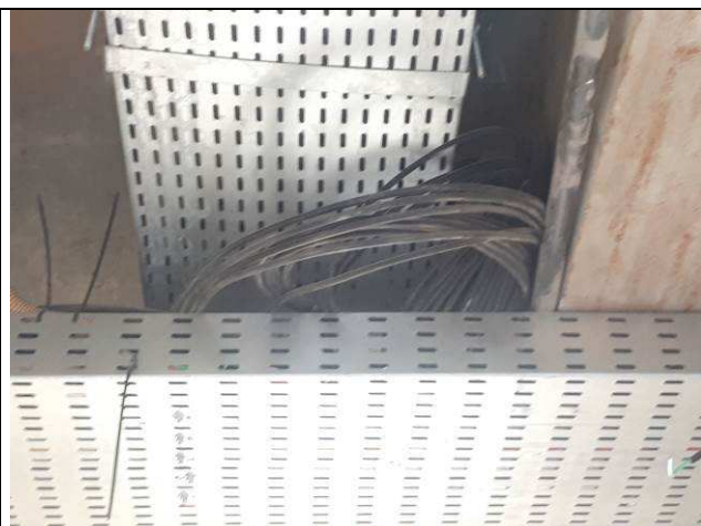
Figura 19E: ramais alimentadores - sala técnica.
