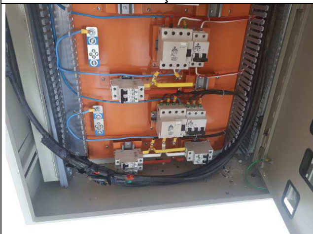
Figura 11E: ramal alimentador quadro QDC4.
