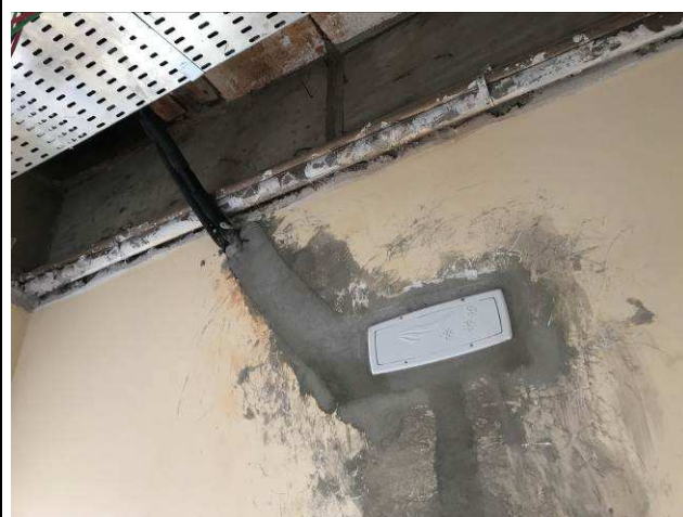
Figura 43C: Caixa de dreno de linha frigorígena - Sala Técnica 2.
