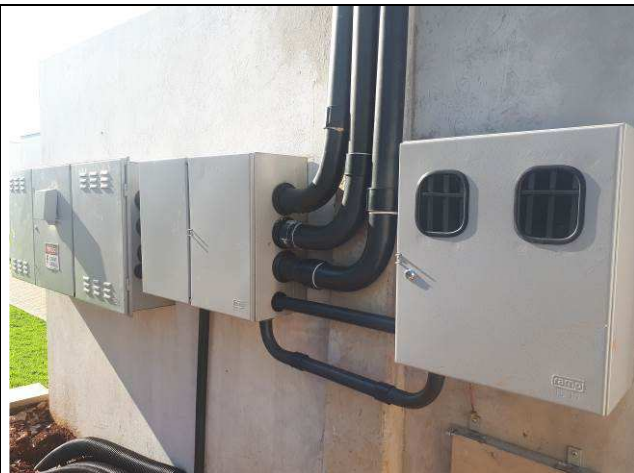
Figura 02E: Entrada de energia - medição.
