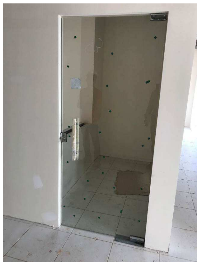
Figura 10C: Porta de vidro temperado do balcão da Distribuição.
