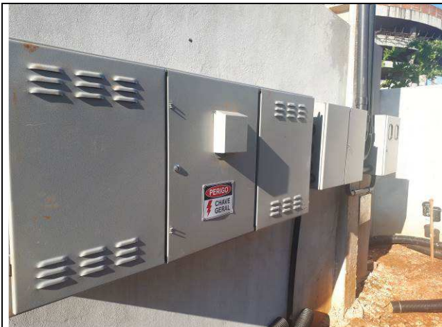
Figura 01E: Entrada de energia - proteção.
