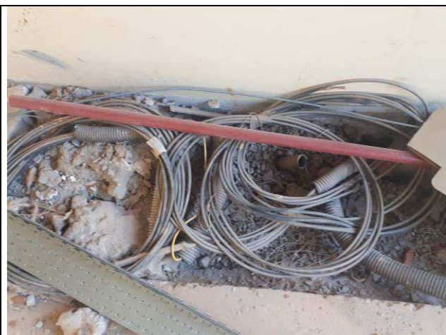
Figura 20E: ramais alimentadores - sala técnica.
