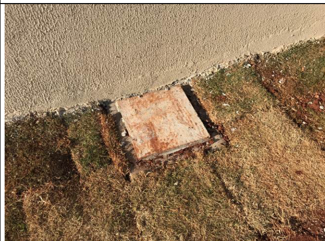
Figura 106C: Caixas de gordura.
