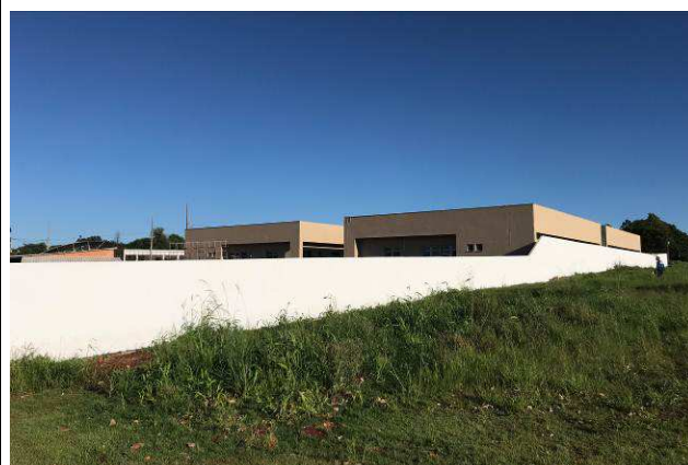
Figura 128C: Muro de divisa - revestimento argamassado finalizado.
