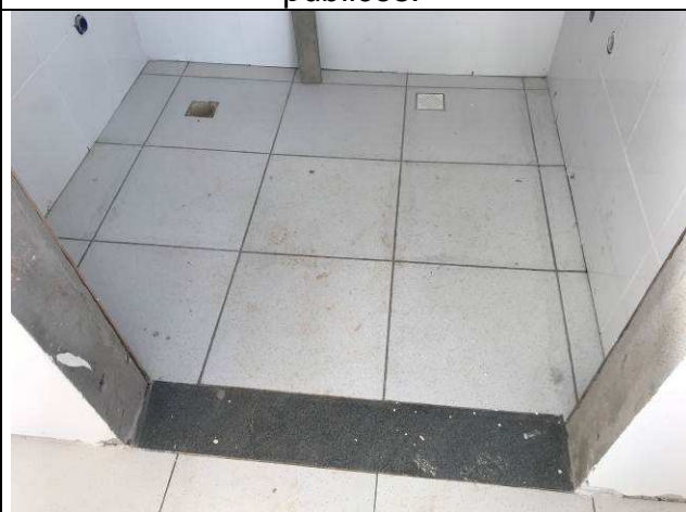
Figura 82C: Piso cerâmico - banheiros 2ª Vara.
