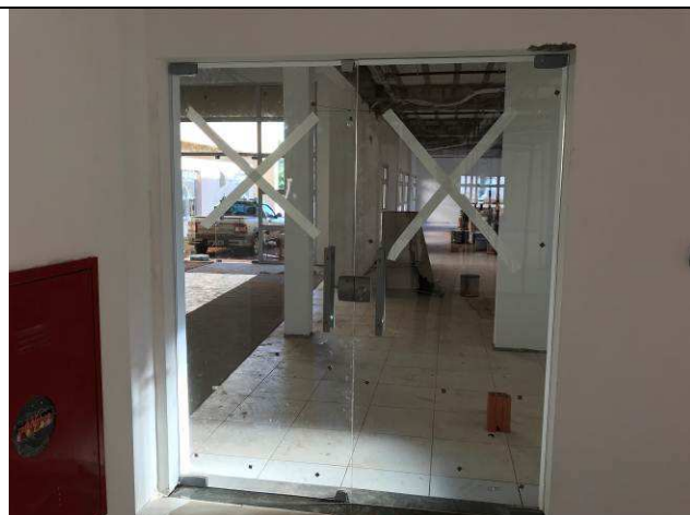
Figura 25C: Porta de Vidro Temperado - entrada 2ª Vara.
