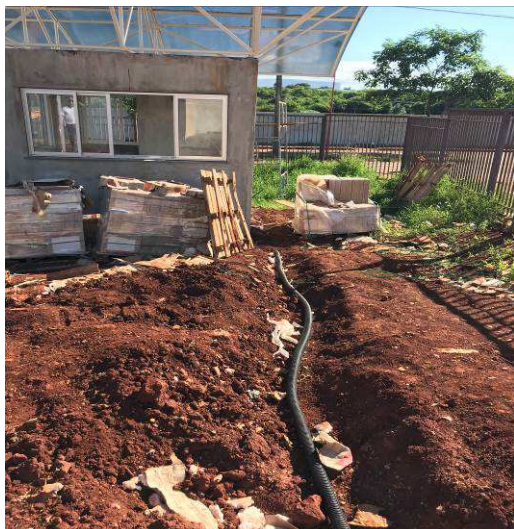
Figura 19E: infraestrutura externa - eletrodutos PEAD e caixas.
