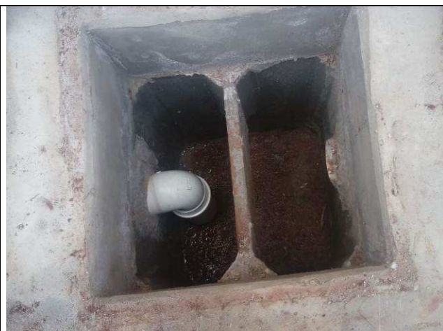
Figura 104C: Caixas de gordura.
