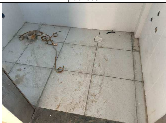
Figura 81C: Piso cerâmico - banheiros 1ª Vara.
