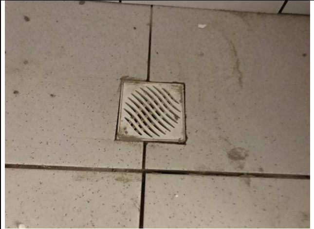
Figura 92C: Ralos das caixas sifonadas.
