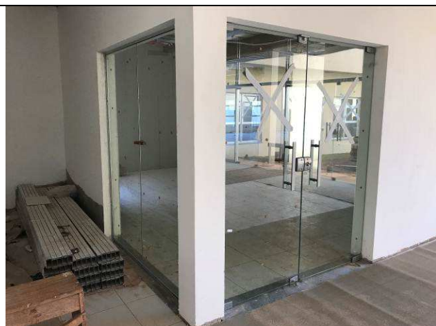
Figura 23C: Porta de Vidro Temperado - entrada 1ª Vara.
