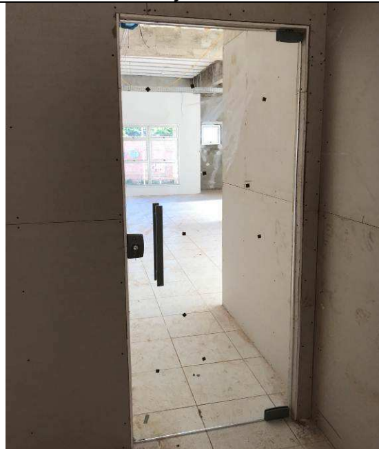
Figura 22C: Porta de Vidro Temperado - entrada Distribuição / Sala dos Oficiais.
