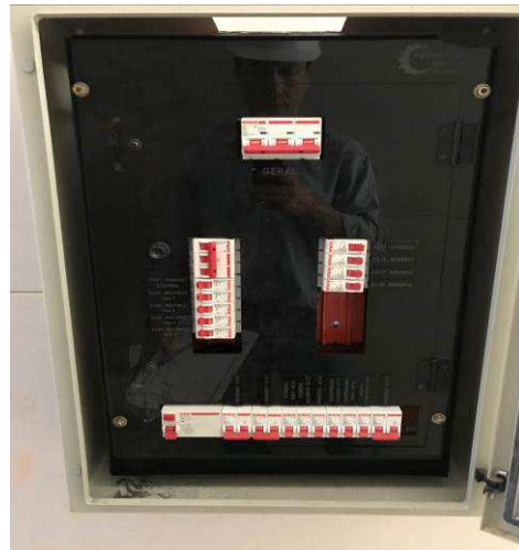
Figura 16E: quadro elétrico QDC3.
