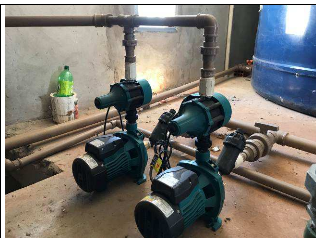
Figura 98C: Motobombas de pressurização.
