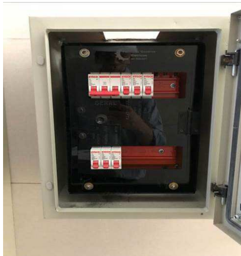
Figura 15E: quadro elétrico QDE3.
