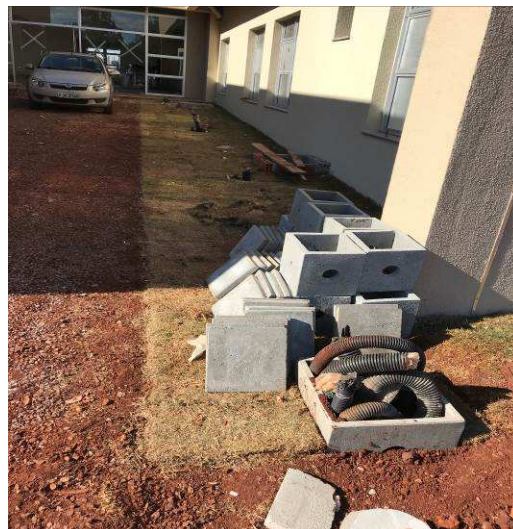
Figura 20E: infraestrutura externa - eletrodutos PEAD e caixas.
