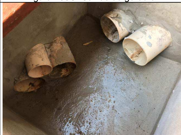
Figura 108C: Caixa de inspeção de águas pluviais.
