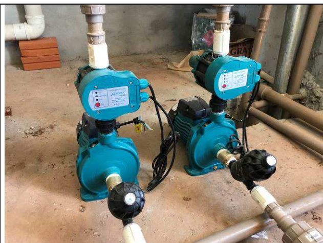
Figura 97C: Motobombas de pressurização.
