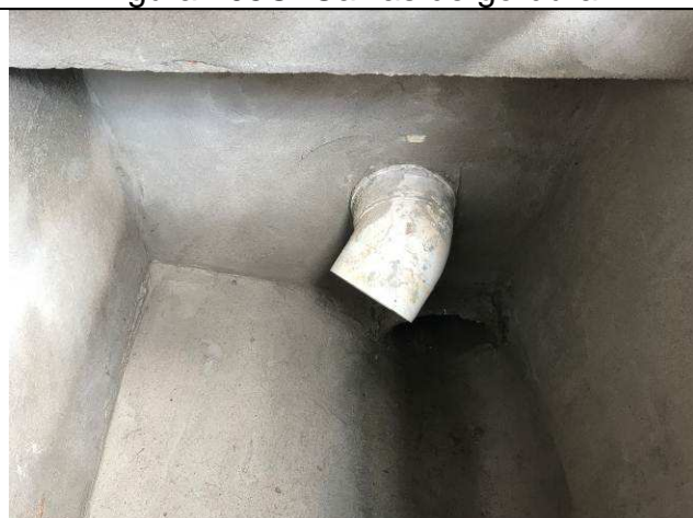
Figura 107C: Caixa de inspeção de esgoto.
