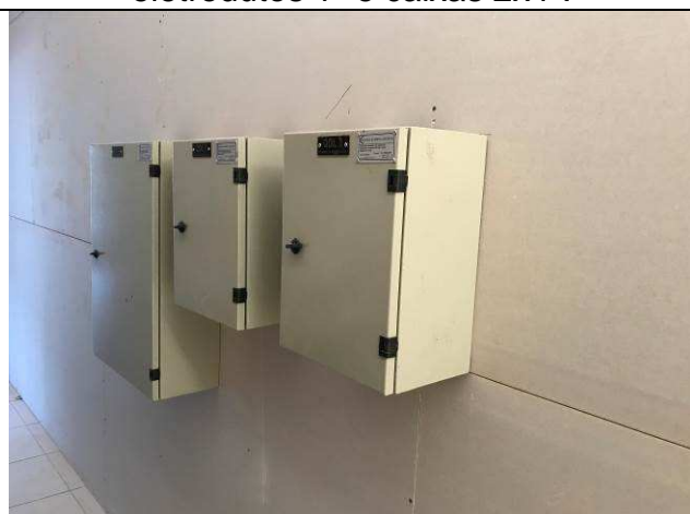
Figura 13E: quadros elétricos QDL3, QDE3 e QDC3.
