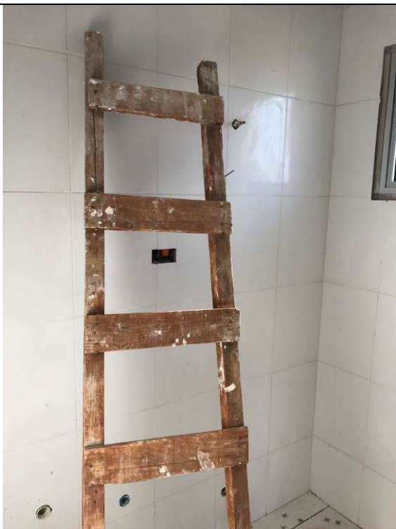
Figura 69C: Azulejos - Banheiro da Área de Vivência.
