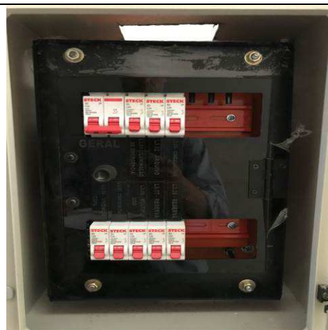
Figura 14E: quadro elétrico QDL3.
