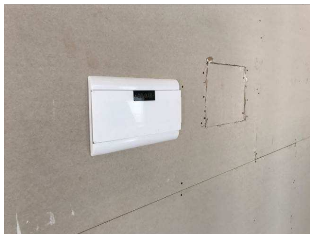
Figura 17E: quadro elétrico QD-OAB.
