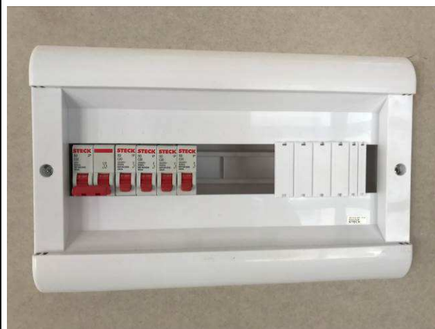
Figura 18E: quadro elétrico QD-OAB.
