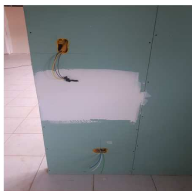
Figura 10E: cabeamento elétrico - lado direito
