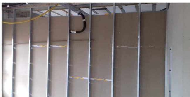
Figura 03C: fechamento de uma das faces de paredes de gesso acartonado simples - bloco esquerdo
