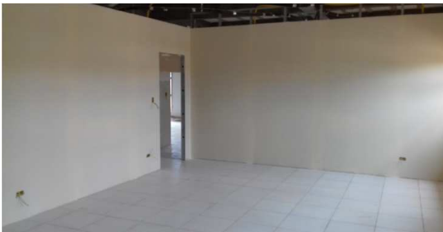
Figura 28C: paredes de dry-wall com primeira demão de pintura já executada - bloco da direita
