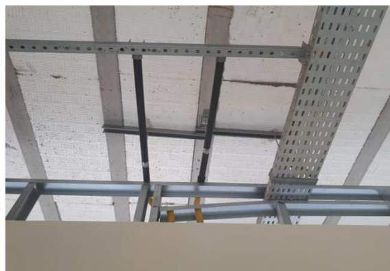
Figura 02E: infraestrutura de eletrodutos - lado direito
