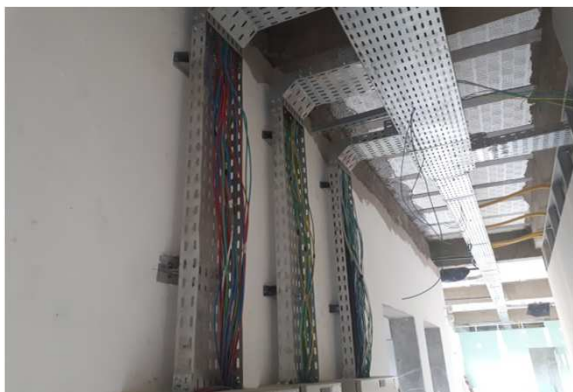
Figura 05E: infraestrutura de eletrocalhas e cabeamento elétrico
