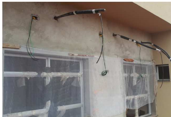
Figura 24E: cabearno alimentação condicionadores de ar
