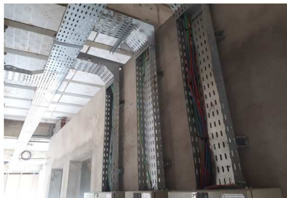
Figura 06E: infraestrutura de eletrocalhas e cabeamento elétrico
