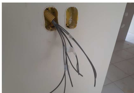
Figura 08E: cabeamento elétrico - lado direito
