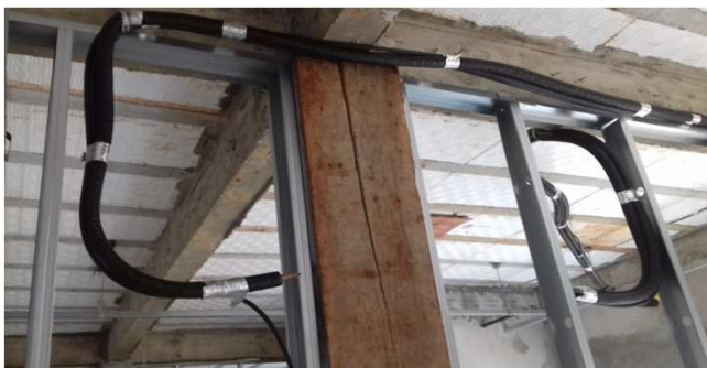
Figura 24C: redes frigorígenas que atendem o gabinete e a sala de audiência 2
