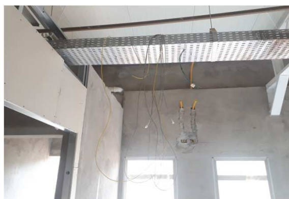
Figura 20E: infraestrutura de eletrodutos - lado direito
