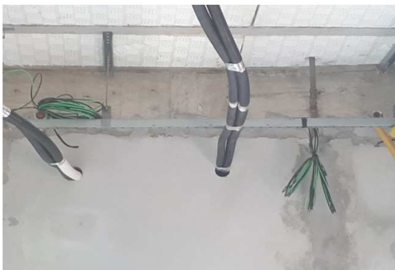
Figura 23E: cabearno alimentação condicionadores de ar
