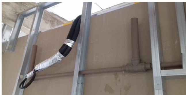
Figura 17C: dreno de ar condicionado instalado em sala de audiência e gabinete - bloco esquerdo
