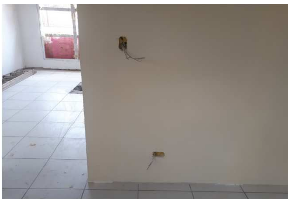
Figura 01E: infraestrutura de eletrodutos e caixas 2x4" - lado direito
