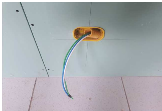
Figura 12E: cabearamento elétrico - lado direito
