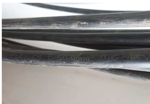
Figura 16E: cabearamento elétrico #50mm 2
