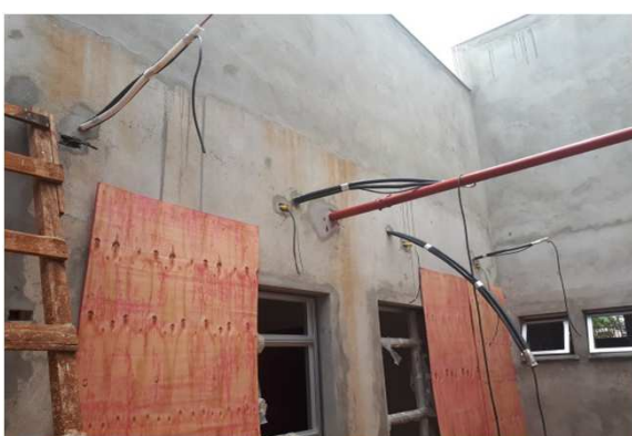
Figura 21E: cabeamento alimentação condicionadores de ar
