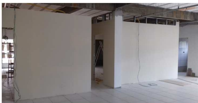
Figura 29C: paredes de dry-wall com primeira demão de pintura já executada - bloco da direita
