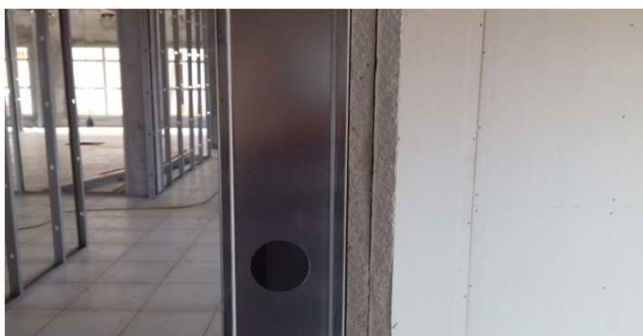
Figura 08C: detalhe de parede com placa dupla, aplicada em uma das faces - bloco esquerdo
