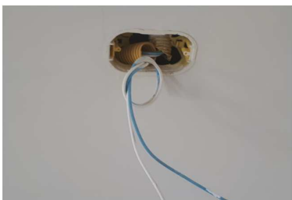
Figura 09E: cabeamento elétrico - lado direito
