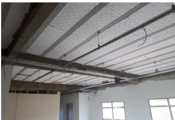
Figura 03E: infraestrutura de eletrocalhas e perfilados - lado direito
