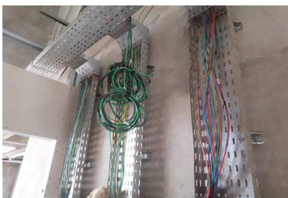
Figura 07E: infraestrutura de eletrocalhas e cabeamento elétrico
