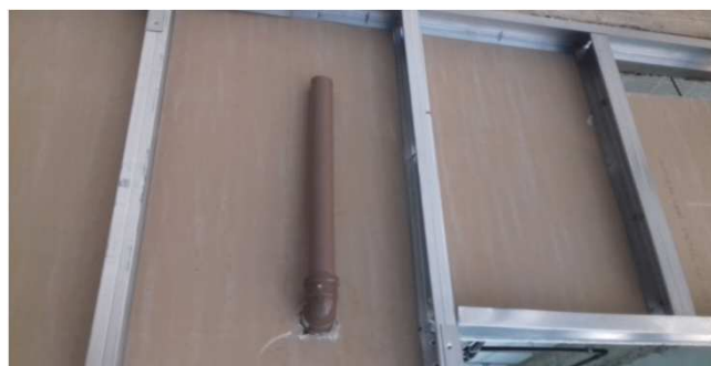
Figura 18C: dreno de ar condicionado instalado na sala dos assistentes - bloco esquerdo
