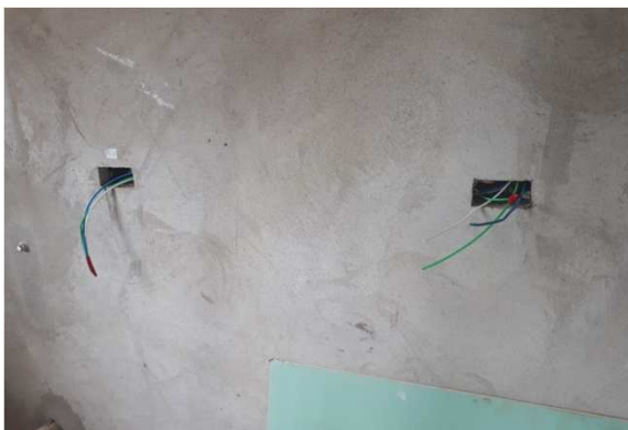
Figura 11E: cabearamento elétrico - lado direito
