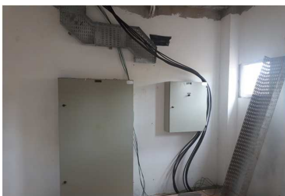
Figura 15E: cabearamento elétrico alimentação QDC1 e C2
