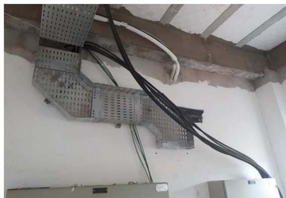
Figura 04E: infraestrutura de eletrocalhas - sala técnica
