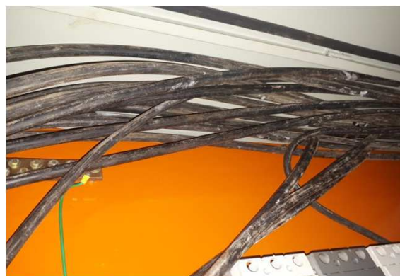
Figura 14E: cabos 120mm 2 e 70mm 2 - entrada de energia e alimentação QDG
