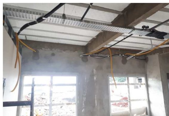
Figura 06E: infraestrutura de eletrodutos - lado direito
