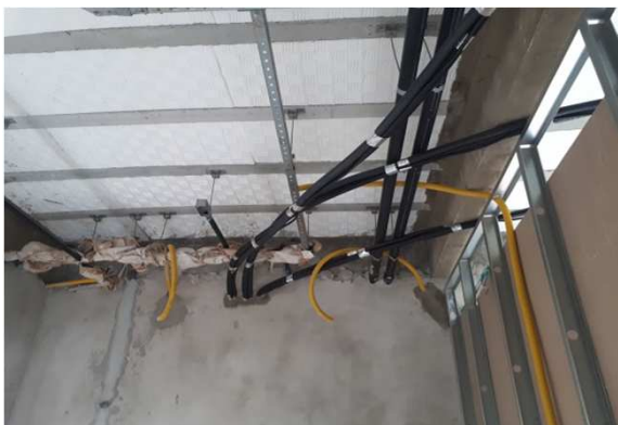
Figura 07E: infraestrutura de eletrodutos - lado direito
