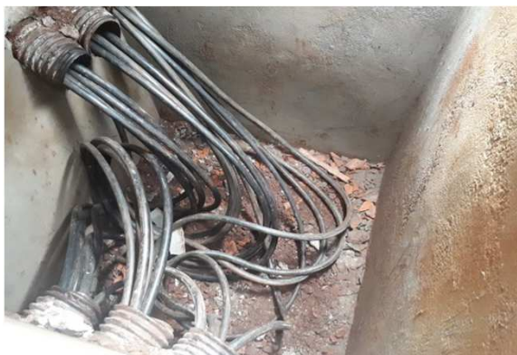
Figura 17E: cabos 120mm 2 e 70mm 2 - entrada de energia e alimentação QDG
