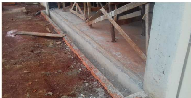
Figura 37C: canaleta em alvenaria - entrada principal
