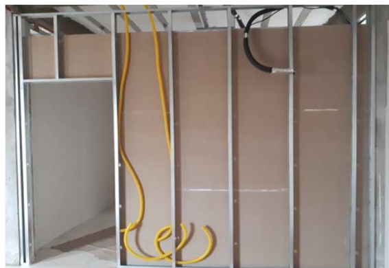
Figura 02E: infraestrutura de eletrodutos - lado direito
