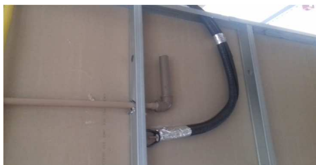
Figura 26C: rede frigorígena e dreno - sala de testemunhas
