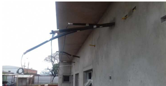
Figura 32C: redes frigorígenas saindo para a lateral esquerda
