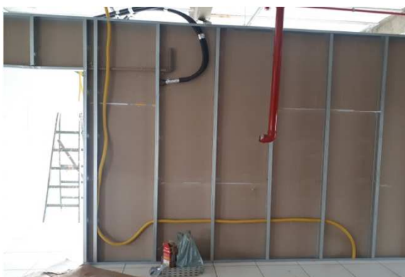
Figura 05E: infraestrutura de eletrodutos - lado direito
