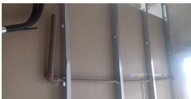
Figura 27C: rede frigorígena e dreno - sala de conciliação
