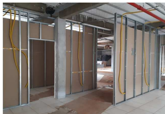
Figura 04E: infraestrutura de eletrodutos - lado direito
