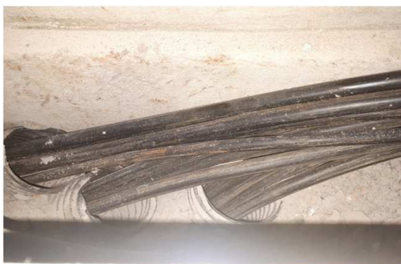
Figura 13E: cabos 120mm 2 e 70mm 2 - entrada de energia e alimentação QDG
