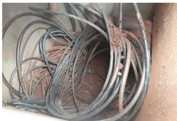
Figura 18E: cabos 120mm 2 e 70mm 2 - entrada de energia e alimentação QDG
