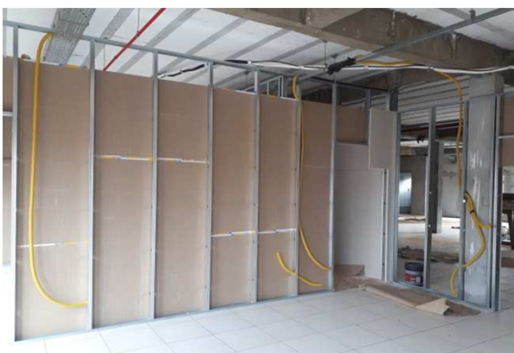
Figura 03E: infraestrutura de eletrodutos - lado direito
