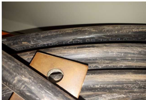
Figura 12E: cabos 120mm 2 e 70mm 2 - entrada de energia e alimentação QDG
