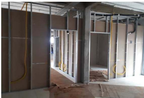
Figura 01E: infraestrutura de eletrodutos - lado direito
