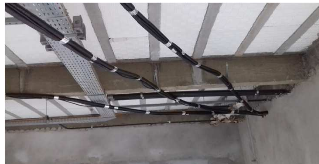
Figura 30C: rede frigorígena saindo para a área externa - bloco esquerdo
