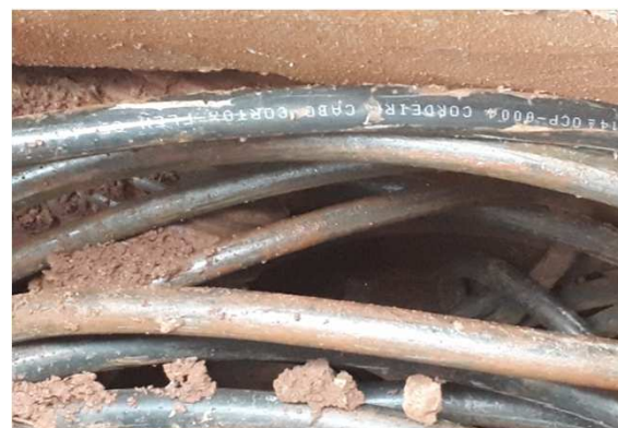
Figura 16E: cabos 120mm 2 e 70mm 2 - entrada de energia e alimentação QDG
