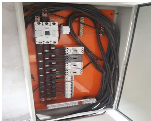
Figura 11E: cabos 120mm 2 e 70mm 2 - entrada de energia e alimentação QDG
