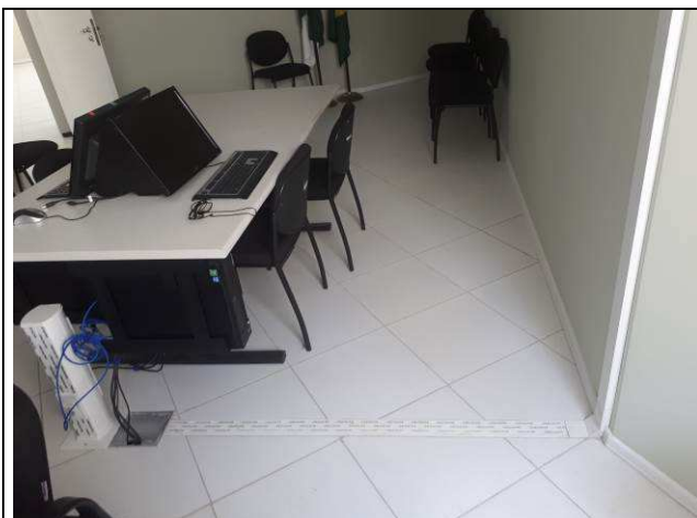
Figura 01E: canaletas embutidas no piso - sala de audiências
