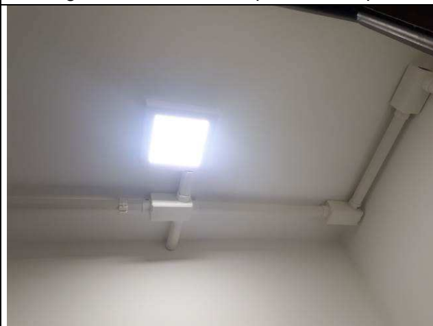
Figura 28E: luminárias plafon sobrepor
