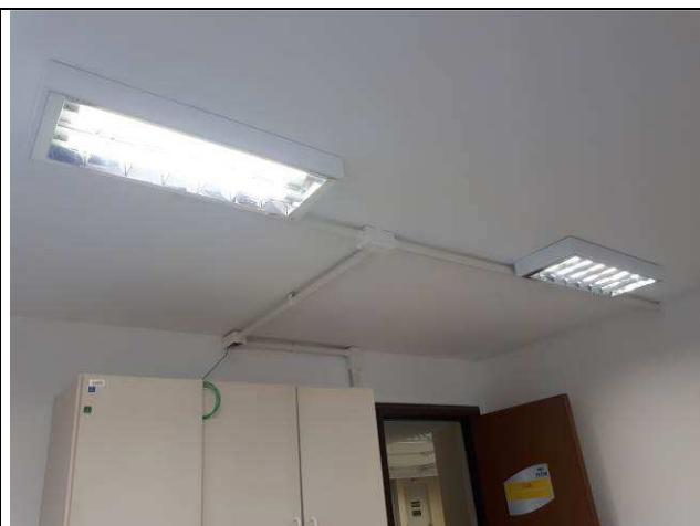
Figura 25E: luminárias 2x16W sobrepor
