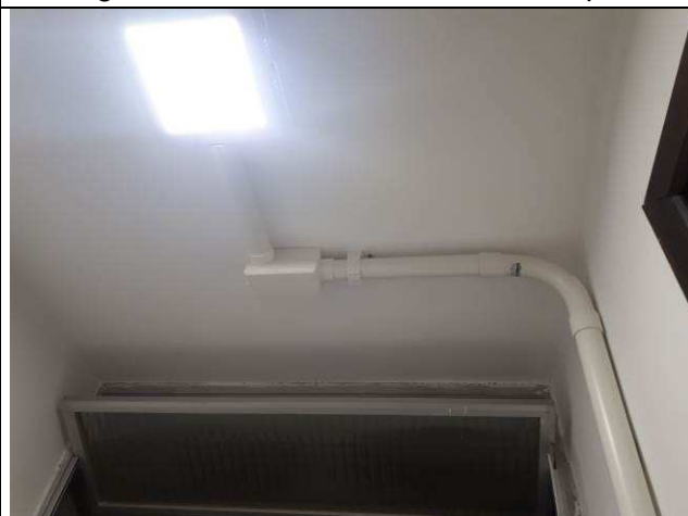
Figura 27E: luminárias plafon sobrepor
