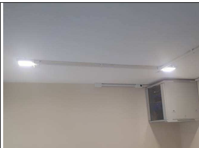
Figura 02E: infraestrutura de condutores, eletrodutos.
