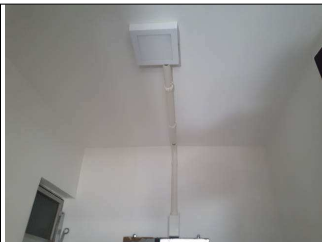
Figura 26E: luminárias plafon sobrepor
