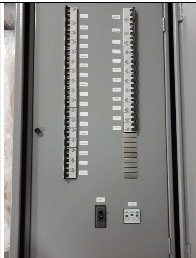
Figura 42E: Quadro elétrico QDAR2 - fundos do ed. VM400
