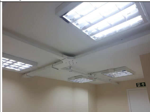
Figura 23E: luminárias 4x16W sobrepor
