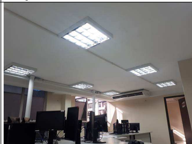
Figura 22E: luminárias 4x16W sobrepor
