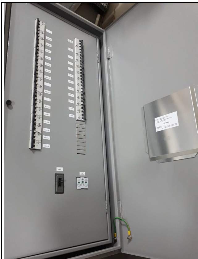
Figura 41E: Quadro elétrico QDAR2 - fundos do ed. VM400
