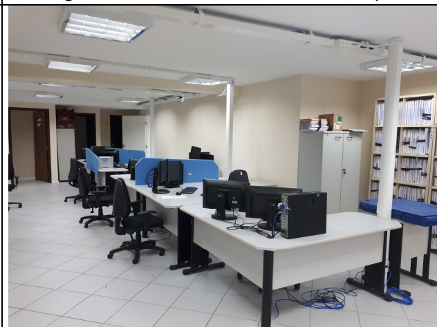
Figura 24E: luminárias 4x16W sobrepor
