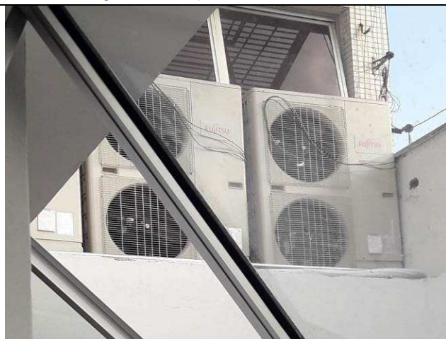
Figura 05C: equipamentos de ar condicionado instalados.
