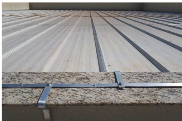
Figura 19E: SPDA tipo Faraday, fitas alumínio, descidas, curvas, fixação
