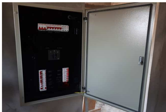
Figura 06E: Quadro QDEG
