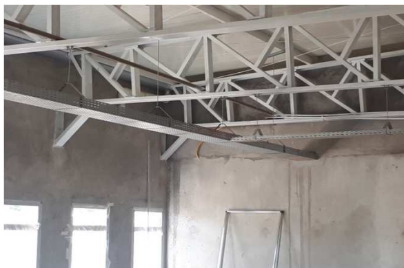
Figura 01E: infraestrutura de eletrocalhas área central
