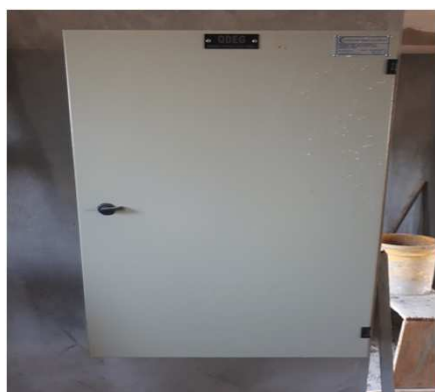
Figura 05E: Quadro QDEG
