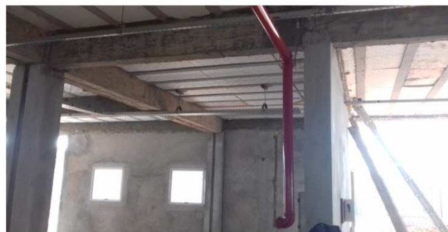
Figura 36C: local de hidrante - bloco central
