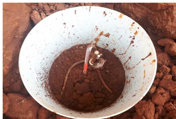
Figura 14E: malha de aterramento, cabo cobre nu, descidas, haste, caixa inspeção
