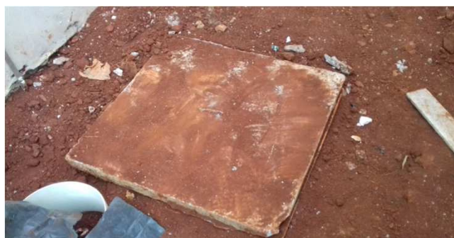
Figura 20C: caixa de inspeção de esgoto 60x60mm
