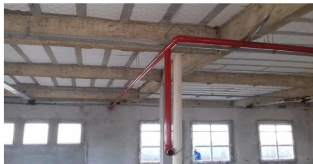
Figura 34C: local de instalação de hidrante - bloco da esquerda
