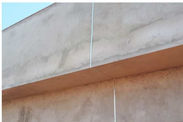
Figura 25E: SPDA tipo Faraday, fitas alumínio, descidas, curvas, fixação
