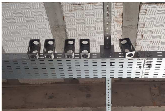
Figura 28E: infraestrutura interna rede lógica
