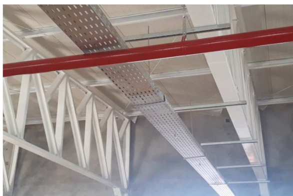
Figura 03E: infraestrutura de eletrocalhas área central
