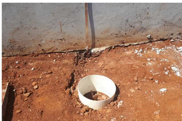
Figura 17E: malha de aterramento, cabo cobre nu, descidas, haste, caixa inspeção
