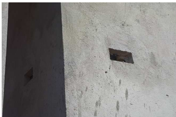
Figura 27E: infraestrutura CFTV
