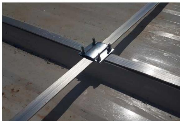
Figura 20E: SPDA tipo Faraday, fitas alumínio, descidas, curvas, fixação
