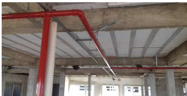
Figura 35C: tubos e conexões de incêndio - bloco da direita
