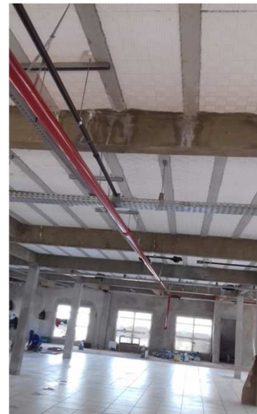
Figura 32C: tubulação de incêndio - bloco da esquerda
