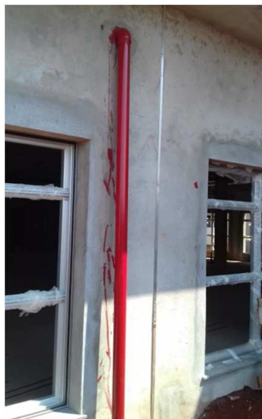
Figura 30C: trecho vertical de tubulação de incêndio - caminho para o hid. externo
