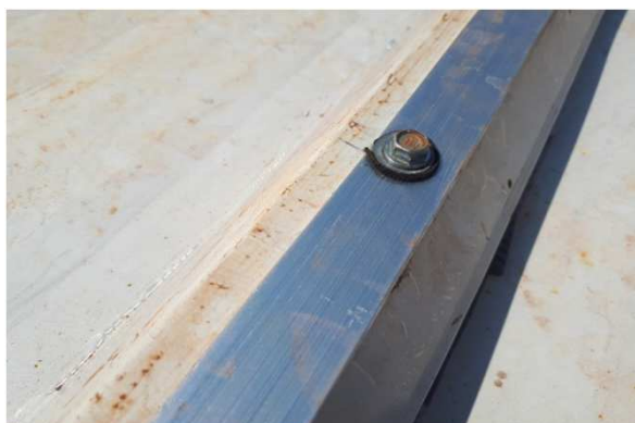
Figura 23E: SPDA tipo Faraday, fitas alumínio, descidas, curvas, fixação
