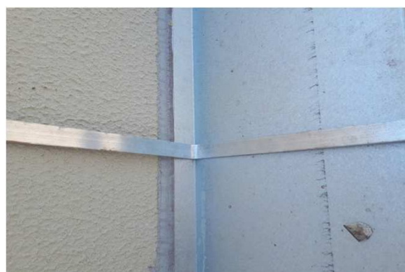
Figura 24E: SPDA tipo Faraday, fitas alumínio, descidas, curvas, fixação
