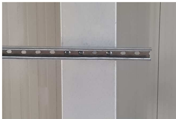
Figura 02E: infraestrutura de eletrocalhas área central
