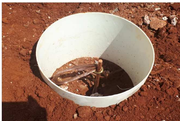
Figura 15E: malha de aterramento, cabo cobre nu, descidas, haste, caixa inspeção
