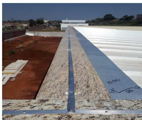
Figura 22E: SPDA tipo Faraday, fitas alumínio, descidas, curvas, fixação
