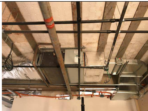
Figura 48C: Evaporadora - 4,0HP - 1ª Vara.
