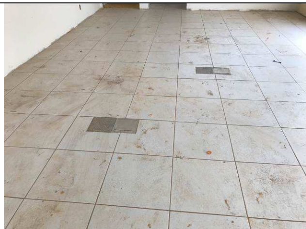
Figura 40C: Piso cerâmico - caixas de piso - salas de audiências.
