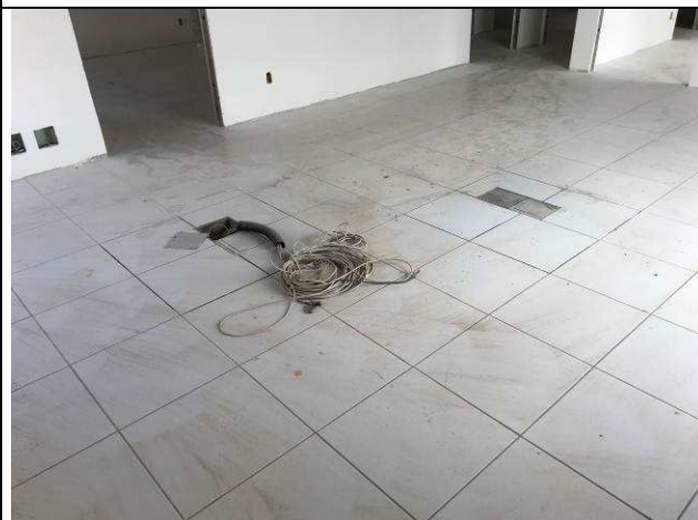
Figura 43C: Piso cerâmico - caixas de piso - salas de audiências.
