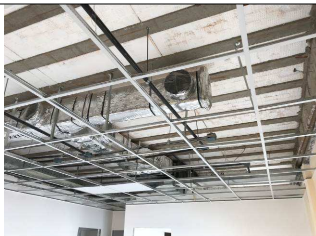
Figura 18C: Perfis metálicos do forro modular removível - 1ª Vara.
