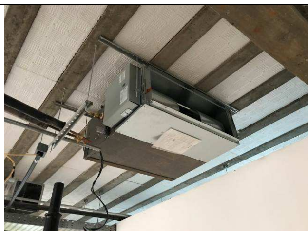
Figura 54C: Evaporadora - 4,0HP - 3ª Vara.
