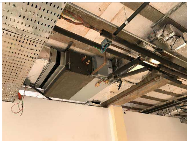
Figura 50C: Evaporadora - 4,0HP - 1ª Vara.
