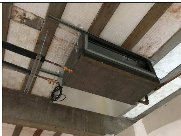
Figura 52C: Evaporadora - 4,0HP - 2ª Vara.
