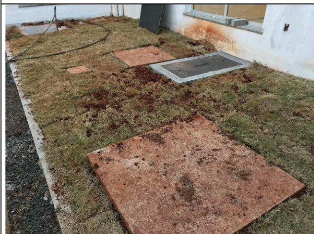
Figura 60C: Grama plantada - área das condensadoras de ar condicionado.
