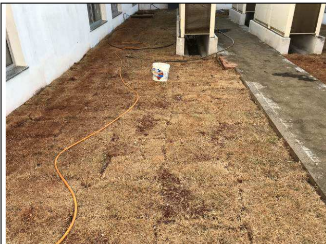
Figura 58C: Grama plantada - área das condensadoras de ar condicionado.
