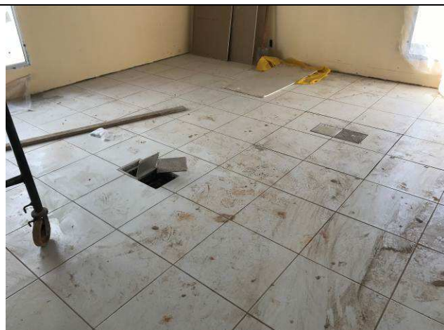
Figura 42C: Piso cerâmico - caixas de piso - salas de audiências.
