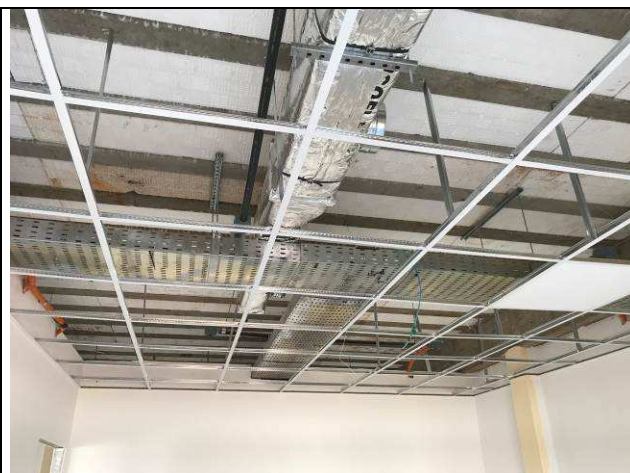
Figura 19C: Perfis metálicos do forro modular removível - 1ª Vara.
