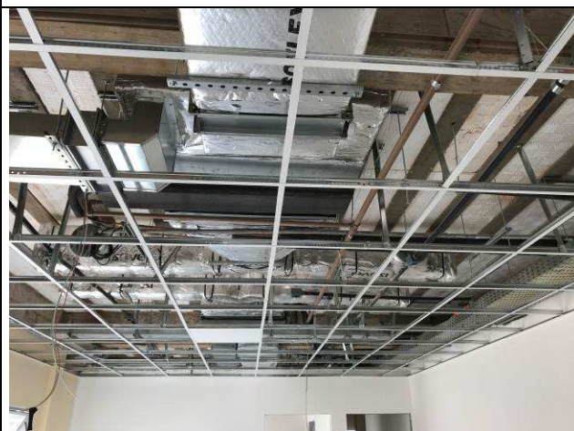
Figura 23C: Perfis metálicos do forro modular removível - 1ª Vara.
