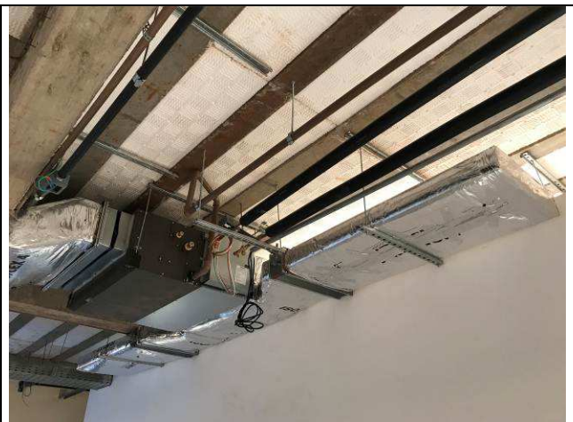
Figura 49C: Evaporadora - 4,0HP - 1ª Vara.
