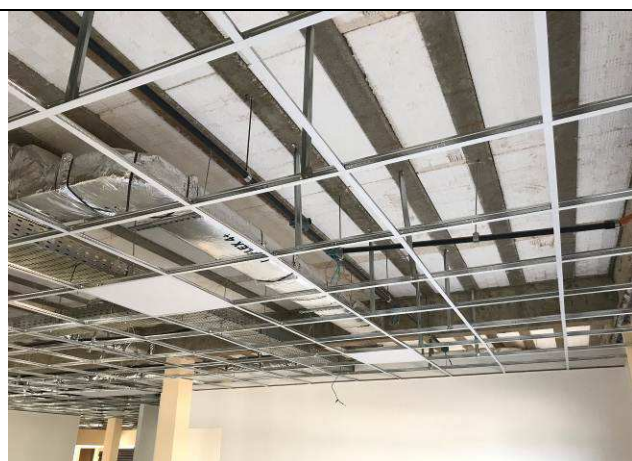
Figura 20C: Perfis metálicos do forro modular removível - 1ª Vara.
