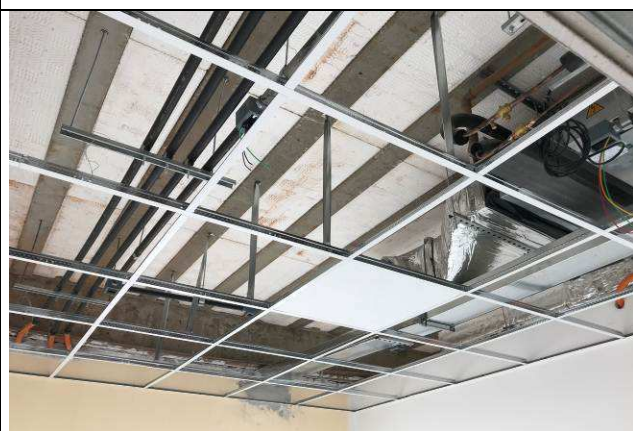
Figura 17C: Perfis metálicos do forro modular removível - 1ª Vara.
