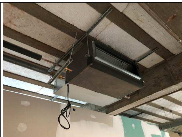
Figura 53C: Evaporadora - 4,0HP - 2ª Vara.
