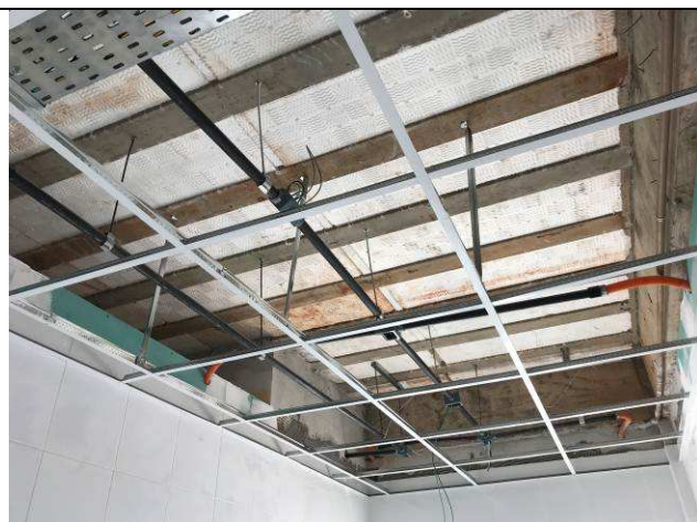
Figura 22C: Perfis metálicos do forro modular removível - 1ª Vara.
