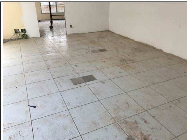
Figura 41C: Piso cerâmico - caixas de piso - salas de audiências.
