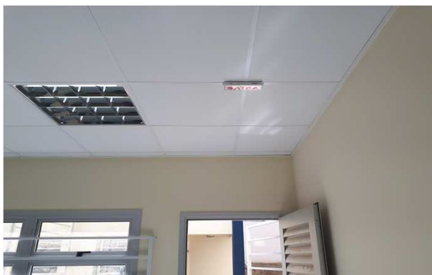
Figura 13E: Luminárias, sensores, blocos de emergência.
