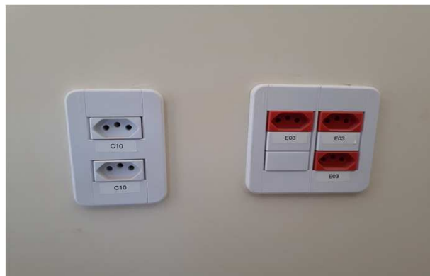
Figura 08E: Tomadas elétricas
