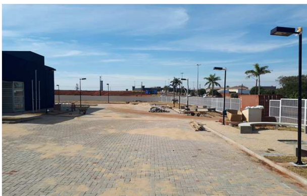
Figura 19E: Luminárias externas
