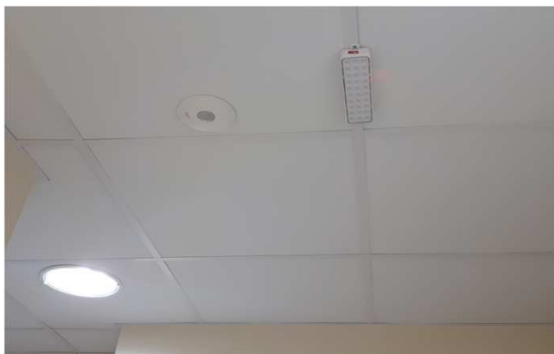
Figura 09E: Luminárias, sensores, blocos de emergência.
