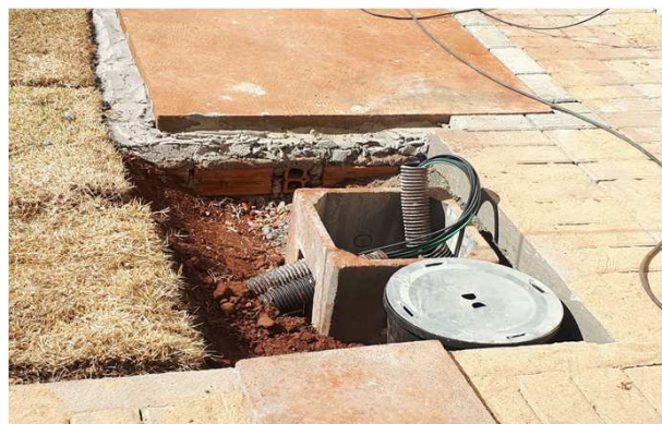
Figura 06E: Cabos elétricos e Infraestrutura externa
