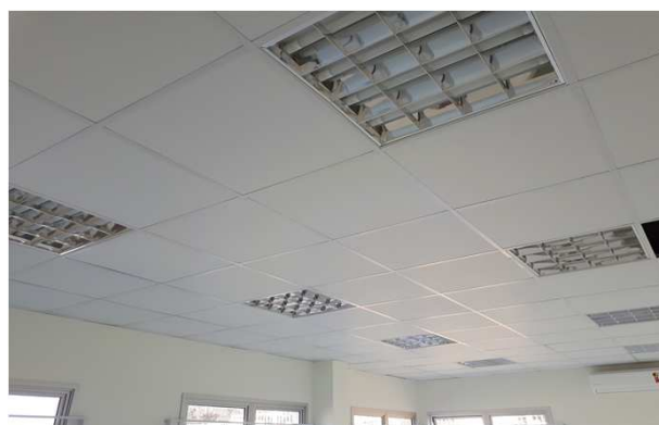
Figura 12E: Luminárias, sensores, blocos de emergência.
