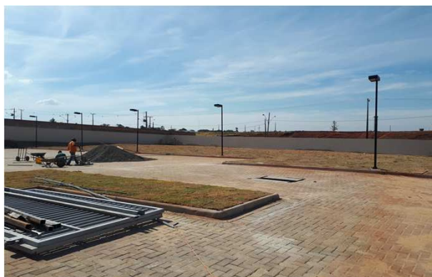
Figura 20E: Luminárias externas
