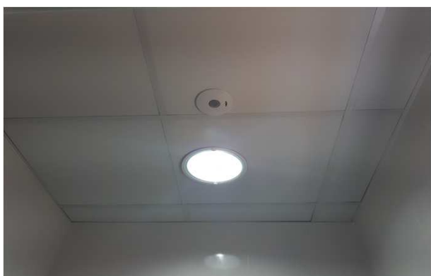
Figura 11E: Luminárias, sensores, blocos de emergência.
