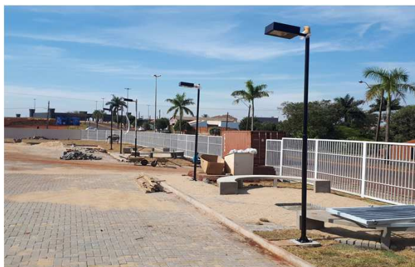
Figura 18E: Luminárias externas
