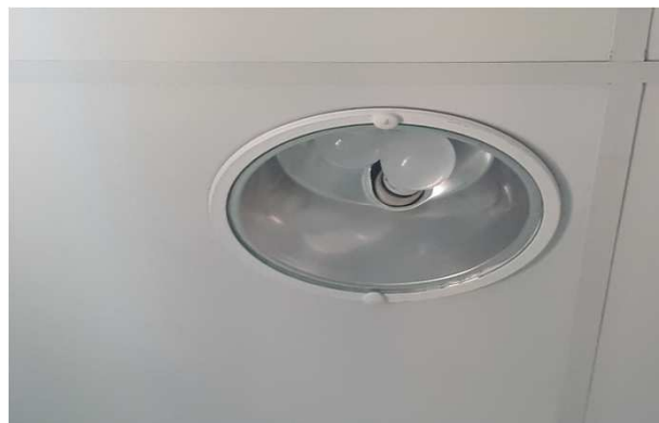
Figura 10E: Luminárias, sensores, blocos de emergência.
