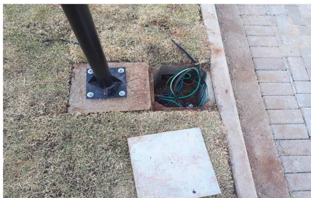
Figura 05E: Cabos elétricos e Infraestrutura externa
