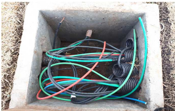
Figura 07E: Cabos elétricos e Infraestrutura externa
