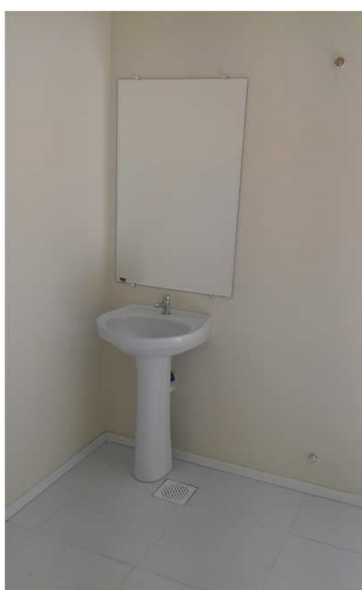
Figura 64C: lavatório com coluna - sala de perícias
