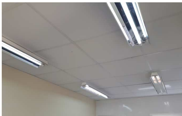
Figura 14E: Luminárias, sensores, blocos de emergência.
