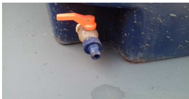
Figura 30C: saída de água para alimentação com reúso
