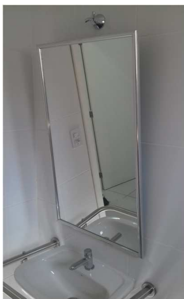
Figura 31C: espelho inclinado instalado em san. PNE
