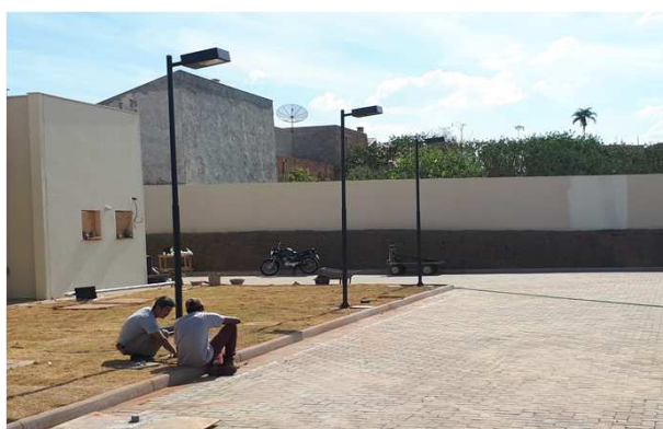
Figura 22E: Luminárias externas
