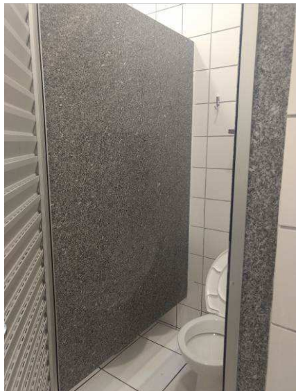
Figura 11c: Divisórias sanitárias em granito
