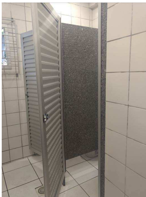
Figura 14c: divisórias em granito/portas em alumínio
