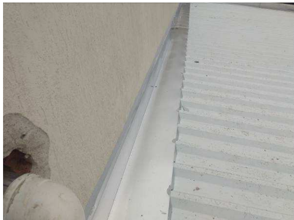
Figura 03c: Calhas em alumínio
