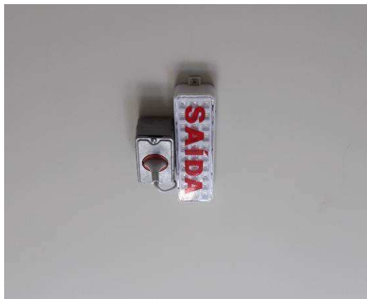
Figura 12E: Luminária de emergência
