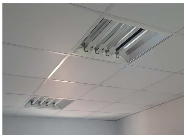
Figura 18E: Luminárias 4x16W sem aletas
