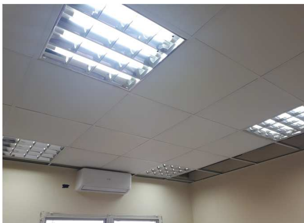
Figura 16E: Luminárias 4x16W com aletas
