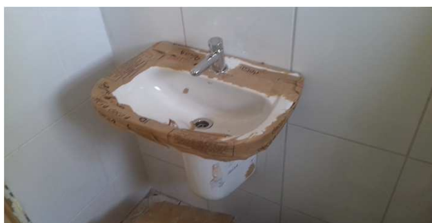
Figura 30C: lavatório PNE e torneira, instalados no banheiro da secretaria
