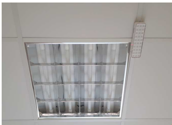
Figura 17E: Luminárias 4x16W com aletas
