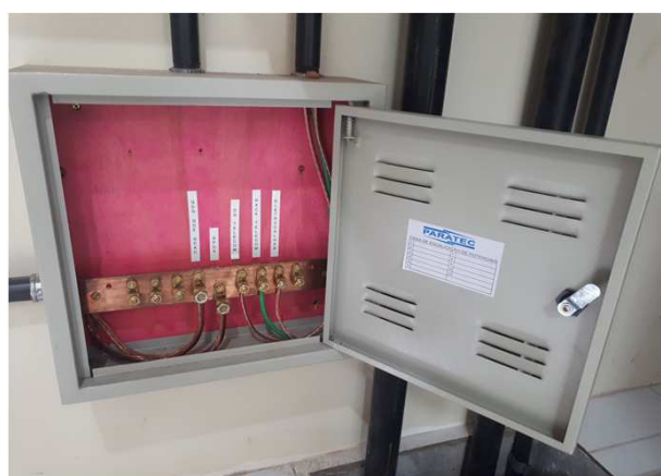
Figura 33E: Quadro BEP
