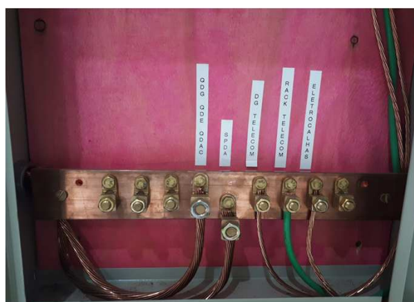
Figura 34E: Quadro BEP
