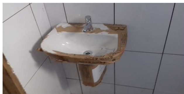
Figura 29C: lavatório PNE e torneira, instalado s no banheiro público
