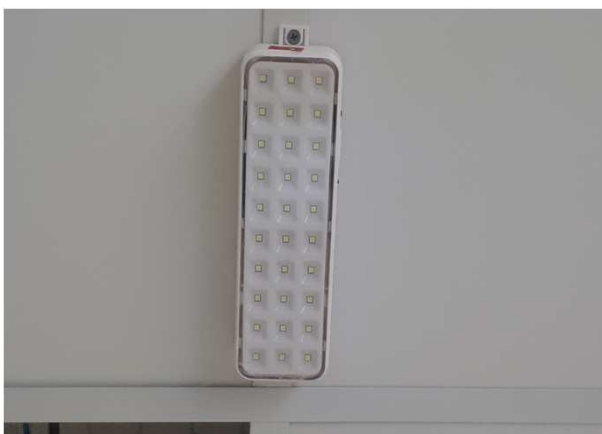
Figura 19E: blocos de emergência
