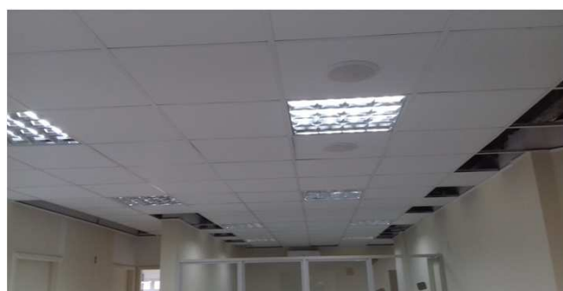
Figura 18C: forro modular instalado no atendimento
