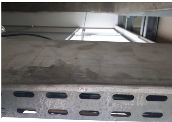
Figura 01E: Eletrocalhas tampadas
