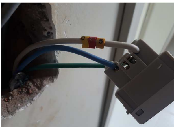
Figura 05E: Cabos elétricos área interna - concluídos
