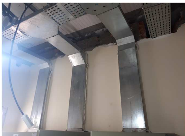
Figura 03E: Eletrocalhas tampadas
