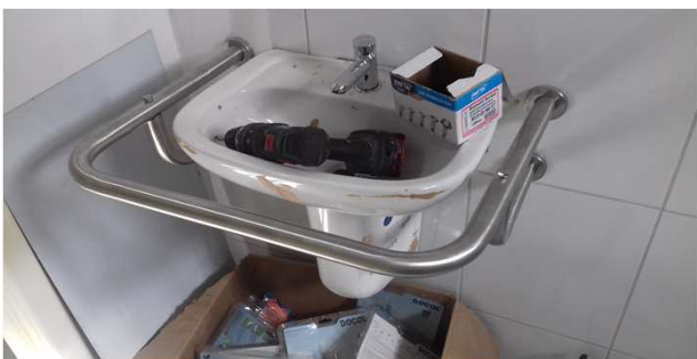
Figura 33C: barra de apoio instalada junto a lavatório PNE
