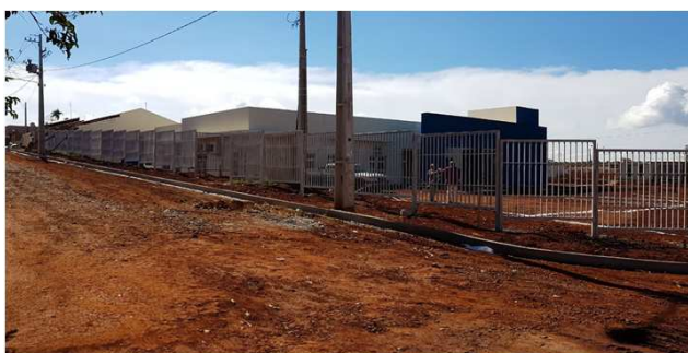
Figura 48C: visão ampla do gradil instalado na lateral esquerda
