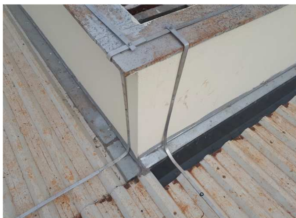
Figura 30E: Sistema de captação SPDA - fitas de alumínio.
