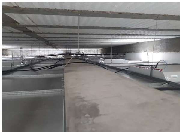
Figura 02E: Eletrocalhas tampadas
