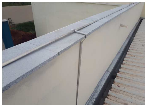
Figura 31E: Sistema de captação SPDA - fitas de alumínio.
