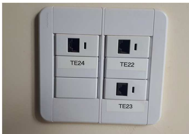
Figura 35E: Conectores RJ45 cat6
