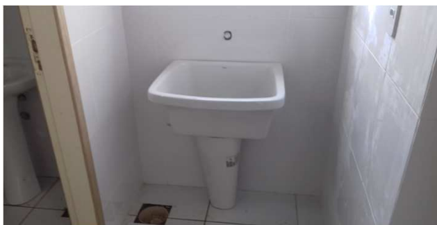
Figura 31C: tanque de louça, instalado na área de serviço do arquivo
