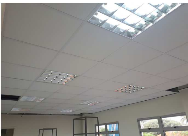
Figura 15E: Luminárias 4x16W com aletas
