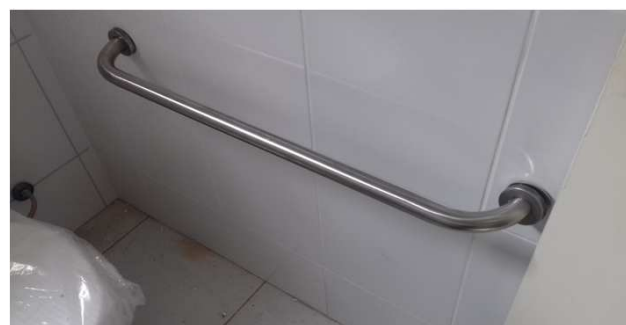
Figura 36C: barra de apoio para vaso sanitário - sanitário PNE da secretaria
