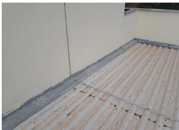
Figura 29E: Sistema de captação SPDA - fitas de alumínio.
