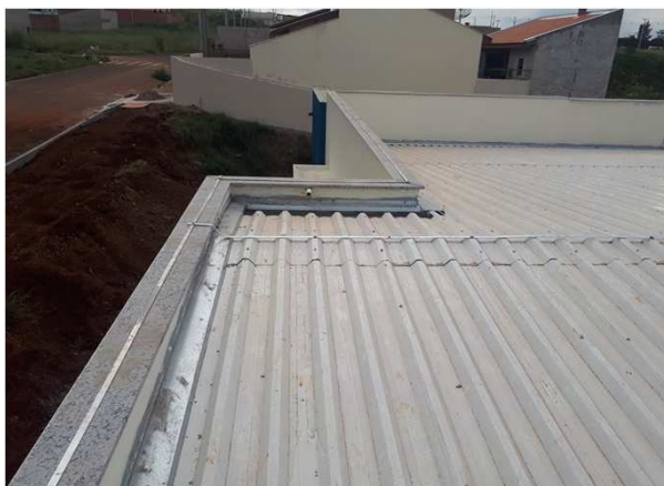
Figura 32E: Sistema de captação SPDA - fitas de alumínio.
