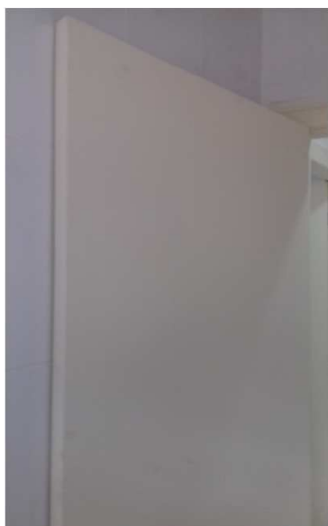
Figura 07C: Porta de sanitário da secretaria
