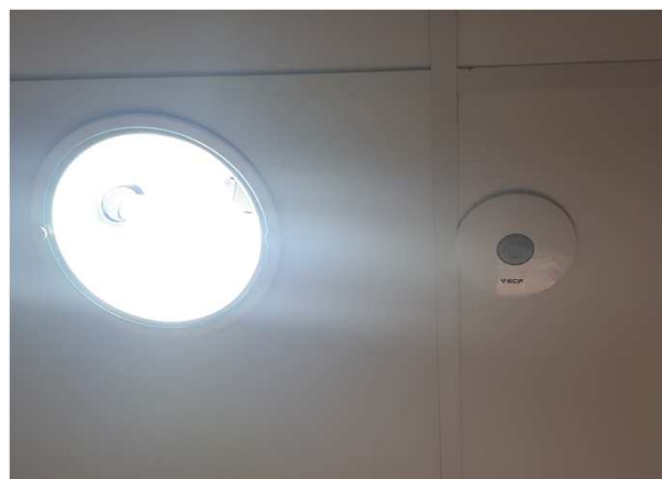
Figura 21E: luminárias com difusor e sensor de presença
