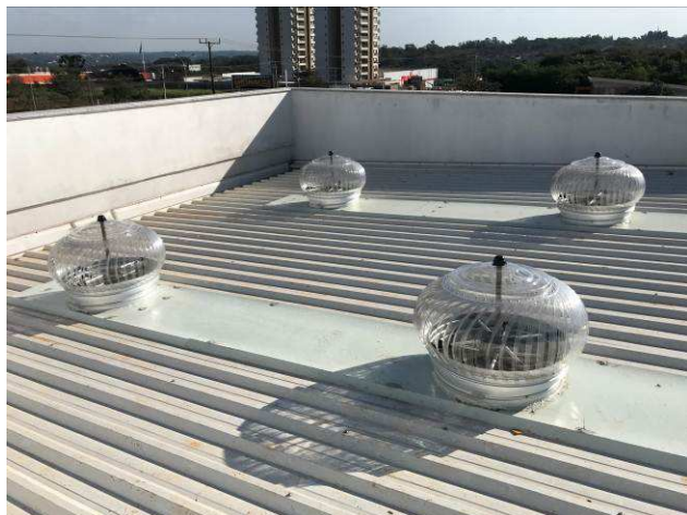
Figura 43C: Exaustores eólicos - vista externa - Fórum.
