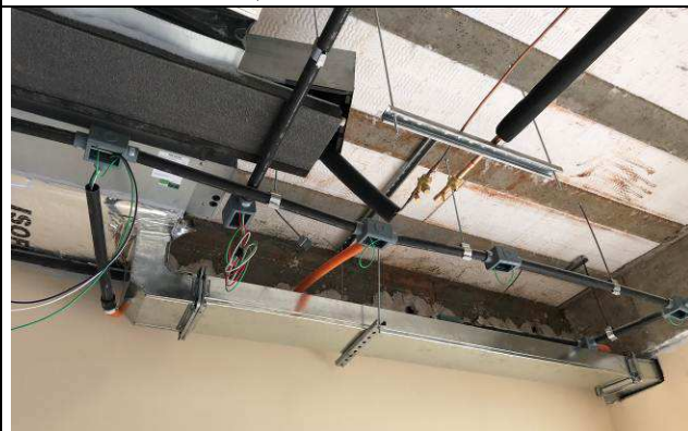
Figura 72C: Duto de captação de ar externo - 1ª Vara.
