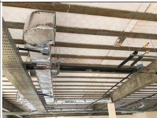
Figura 80C: Duto de insuflamento de ar frio - 2ª Vara.
