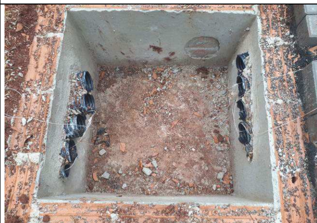
Figura 03E: infraestrutura externa dutos e caixas para entrada de energia.
