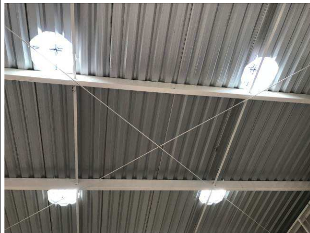
Figura 44C: Exaustores eólicos - vista interna - Fórum.
