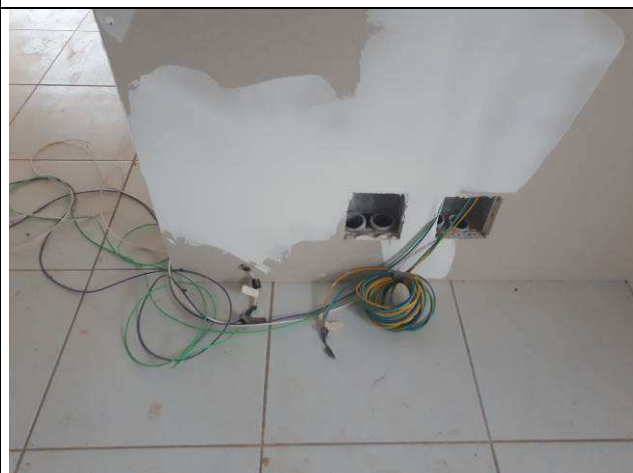
Figura 24E: cabeamento elétrico #2,5mm 2 quadrante frontal lado direito.
