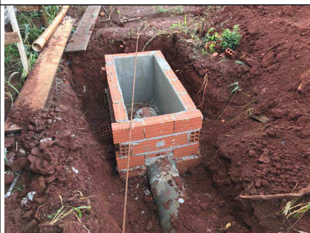
Figura 62C: Rede de drenagem de águas pluviais - tubulações e caixas.
