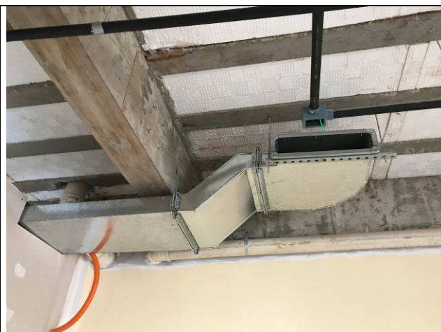
Figura 76C: Duto de captação de ar externo - 1ª Vara.
