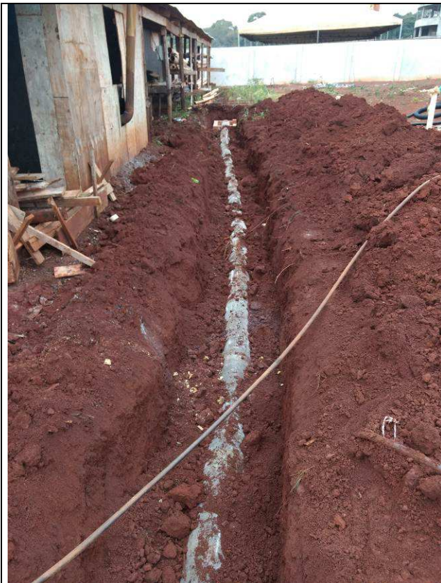
Figura 59C: Rede de drenagem de águas pluviais - tubulações e caixas.
