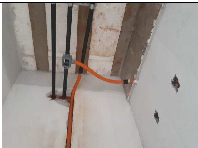
Figura 19E: eletrodutos rígidos, eletrodutos corrugados, unidut, conduletes.
