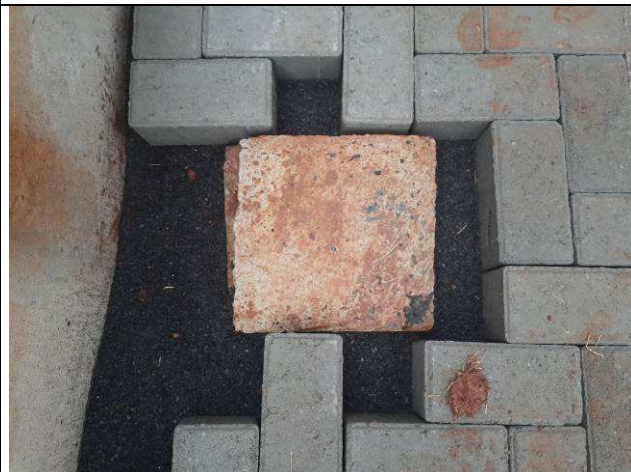
Figura 10E: caixas de inspeção de aterramento.
