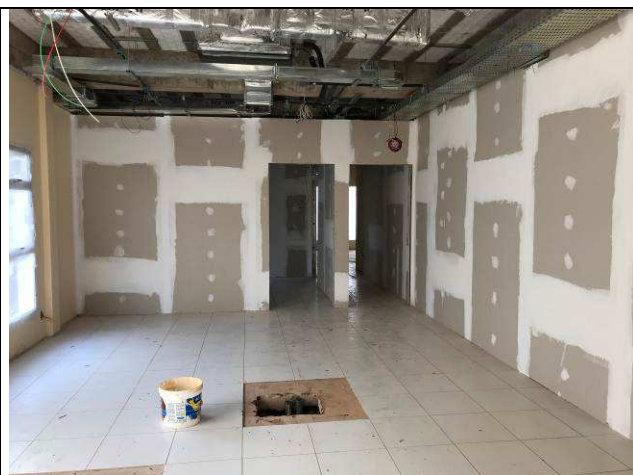
Figura 15C: Paredes de gesso acartonado - sala de audiências e conciliação - 1ª Vara.
