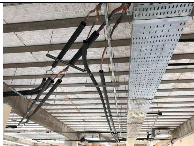
Figura 88C: Rede frigorígena - Área de apoio.
