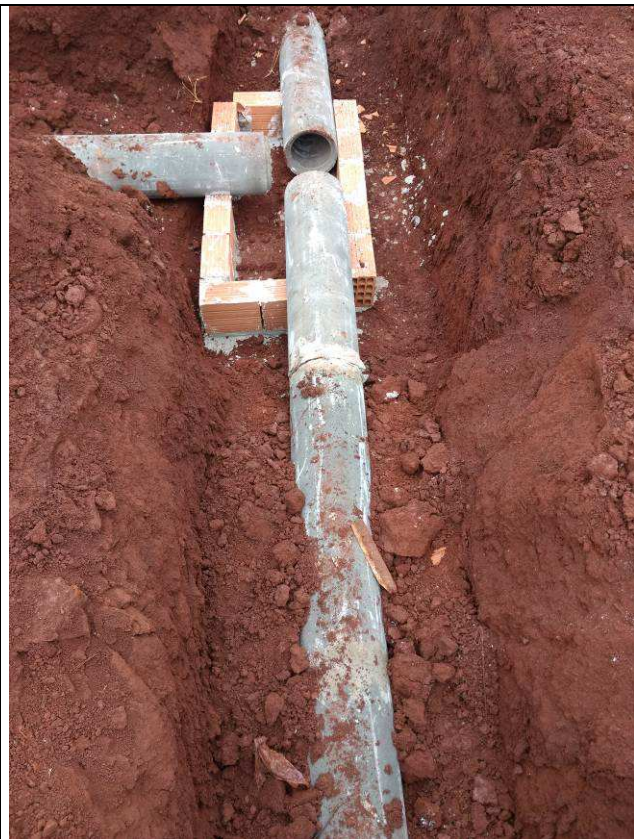
Figura 60C: Rede de drenagem de águas pluviais - tubulações e caixas.
