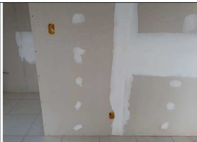
Figura 14E: caixas 2x4" e 4x4" embutidas em drywall.
