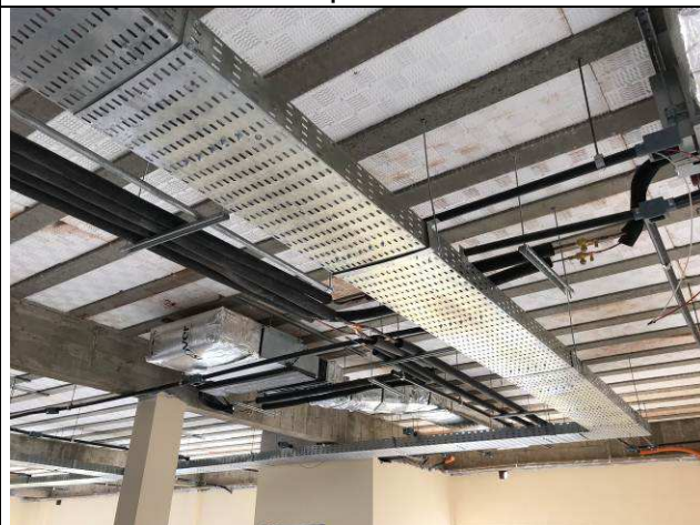
Figura 92C: Rede frigorígena - Área de apoio.
