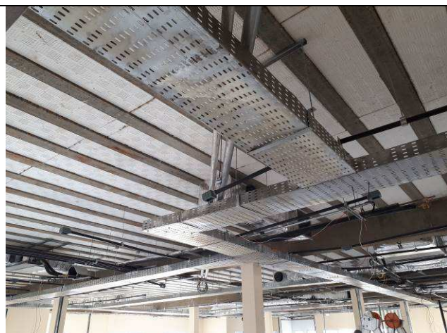
Figura 23E: eletrodutos em FG para alimentadores quadros parciais.
