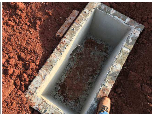
Figura 64C: Rede de drenagem de águas pluviais - tubulações e caixas.
