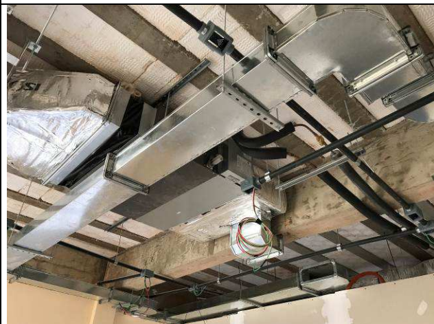
Figura 74C: Duto de captação de ar externo - 1ª Vara.
