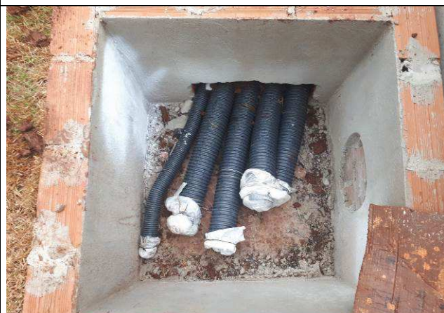
Figura 04E: infraestrutura externa dutos e caixas para entrada de energia.
