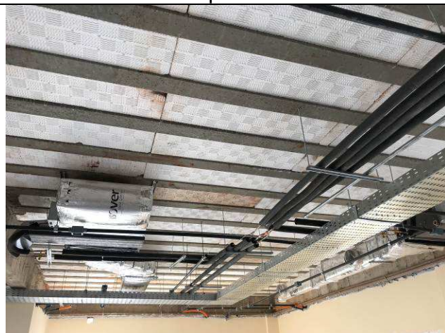
Figura 91C: Rede frigorígena - Área de apoio.
