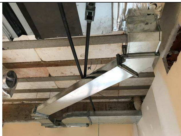
Figura 75C: Duto de captação de ar externo - 1ª Vara.
