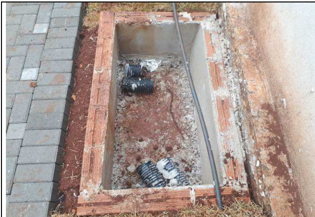
Figura 29E: infraestrutura externa entrada de telecomunicações.
