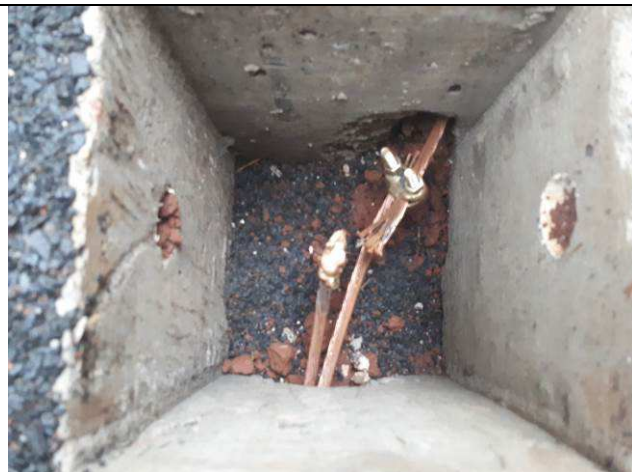
Figura 09E: caixas de inspeção de aterramento.
