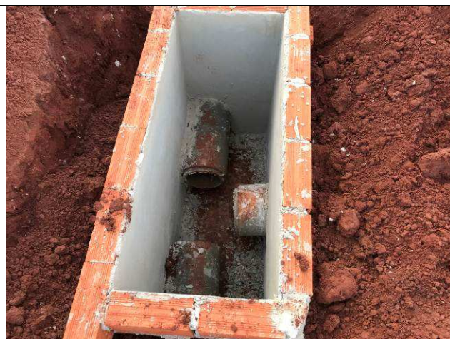
Figura 63C: Rede de drenagem de águas pluviais - tubulações e caixas.
