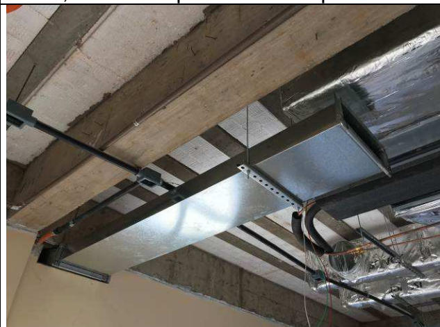
Figura 73C: Duto de captação de ar externo - 1ª Vara.
