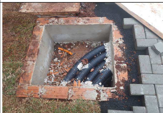
Figura 05E: infraestrutura externa dutos e caixas para entrada de energia.
