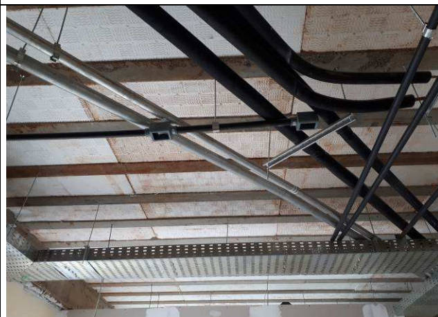
Figura 22E: eletrodutos em FG para alimentadores quadros parciais.
