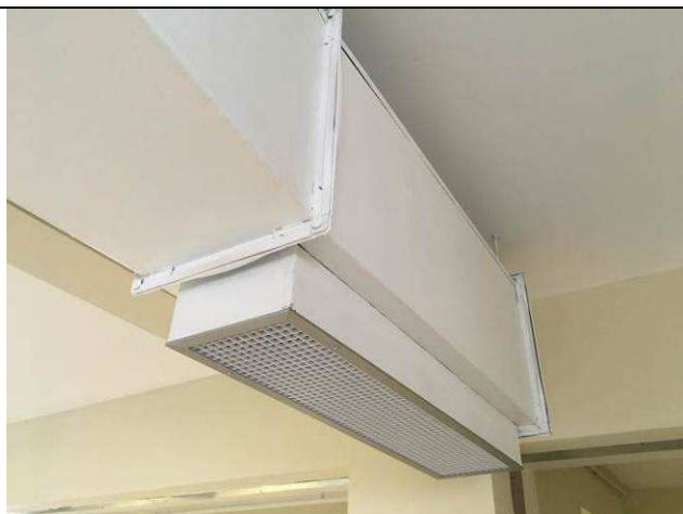
Figura 13C: Duto de insuflamento e exaustão - pintados.
