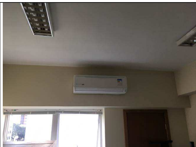
Figura 15C: Equipamento Split, instalado.
