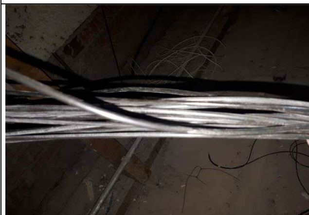
Figura 37E: Cabeamento elétrico ar-condicionado cobertura VM362
