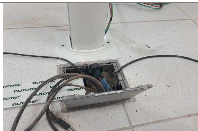
Figura 30E: Caixas de piso Dutotec e cabeamento estruturado
