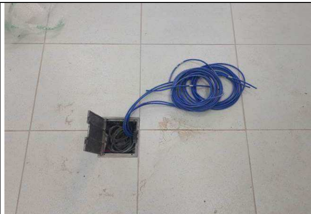
Figura 27E: Caixas de piso Dutotec e cabeamento estruturado
