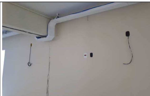
Figura 04E: Pintura eletrocalhas aparentes.
