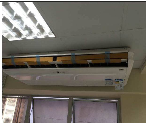
Figura 14C: Equipamento Split, instalado.
