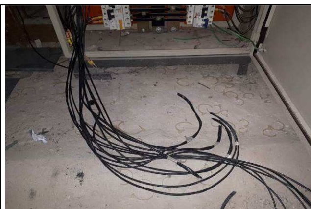
Figura 35E: Cabeamento elétrico ar-condicionado cobertura VM362
