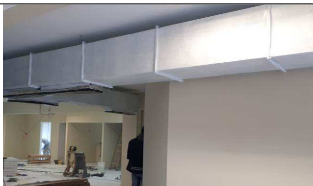
Figura 11C: Duto de insuflamento e exaustão - pintados.
