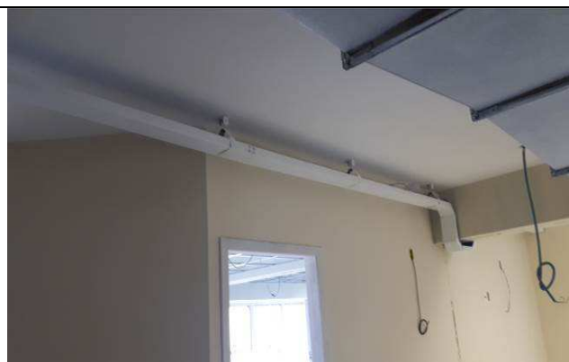
Figura 03E: Pintura eletrocalhas aparentes.
