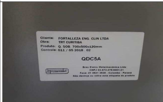
Figura 24E: Quadro QDC5A
