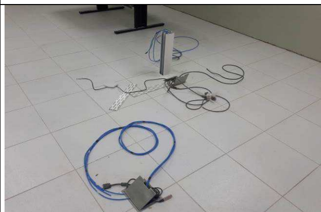
Figura 29E: Caixas de piso Dutotec e cabeamento estruturado
