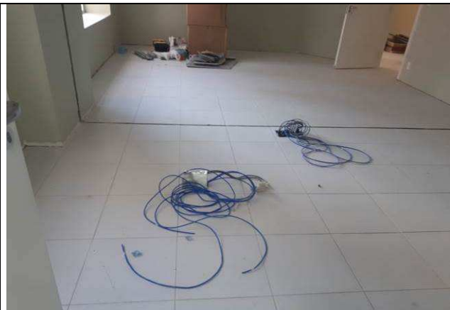
Figura 28E: Caixas de piso Dutotec e cabeamento estruturado
