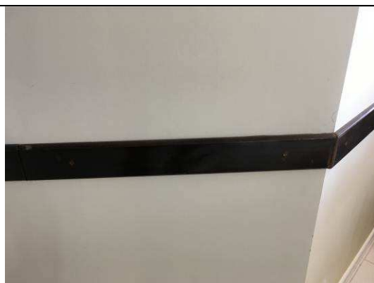
Figura 12C: Pintura em verniz bate macas
