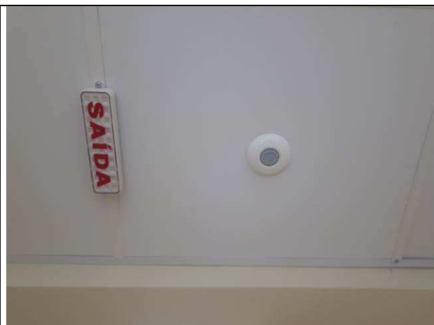
Figura 22E: sensor de presença e bloco de iluminação de emergência
