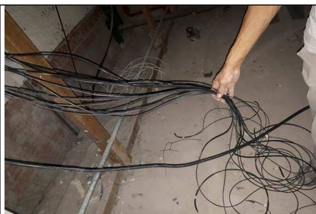
Figura 36E: Cabeamento elétrico ar-condicionado cobertura VM362
