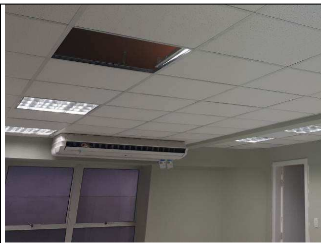
Figura 16C: Equipamento Split, instalado.
