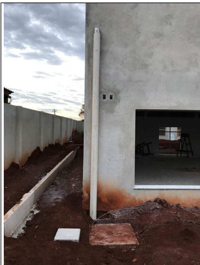
Figura 39C: Captação de águas pluviais - Arquivo.
