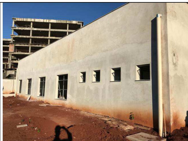
Figura 41C: Captação de águas pluviais - Arquivo.
