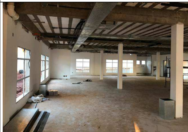
Figura 72C: Paredes com massa PVA - 2ª Vara - Fórum.
