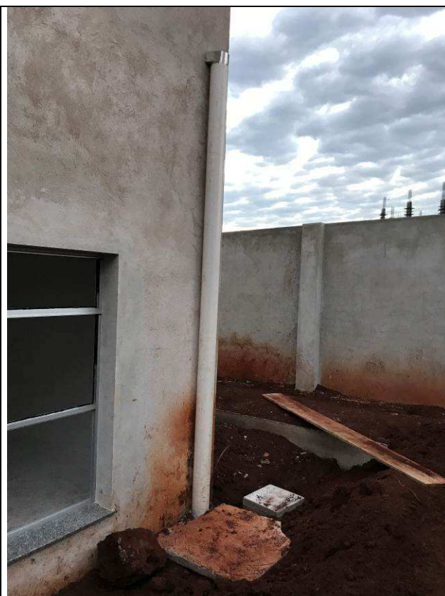
Figura 40C: Captação de águas pluviais - Arquivo.
