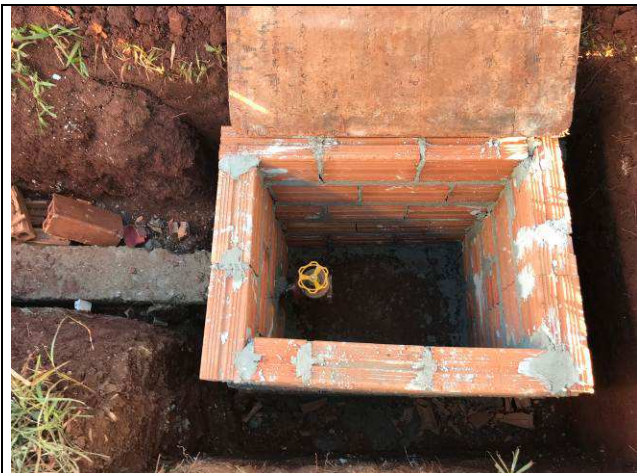
Figura 65C: Caixa e registro - hidrante de recalque.
