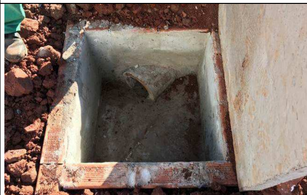
Figura 44C: Caixas águas pluviais - Arquivo.
