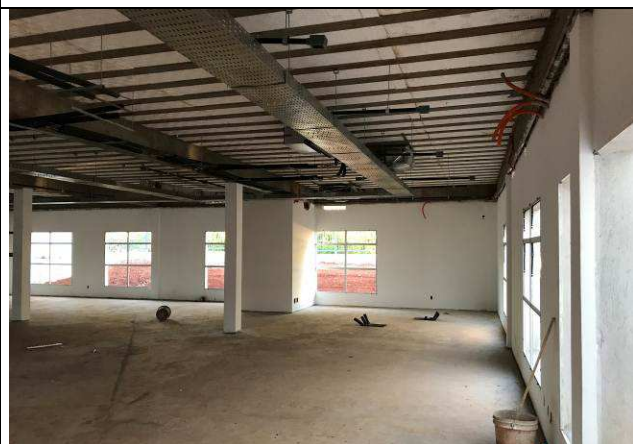
Figura 74C: Paredes com massa PVA - 2ª Vara - Fórum.
