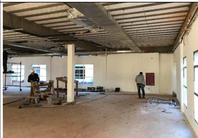
Figura 71C: Paredes com massa PVA - 3ª Vara - Fórum.
