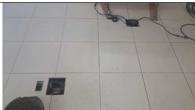
Figura 13E: Infraestrutura de eletrodutos e caixas de piso
