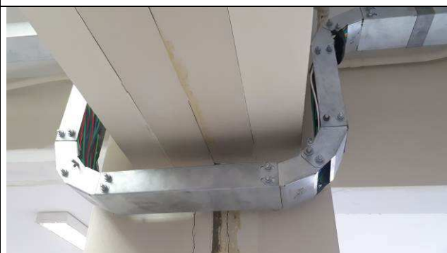
Figura 10E: Infraestrutura de eletrocalhas - desvios nas vigas, eletrocalhas lisa
