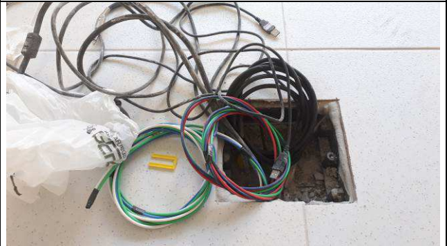
Figura 32E: Caixas de passagem - salas de audiências - cabeamento sonorização
