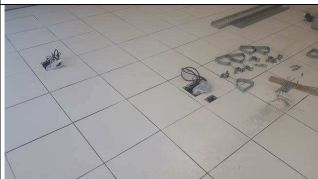
Figura 12E: Infraestrutura de eletrodutos e caixas de piso
