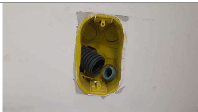
Figura 15E: Infraestrutura de eletrodutos e caixas de parede
