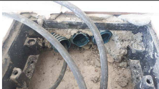
Figura 31E: Caixas de passagem - salas de audiências - cabeamento sonorização
