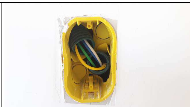
Figura 20E: Cabeamento elétrico - identificação de circuitos, cores padrão
