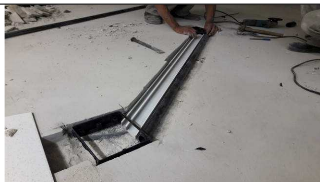
Figura 25E: Canaletas Dutotec instaladas no piso das salas de audiências
