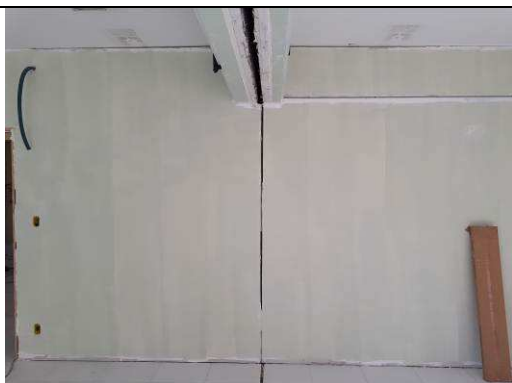
Figura 13C: Foi aplicado fundo selador látex pva em paredes, uma demão em divisória de gesso acartonado novo, e emassamento com massa pva em divisória de gesso acartonado nova e nas aberturas de vão em alvenaria.
