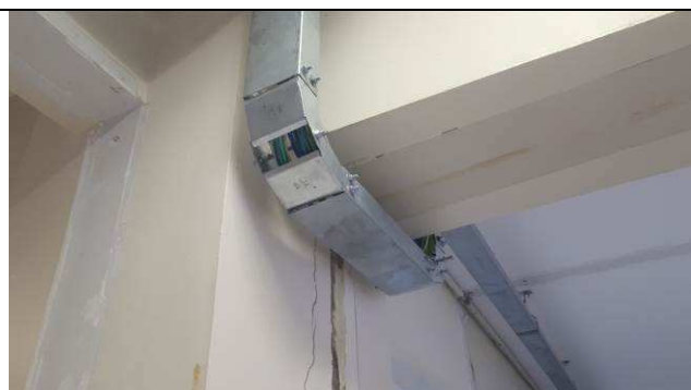
Figura 09E: Infraestrutura de eletrocalhas - desvios nas vigas, eletrocalhas lisa
