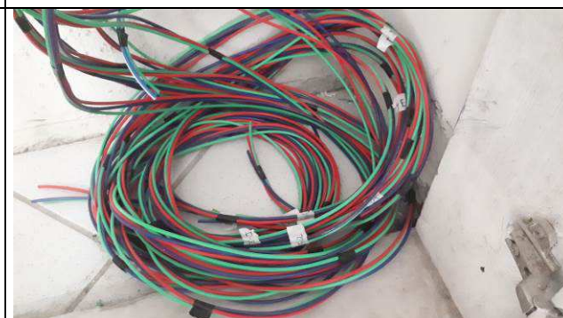
Figura 24E: Cabeamento elétrico - Circuitos rede estabilizada
