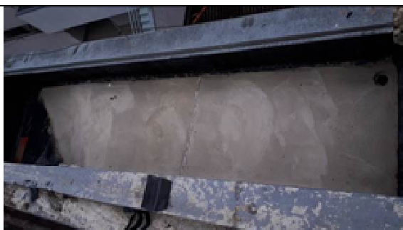
Figura 01C: Finalizada a proteção mecânica, sobre a manta asfáltica foi aplicada camada de proteção mecânica em argamassa.
