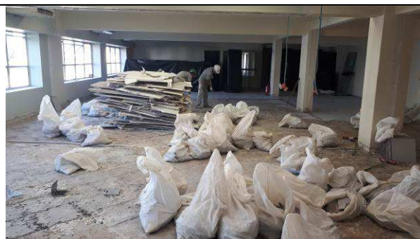
Figura 04C: Foram removidas todas as divisórias em gesso acartonado e esquadrias de madeira. Aconteceu a demolição do forro de gesso e piso cerâmico na 1ª e 2ª VT.
