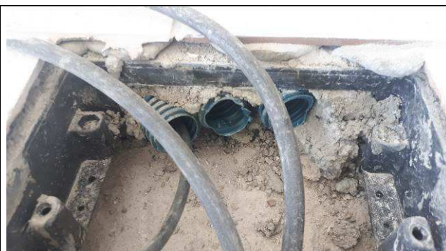
Figura 14E: Infraestrutura de eletrodutos e caixas de piso
