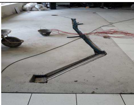
Figura 03E: Rasgos no contrapiso das salas de audiências
