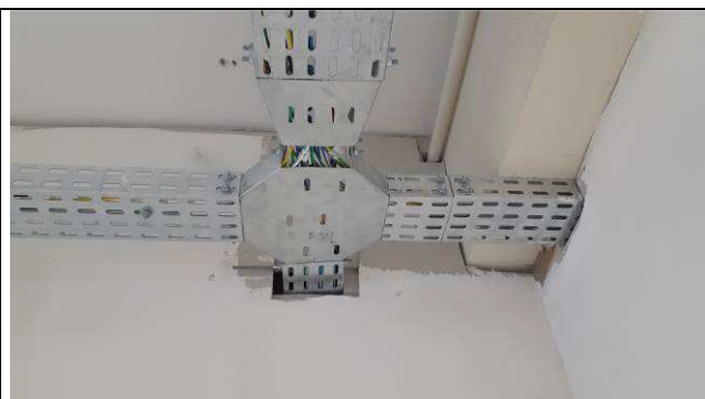
Figura 08E: Infraestrutura de eletrocalhas - cruzetas, tes, redutores
