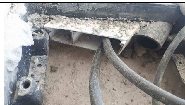
Figura 26E: Canaletas Dutotec instaladas no piso das salas de audiências
