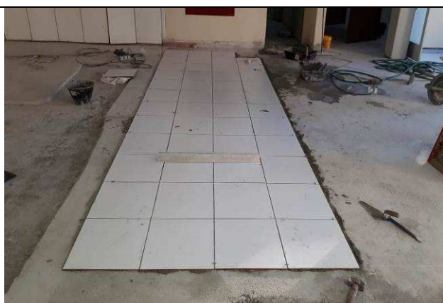
Figura 05C: Assentamento de pisos cerâmico 45x 45, assentado com argamassa colante ACI e rejunte flexível.
