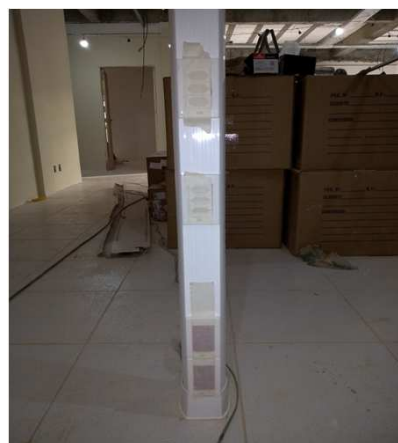
Figura 12E: infraestrutura interna - eletrocalhas, eletrodutos
