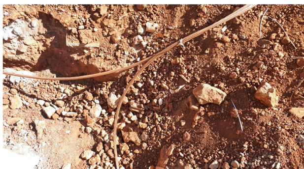
Figura 16E: Sistema de captação SPDA - fitas de alumínio.
