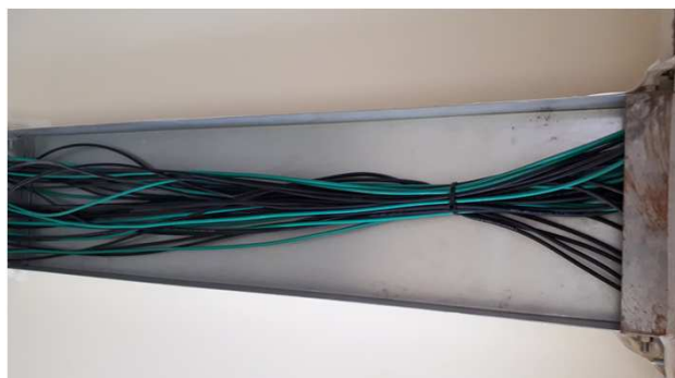
Figura 10E: infraestrutura externa
