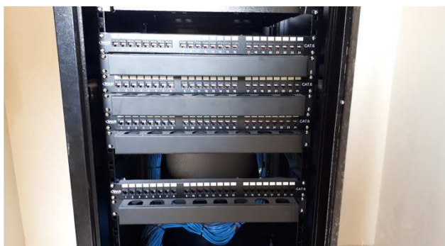
Figura 29E: cabecamento lógico UTP cat6, rack
