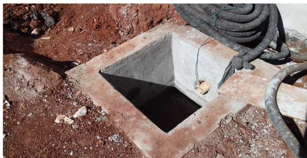
Figura 43C: caixa de inspeção de esgoto 60x60cm
