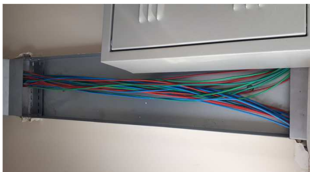
Figura 09E: infraestrutura externa
