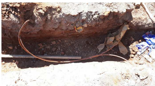
Figura 18E: Sistema de captação SPDA - fitas de alumínio.
