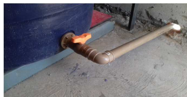
Figura 37C: tubo de 32mm e registro de esfera de 1", na saída de limpeza de reservatório
