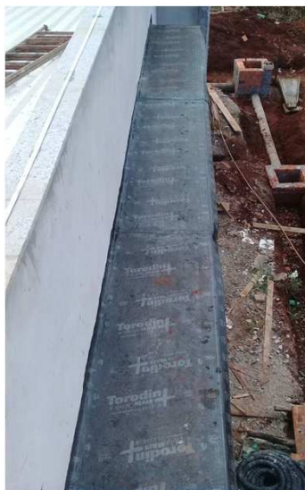
Figura 18C: marquize lateral direita, impermeabilizada
