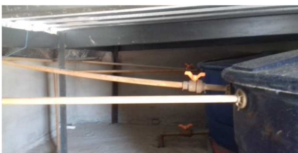
Figura 36C: registros de esfera de 3/4", e tubos de 25mm na entrada dos reservatórios
