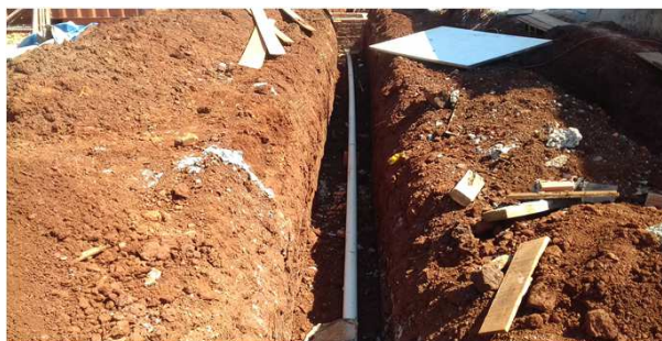
Figura 41C: tubulação de esgoto 100mm
