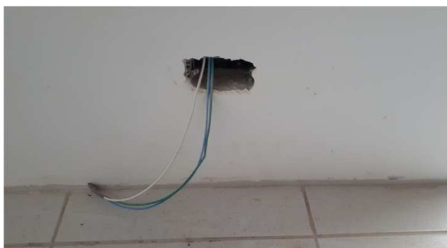
Figura 01E: entrada de energia elétrica e telecomunicações
