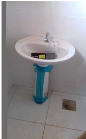
Figura 54C: lavatório em sanitário público
