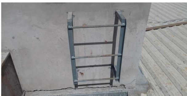
Figura 61C: escada instalada no acesso ao reservatório
