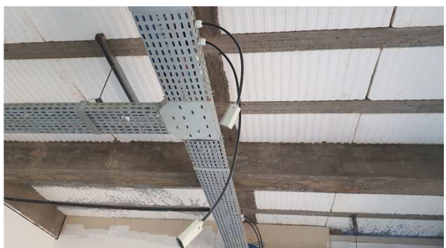
Figura 07E: entrada de energia elétrica e telecomunicações
