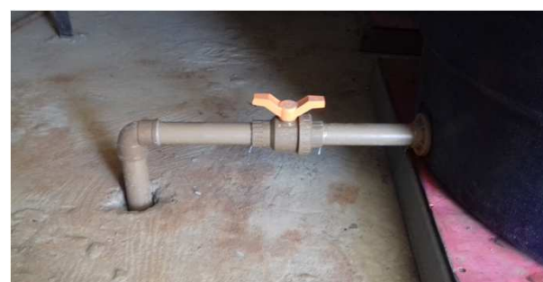
Figura 35C: tubo de 50mm e registro de esfera de 2", na alimentação da rede interna
