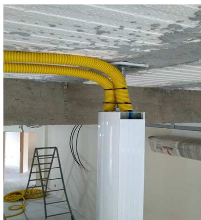
Figura 11E: infraestrutura interna - eletrocalhas
