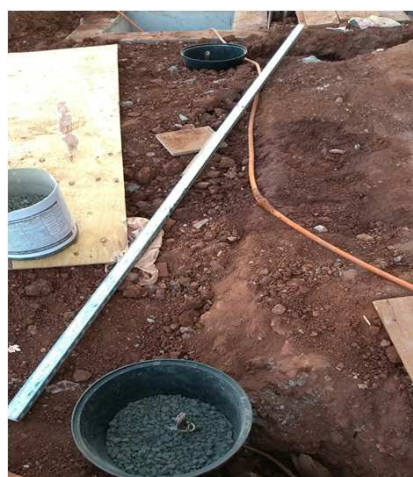
Figura 19E: Sistema de captação SPDA - fitas de alumínio.
