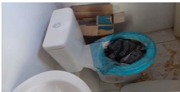
Figura 49C: vaso sanitário com caixa acoplada em sanitário público
