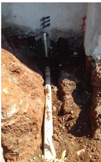
Figura 44C: tubulação de esgoto 100mm
