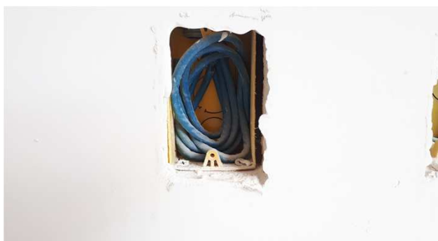
Figura 21E: infraestrutura externa
