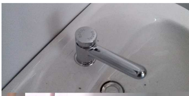
Figura 55C: torneira com fechamento automático, em sanitário público
