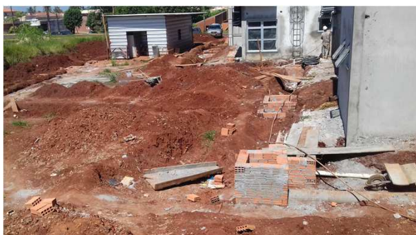
Figura 01C: valas abertas na parte frontal do imóvel
