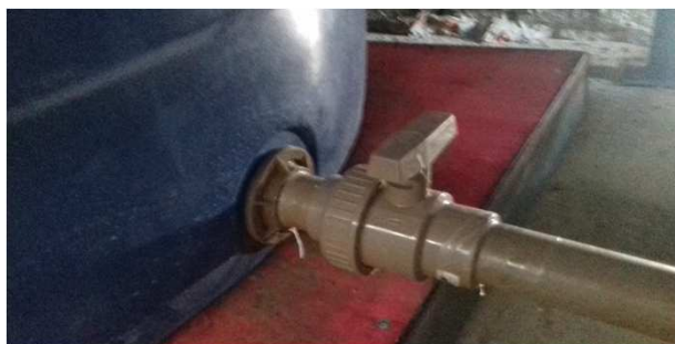
Figura 38C: tubo de 32mm e registro de esfera de 1", na saída de limpeza do 2º reservatório
