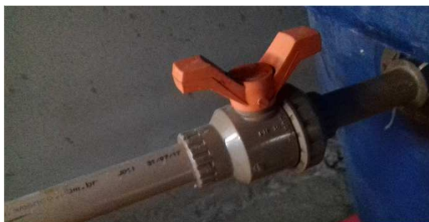
Figura 39C: detalhe de registro de esfera 3/4", na entrada de um dos reservatórios
