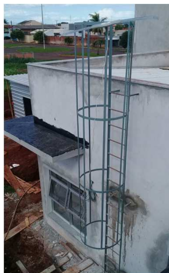
Figura 62C: escada instalada no acesso à cobertura
