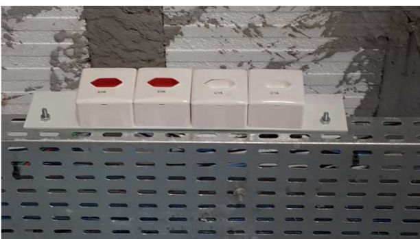
Figura 04E: entrada de energia elétrica e telecomunicações
