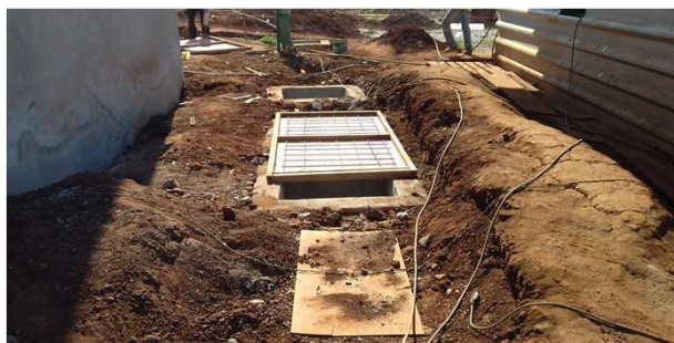
Figura 40C: caixas de inspeção de esgoto 80x80cm
