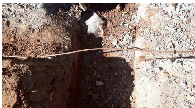
Figura 17E: Sistema de captação SPDA - fitas de alumínio.
