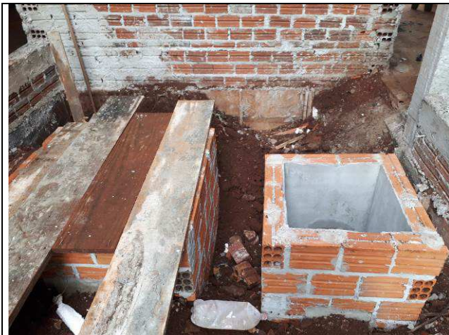
Figura 29E: Caixas 50x50 entrada de telecomunicações
