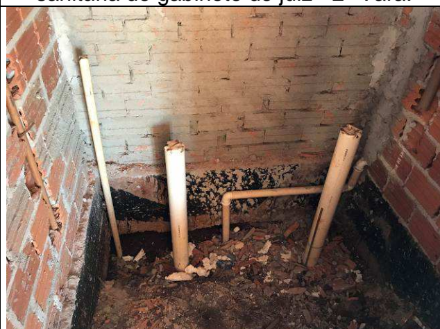
Figura 62C: Pontos de esgoto - instalação sanitária da secretaria - 2ª Vara.
