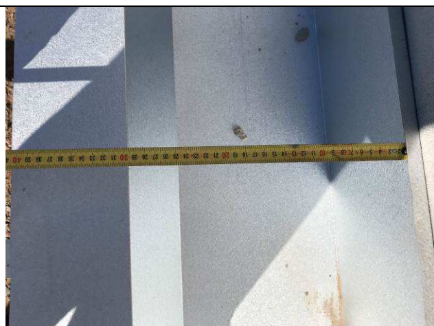
Figura 29C: Calhas da cobertura.
