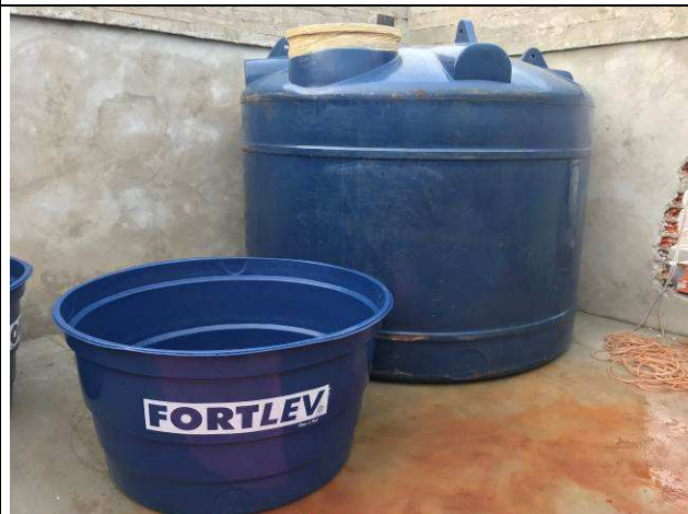
Figura 68C: Reservatórios de água fria (10.000 litros) e reaproveitamento de águas pluviais (1.000 litros).
