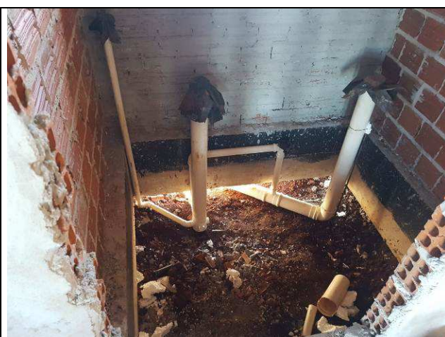
Figura 58C: Pontos de esgoto - instalação sanitária da secretaria - 1ª Vara.
