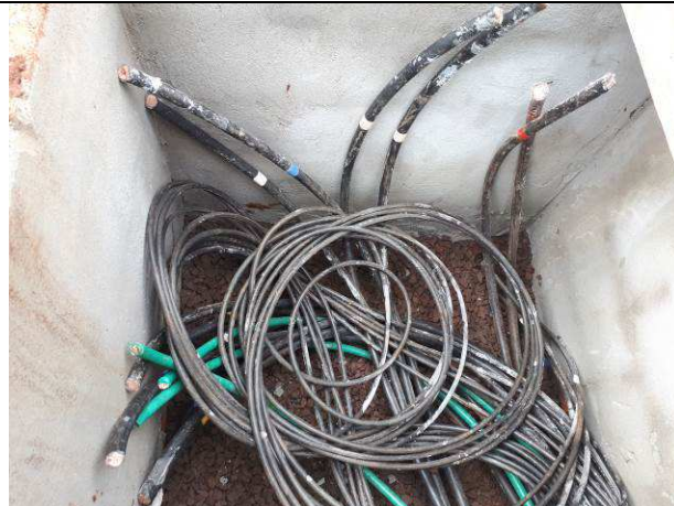
Figura 02E: caixas 80x80 entrada de energia elétrica
