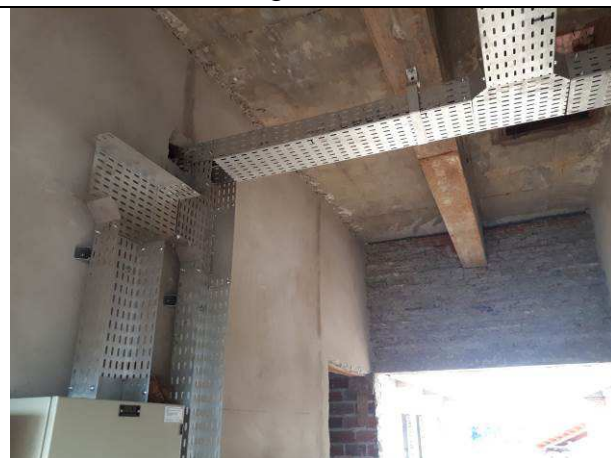
Figura 04E: eletrocalhas sala técnica
