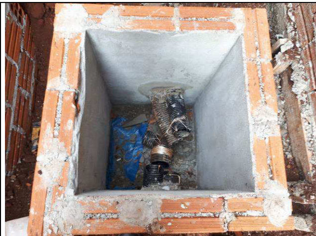
Figura 30E: Caixas 50x50 entrada de telecomunicações
