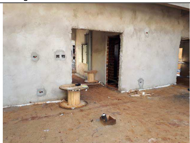
Figura 05E: caixas 2x4, 4x4, eletrodutos hall principal
