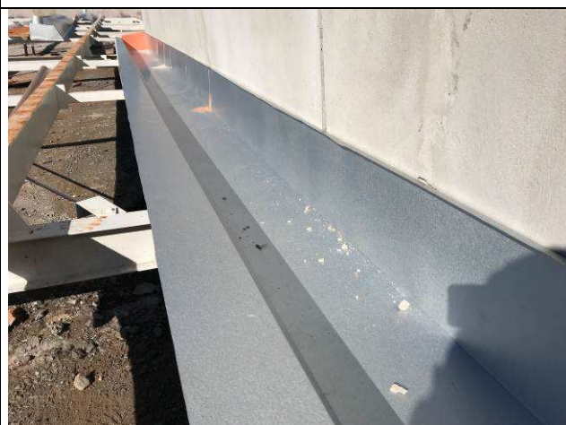
Figura 28C: Calhas da cobertura.
