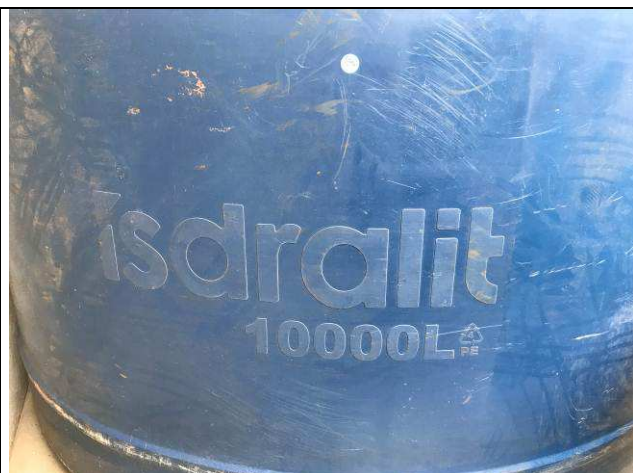
Figura 69C: Reservatórios de água fria (10.000 litros).
