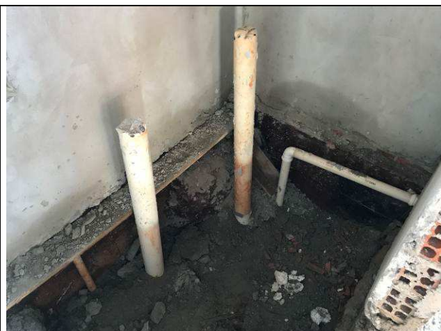
Figura 60C: Pontos de esgoto - instalação sanitária de gabinete de juiz - 2ª Vara.
