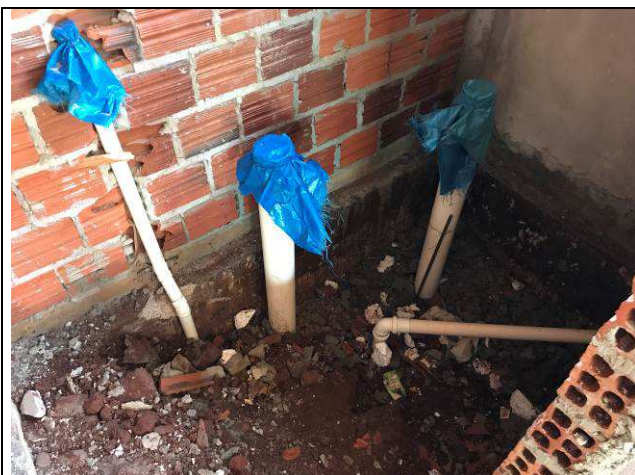
Figura 59C: Pontos de esgoto - instalação sanitária de gabinete de juiz - 1ª Vara.
