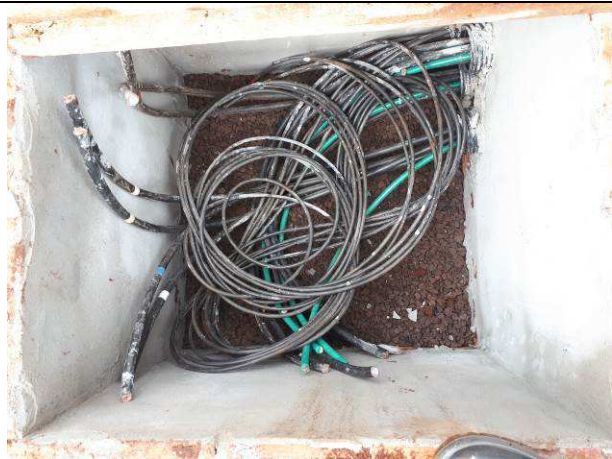
Figura 01E: caixas 80x80 entrada de energia elétrica
