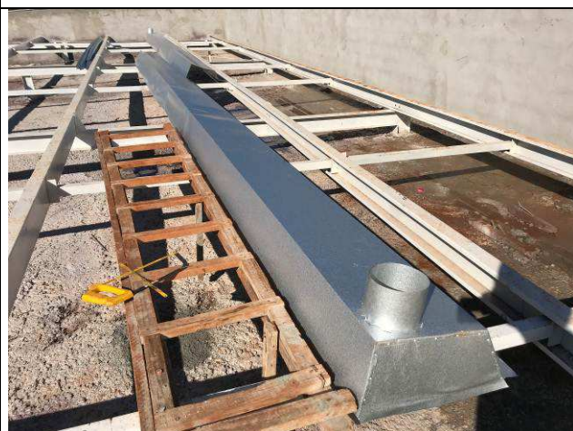
Figura 30C: Calhas da cobertura.
