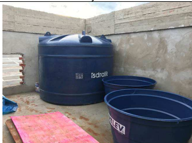
Figura 67C: Reservatórios de água fria (10.000 litros) e reaproveitamento de águas pluviais (1.000 litros).
