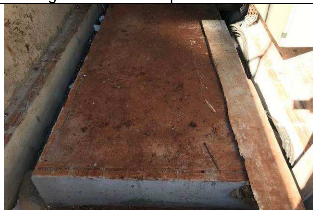
Figura 55C: Canaleta na sala técnica.
