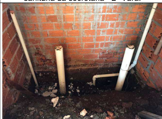
Figura 64C: Pontos de esgoto - instalação sanitária terceirizados.
