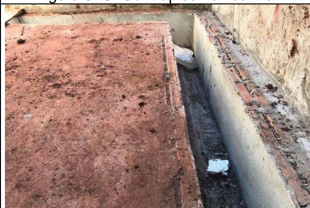
Figura 56C: Canaleta na sala técnica.
