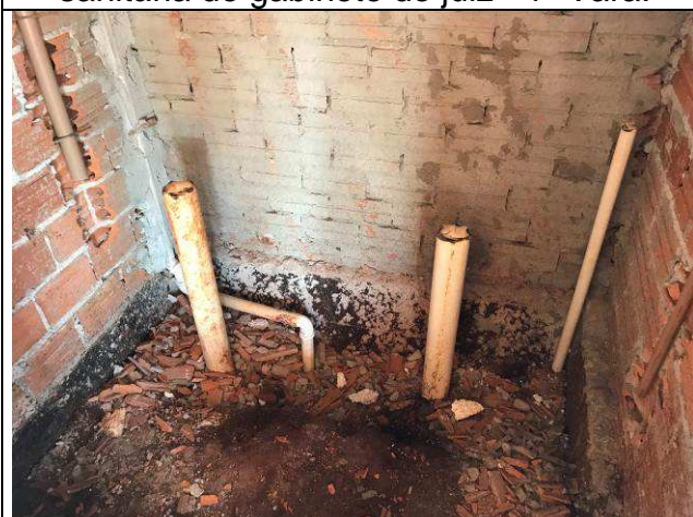
Figura 61C: Pontos de esgoto - instalação sanitária da secretaria - 2ª Vara.
