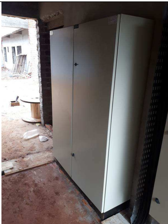
Figura 17E: Quadro QDG
