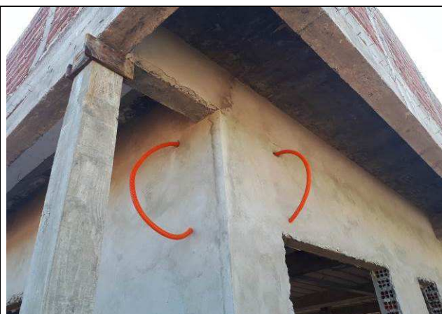
Figura 02E: eletrodutos corrugados.
