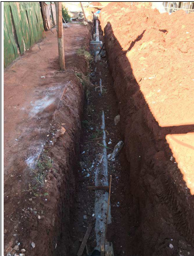
Figura 55C: Tubos de concreto - águas pluviais.
