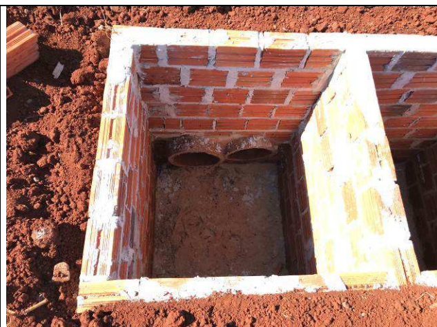
Figura 59C: Tubos de concreto em caixa de passagem - águas pluviais.
