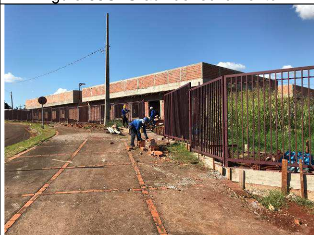
Figura 67C: Gradil de fechamento.
