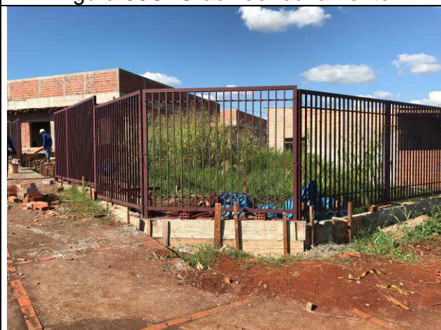
Figura 68C: Gradil de fechamento.
