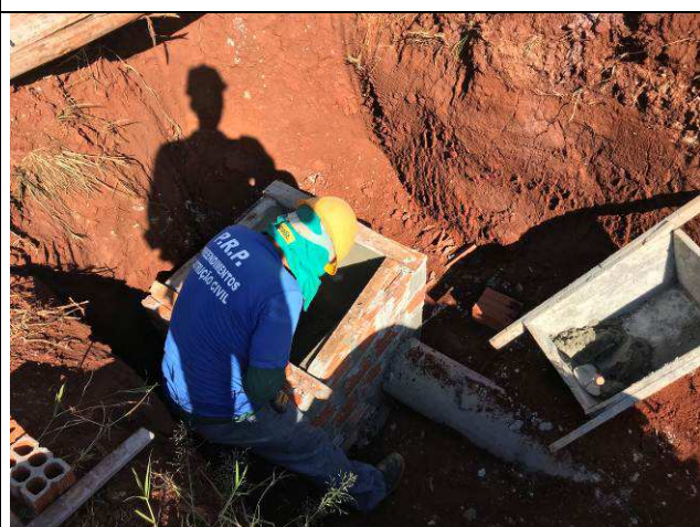
Figura 58C: Tubos de concreto em caixa de passagem - águas pluviais.
