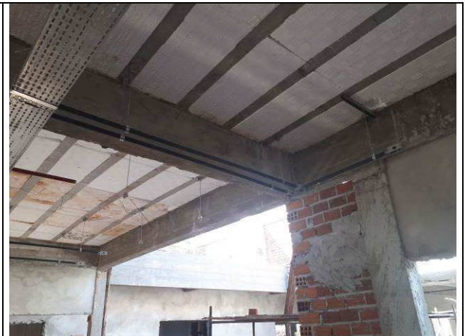
Figura 18E: eletrodutos rígidos e condutores para infraestrutura de lógica.
