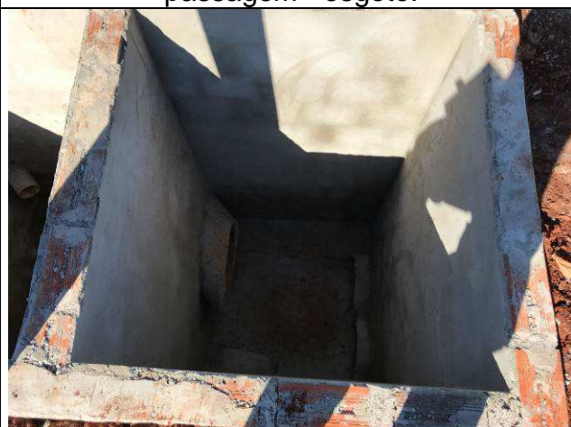
Figura 62C: Caixas de passagem - águas pluviais.
