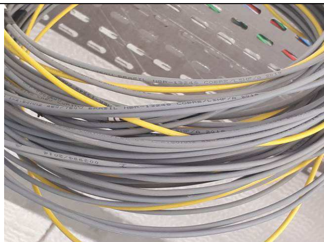
Figura 11E: cabecamento elétrico 2,5mm².
