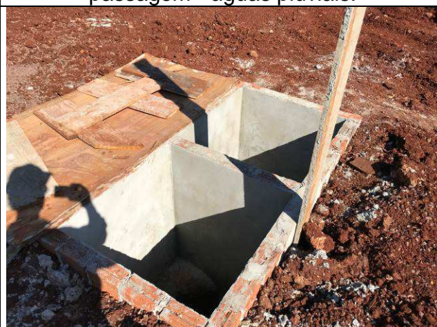
Figura 61C: Caixas de passagem - águas pluviais e esgoto.
