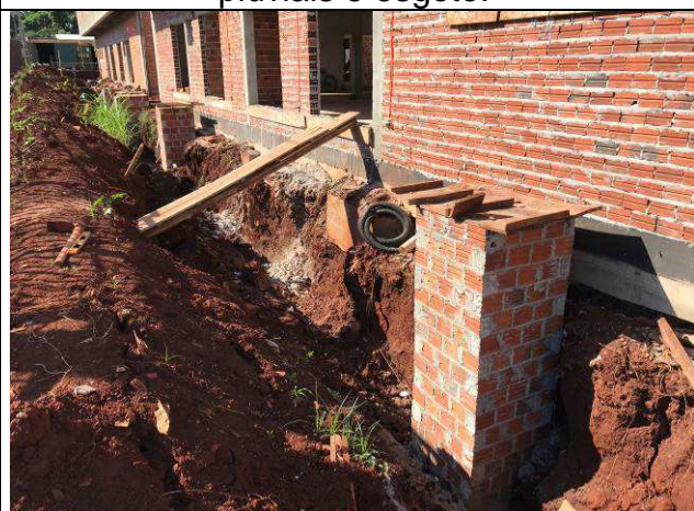
Figura 63C: Caixas de passagem - águas pluviais e esgoto.
