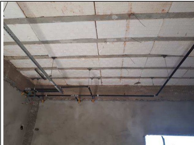
Figura 17E: eletrodutos rígidos e condutores para infraestrutura de lógica.
