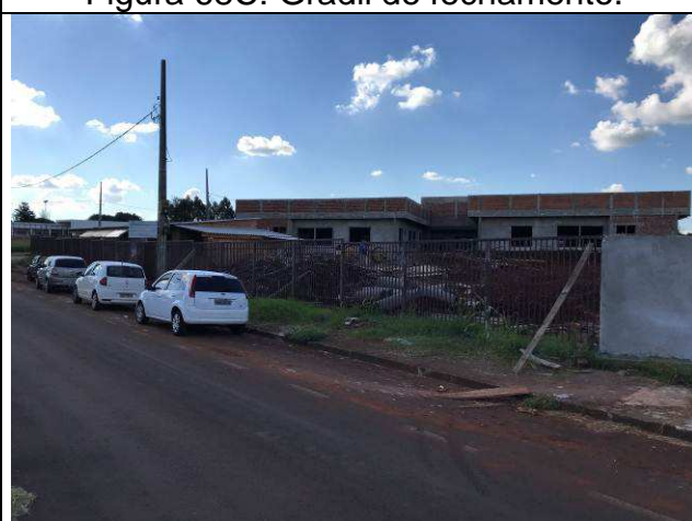
Figura 70C: Gradil de fechamento.
