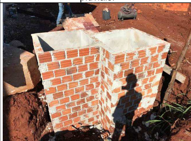
Figura 64C: Caixas de passagem - águas pluviais.
