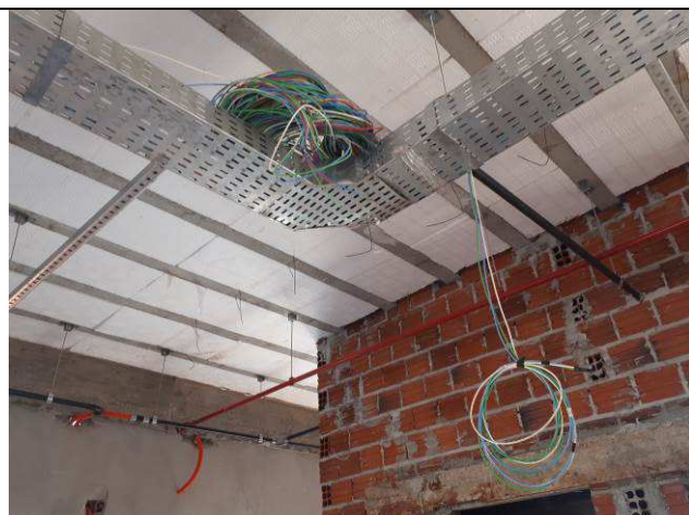
Figura 09E: cabecamento elétrico 2,5mm².
