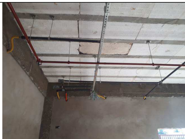
Figura 19E: eletrodutos rígidos e condutores para infraestrutura de lógica e CFTV.
