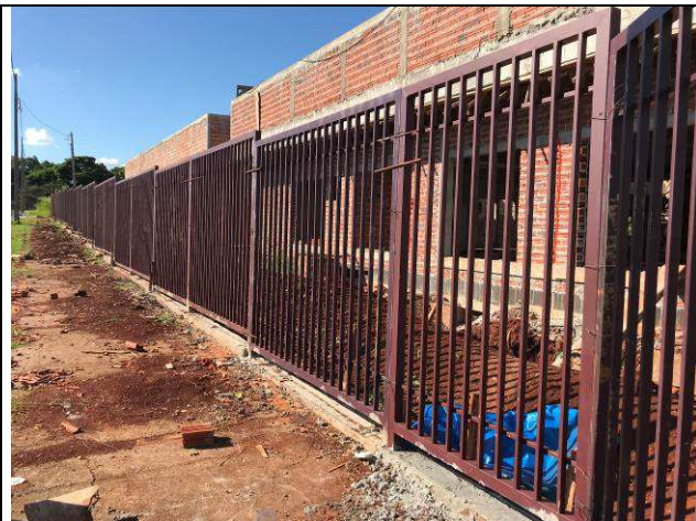
Figura 66C: Gradil de fechamento.
