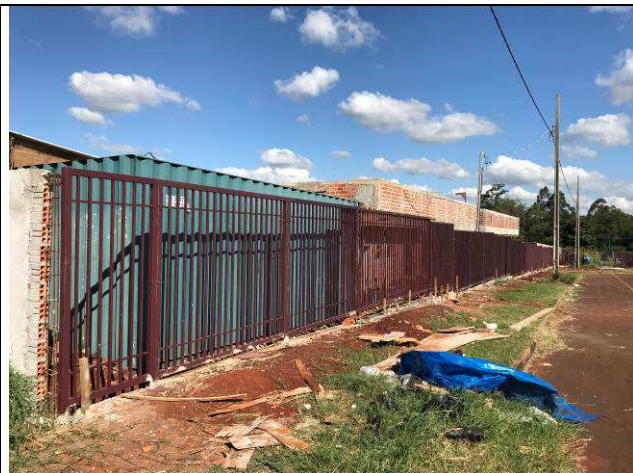
Figura 65C: Gradil de fechamento.
