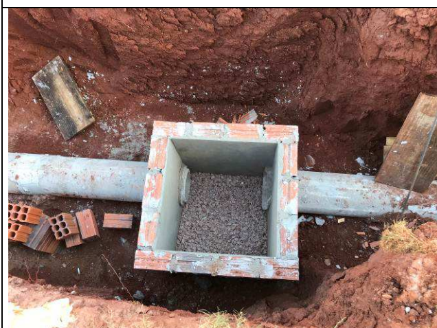
Figura 57C: Tubos de concreto em caixa de passagem - águas pluviais.
