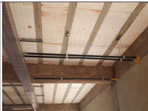
Figura 20E: eletrodutos rígidos e condutores para infraestrutura de lógica e CFTV.
