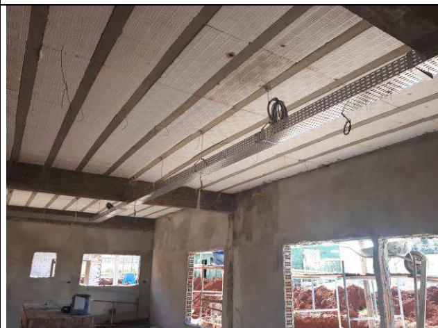
Figura 12E: cabecamento elétrico 2,5mm².
