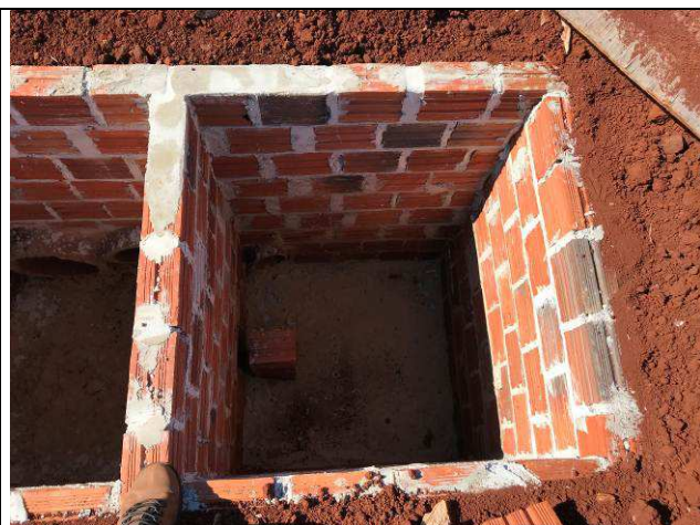
Figura 60C: Tubos de PVC em caixa de passagem - esgoto.
