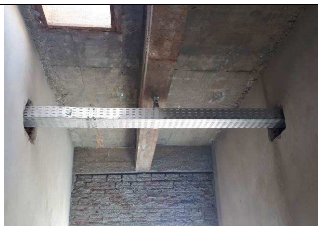
Figura 01E: eletrocalhas de interligação entre quadrantes - sala técnica.
