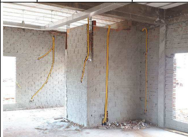
Figura 14E: Eletrodutos e caixas 2x4" - quadrante fundos à esquerda.
