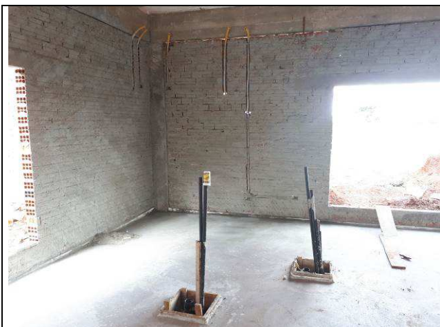
Figura 17E: Eletrodutos PVC rígidos sob o piso - sala de audiências quadrante frontal à direita.
