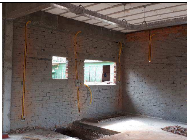
Figura 11E: Eletrodutos e caixas 2x4" - quadrante fundos à direita.
