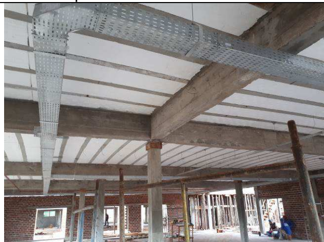
Figura 03E: Eletrocalhas, perfilados - quadrante frontal à esquerda.
