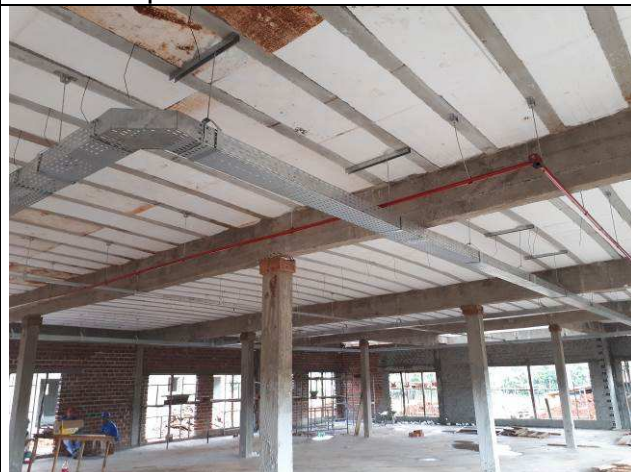
Figura 04E: Eletrocalhas, perfilados - quadrante frontal à esquerda.
