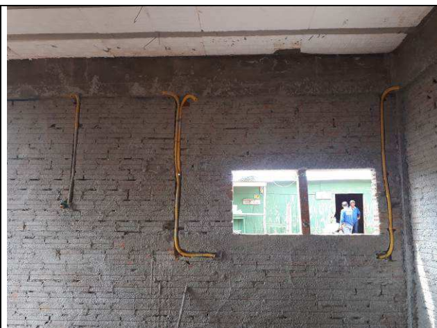
Figura 12E: Eletrodutos e caixas 2x4" - quadrante fundos à esquerda.
