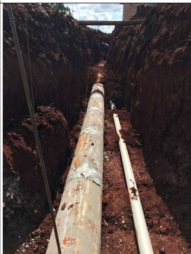
Figura 94C: Tubos de concreto e PVC - águas pluviais e esgoto.
