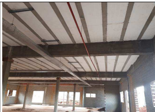
Figura 22E: infraestrutura SDAI - quadrante fundos à direita.
