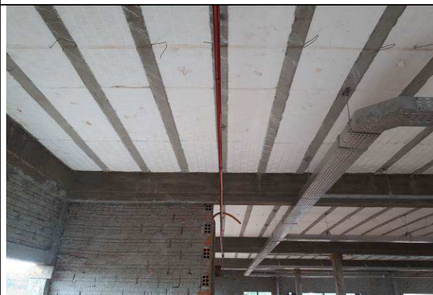
Figura 24E: infraestrutura SDAI - quadrante fundos à esquerda.
