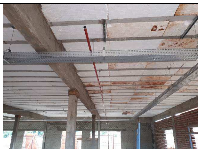
Figura 20E: infraestrutura SDAI - condutores e eletrodutos FG - quadrante frontal à esquerda.
