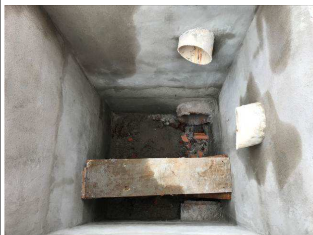
Figura 99C: Caixas de passagem - águas pluviais e esgoto.
