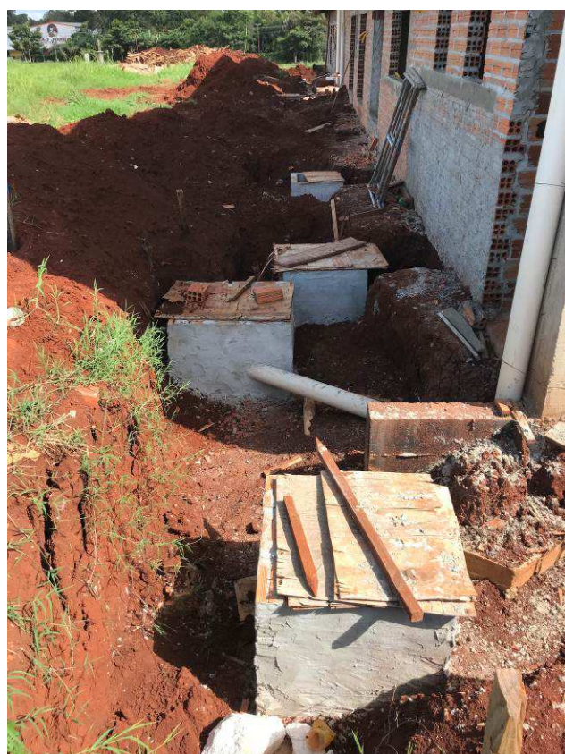
Figura 98C: Caixas de passagem - águas pluviais e esgoto.
