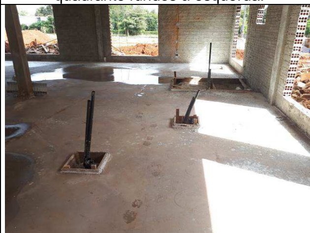
Figura 16E: Eletrodutos sob o piso sala de audiências.
