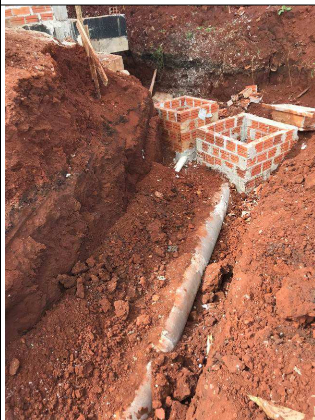
Figura 95C: Tubos de concreto e PVC - águas pluviais e esgoto.
