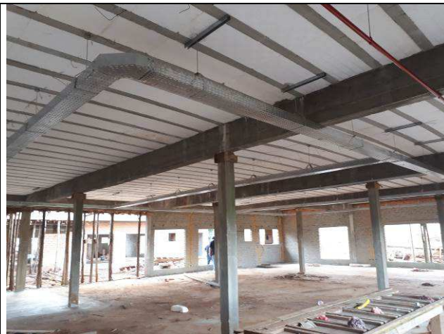
Figura 02E: Eletrocalhas, perfilados - quadrante frontal à direita.
