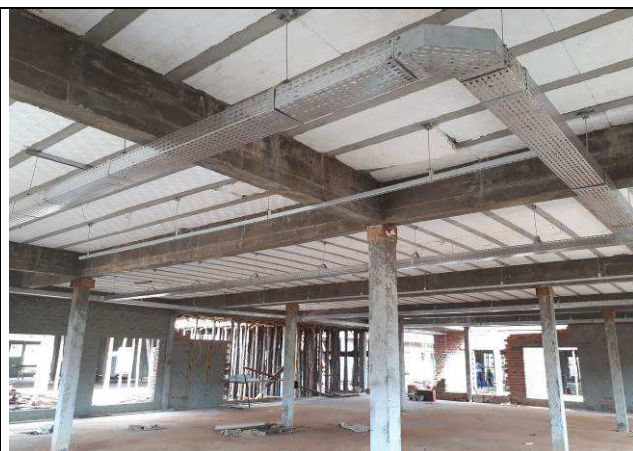
Figura 06E: Eletrocalhas, perfilados - quadrante fundos à esquerda.
