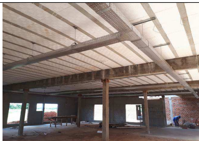
Figura 05E: Eletrocalhas, perfilados - quadrante fundos à direita.
