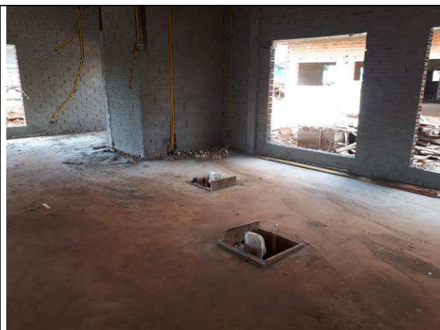
Figura 18E: Eletrodutos PVC rígidos sob o piso - sala de audiências - quadrante fundos à esquerda.
