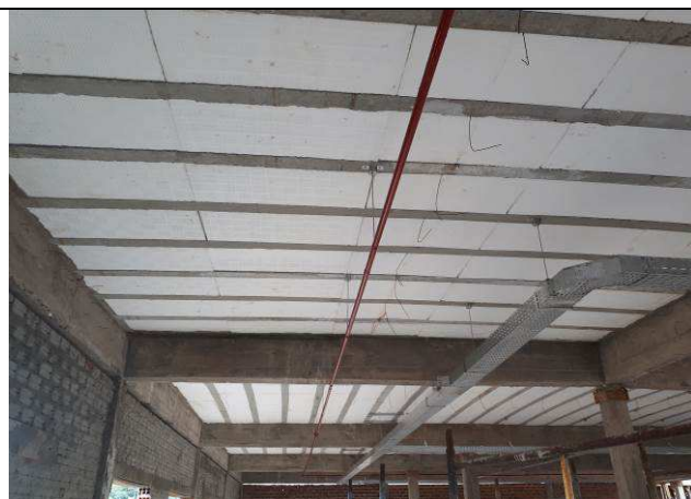
Figura 21E: infraestrutura SDAI - quadrante frontal à esquerda.
