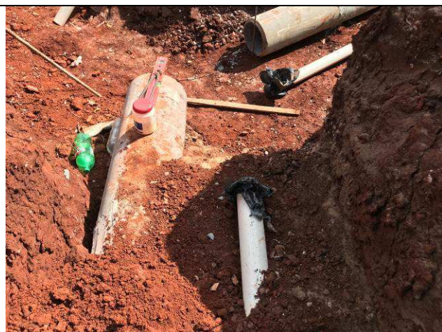
Figura 96C: Tubos de concreto e PVC - águas pluviais e esgoto.
