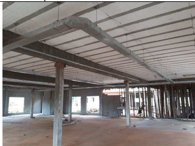
Figura 07E: Eletrocalhas, perfilados - quadrante fundos à esquerda.
