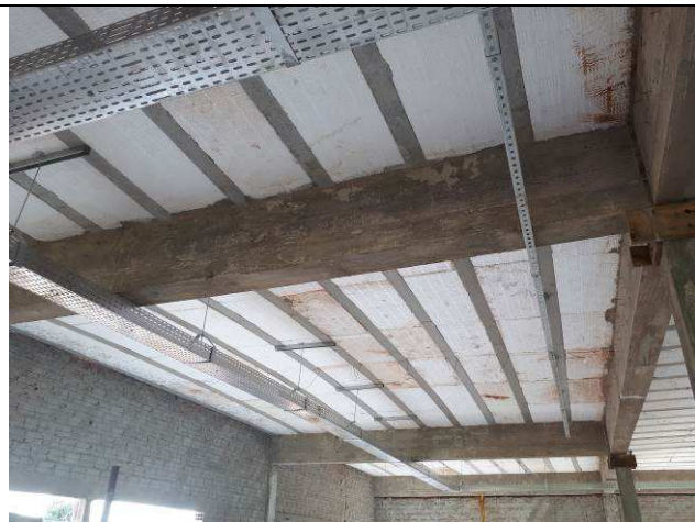
Figura 01E: Eletrocalhas, perfilados - quadrante frontal à direita.
