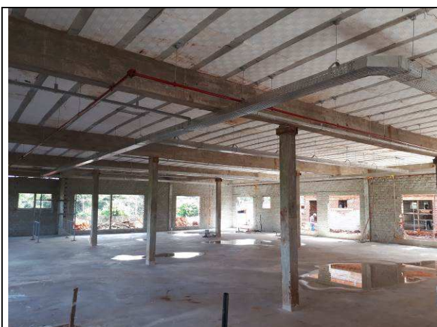
Figura 19E: infraestrutura SDAI - condutores e eletrodutos FG - quadrante frontal à direita.
