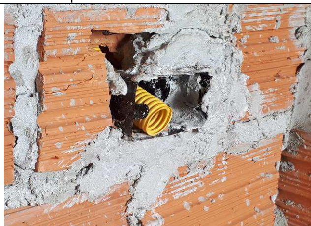
Figura 13E: Eletrodutos e caixas 2x4" - quadrante fundos à esquerda.
