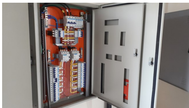
Figura 36E: Quadros elétricos - QDAR
