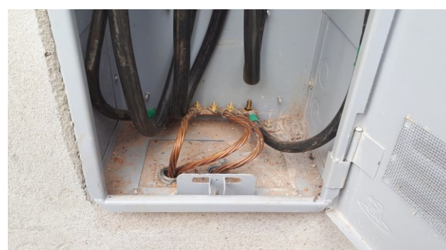
Figura 04E: entrada de energia elétrica e telecomunicações
