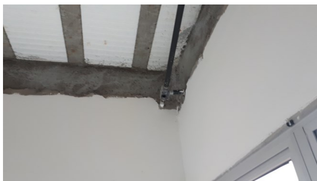
Figura 49E: infraestrutura interna: eletrodutos, caixas
