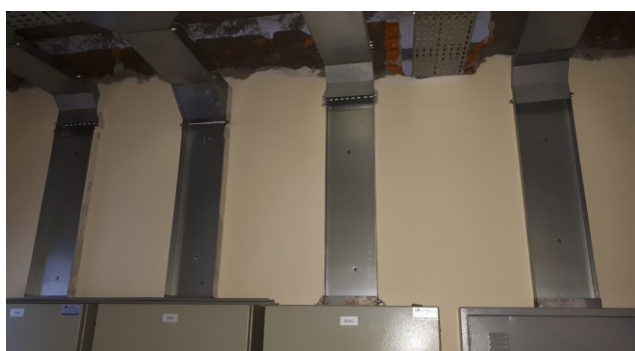
Figura 11E: infraestrutura interna - eletrocalhas
