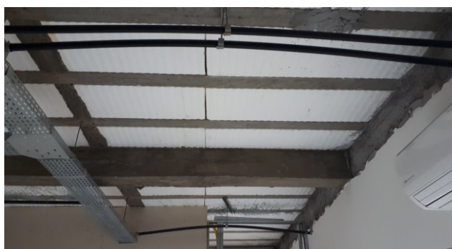
Figura 17E: infraestrutura interna - eletrocalhas, eletrodutos, caixas
