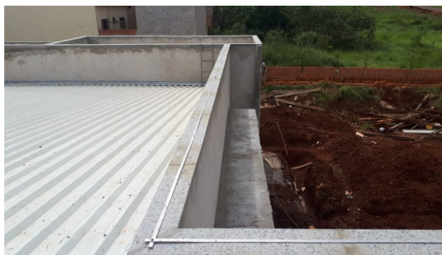
Figura 42E: Sistema de captação SPDA - fitas de alumínio.
