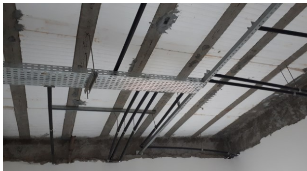
Figura 14E: infraestrutura interna - eletrocalhas, eletrodutos
