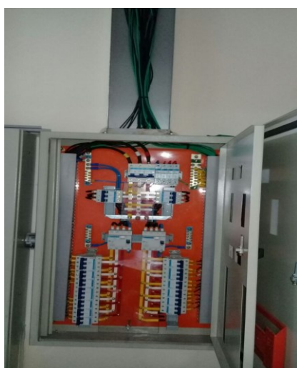
Figura 25E: cabeamento elétrico ar-condicionado
