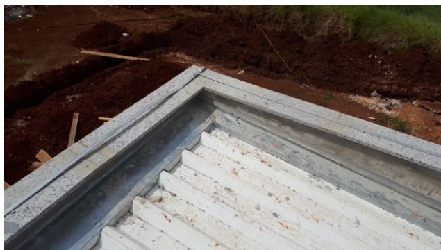
Figura 43E: Sistema de captação SPDA - fitas de alumínio.
