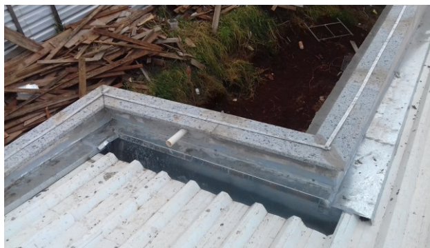
Figura 44E: Sistema de captação SPDA - fitas de alumínio.
