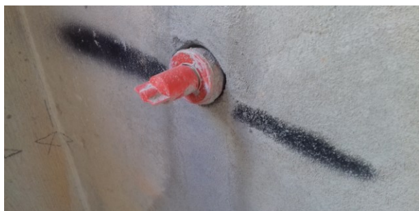
Figura 42C: registro de pressão 3/4", instalado no sanitário do arquivo - chuveiro
