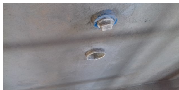
Figura 44C: ponto de água fria, instalado no sanitário da secretaria
