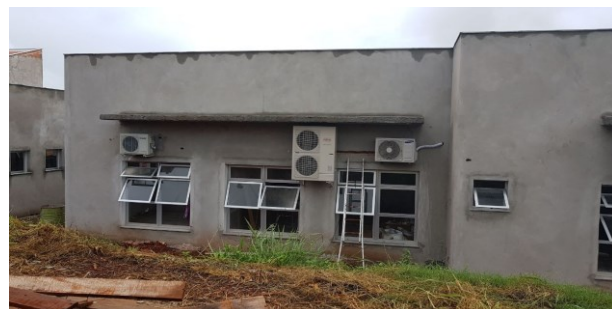
Figura 63C: equip. condensador de 42.000 BTU, c/ evaporadora instalada na secretaria
