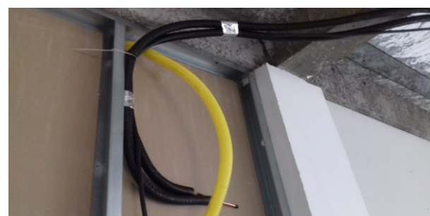
Figura 51C: rede frigorígena instalada no atendimento
