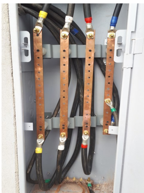
Figura 05E: entrada de energia elétrica e telecomunicações
