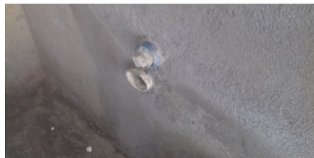
Figura 43C: ponto de água fria, instalado no sanitário PNE
