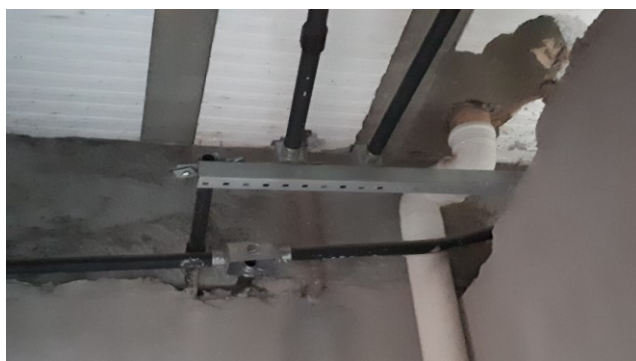
Figura 51E: infraestrutura interna: eletrodutos, caixas
