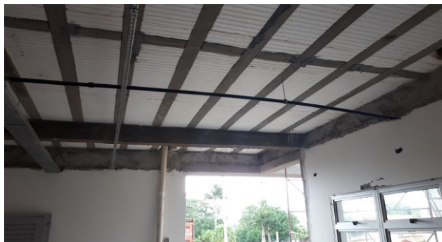
Figura 13E: infraestrutura interna - eletrocalhas, eletrodutos
