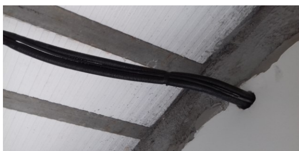
Figura 52C: rede frigorígena instalada na sala de pré-acordo
