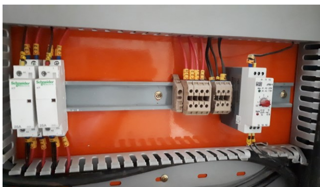
Figura 32E: Quadros elétricos - QDG
