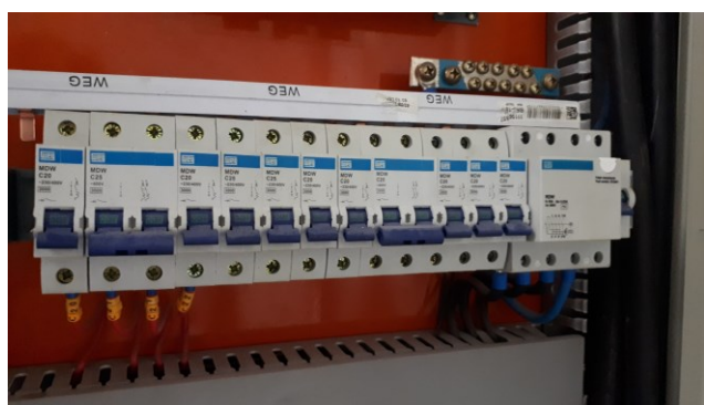
Figura 31E: Quadros elétricos - QDG
