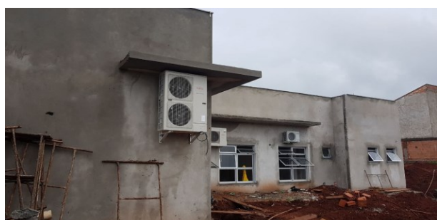
Figura 62C: equipamento condensador de 42.000 BTU, c/ evaporadora instalada no hall
