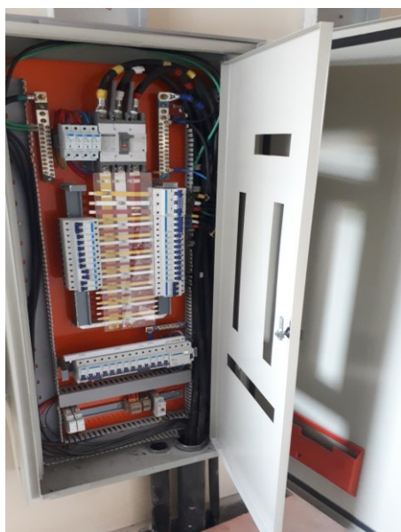
Figura 29E: Quadros elétricos - QDG
