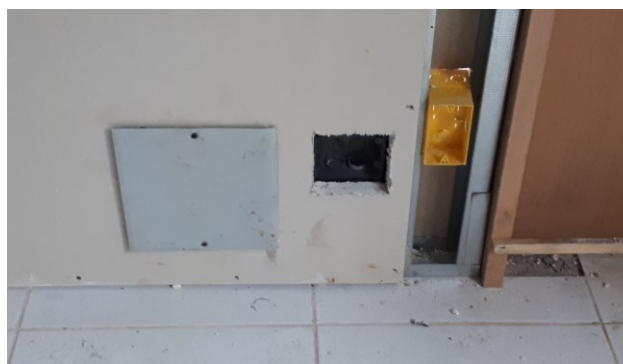
Figura 50E: infraestrutura interna: eletrodutos, caixas
