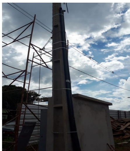
Figura 08E: entrada de energia elétrica e telecomunicações
