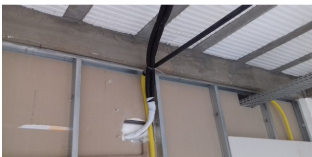
Figura 50C: rede frigorígena instalada na secretaria
