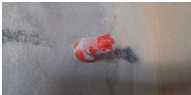
Figura 40C: registro de gaveta 3/4", instalado em sanitário da secretaria
