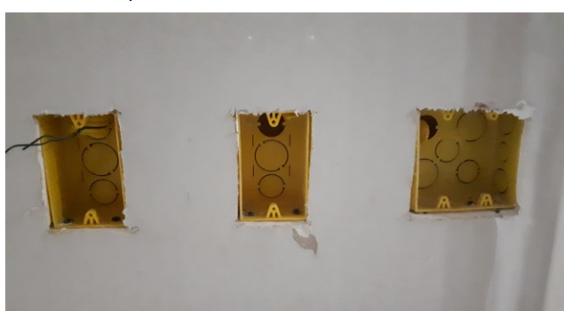
Figura 19E: infraestrutura interna - eletrodutos, caixas
