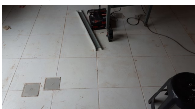
Figura 20E: infraestrutura interna - eletrodutos, caixas de piso
