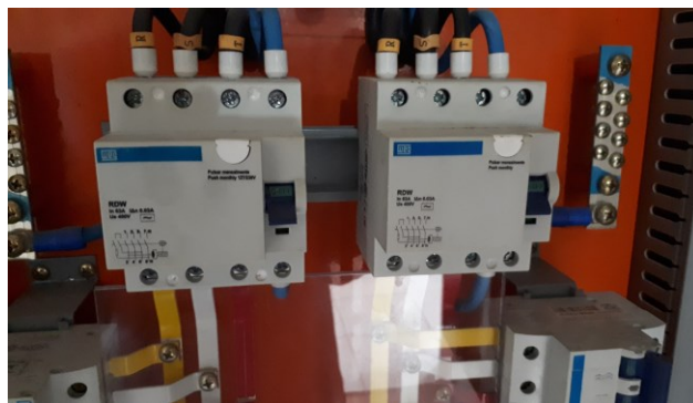
Figura 34E: Quadros elétricos - QDAR
