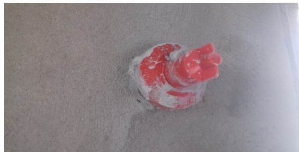
Figura 41C: registro de gaveta 1 1/2", instalado em sanitário PNE
