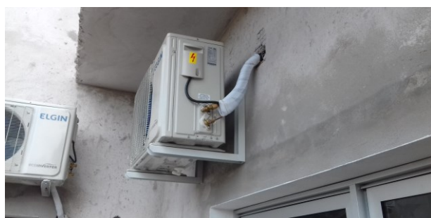
Figura 59C: condensadoras instaladas na lateral direita - gabinete do juiz auxiliar
