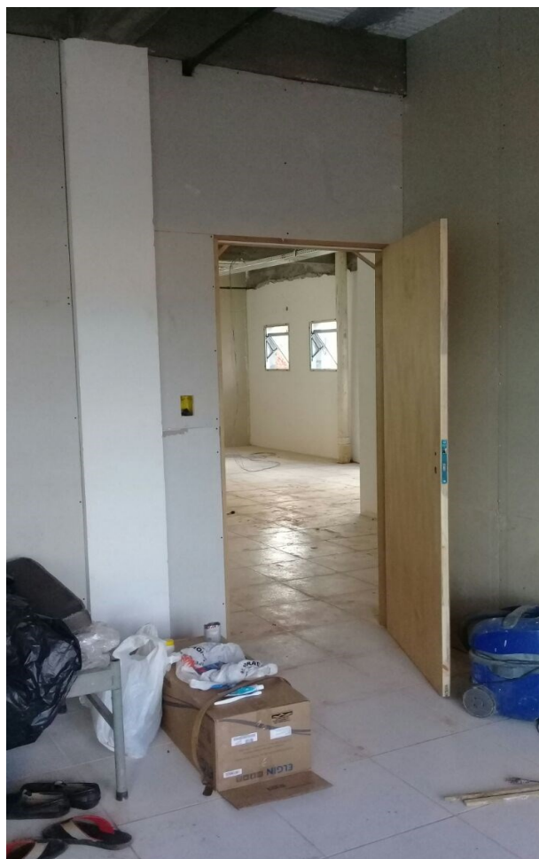
Figura 14C: parede de gesso acartonado em gabinete de juiz
