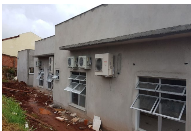
Figura 26E: cabeamento elétrico ar-condicionado
