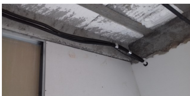
Figura 54C: rede frigorígena instalada na secretaria - aparelho de 18.000 BTU
