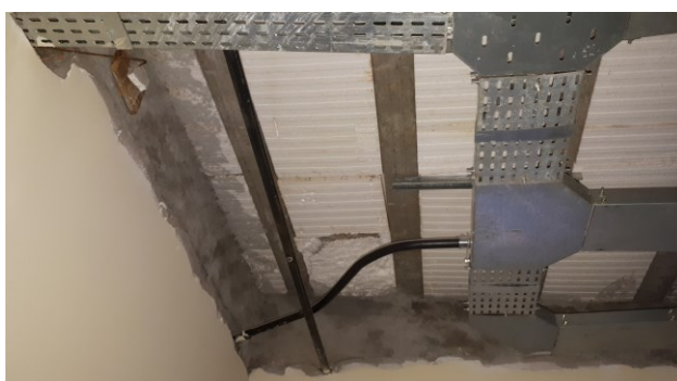
Figura 12E: infraestrutura interna - eletrocalhas, eletrodutos
