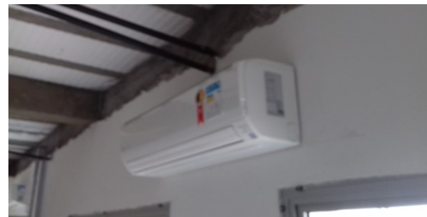
Figura 55C: aparelho de 12.000BTU, instalado na sala de pré-acordo
