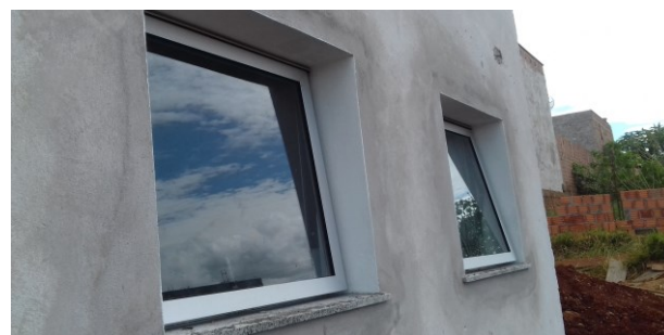
Figura 37C: peitoris em granito instalados em janelas dos sanitários públicos
