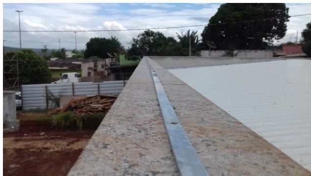
Figura 41E: Sistema de captação SPDA - fitas de alumínio.
