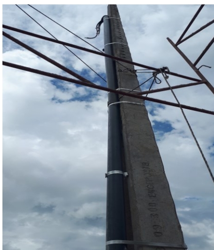
Figura 07E: entrada de energia elétrica e telecomunicações
