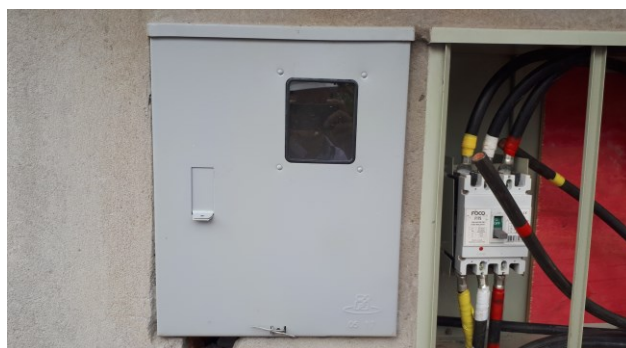
Figura 02E: entrada de energia elétrica e telecomunicações
