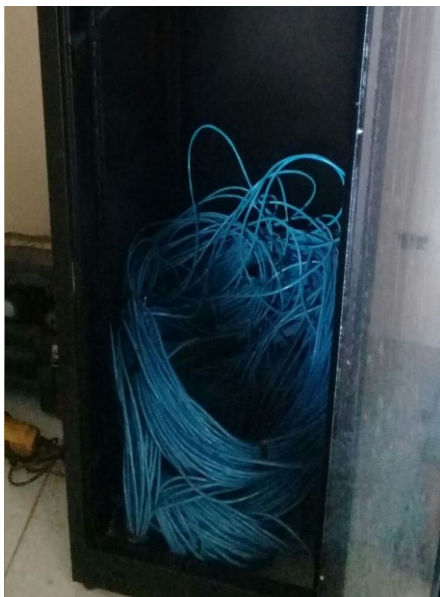
Figura 55E: cabeamento lógico UTP cat6, rack
