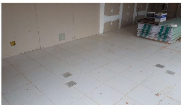
Figura 52E: infraestrutura interna: eletrodutos, caixas de piso
