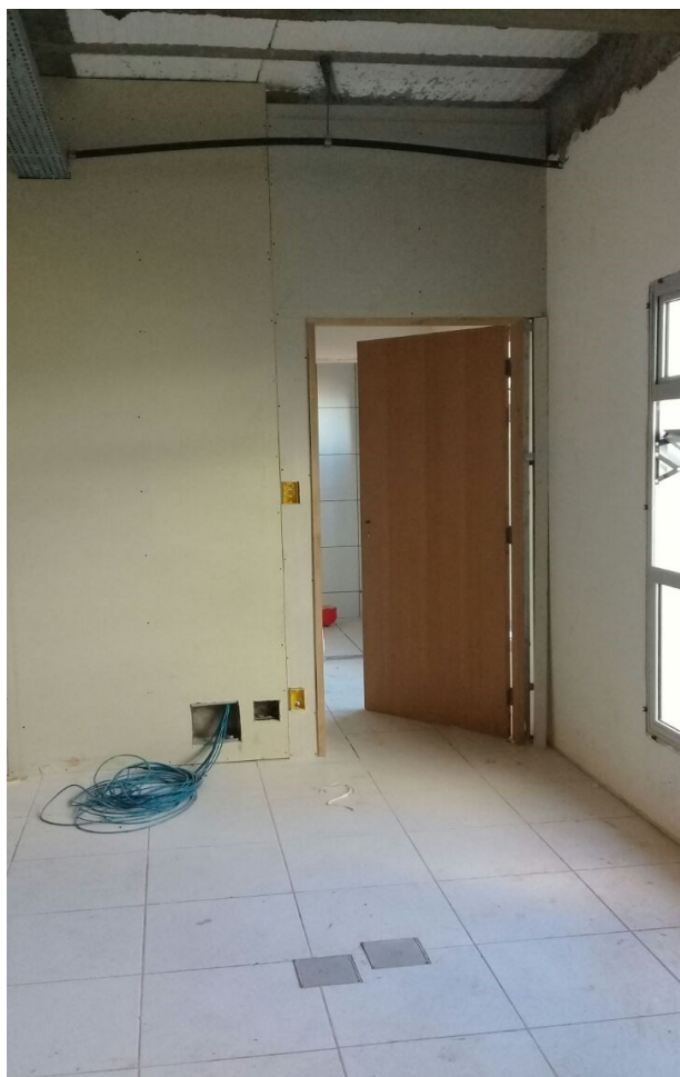
Figura 13C: parede de gesso acartonado em gabinete de juiz
