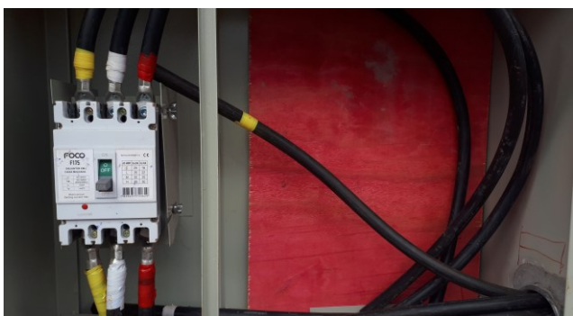
Figura 03E: entrada de energia elétrica e telecomunicações
