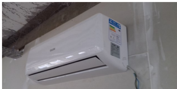
Figura 56C: aparelho de 12.000BTU, instalado na sala de atendimento
