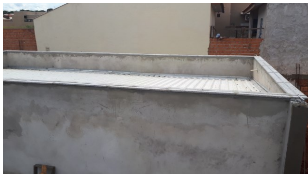
Figura 45E: Sistema de captação SPDA - fitas de alumínio.
