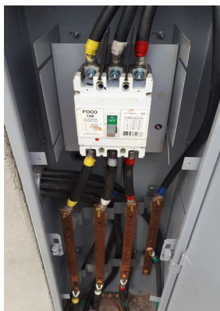
Figura 06E: entrada de energia elétrica e telecomunicações
