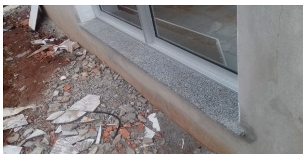
Figura 39C: peitoril em granito, no gabinete do juiz auxiliar
