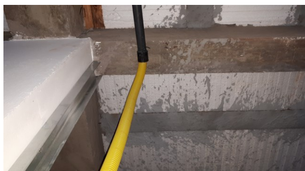
Figura 18E: infraestrutura interna - eletrocalhas, eletrodutos, caixas
