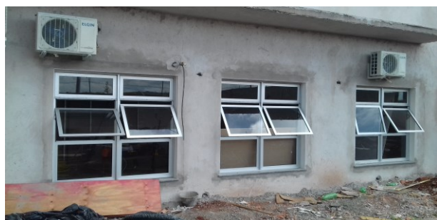
Figura 60C: condensadoras instaladas - gabinete do juiz titular e sala de assistentes
