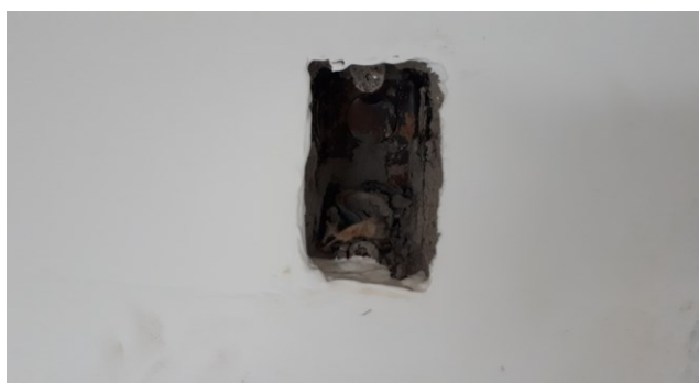
Figura 15E: infraestrutura interna - eletrodutos, caixas
