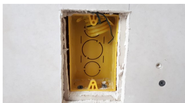
Figura 16E: infraestrutura interna - eletrodutos, caixas
