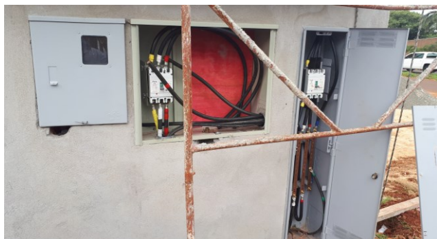
Figura 01E: entrada de energia elétrica e telecomunicações
