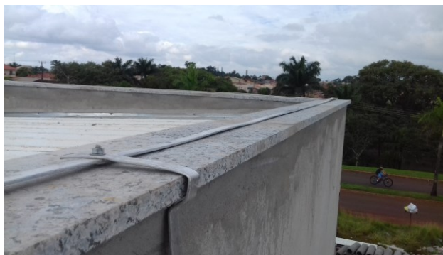
Figura 46E: Sistema de captação SPDA - fitas de alumínio.
