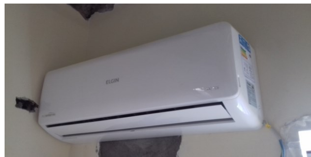
Figura 57C: aparelho de 12.000BTU, instalado no gabinete do juiz auxiliar
