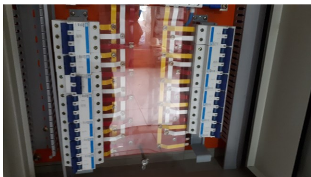
Figura 35E: Quadros elétricos - QDAR
