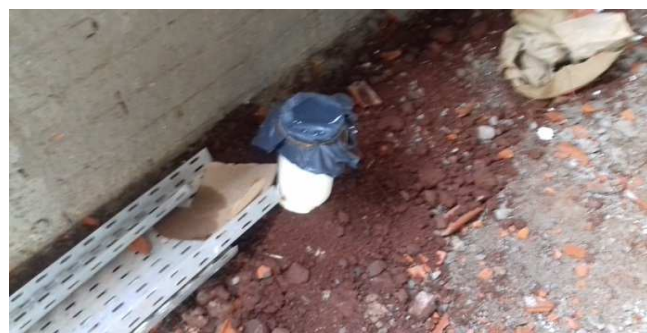
Figura 31C: ponto de esgoto primário em sanitário - 1ª VT
