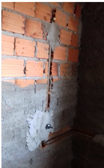
Figura 26C: ponto de água fria em vestiário
