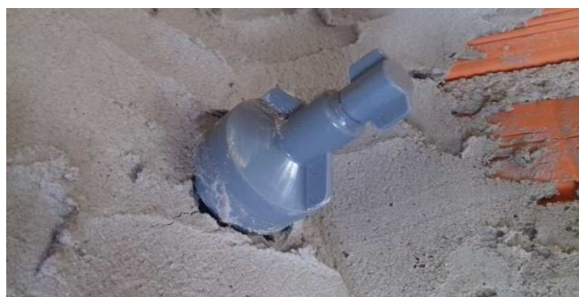
Figura 36C: registro de gaveta instalado em um sanitário de vestiário
