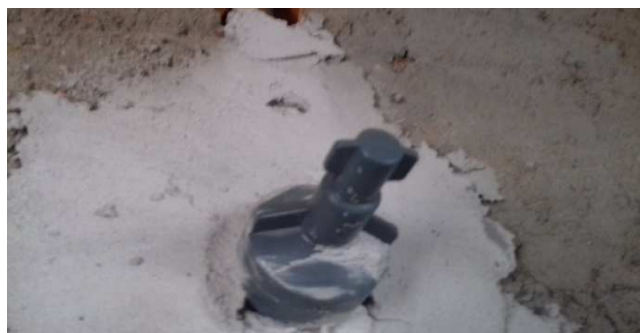
Figura 37C: registro de gaveta instalado em um sanitário de secretaria
