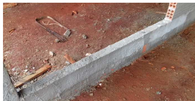
Figura 06C: contraverga em vão de janela - bloco central
