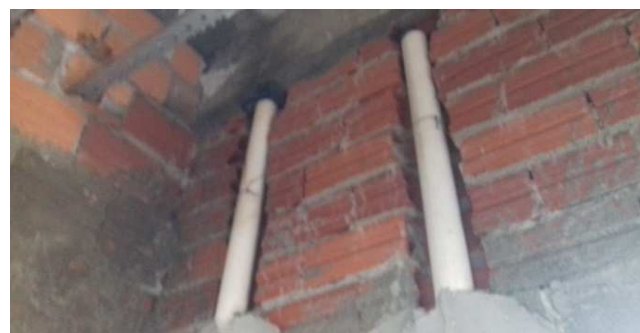
Figura 32C: pontos de esgoto secundário - ventilação - em sanitário da 2ª VT
