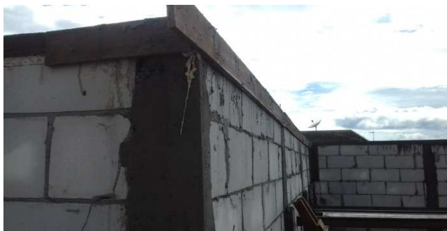
Figura 02C: pilaretes de travamento da platibanda e vigas cinta de amarração - bloco da direita
