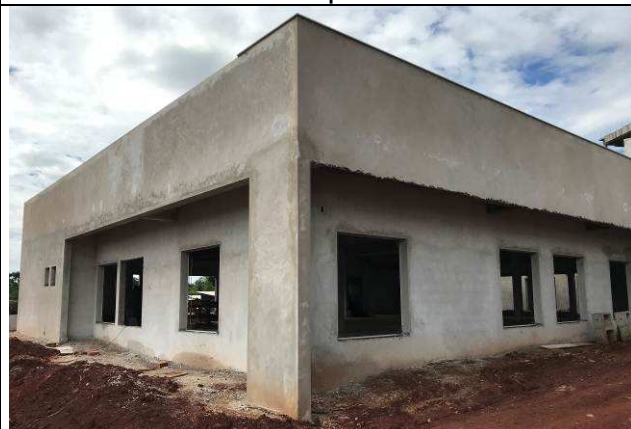
Figura 62C: Revestimento argamassado da face externa - requadros - Fórum.
