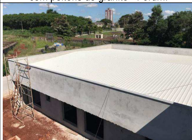
Figura 18C: Rufos da cobertura do barrilete - Fórum.
