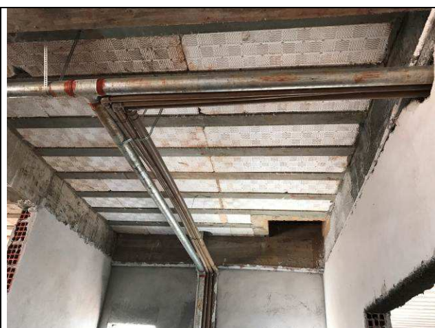
Figura 118C: Tubulação da rede de hidrantes.
