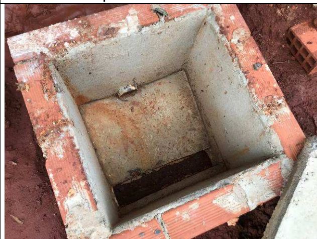
Figura 114C: Rede de coleta de esgoto - Fórum.
