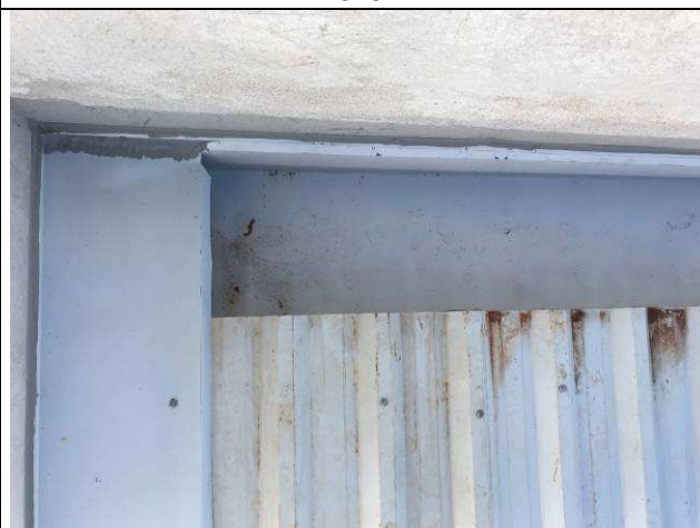
Figura 20C: Rufos da cobertura do barrilete - Fórum.
