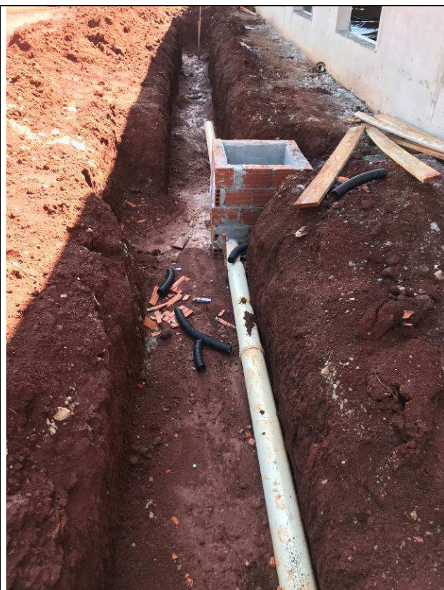
Figura 115C: Rede de coleta de esgoto - Fórum.
