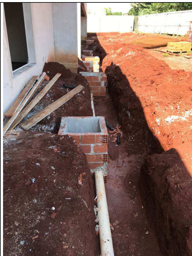
Figura 116C: Rede de coleta de esgoto - Fórum.
