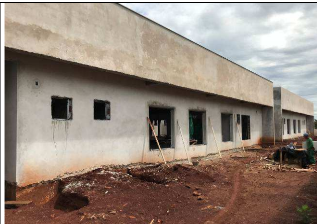
Figura 60C: Revestimento argamassado da face externa - requadros - Fórum.
