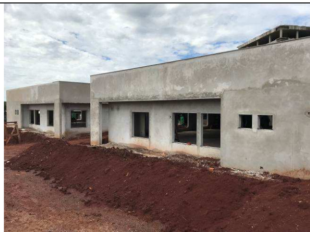
Figura 65C: Revestimento argamassado da face externa - requadros - Fórum.
