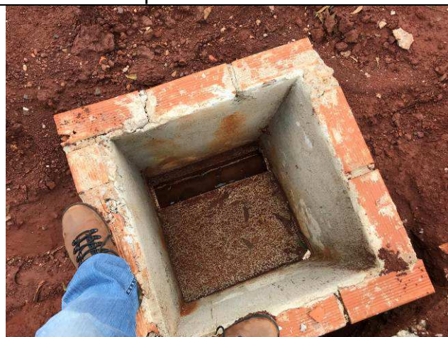
Figura 113C: Rede de coleta de esgoto - Fórum.
