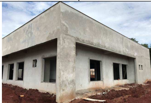
Figura 61C: Revestimento argamassado da face externa - requadros - Fórum.
