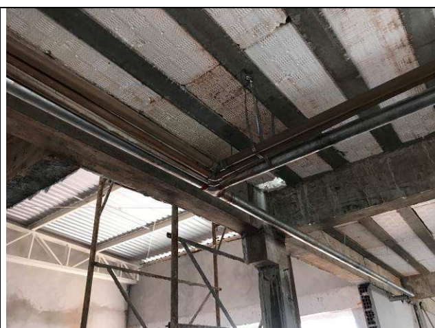
Figura 117C: Tubulação da rede de hidrantes.
