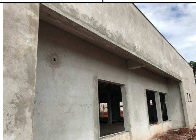
Figura 64C: Revestimento argamassado da face externa - requadros - Fórum.
