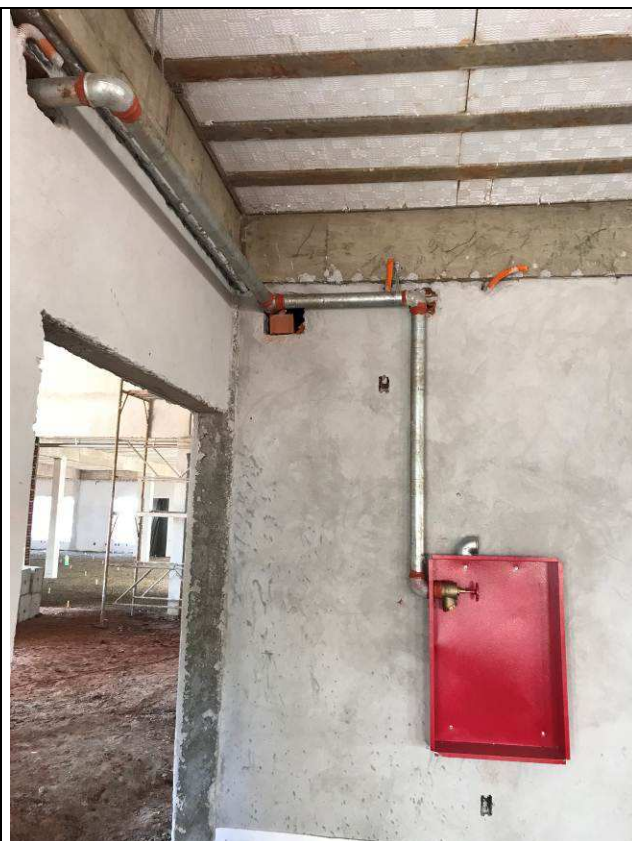
Figura 120C: Abrigo para hidrantes - Fórum.
