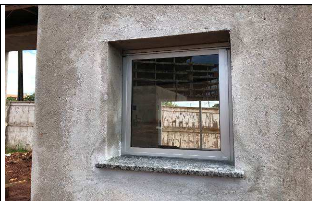
Figura 08C: Janela de alumínio, tipo máximo ar, instalada na guarita.
