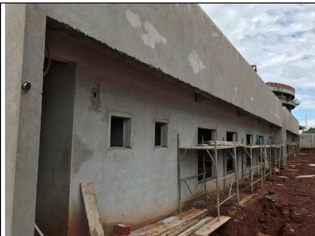
Figura 66C: Revestimento argamassado da face externa - requadros - Fórum.
