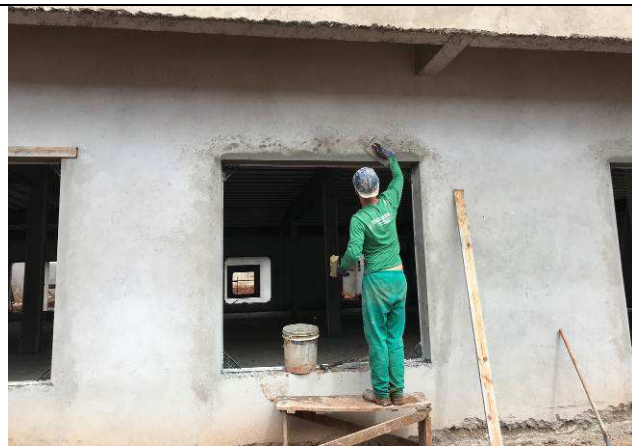
Figura 59C: Revestimento argamassado da face externa - requadros - Fórum.
