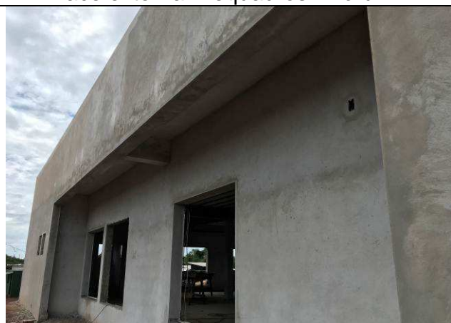
Figura 63C: Revestimento argamassado da face externa - requadros - Fórum.
