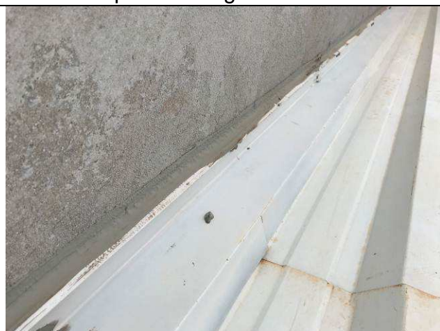
Figura 19C: Rufos da cobertura do barrilete - Fórum.
