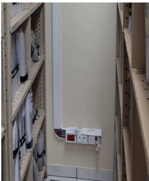
Figura 15E: Canaleta de alumínio
