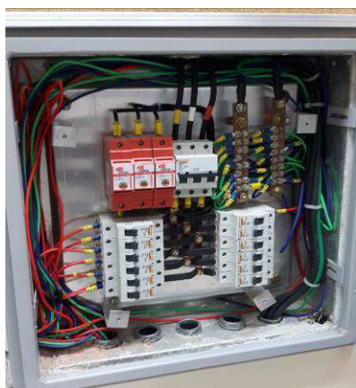
Figura 01E: Revisão dos quadros elétricos
