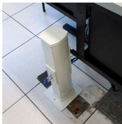
Figura 02E: Adequação de pontos lógicos
