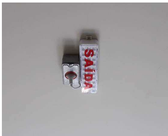
Figura 10E: Luminária de emergência
