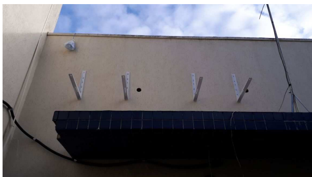
Figura 11c: suportes para equipamentos de ar condicionado
