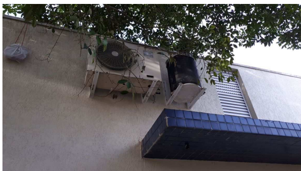
Figura 09c: Eq. Ar condicionado realocado
