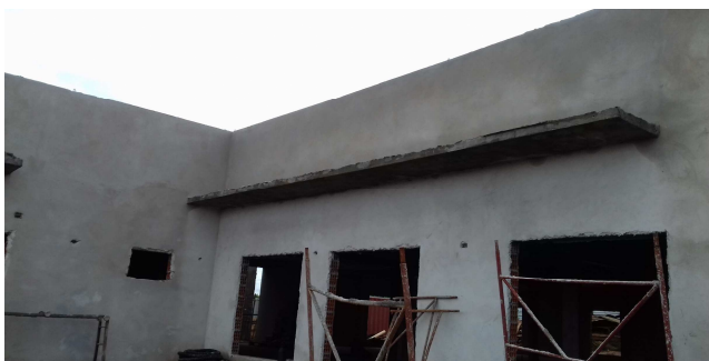
Figura 13C: rebôco externo do prédio principal - lateral direita
