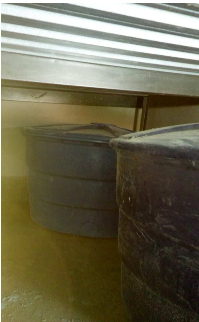
Figura 25C: Reservatórios em polietileno
