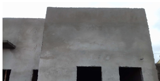
Figura 14C: rebôco externo do prédio principal - lateral direita
