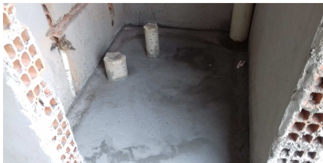
Figura 19C: Ponto de esgoto primário, secundário e tubulação de ventilação subindo
