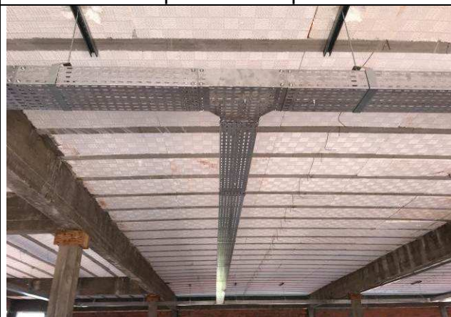
Figura 06E: Eletrocalhas e perfilados - Sala Múltiplo Uso / Arquivo.
