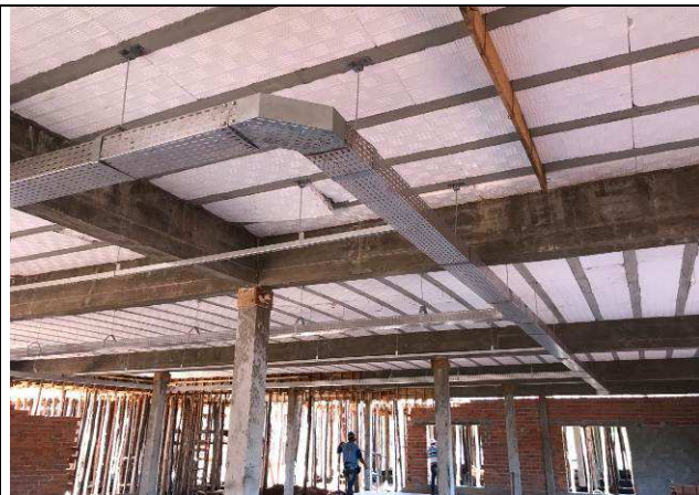
Figura 01E: Eletrocalhas e perfilados - 2ª Vara do Trabalho
