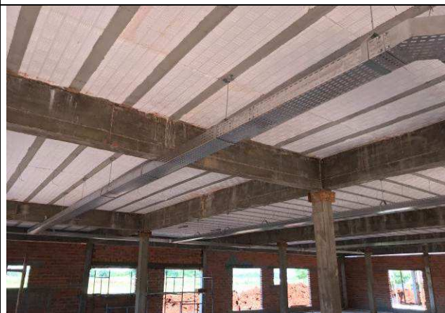
Figura 05E: Eletrocalhas e perfilados - Sala Múltiplo Uso / Arquivo.
