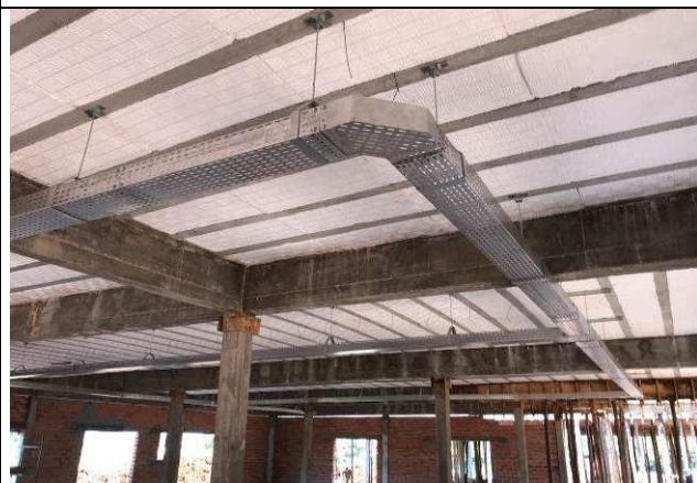
Figura 04E: Eletrocalhas e perfilados - Sala Múltiplo Uso / Arquivo.
