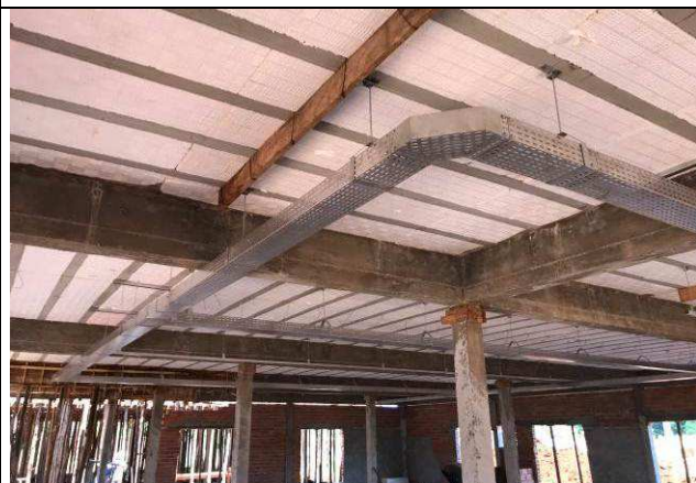
Figura 03E: Eletrocalhas e perfilados - 2ª Vara do Trabalho.
