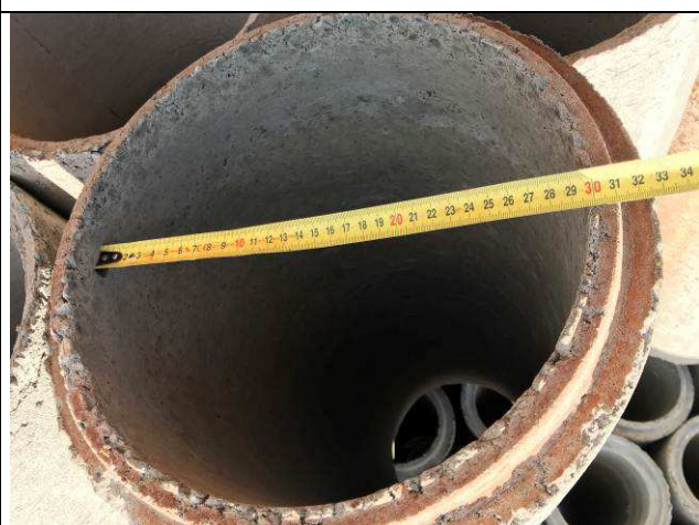
Figura 74C: Tubos de concreto - águas pluviais.
