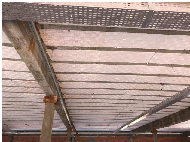
Figura 07E: Eletrocalhas e perfilados - Sala Múltiplo Uso / Arquivo.
