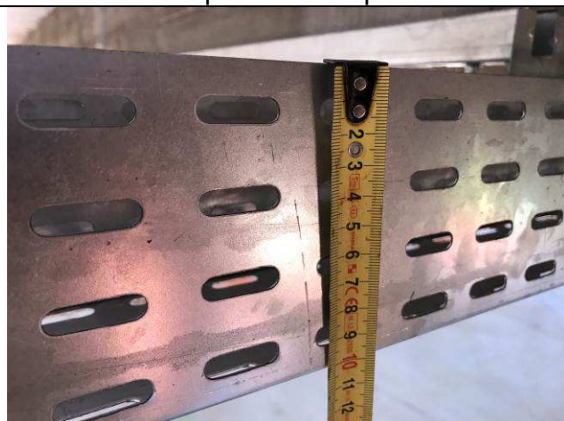
Figura 09E: Eletrocalhas - altura 100 mm.
