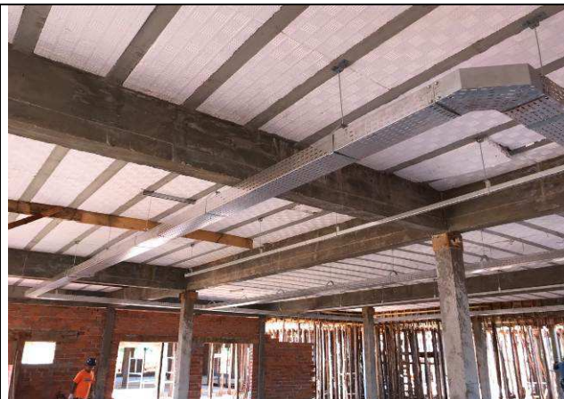
Figura 02E: Eletrocalhas e perfilados - 2ª Vara do Trabalho.
