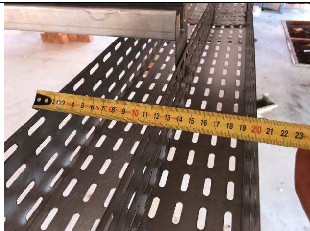
Figura 08E: Eletrocalhas - largura 200 mm.
