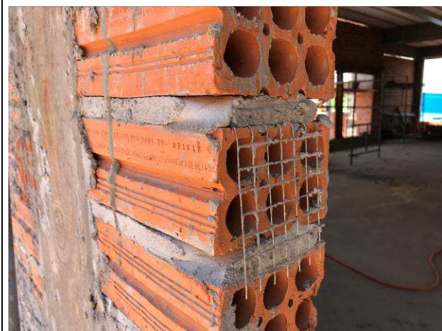
Figura 36C: Na união entre as alvenarias e os pilares de concreto foi utilizada tela soldada, para evitar fissuras nas ligações entre a estrutura e a alvenaria.
