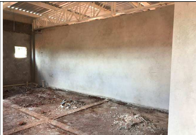
Figura 57C: Revestimento argamassado das paredes internas - Arquivo.
