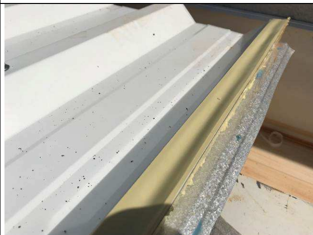
Figura 38C: Aplicação de fita de vedação à base de borracha butílica nas emendas.
