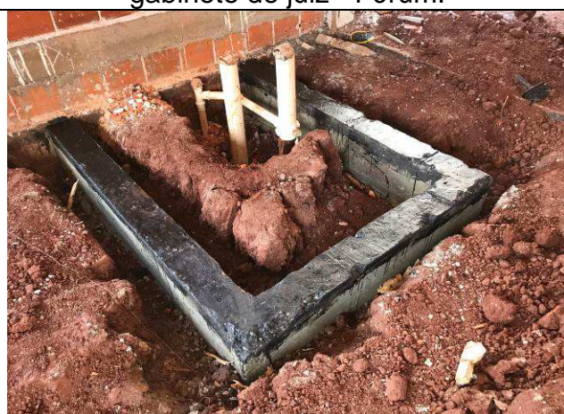
Figura 85C: Pontos de esgoto - BWC gabinete de juiz - Fórum.
