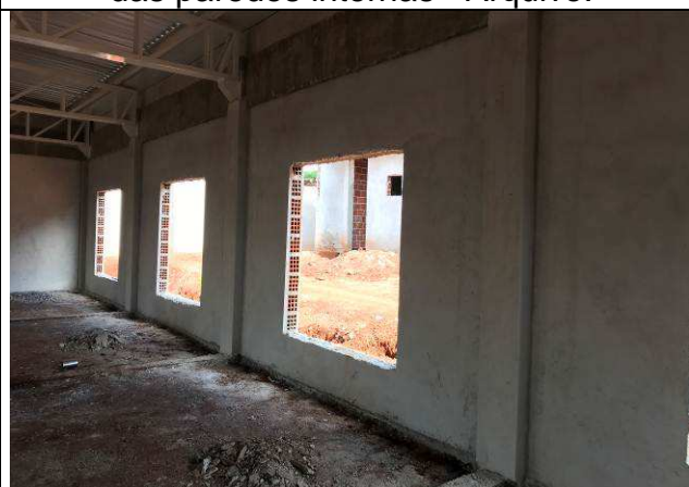
Figura 59C: Revestimento argamassado das paredes internas - Arquivo.
