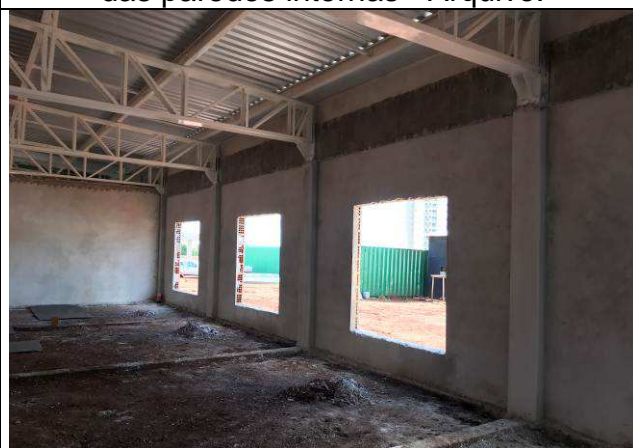
Figura 60C: Revestimento argamassado das paredes internas - Arquivo.
