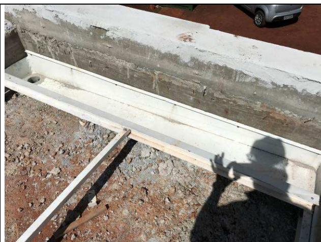
Figura 52C: Calhas de cobertura - Guarita.
