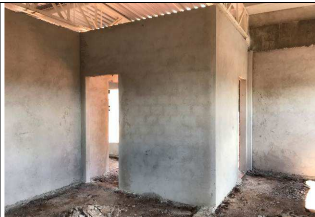
Figura 58C: Revestimento argamassado das paredes internas - Arquivo.
