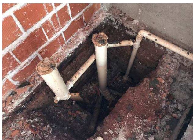
Figura 73C: Pontos de esgoto - BWC gabinete de juiz - Fórum.
