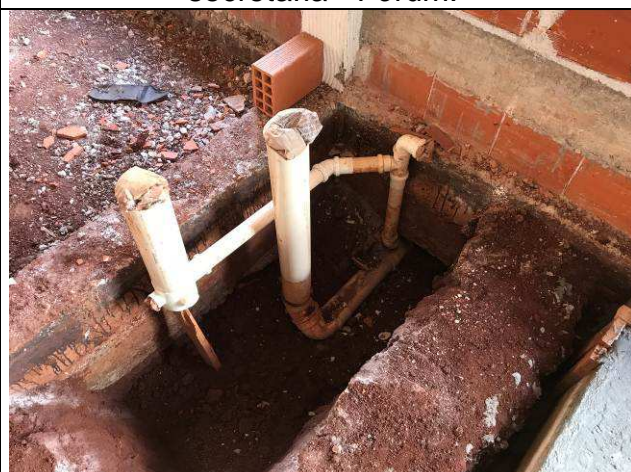
Figura 84C: Pontos de esgoto - BWC gabinete de juiz - Fórum.
