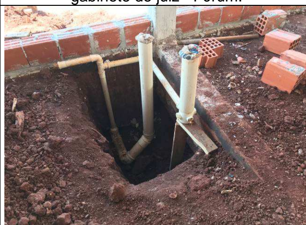
Figura 86C: Pontos de esgoto - BWC perícia - Fórum.
