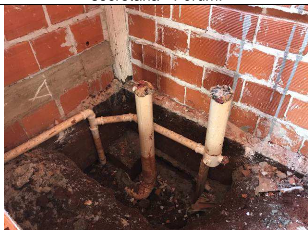
Figura 83C: Pontos de esgoto - BWC gabinete de juiz - Fórum.
