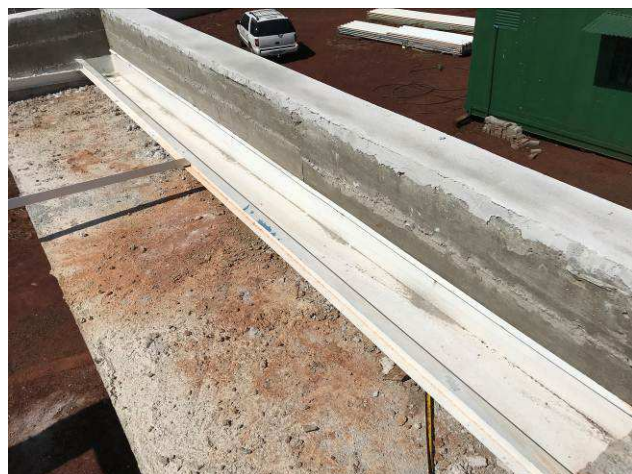
Figura 53C: Calhas de cobertura - Guarita.
