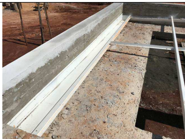
Figura 51C: Calhas de cobertura - Guarita.
